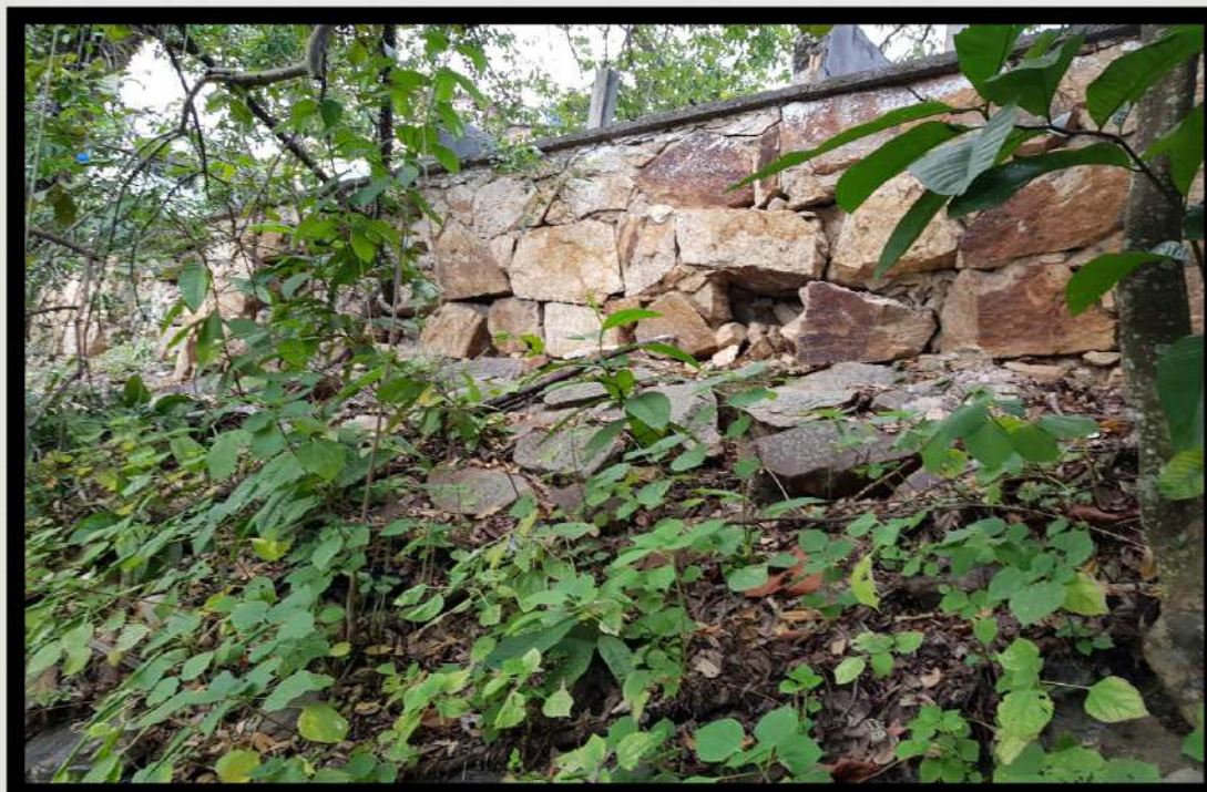
MURO DE PEDRA ARGAMASSADA ESTÁVEL. MUROS ENCOSTA DE JUSANTE ESTÁVEL SEM DESLOCAMENTOS. IMAGEM : 04 – REJUNTAR MURO 3 EXISTENTE – RESTAURAR ALVENARIA DE BLOCOS DE ROCHA.
