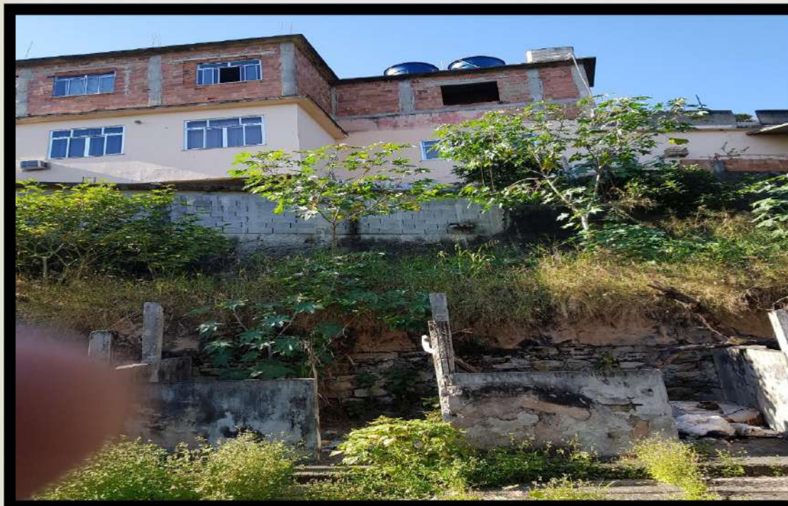
LOCAL DA DIVISA SUDOESTE – ENCOSTA COM DESLOCAMENTOS. MUROS ANTIGOS ROMPIDOS E TALUDE EM MOVIMENTO DE RASTEJO. IMAGEM : 03 – MURO M 2 NA BASE – MURO ATIRANTADO COM 2 LINHAS TIRANTES.
