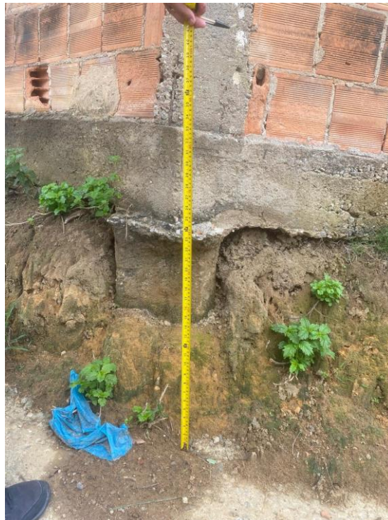
Figura 7 - Desnível aproximado de 60 cm na região crítica do muro
