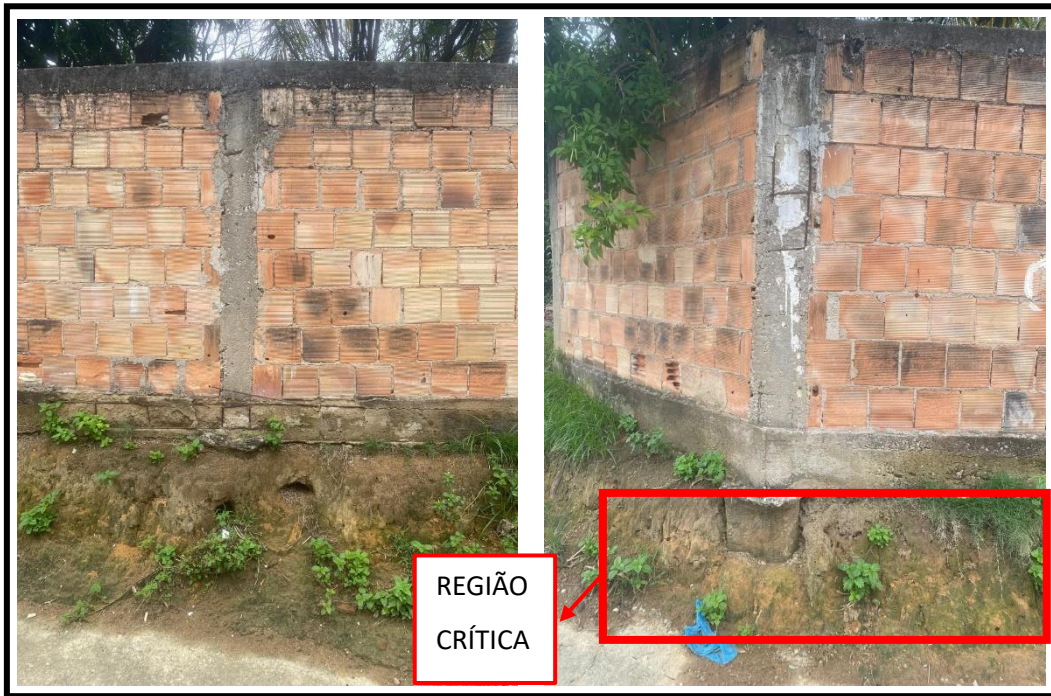
Figura 6 - Patologias no muro na região crítica
