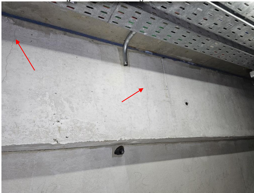
Figura 18: Fissuras em viga do 6º Pavimento
