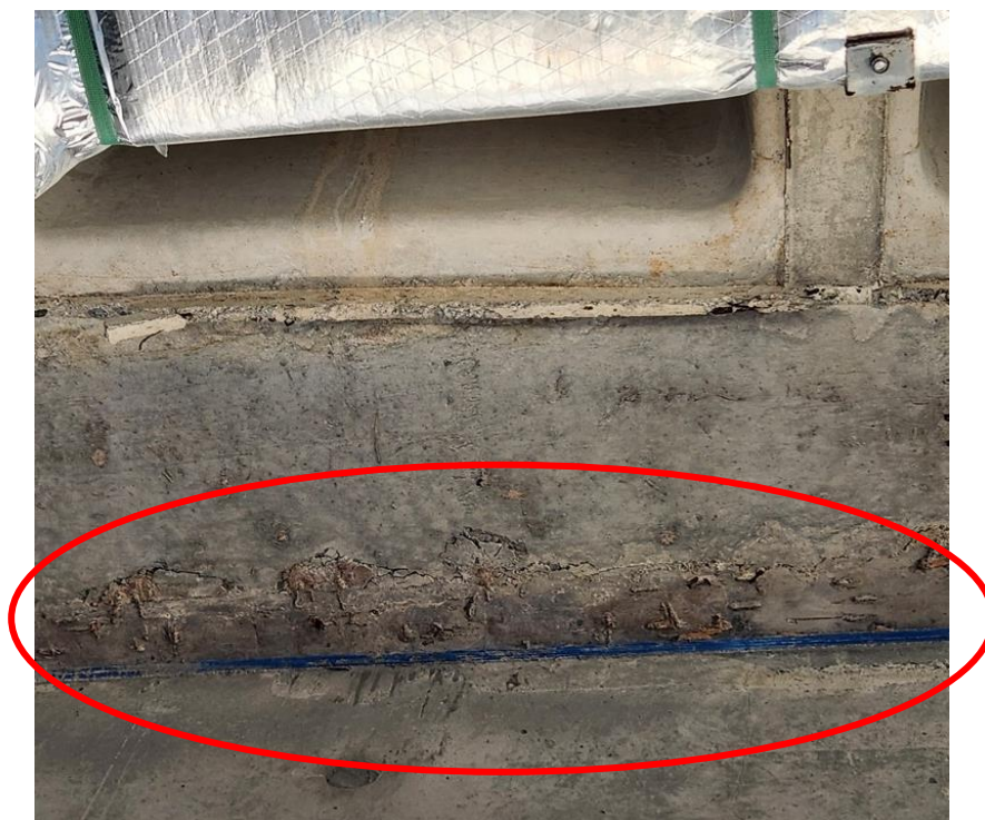
Figura 7: Trecho de concreto degradado no 3º Pavimento Inferior
