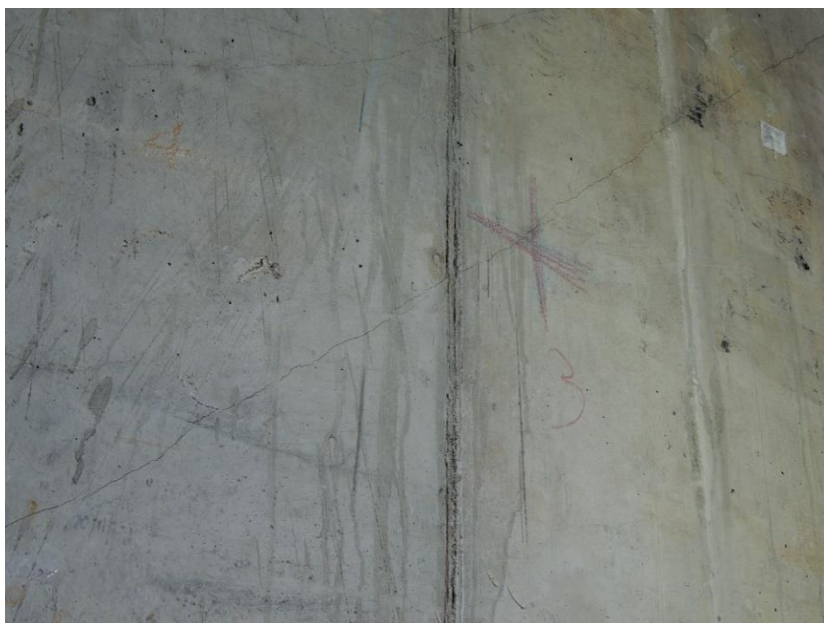
Figura 26: Fissura no reservatório do subsolo
