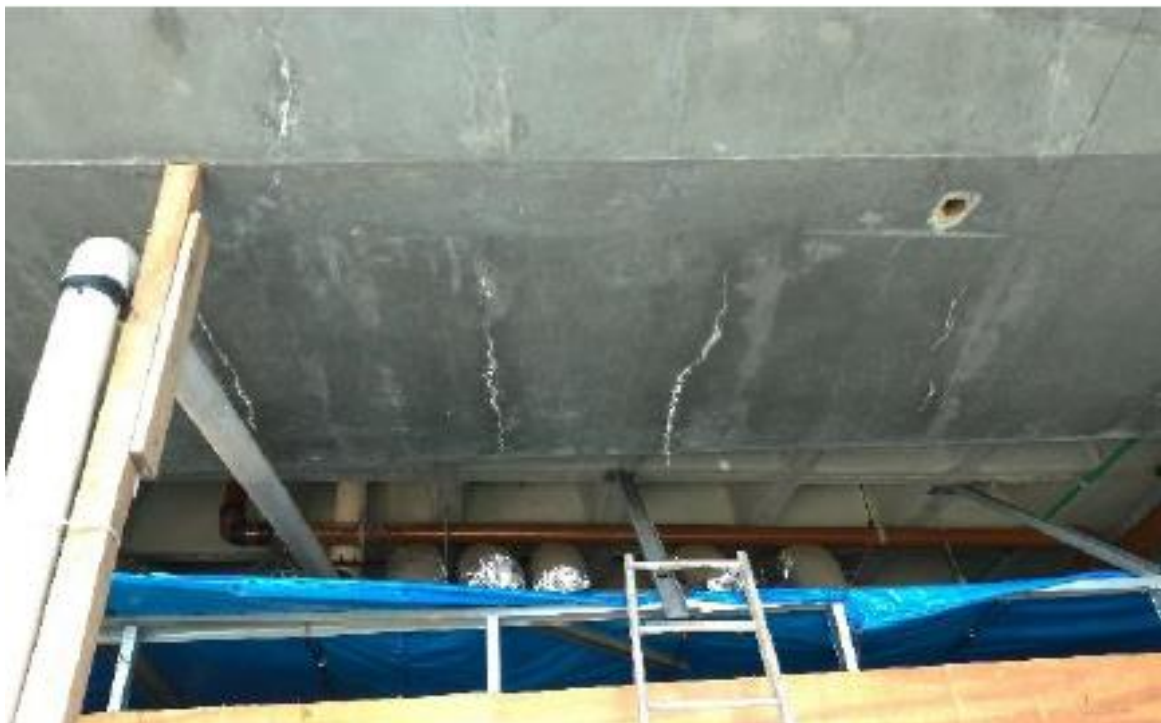
Figura 12: Identificação das fissuras em fundo de laje
