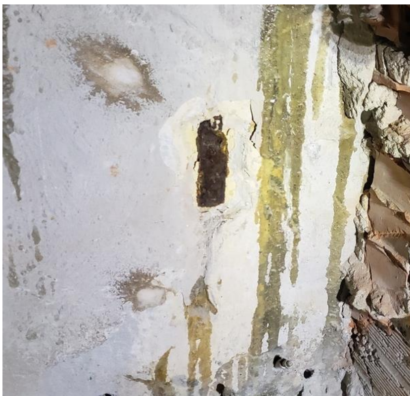
Figura 1: Armadura exposta no Térreo
