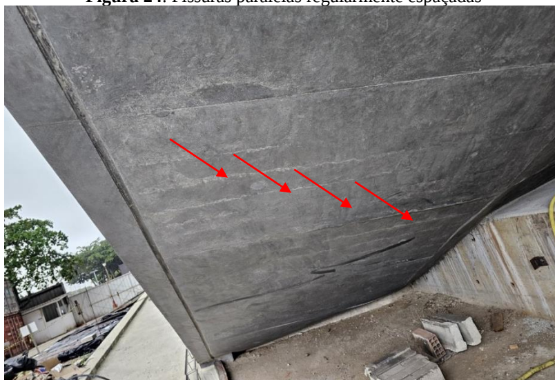
Figura 24: Fissuras paralelas regularmente espaçadas
