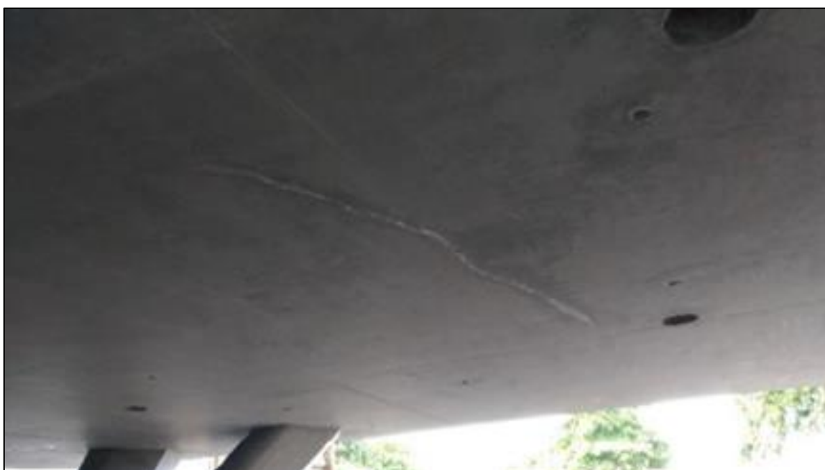
Figura 7: Fissura em fundo de laje
