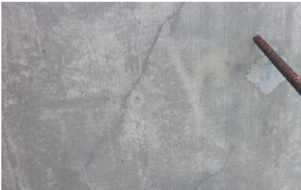
Figura 10: Identificação de fissuras diagonais em viga-parede
