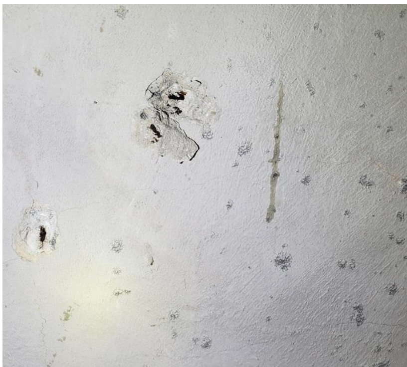
Figura 11: Deslocamento associado à corrosão no Térreo
