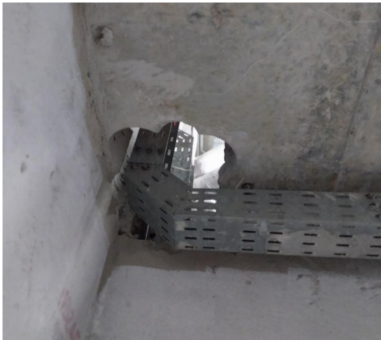
Figura 14: Furo deixando armaduras sem cobrimento no Entrepiso Técnico (nível +16,00)
