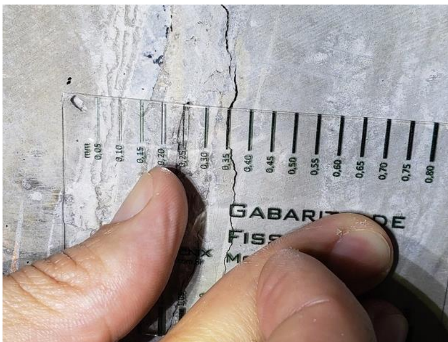
Figura 20: Fissuras no reservatório do Subsolo
