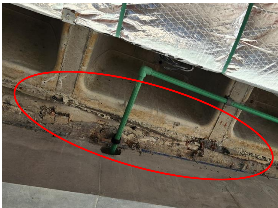
Figura 6: Trecho de concreto degradado no 3º Pavimento Inferior
