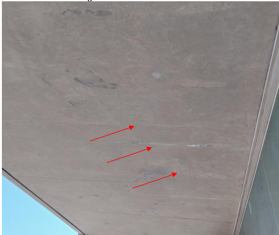
Figura 17: Fissuras no 4º Pavimento
