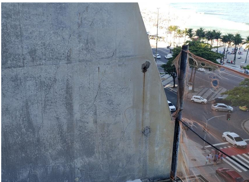
Figura 25: Fissuras indicativa de deformação excessiva
