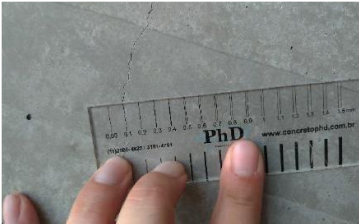
Figura 11: Identificação de fissuras com abertura de 0,1mm
