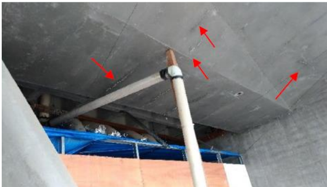
Figura 8: Fissuras e eflorescência em fundo de laje
