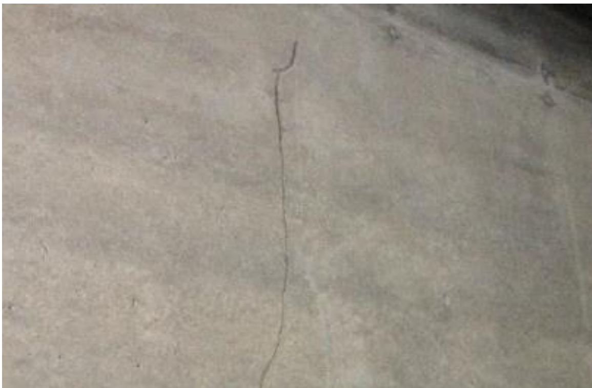
Figura 9: Identificação de fissura em viga-parede
