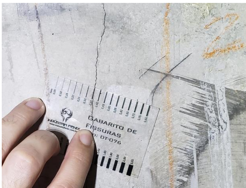
Figura 19: Fissuras no reservatório do Subsolo
