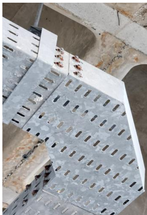
Figura 13: Demonstração da Patologia do parafuso com arruela e porca
