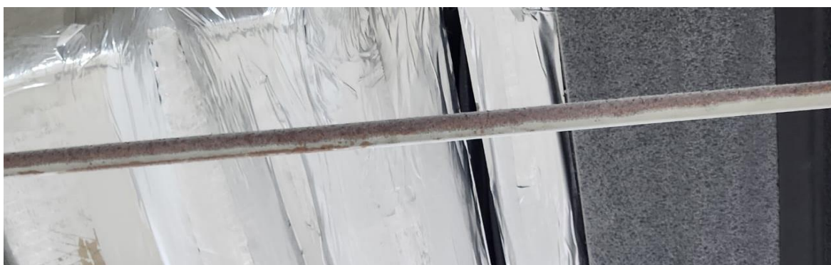
Figura 20: Demonstração da Patologia do Eletroduto galvanizado 3/4"
