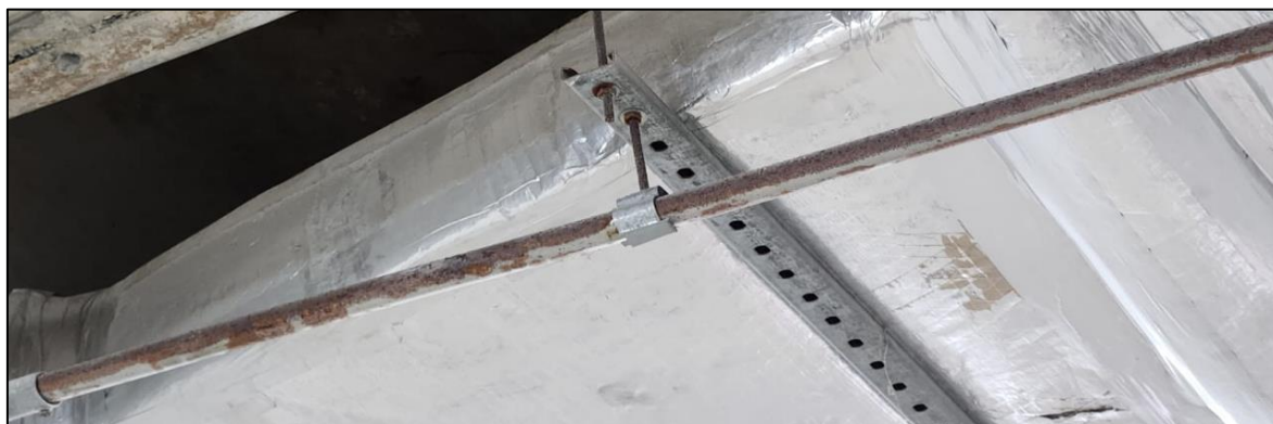
Figura 23: Demonstração da Patologia do Eletroduto galvanizado 3/4"
