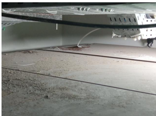
Figura 29: Demonstração da Patologia do QGBT-E – 2º Subsolo
