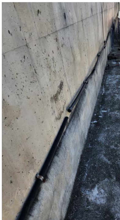
Figura 18: Demonstração da Patologia do Eletroduto PVC 3/4"
