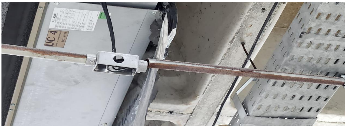
Figura 21: Demonstração da Patologia do Eletroduto galvanizado 3/4"
