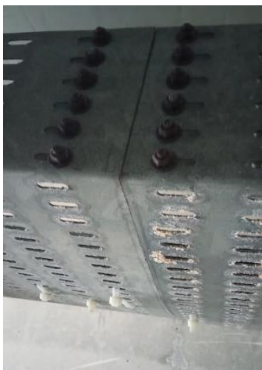
Figura 11: Demonstração da Patologia do parafuso com arruela e porca
