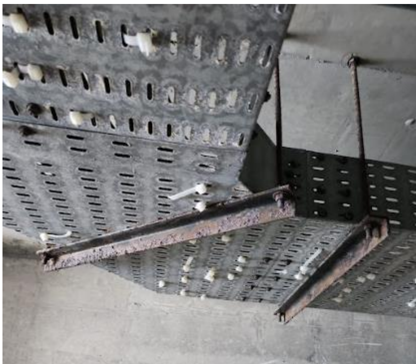
Figura 2: Demonstração da Patologia do Suporte de Eletrocalha – 6º Pavimento
