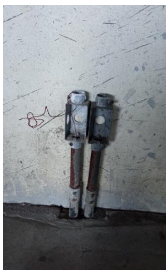
Figura 27: Demonstração da Patologia do Condutele Metálico – 2º pavimento
