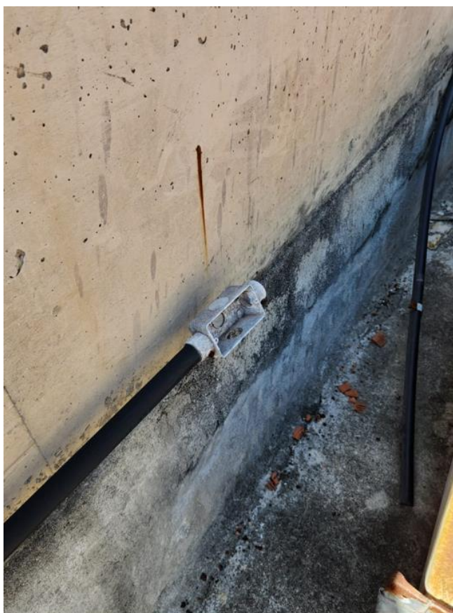
Figura 25: Demonstração da Patologia do Condulete Metálico – 7º pavimento
