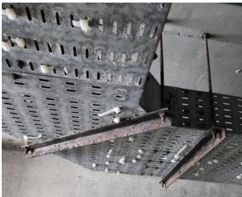
Figura 4: Demonstração da Patologia da Barra rosqueada 1/4" - 6º pavimento
