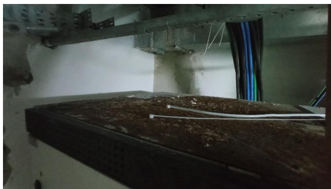
Figura 32: Demonstração da Patologia do QTA-Incêndio – 2º Subsolo.
