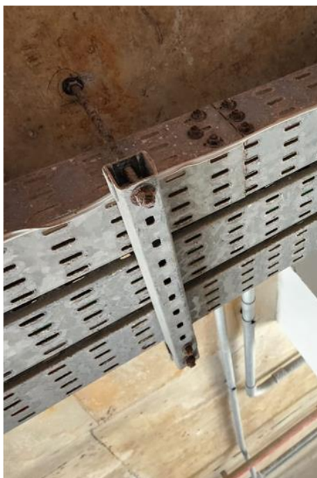
Figura 7: Demonstração da Patologia da Barra rosqueada 1/4" - 5º pavimento
