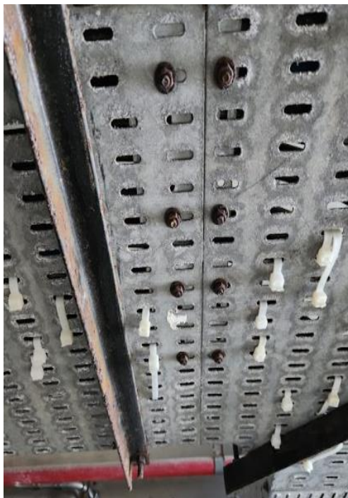
Figura 12: Demonstração da Patologia do parafuso com arruela e porca
