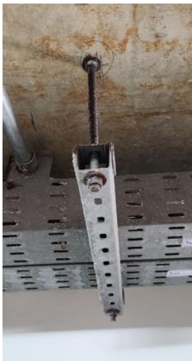
Figura 9: Demonstração da Patologia da Barra rosqueada 1/4" - 5º pavimento
