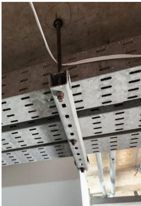
Figura 6: Demonstração da Patologia da Barra rosqueada 1/4" - 5º pavimento
