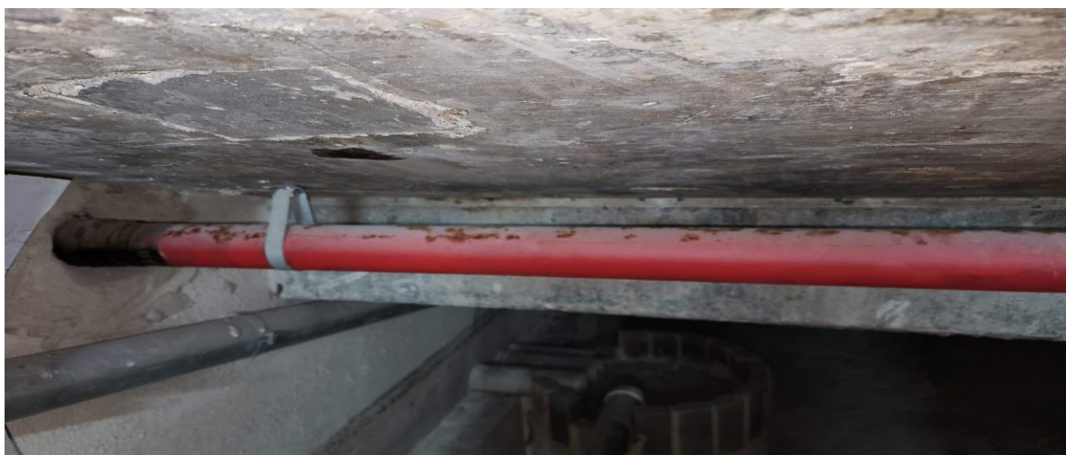
Figura 36: Demonstração da Patologia da Tubulação de aço galvanizado de 50 mm – 2º Pavimento
