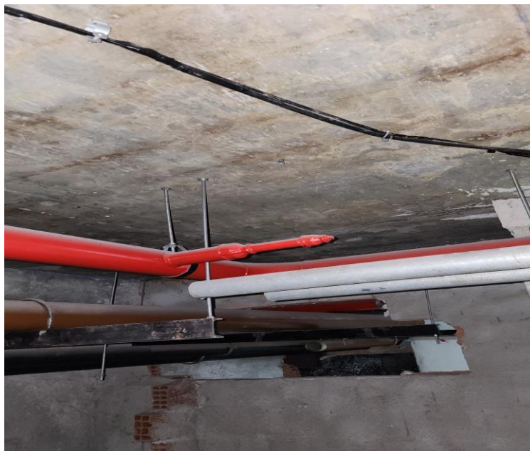
Figura 2: Demonstração da Patologia da Tubulação de aço galvanizado de 25 mm – 2º Subsolo
