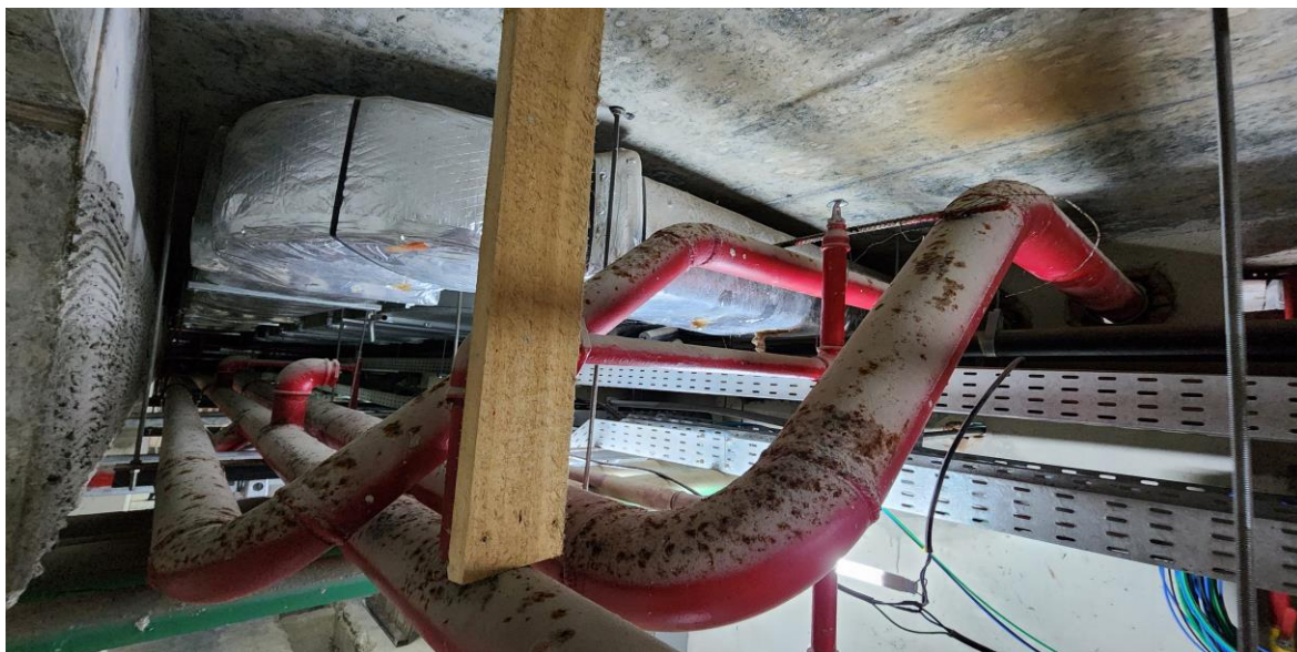
Figura 60: Demonstração da Patologia da Tubulação de aço galvanizado de 100 mm – 2º Subsolo
