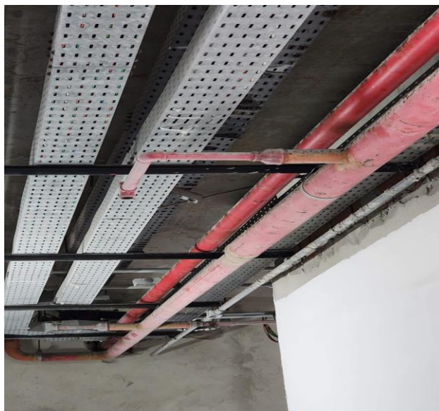
Figura 47: Demonstração da Patologia da Tubulação de aço galvanizado de 65 mm – 1º Subsolo
