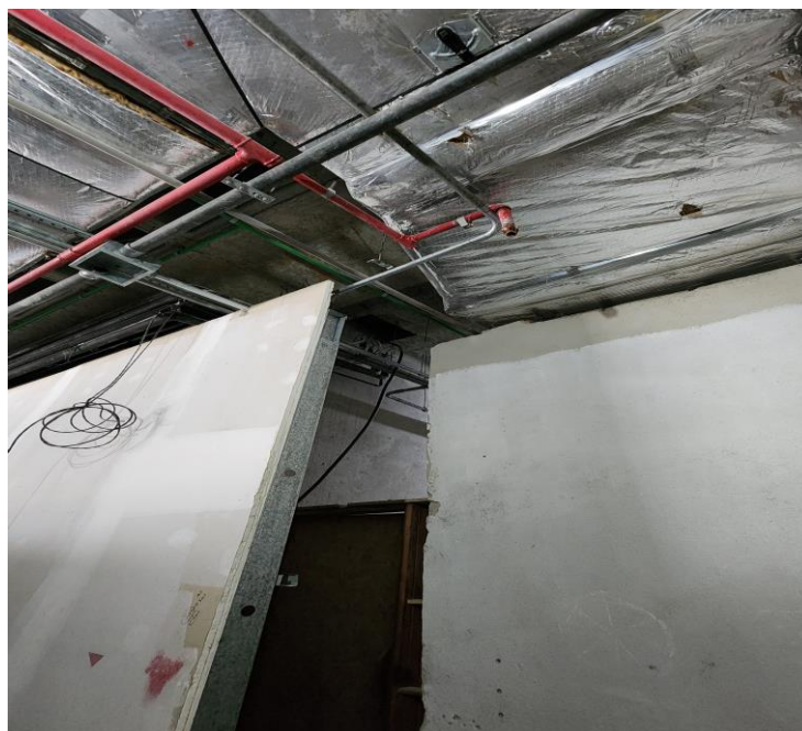
Figura 3: Demonstração da Patologia da Tubulação de aço galvanizado de 25 mm – 2º Pavimento
