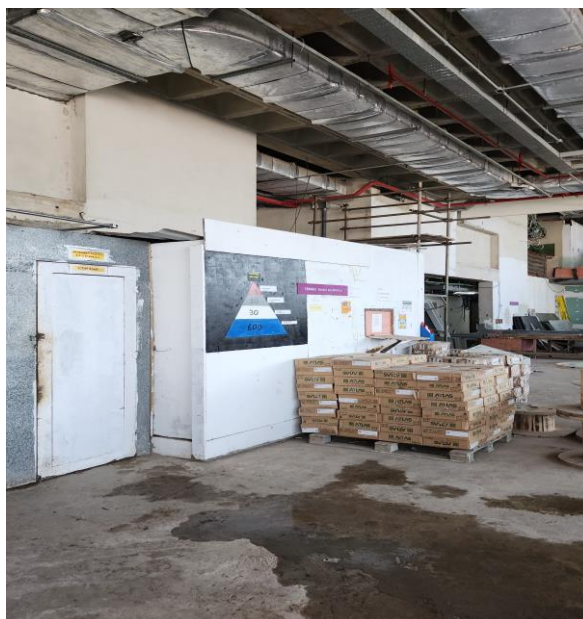
Figura 38: Demonstração da Patologia da Tubulação de aço galvanizado de 50 mm – Térreo
