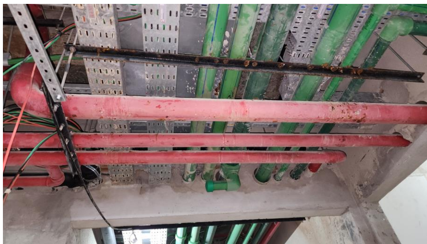
Figura 48: Demonstração da Patologia da Tubulação de aço galvanizado de 65 mm – 1º Pavimento
