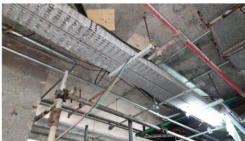
Figura 37: Demonstração da Patologia da Tubulação de aço galvanizado de 50 mm – 4º Pavimento
