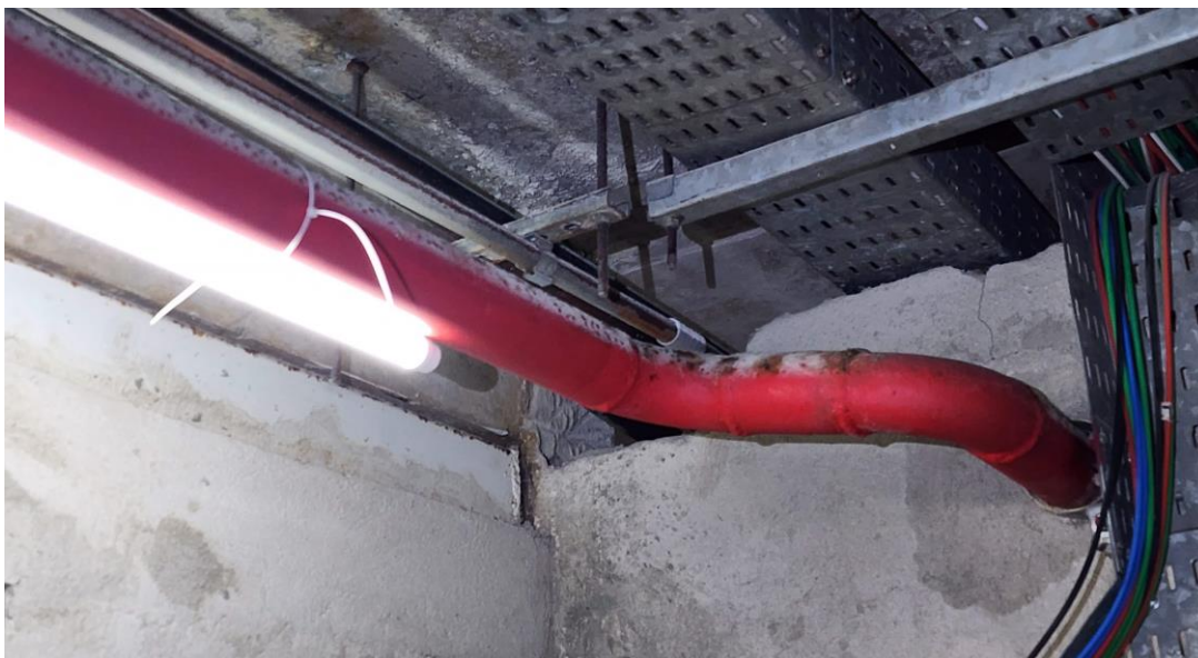
Figura 62: Demonstração da Patologia da Tubulação de aço galvanizado de 100 mm – 2º Pavimento
