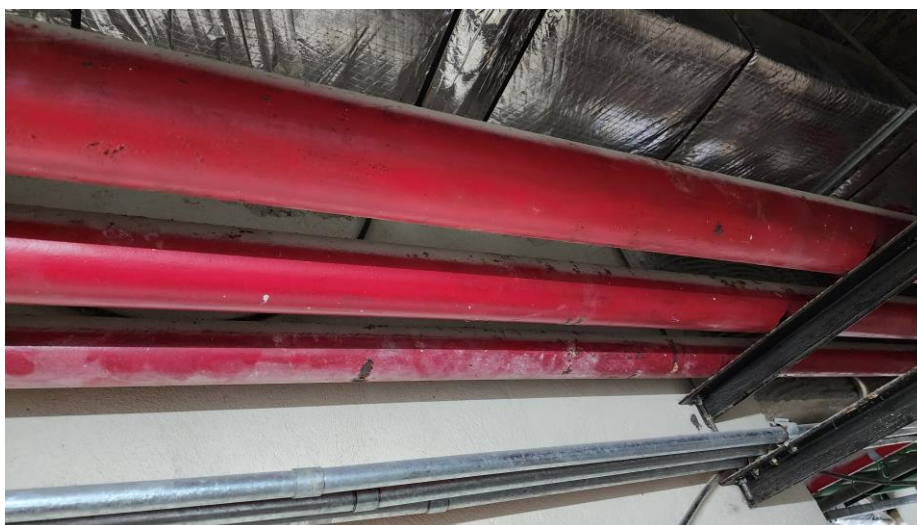
Figura 49: Demonstração da Patologia da Tubulação de aço galvanizado de 65 mm – 2º Pavimento
