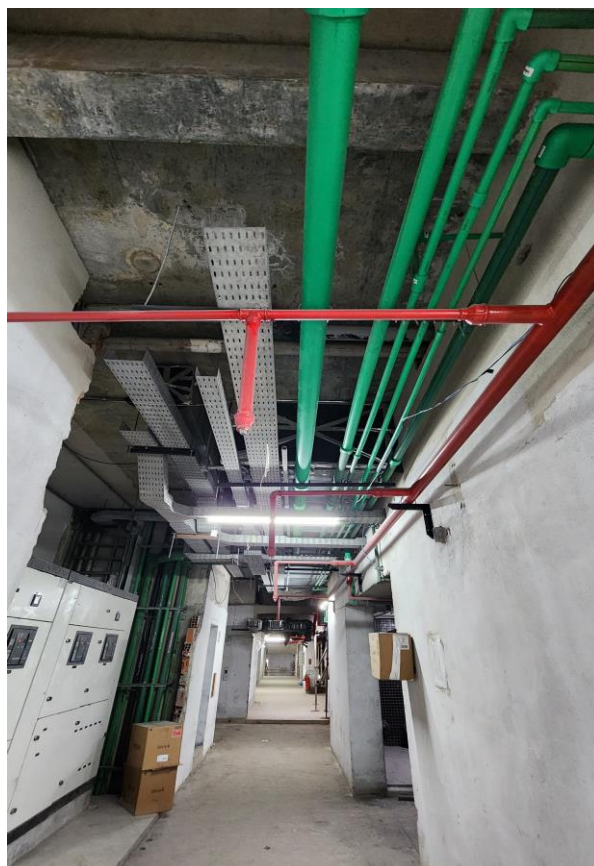
Figura 16: Demonstração da Patologia da Tubulação de aço galvanizado de 32 mm – 2º Subsolo
