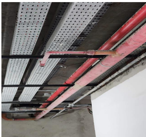
Figura 57: Demonstração da Patologia da Tubulação de aço galvanizado de 80 mm – 2º Subsolo
