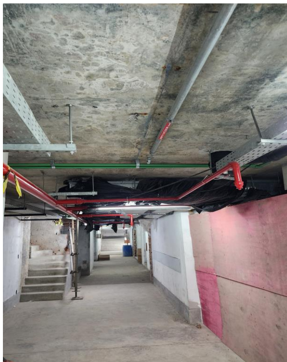
Figura 26: Demonstração da Patologia da Tubulação de aço galvanizado de 40 mm – 6º Pavimento
