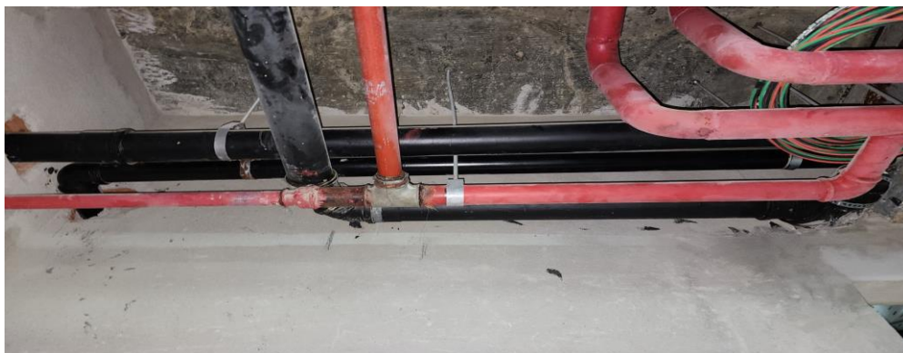
Figura 25: Demonstração da Patologia da Tubulação de aço galvanizado de 40 mm – 2º Pavimento
