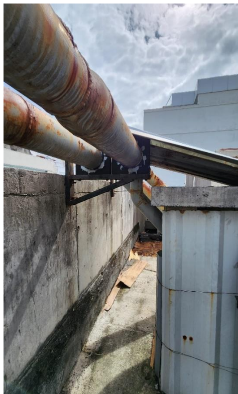
Figura 53: Demonstração da Patologia da Redução de 6" x 5" – 7º Pavimento
