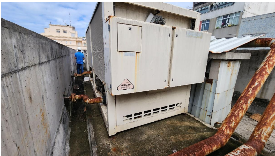
Figura 28: Demonstração da Patologia da Curva 45° de 6" – 7º Pavimento
