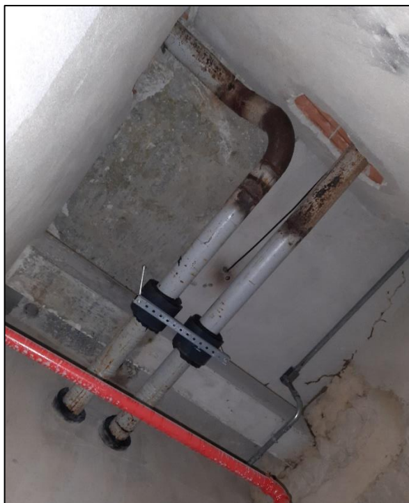
Figura 17: Demonstração da Patologia da Tubulação de água gelada – 4” – Mezanino 1º Subsolo
