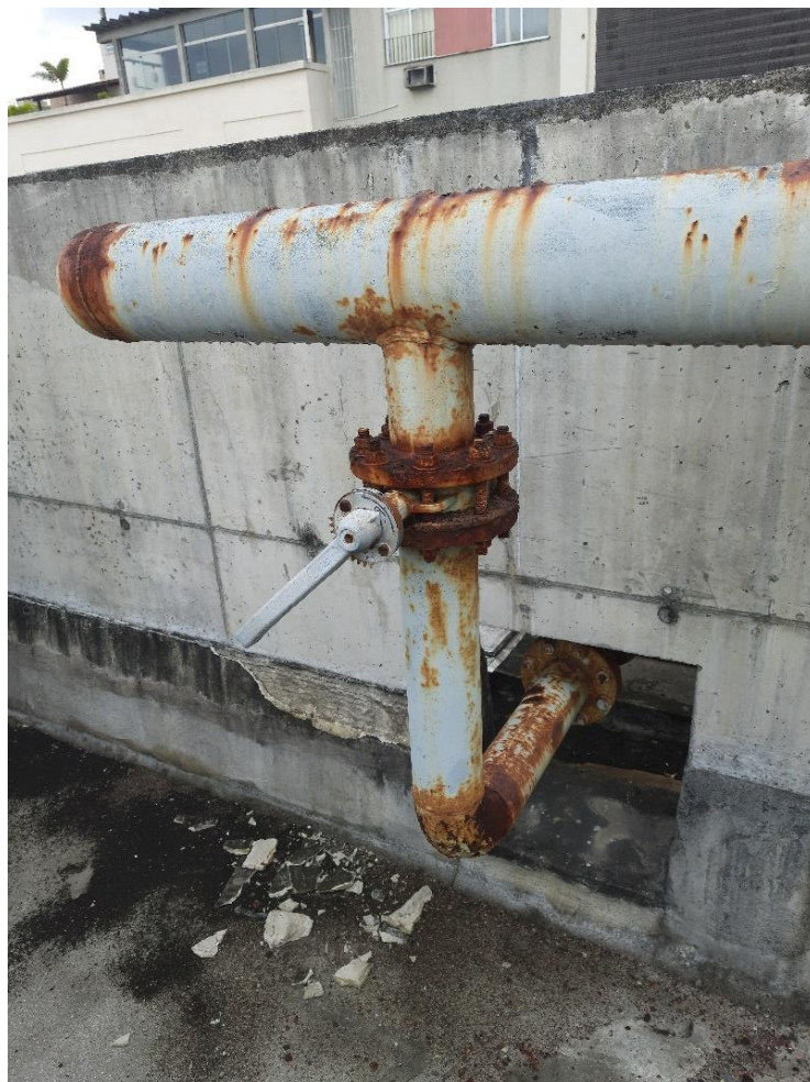
Figura 50: Demonstração da Patologia do CAP de 6” – 7º Pavimento
