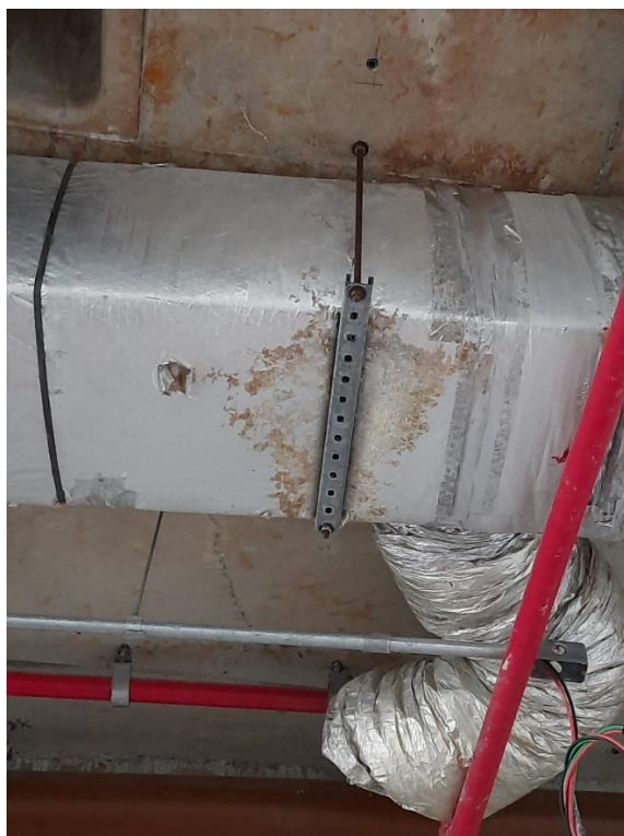
Figura 95: Demonstração da Patologia do Isolamento térmico – 5º Pavimento
