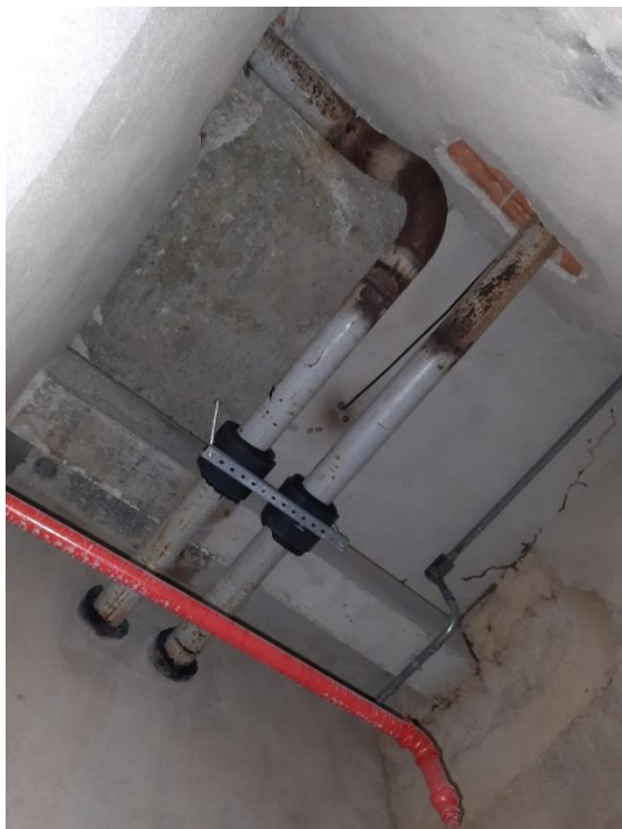
Figura 37: Demonstração da Patologia da Curva 90° de 4" – Mezanino do 1º Subsolo
