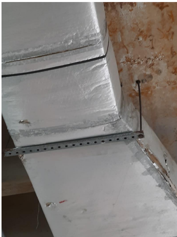
Figura 81: Demonstração da Patologia da Barra roscada de 3/8"
