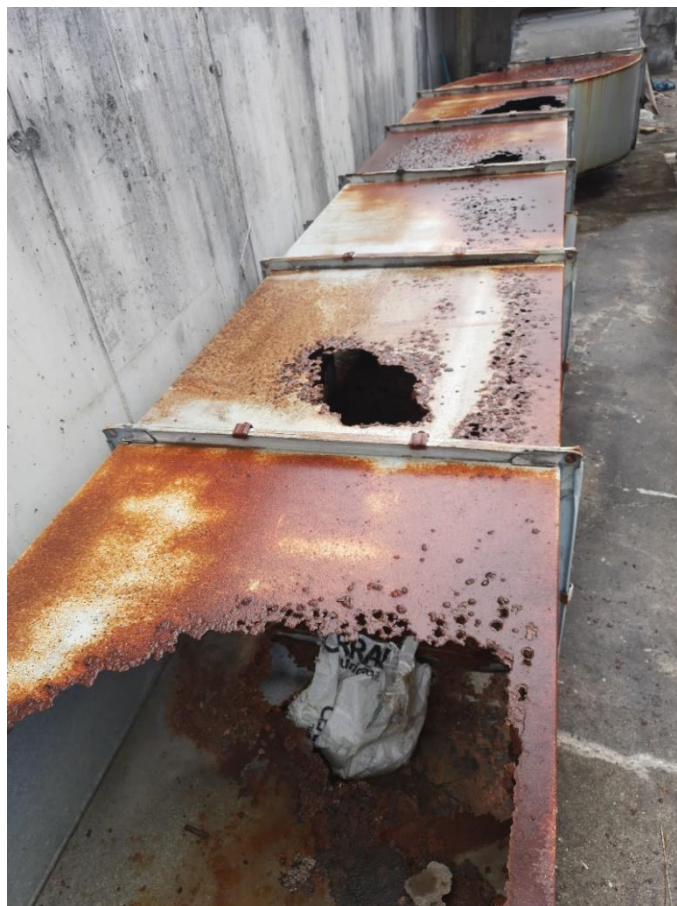
Figura 62: Demonstração da Patologia do Duto chapa galvanizada #22 – 7º Pavimento
