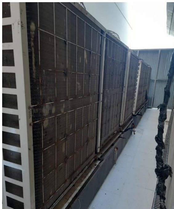
Figura 100: Demonstração da Patologia da Condensadora VRF 43TR
