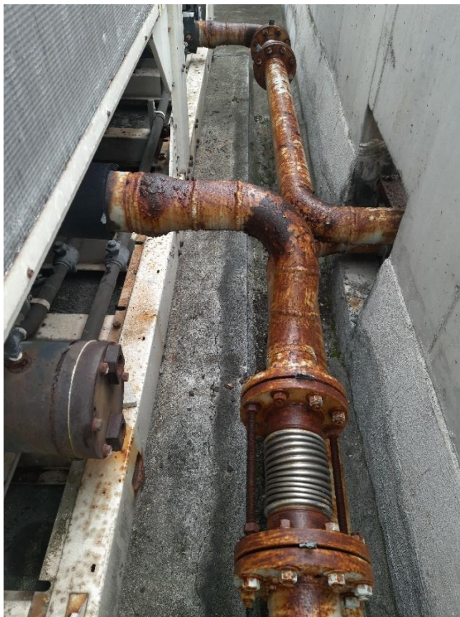
Figura 32: Demonstração da Patologia da Curva 90° de 4" – 7° Pavimento
