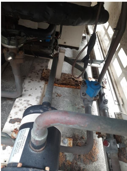
Figura 109: Demonstração da Patologia do Chiller HITACHI – 110 TR
