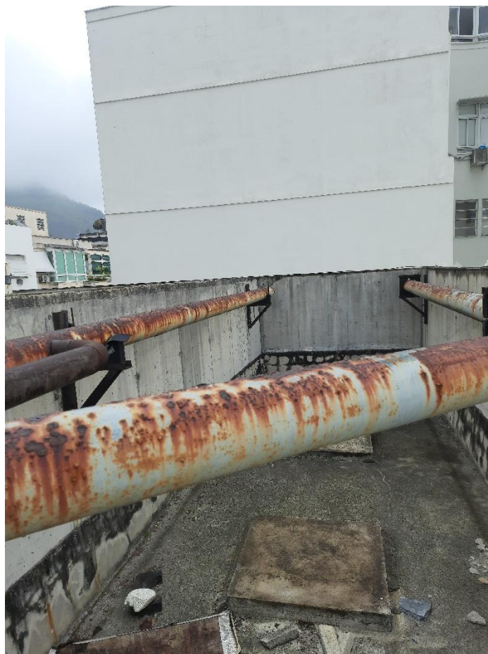
Figura 3: Demonstração da Patologia da Tubulação de água gelada – 6” – 7º Pavimento
