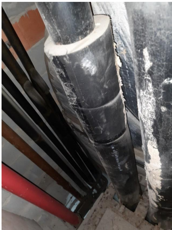
Figura 14: Demonstração da Patologia da Tubulação de água gelada – 4” – Shaft
