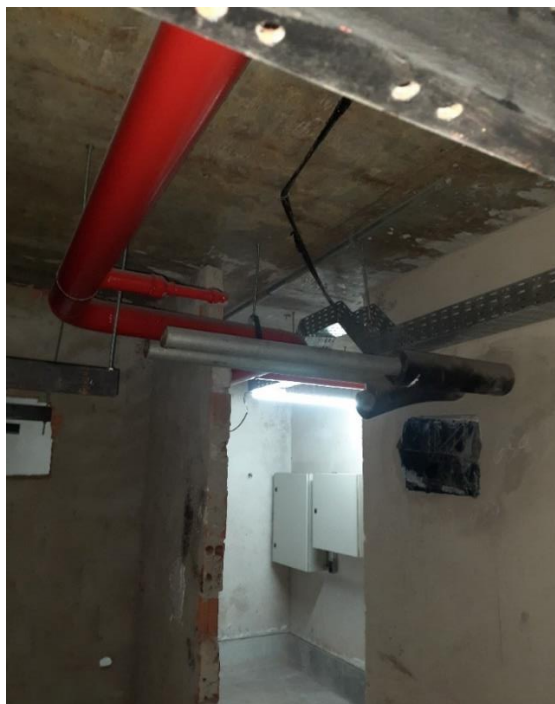
Figura 23: Demonstração da Patologia da Tubulação de água gelada – 2” – Mezanino 1º Subsolo
