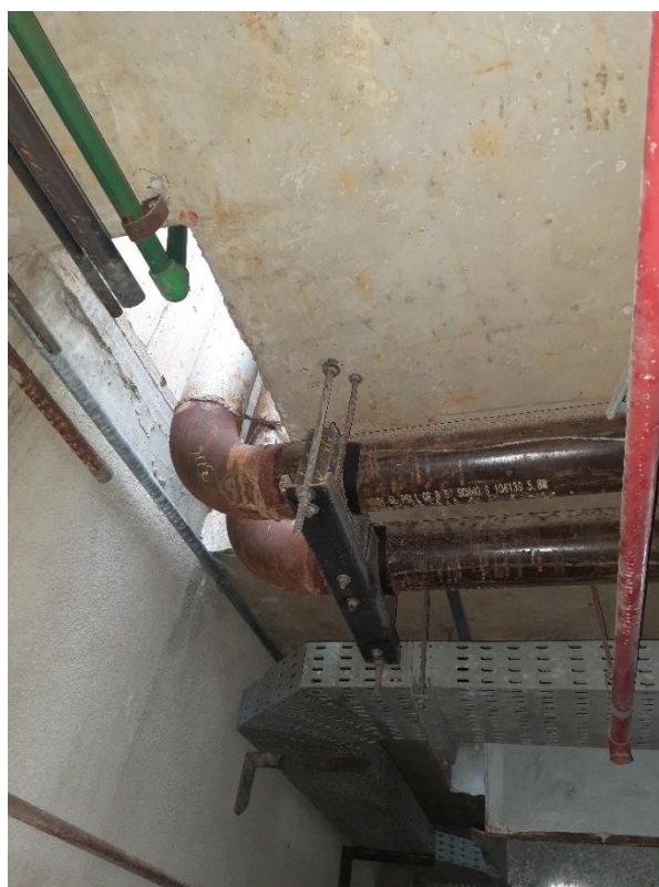
Figura 54: Demonstração da Patologia da Redução de 5" x 4" – 7º Pavimento
