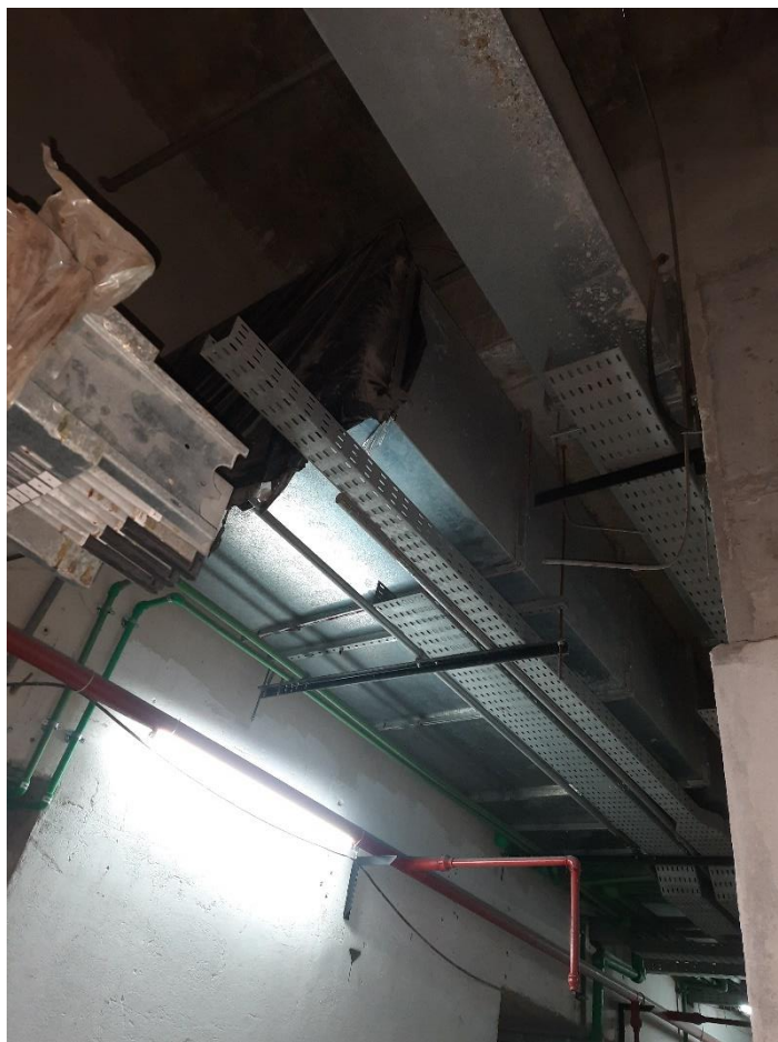
Figura 67: Demonstração da Patologia do Duto chapa galvanizada #22 – Mezanino do 1º Subsolo (pressurização da escada de incêndio)
