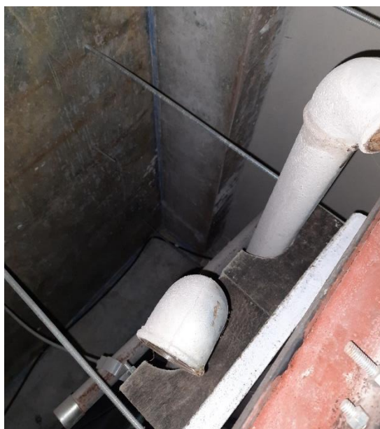
Figura 44: Demonstração da Patologia da Curva 90° de 2" – Mezanino do 1º Subsolo
