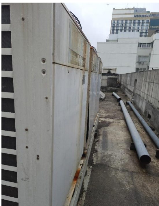
Figura 98: Demonstração da Patologia da Condensadora VRF 43TR - 7º Pavimento
