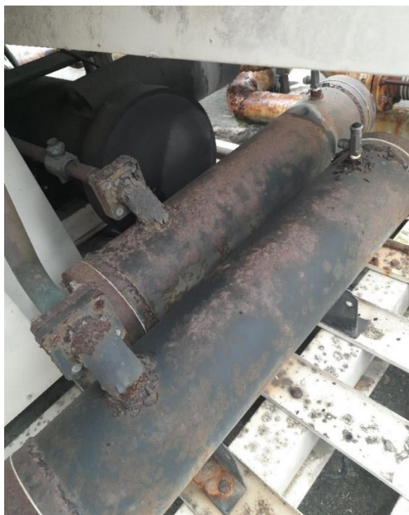
Figura 106: Demonstração da Patologia do Chiller HITACHI – 110 TR
