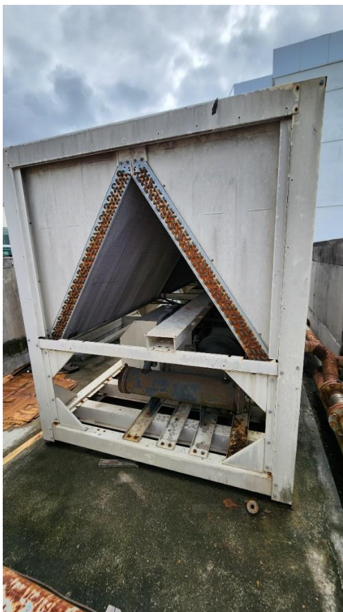
Figura 105: Demonstração da Patologia do Chiller HITACHI – 110 TR
