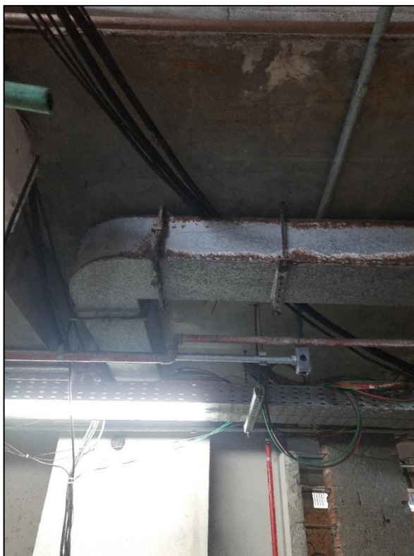
Figura 73: Demonstração da Patologia do Duto chapa galvanizada #26 – Térreo
