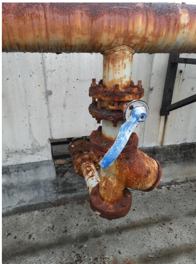
Figura 58: Demonstração da Patologia do Filtro tipo Y de 4" – 7º Pavimento
