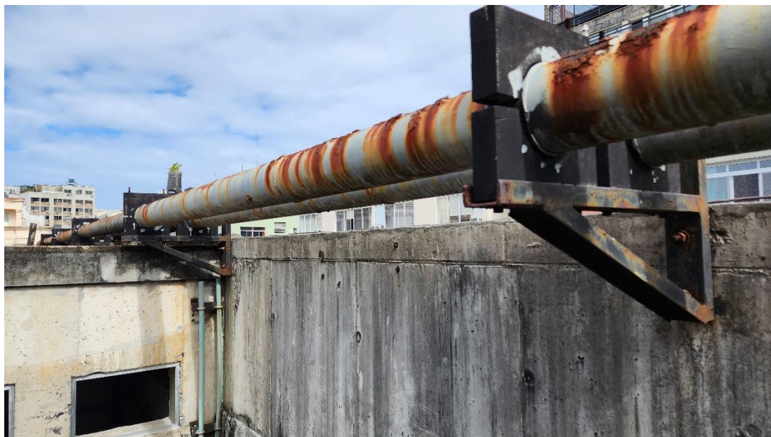
Figura 5: Demonstração da Patologia da Tubulação de água gelada – 5” – 7º Pavimento
