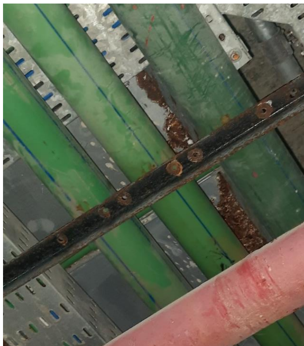
Figura 71: Demonstração da Patologia do Duto chapa galvanizada #24 – 2º Subsolo
