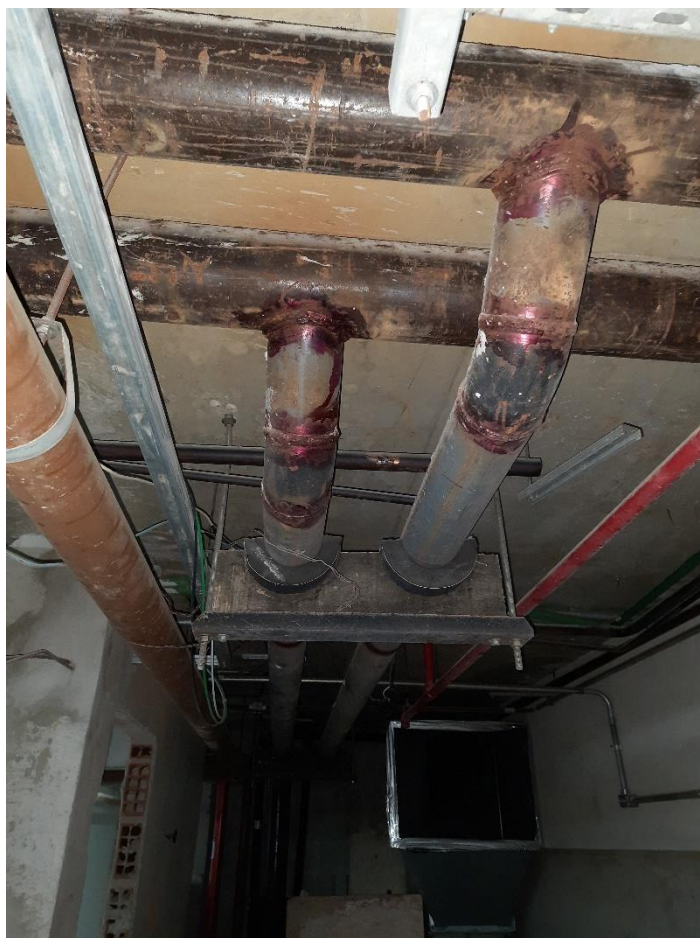
Figura 39: Demonstração da Patologia da Curva 45° de 4" – 6° Pavimento
