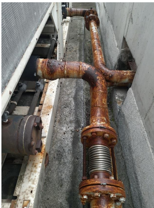
Figura 8: Demonstração da Patologia da Tubulação de água gelada – 4” – 7º Pavimento
