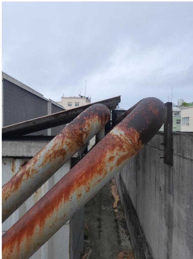
Figura 25: Demonstração da Patologia da Curva 90° de 6” – 7º Pavimento
