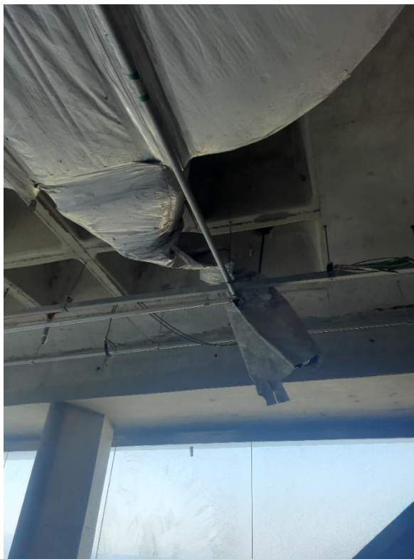
Figura 84: Demonstração da Patologia do Duto flexível de Ø 350 mm
