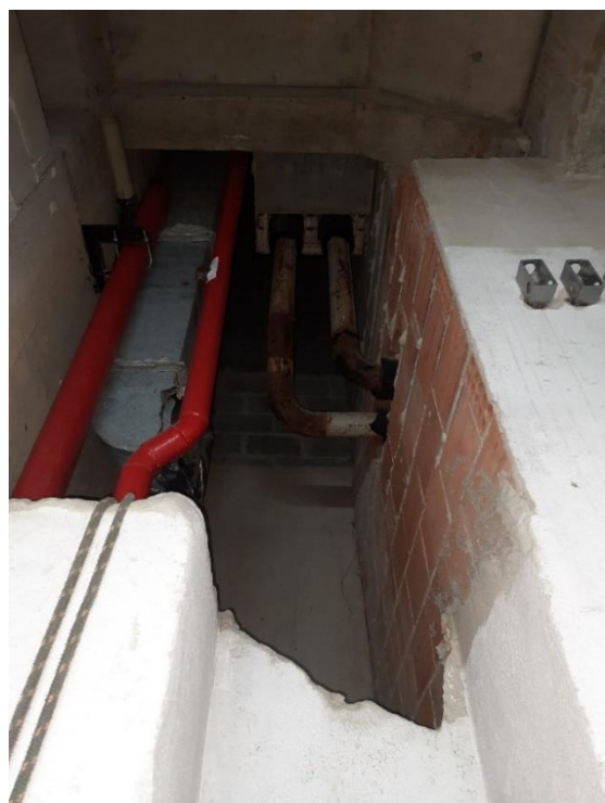
Figura 15: Demonstração da Patologia da Tubulação de água gelada – 4” – Shaft
