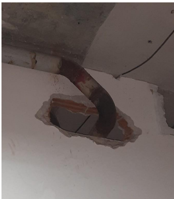
Figura 42: Demonstração da Patologia da Curva 45° de 4" – Mezanino do 1º Subsolo
