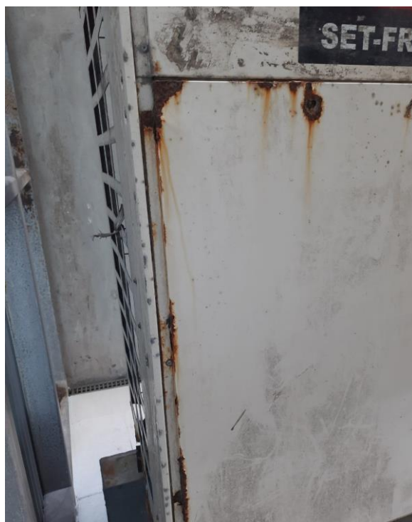
Figura 101: Demonstração da Patologia da Condensadora VRF
