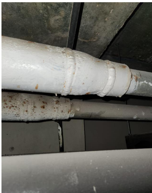
Figura 55: Demonstração da Patologia da Redução de 3" x 2" – 7º Pavimento
