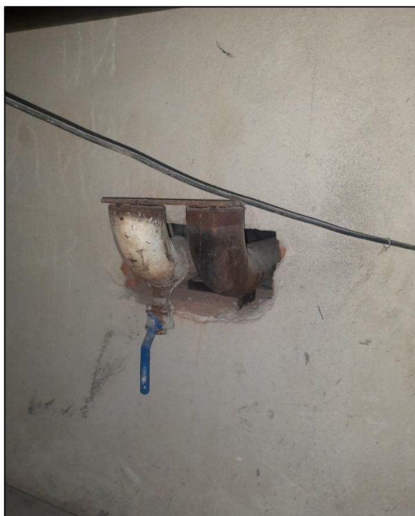
Figura 18: Demonstração da Patologia da Tubulação de água gelada – 4” – Mezanino 1º Subsolo
