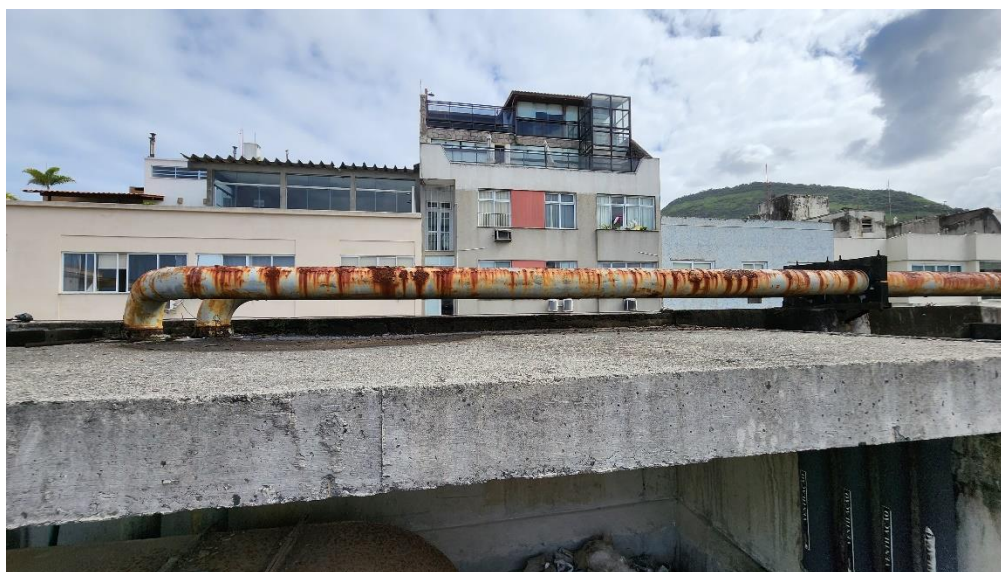
Figura 6: Demonstração da Patologia da Tubulação de água gelada – 5” – 7º Pavimento
