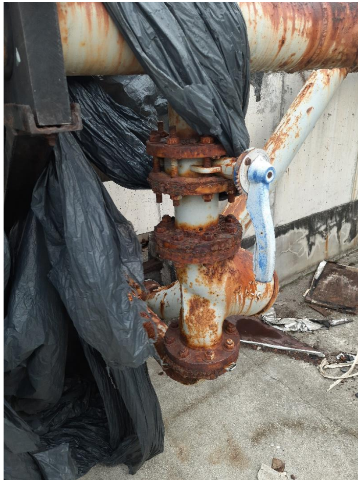
Figura 59: Demonstração da Patologia do Filtro tipo Y de 4” – 7º Pavimento
