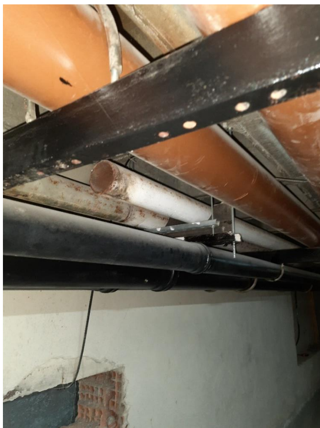
Figura 20: Demonstração da Patologia da Tubulação de água gelada – 3” – Mezanino 1º Subsolo
