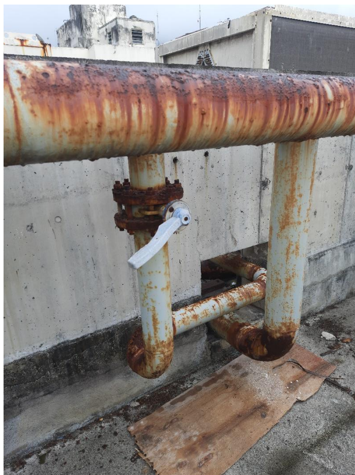
Figura 57: Demonstração da Patologia da Válvula borboleta de 4” – 7º Pavimento
