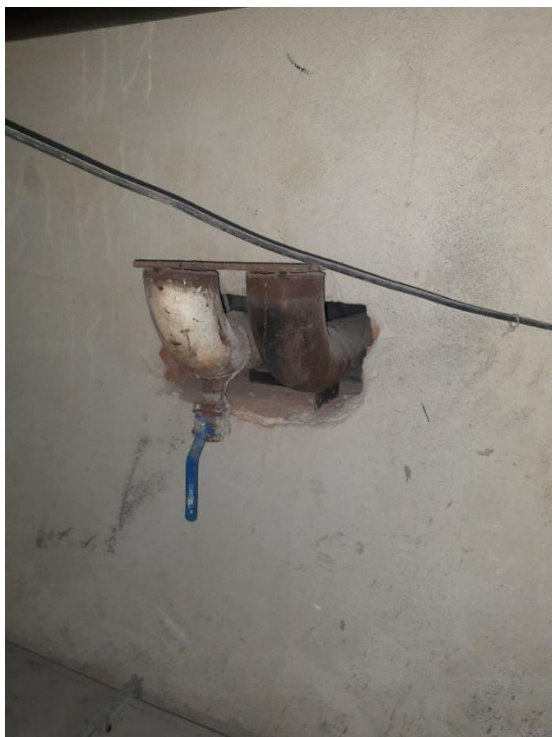
Figura 38: Demonstração da Patologia da Curva 90° de 4" – Mezanino do 1º Subsolo
