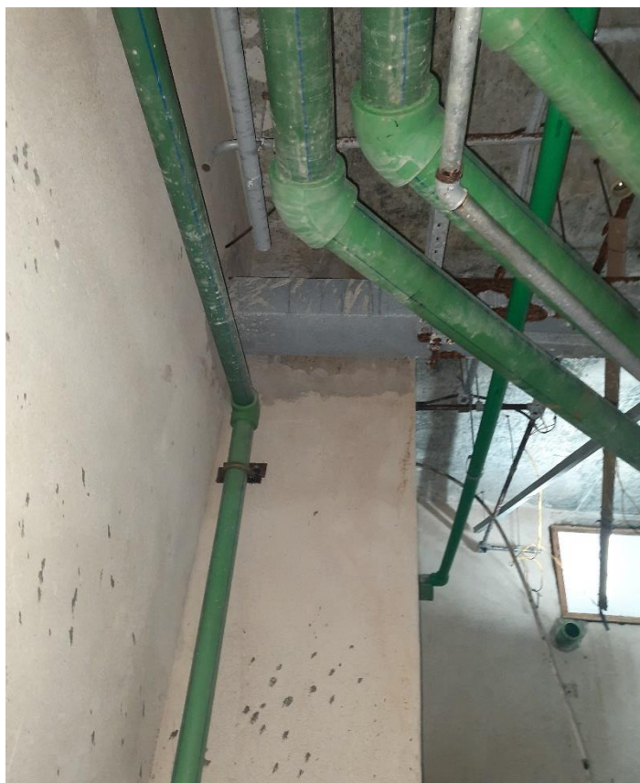
Figura 77: Demonstração da Patologia do Duto chapa galvanizada #26 – 2º Subsolo
