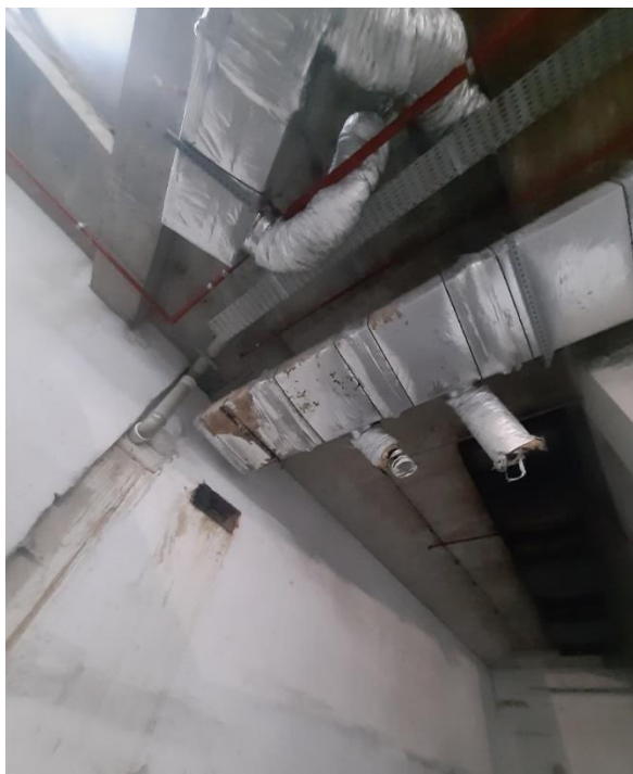
Figura 96: Demonstração da Patologia do Isolamento térmico – Mezanino do 1º Subsolo
