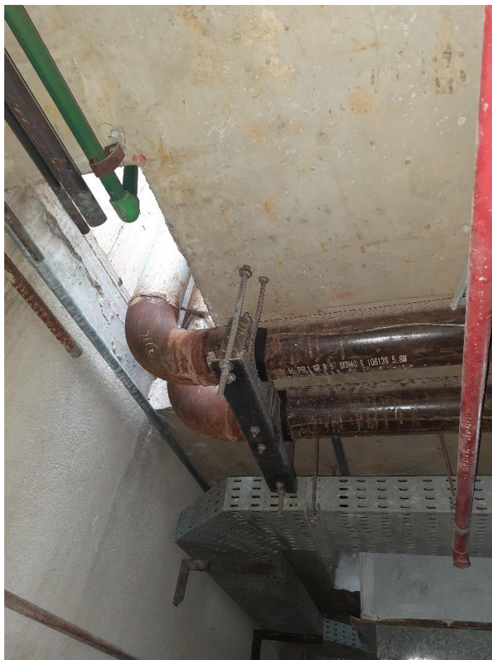
Figura 12: Demonstração da Patologia da Tubulação de água gelada – 4” – 6º pavimento
