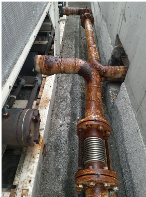
Figura 47: Demonstração da Patologia da Junta de expansão de 4" – 7º Pavimento
