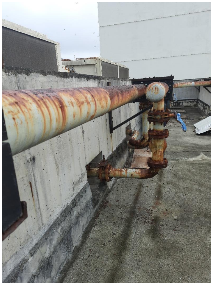
Figura 51: Demonstração da Patologia do CAP de 6" – 7º Pavimento
