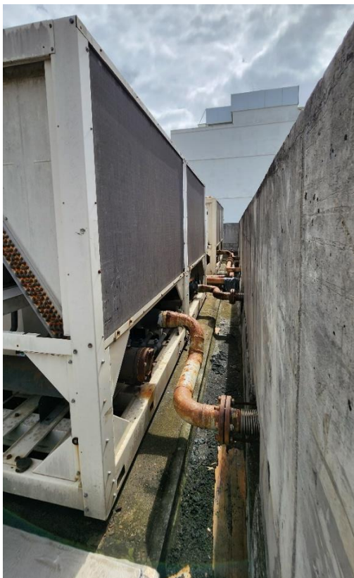
Figura 108: Demonstração da Patologia do Chiller HITACHI – 110 TR
