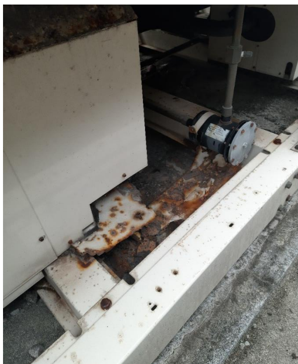
Figura 107: Demonstração da Patologia do Chiller HITACHI – 110 TR
