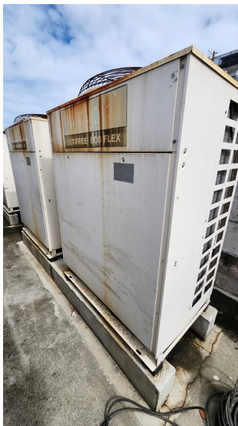
Figura 103: Demonstração da Patologia da Condensadora VRF 28,5TR
