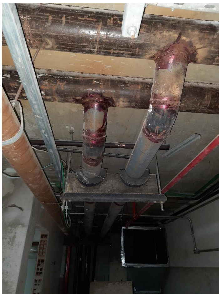
Figura 11: Demonstração da Patologia da Tubulação de água gelada – 4” – 6º pavimento
