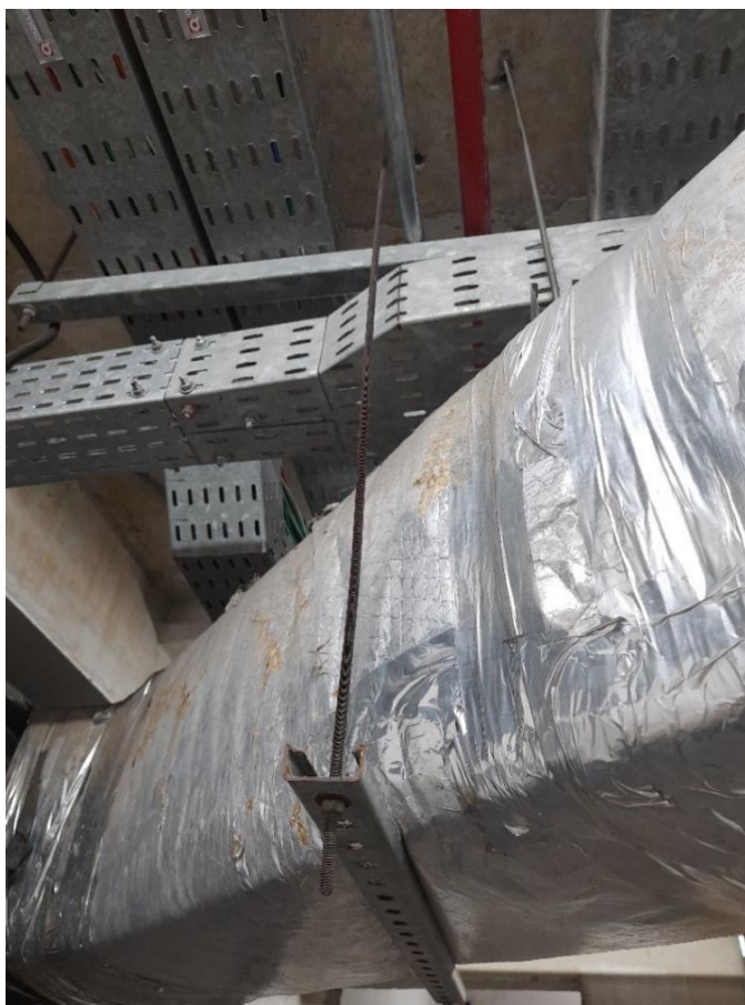
Figura 82: Demonstração da Patologia da Barra roscada de 3/8”
