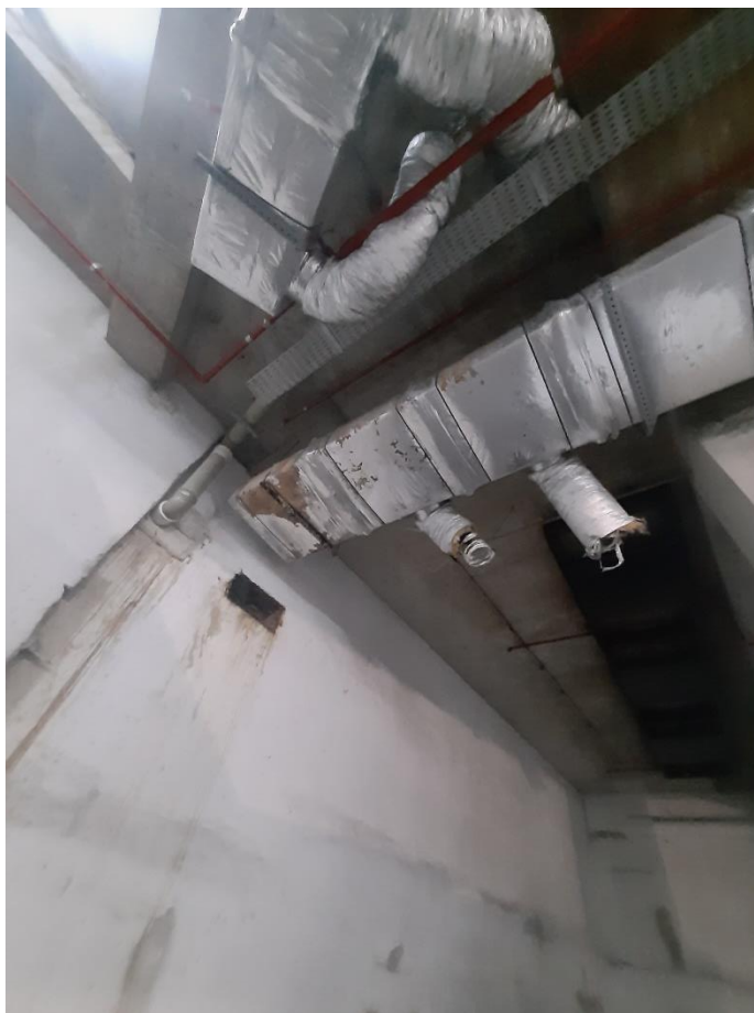
Figura 92: Demonstração da Patologia do Duto flexível de Ø 250 mm – Mezanino do 1º Subsolo
