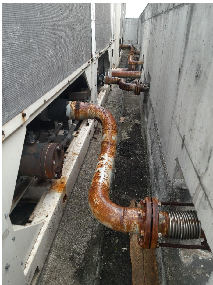
Figura 49: Demonstração da Patologia da Junta de expansão de 4" – 7º Pavimento
