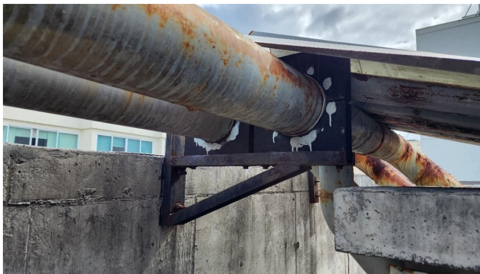
Figura 61: Demonstração da Patologia do Suporte tipo mão francesa – 7º Pavimento
