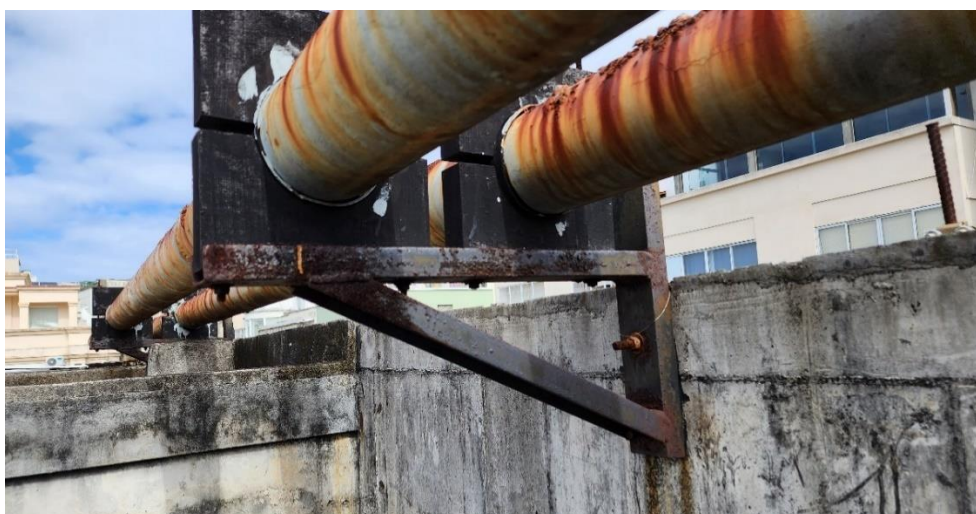
Figura 60: Demonstração da Patologia do Suporte tipo mão francesa – 7º Pavimento
