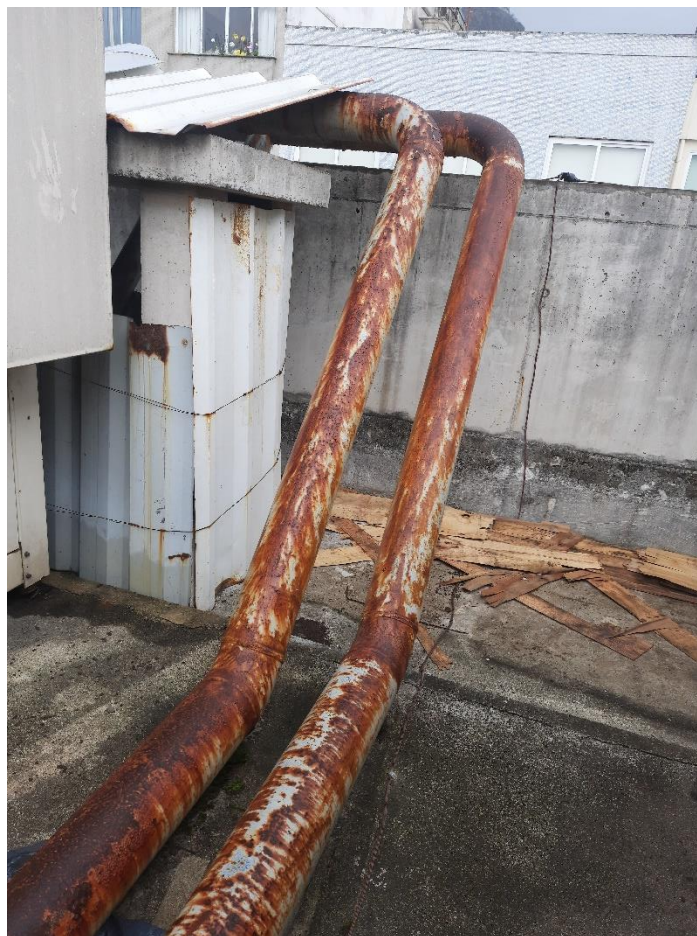
Figura 2: Demonstração da Patologia da Tubulação de água gelada – 6” – 7º Pavimento
