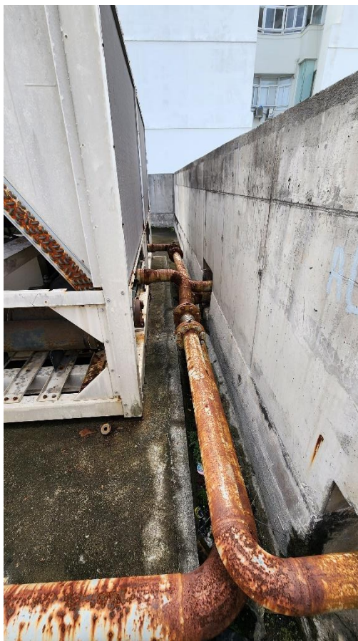
Figura 26: Demonstração da Patologia da Curva 90° de 6'' – 7º Pavimento
