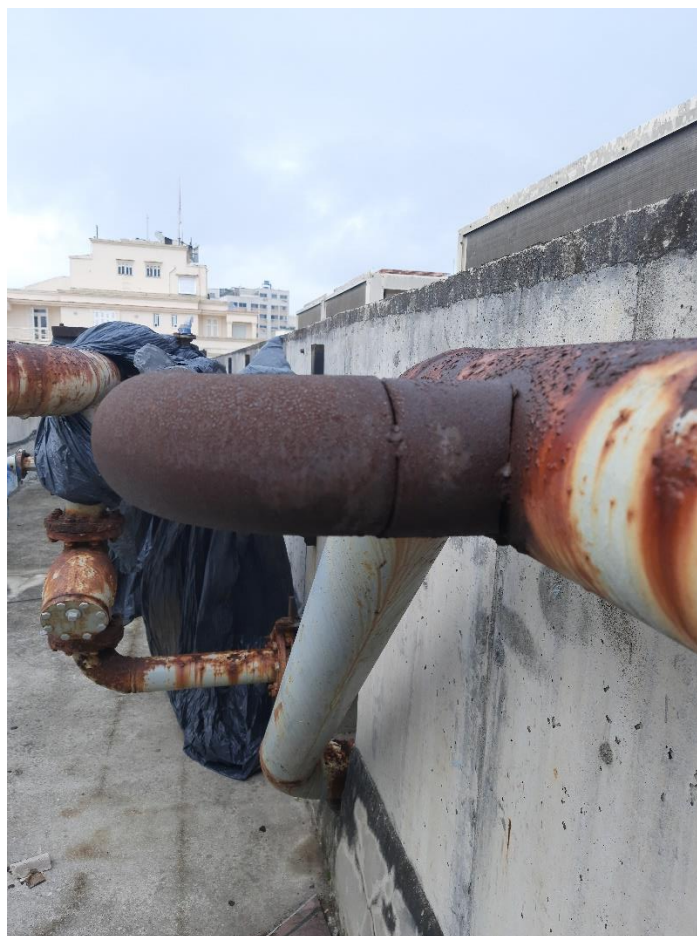
Figura 30: Demonstração da Patologia da Curva 90° de 4" – 7° Pavimento
