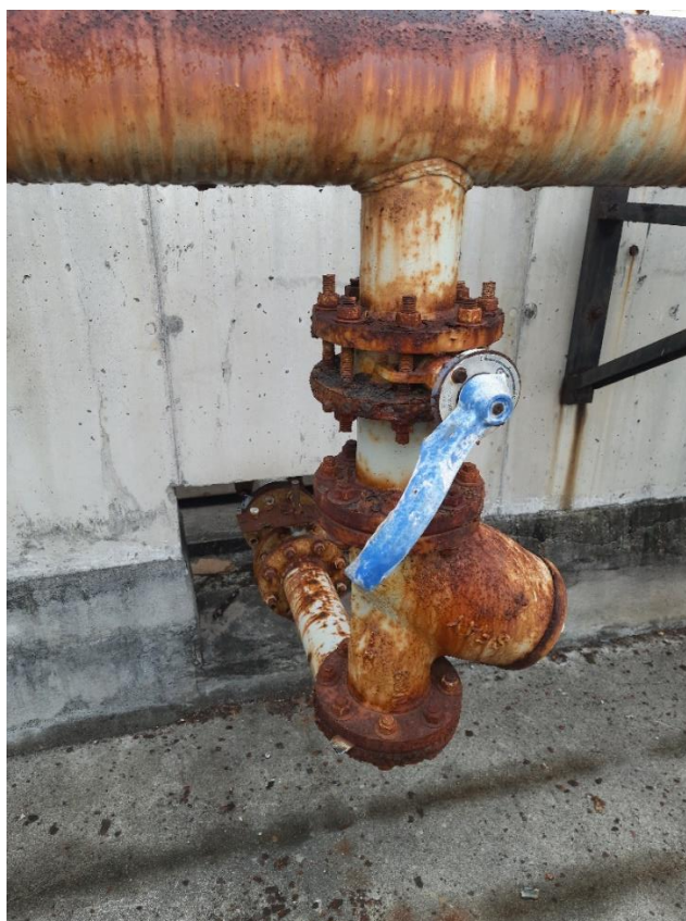
Figura 56: Demonstração da Patologia da Válvula borboleta de 4” – 7º Pavimento
