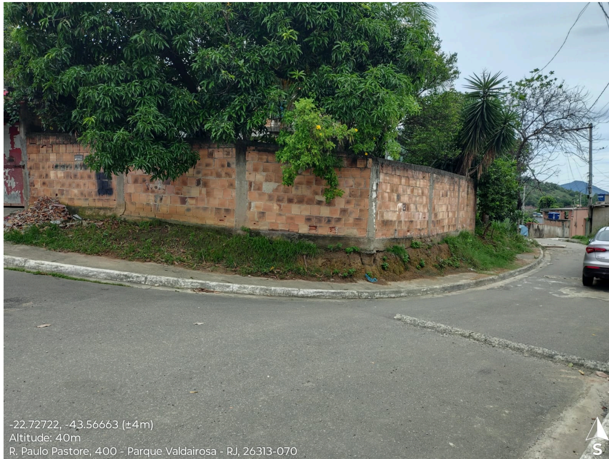
Figura 1 - Perspectiva do muro divisorio do imóvel
