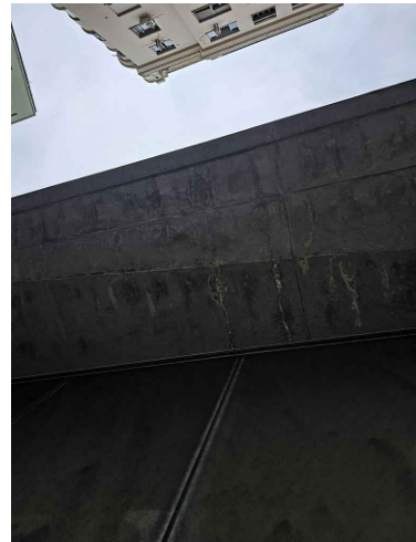
18/07/23 LAJE EXTERNA BALANÇO FISSURAS 9 X 2,5m - ≤ 0,3mm
