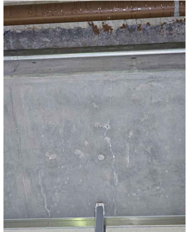
18/07/23 VIGA PROTENDIDA - FISSURAS 3 X 0,9m - ≤ 0,3mm
