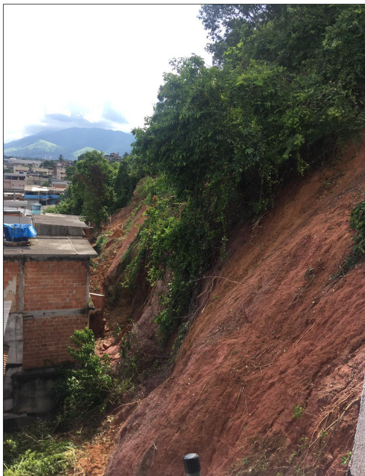
Figura 2 – Talude de aproximadamente 15 m de altura subvertical com deslizamentos planares que atingiram os fundos de todos os imóveis da Rua Chumbo, no Bairro Coelho da Rocha.
