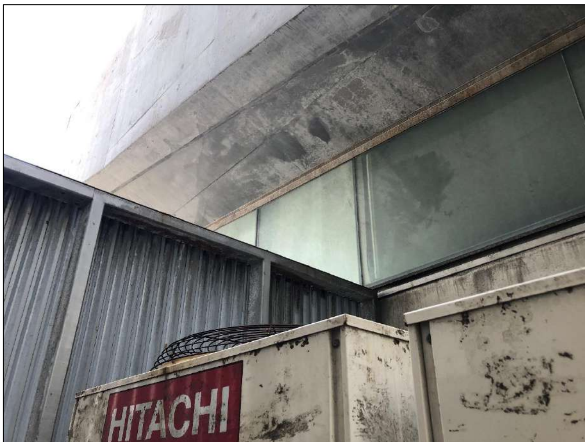
Figura 263: Demonstração da Patologia 1 no 1º pavimento
