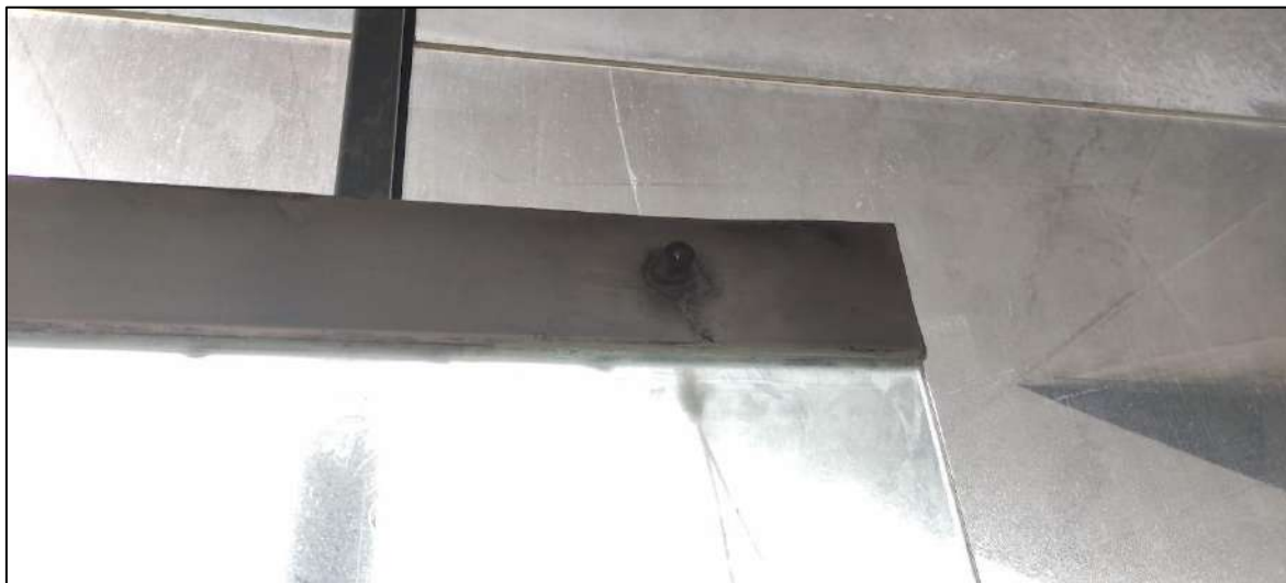
Figura 60: Demonstração da Patologia 15 no painel WW09
