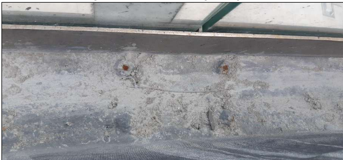
Figura 300: Ausência de silicone no guarda corpo G2.
