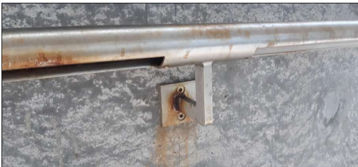
Figura 183: Demonstração da Patologia 17 no guarda-corpo G2
