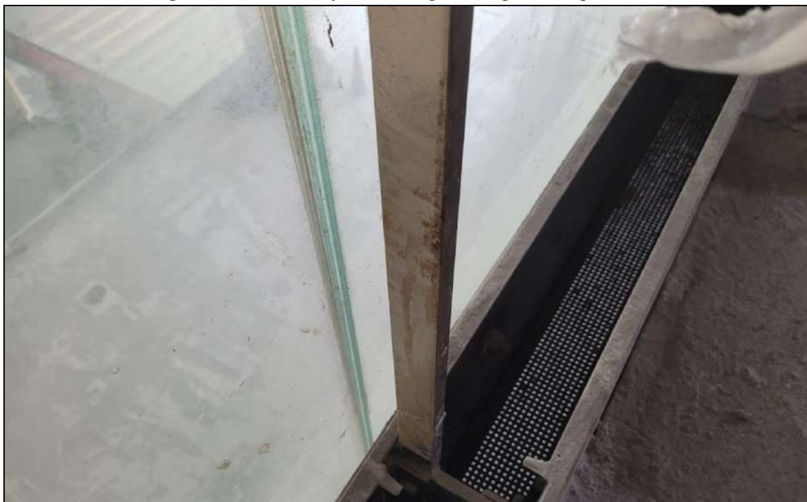
Figura 229: Demonstração da Patologia 12 no guarda-corpo GCI-2b
