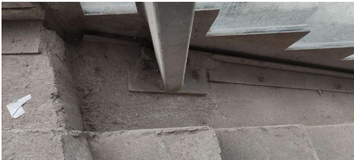
Figura 20: Demonstração da Patologia 1 no painel WW06
