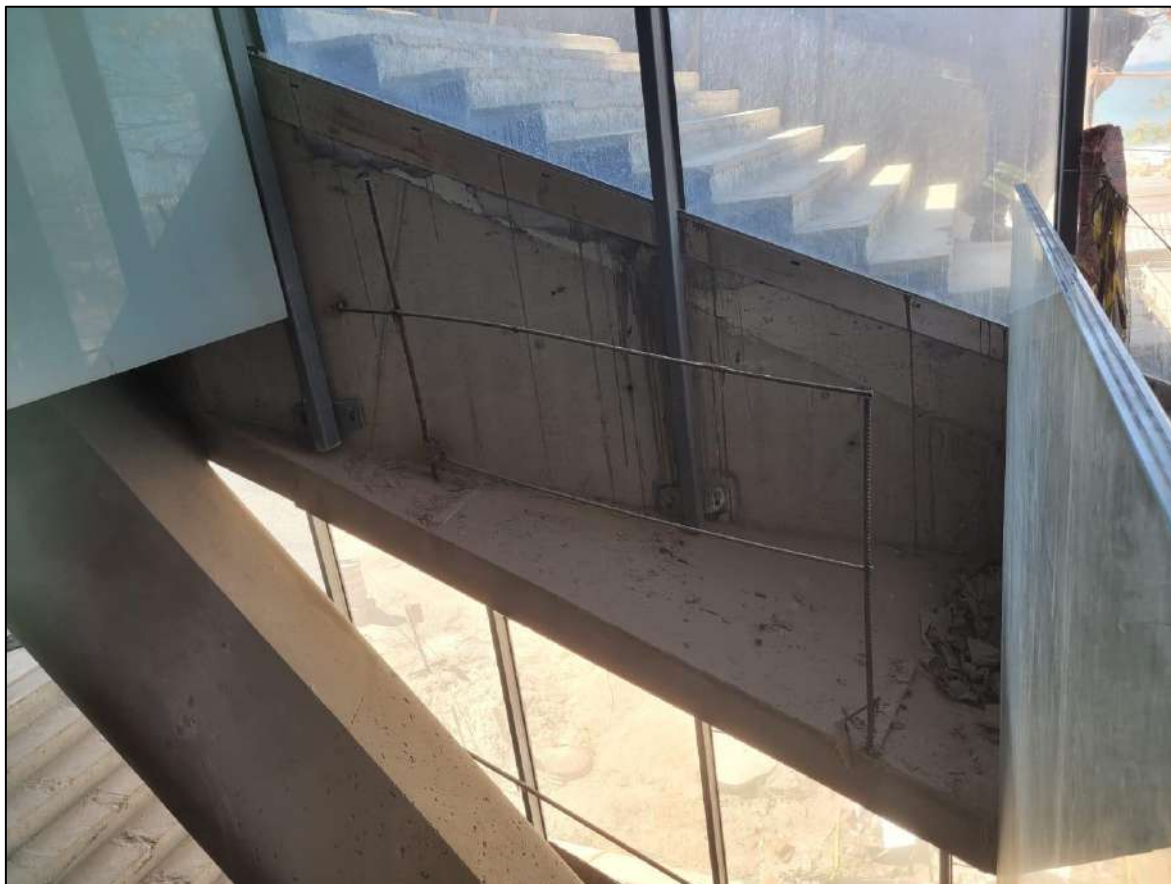
Figura 334: Ausência de vidro e caixilhos no guarda corpo WC-04 - térreo
