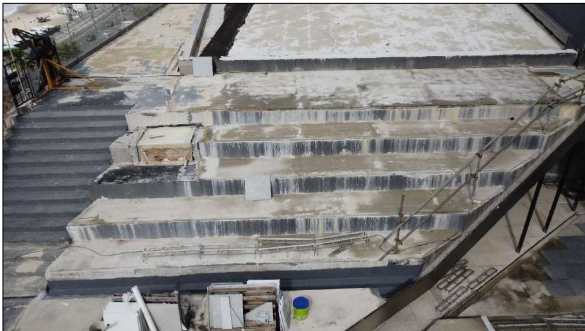
Figura 314: Ausência de vidro no guarda corpo G14
