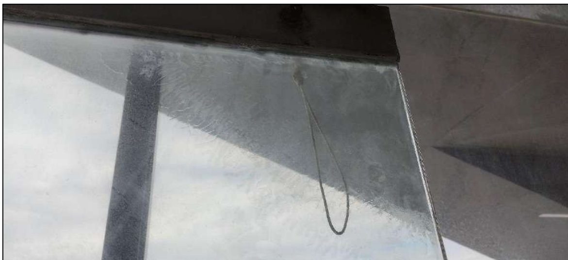
Figura 80: Demonstração da Patologia 1 no painel WW09
