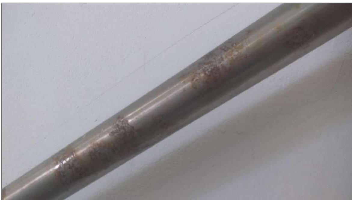
Figura 235: Demonstração da Patologia 1 no corrimão C4
