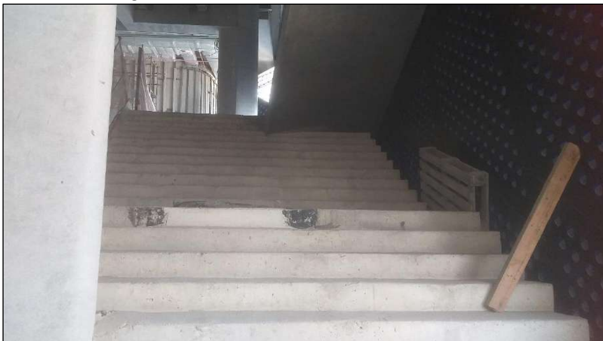
Figura 325: Ausência de corrimão Não Identificado 3 na escada G
