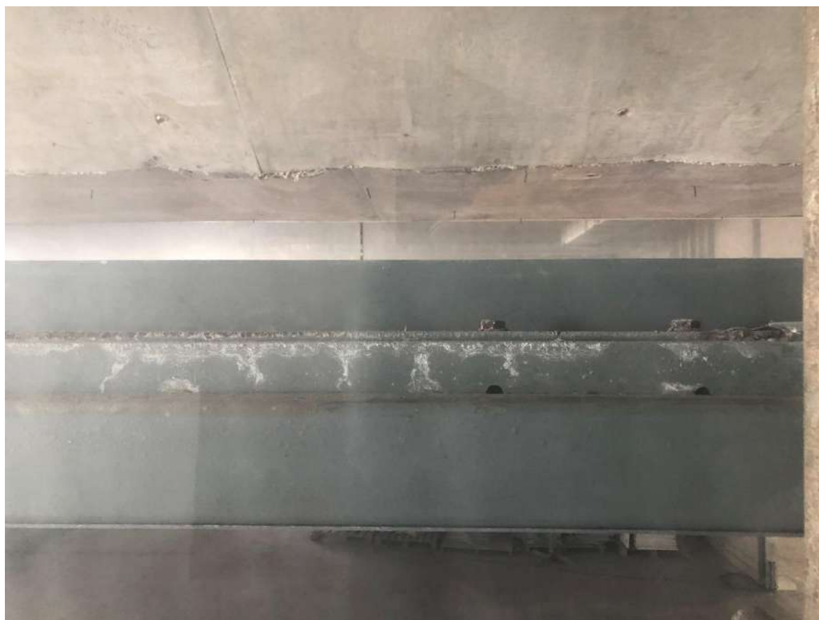
Figura 241: Demonstração da Patologia 2 no 3º pavimento
