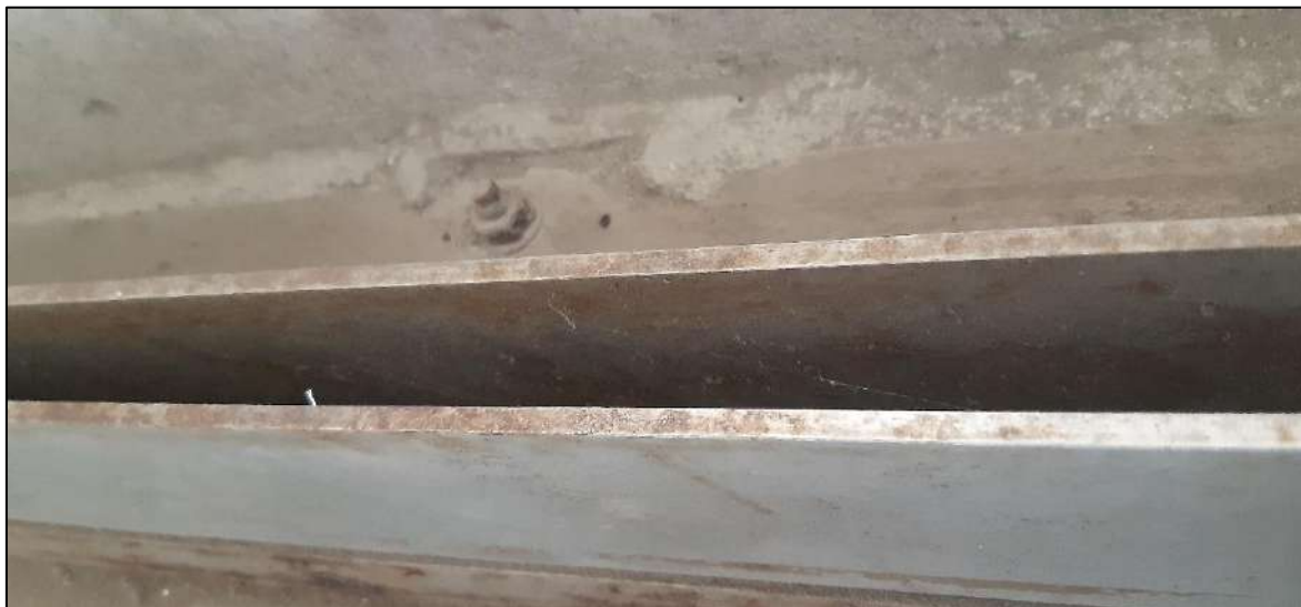
Figura 212: Demonstração da Patologia 9 no guarda-corpo GCI-1a
