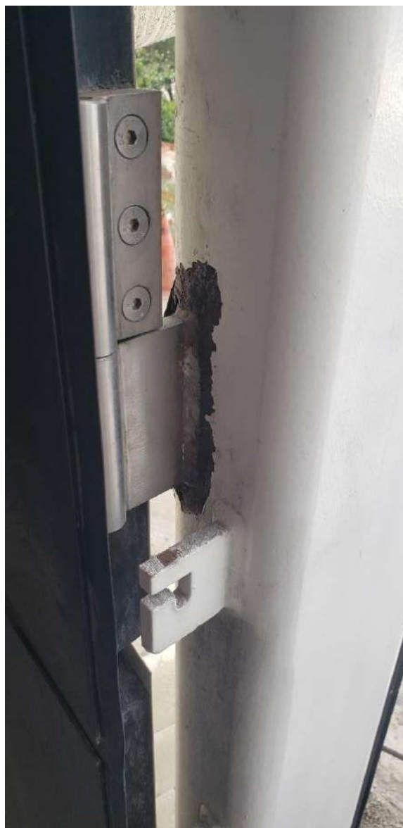
Figura 22: Demonstração da Patologia 2 no painel 3
