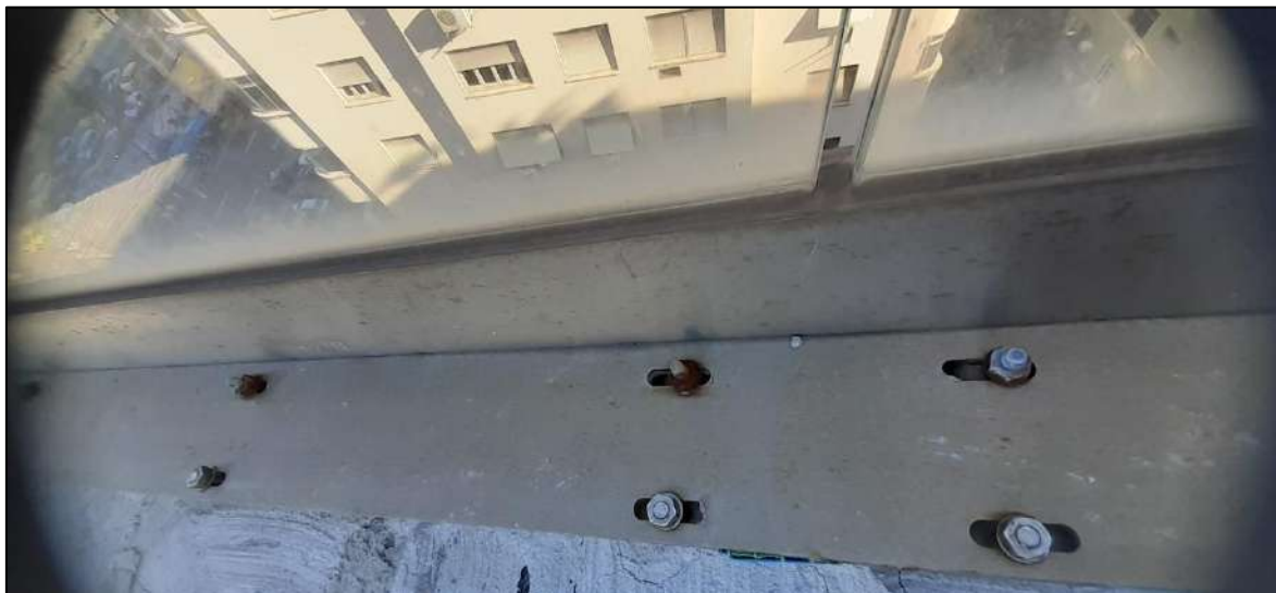
Figura 161: Demonstração da Patologia 10 no guarda-corpo G13
