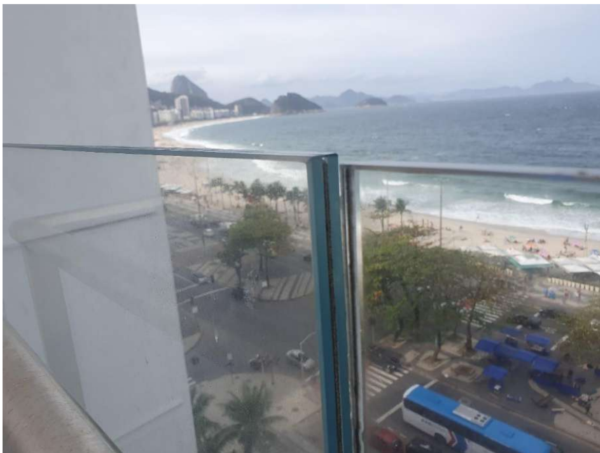
Figura 115: Demonstração da Patologia 1 no guarda-corpo G11B
