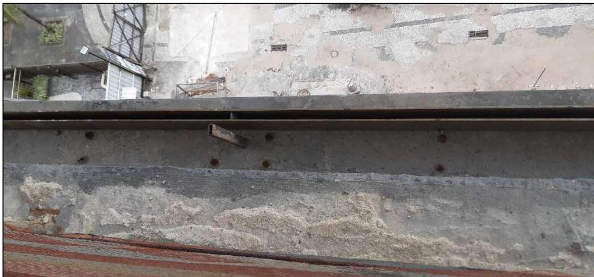
Figura 157: Demonstração da Patologia 10 no guarda corpo G6
