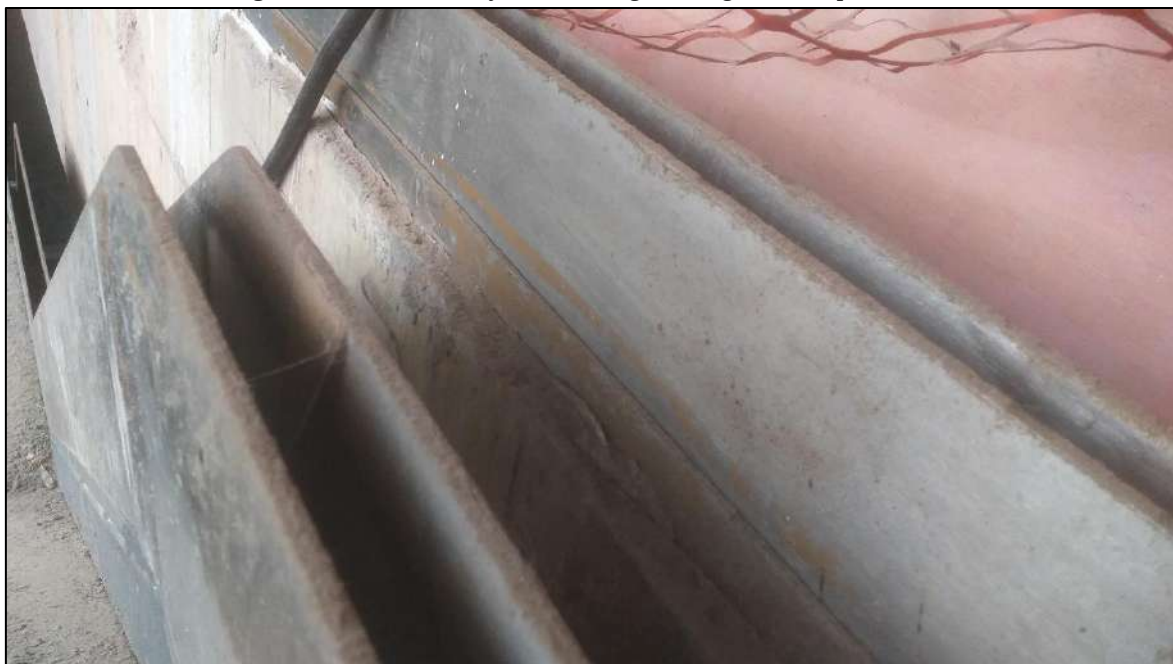
Figura 214: Demonstração da Patologia 9 no guarda-corpo GCI-1c
