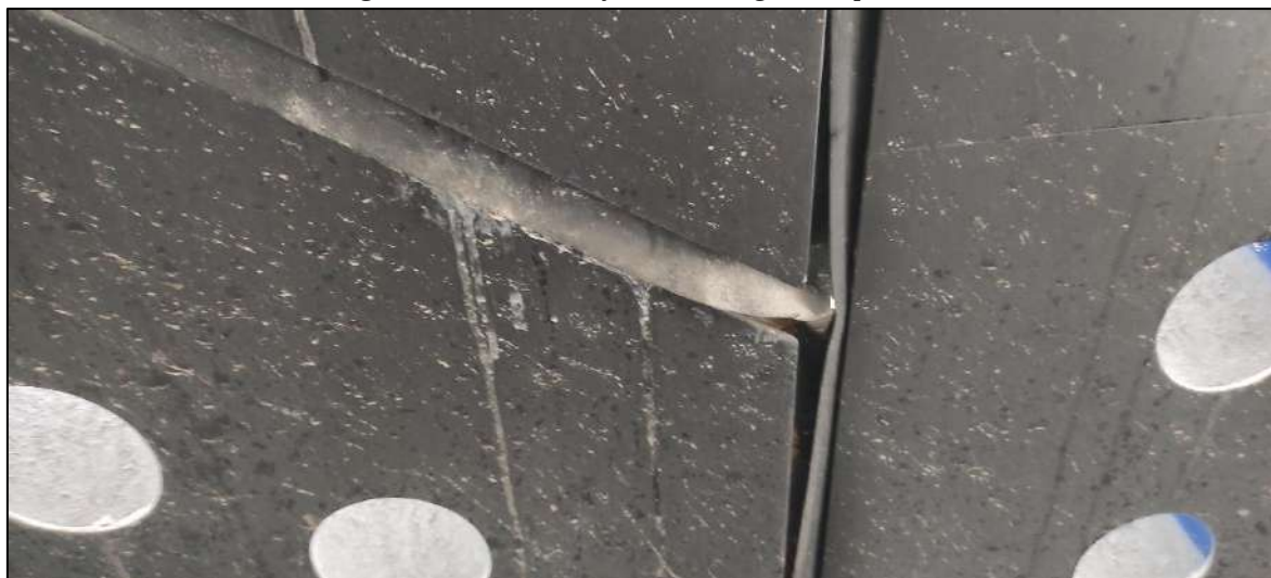
Figura 97: Demonstração da Patologia 3 no painel 1
