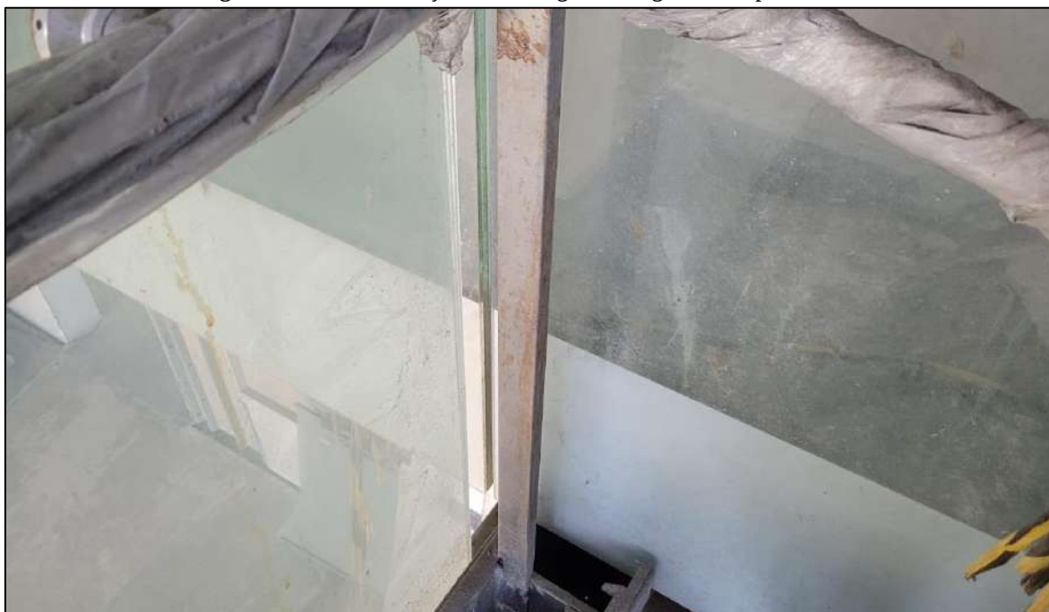
Figura 230: Demonstração da Patologia 12 no guarda-corpo GCI-2c
