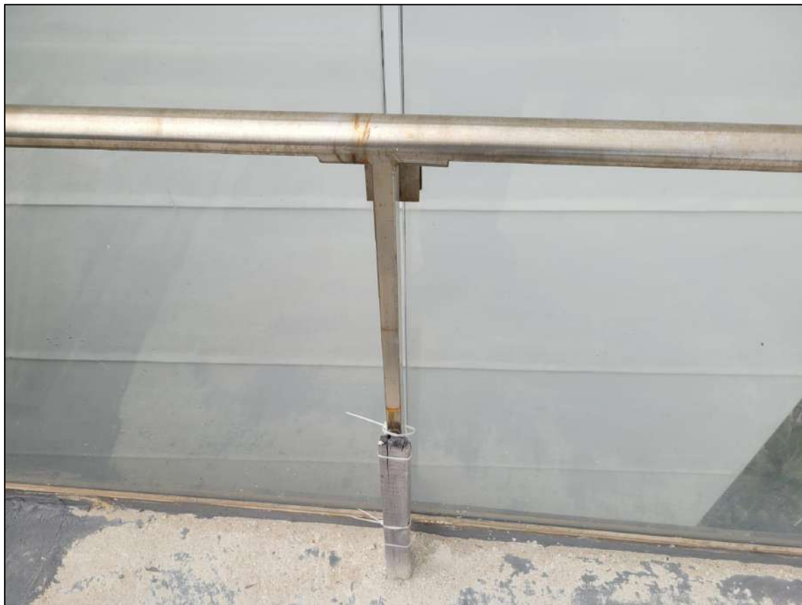
Figura 188: Demonstração da Patologia 17 no guarda-corpo G11B
