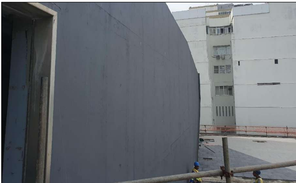
Figura 364: Ausência completa de todo o vidro e estrutura no revestimento EWS 1.3
