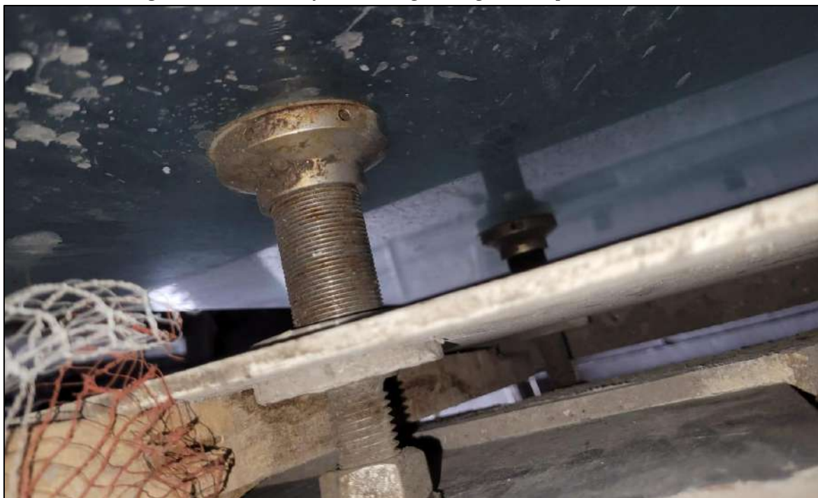
Figura 199: Demonstração da Patologia 3 no guarda-corpo interno GCI-2e
