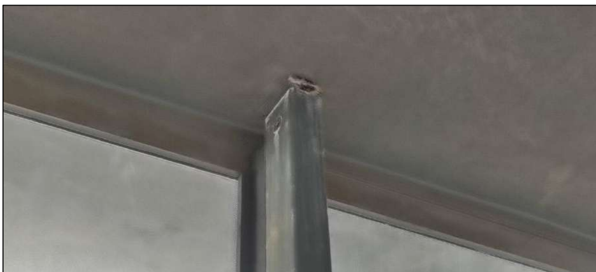
Figura 68: Demonstração da Patologia 16 no painel WW08
