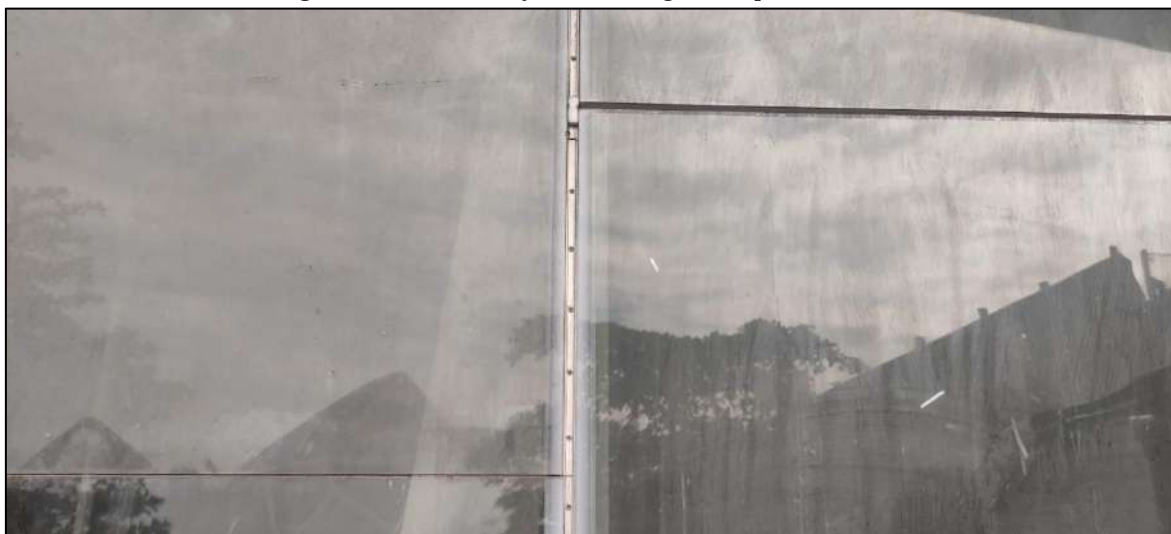
Figura 90: Demonstração da Patologia 4 no painel WW07
