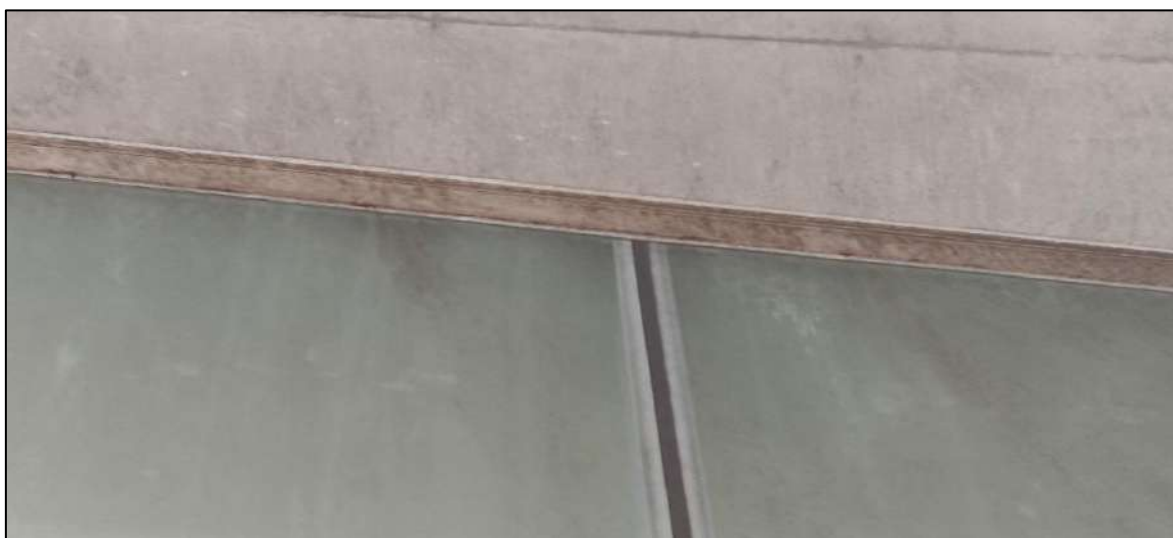
Figura 40: Demonstração da Patologia 7 no painel WW09
