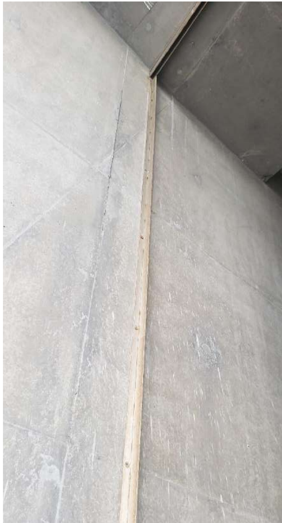
Figura 30: Demonstração da Patologia 6 no painel 3
