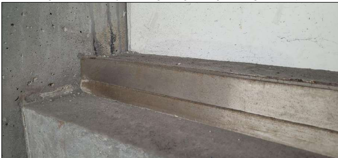
Figura 217: Demonstração da Patologia 9 no guarda-corpo GCI-1d (perfil inferior)
