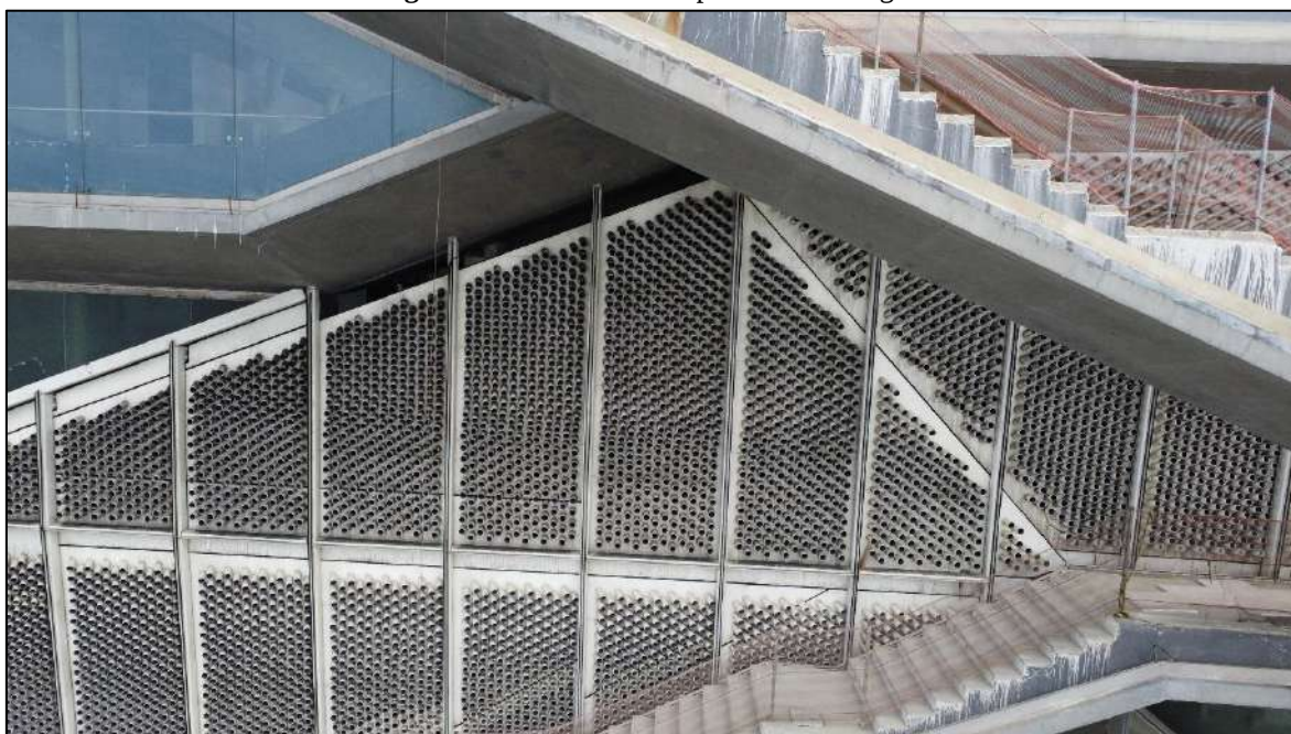
Figura 274: Ausência dos painéis de cobogós
