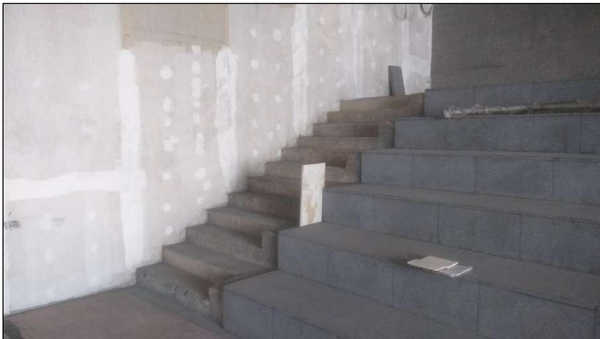
Figura 316: Ausência de corrimão C10 na escada 2º pavimento
