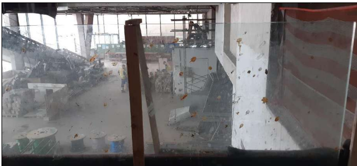
Figura 202: Demonstração da Patologia 6 no guarda-corpo GCI-2f
