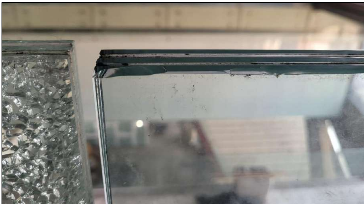
Figura 209: Demonstração da Patologia 8 no guarda-corpo GCI-2b
