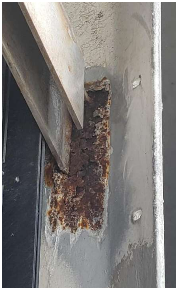
Figura 46: Demonstração da Patologia 8 no painel 3
