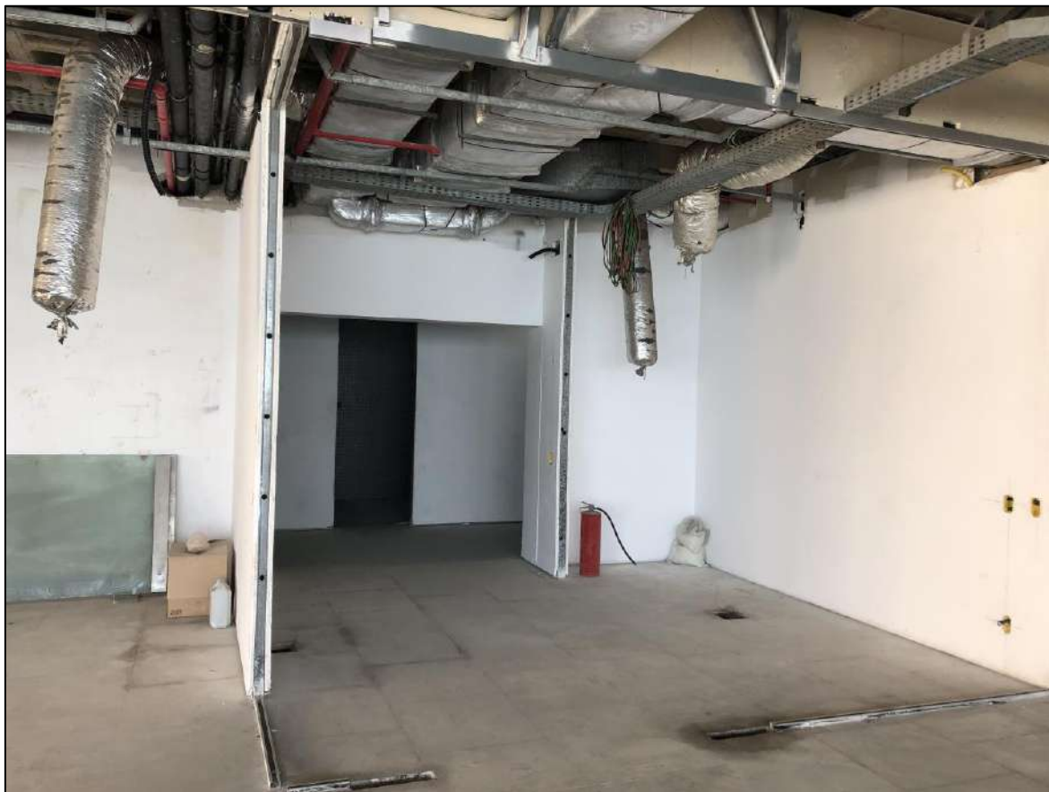
Figura 349: Ausência do vidro da divisória DV7h, DV7a e porta PV2
