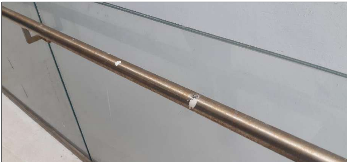
Figura 130: Demonstração da Patologia 7 no guarda corpo G4B
