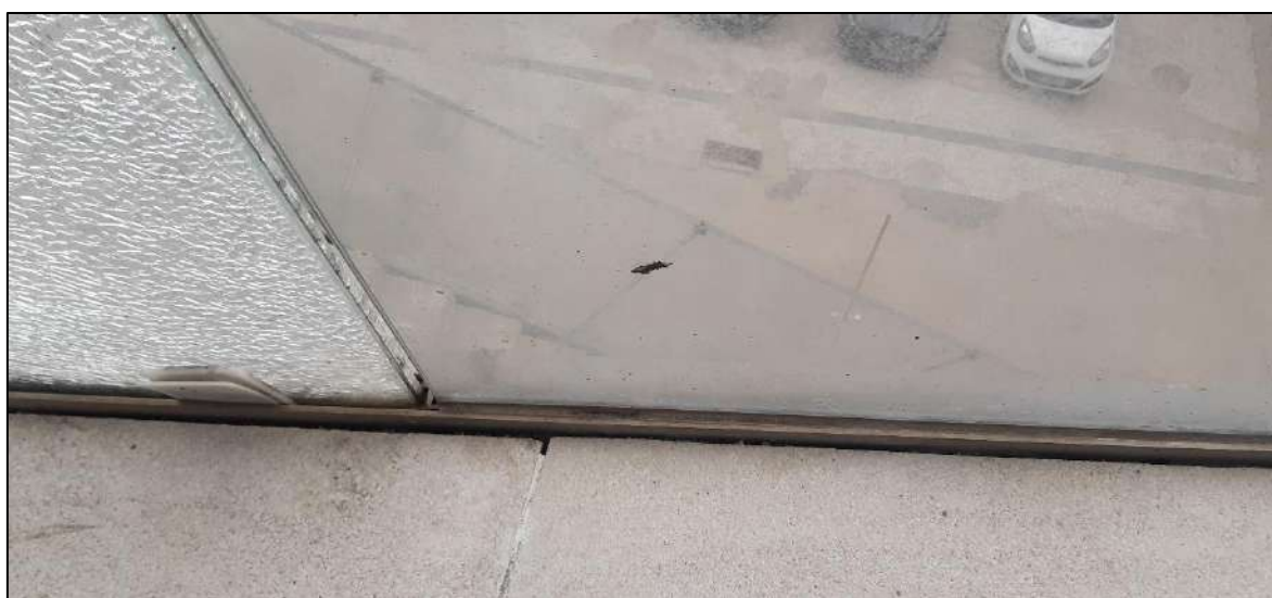
Figura 122: Demonstração da Patologia 3 no guarda corpo G3
