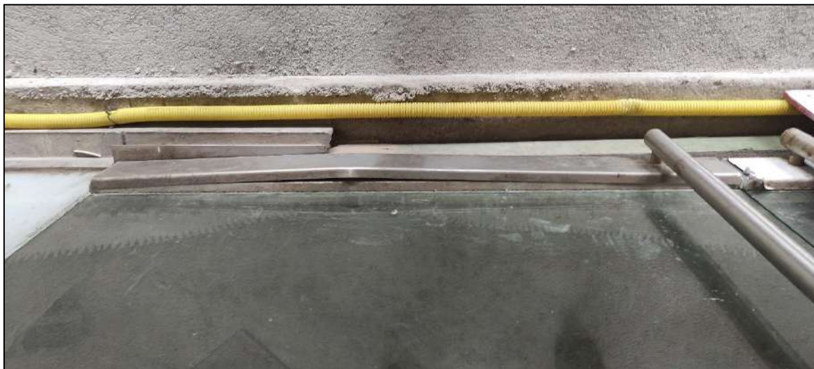
Figura 62: Demonstração da Patologia 15 no painel WW05
