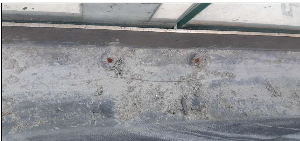
Figura 154: Demonstração da Patologia 10 no guarda corpo
