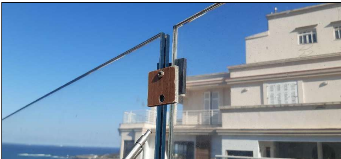
Figura 177: Demonstração da Patologia 14 no guarda-corpo G13
