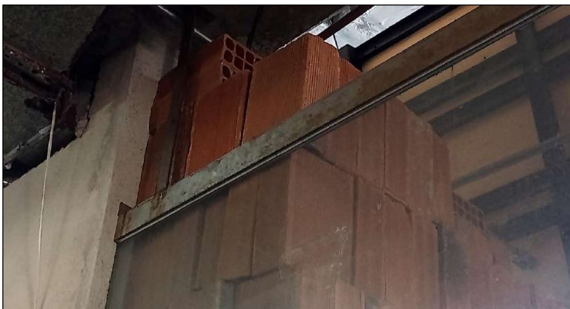
Figura 240: Imagem B – Térreo – Demonstração da Patologia 1 no Térreo
