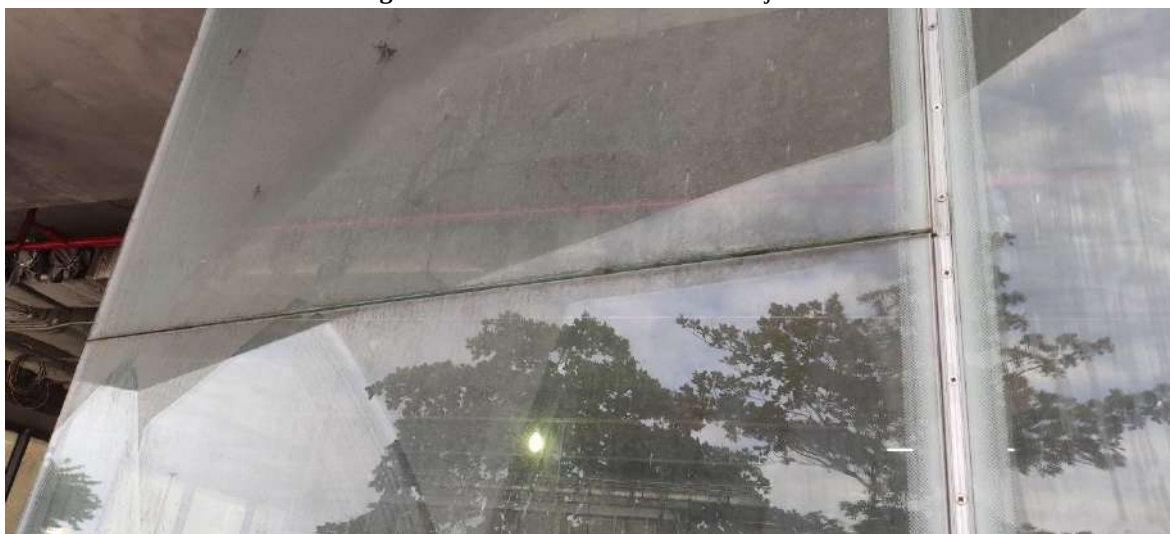
Figura 277: Ausência de silicone nas juntas
