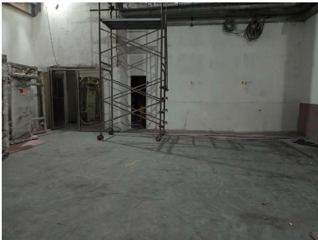
Figura 342: Imagem E - 1º Pavimento – Ausência completa da divisória DV9
