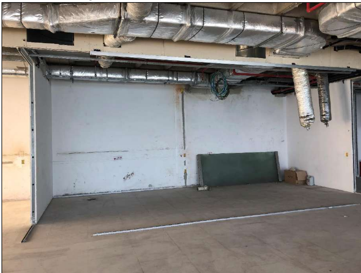
Figura 356: Ausência do vidro das divisórias DV7h e DV7b
