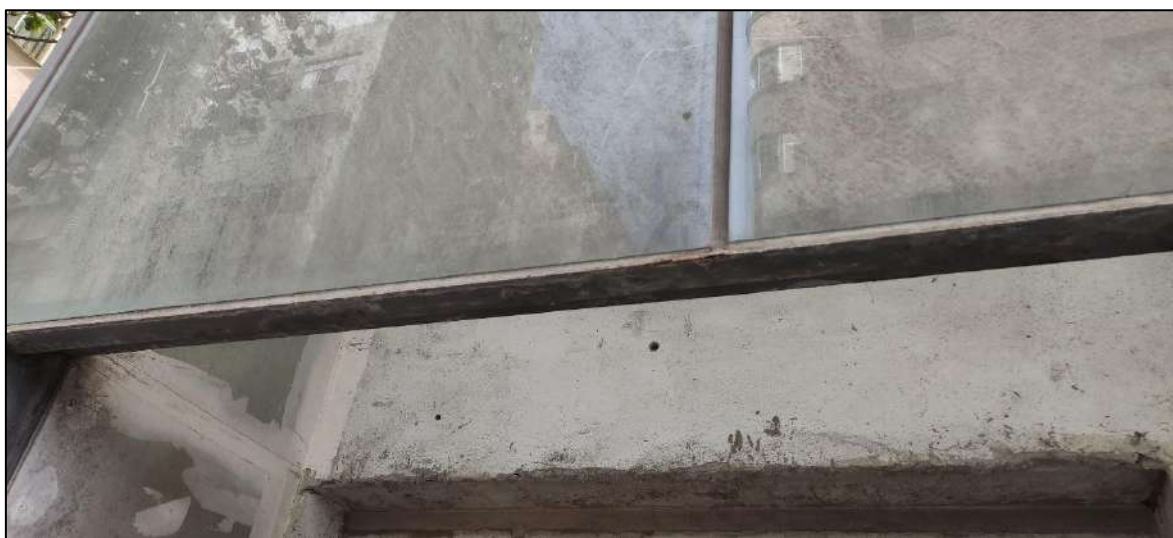
Figura 71: Demonstração da Patologia 17 no painel WW01
