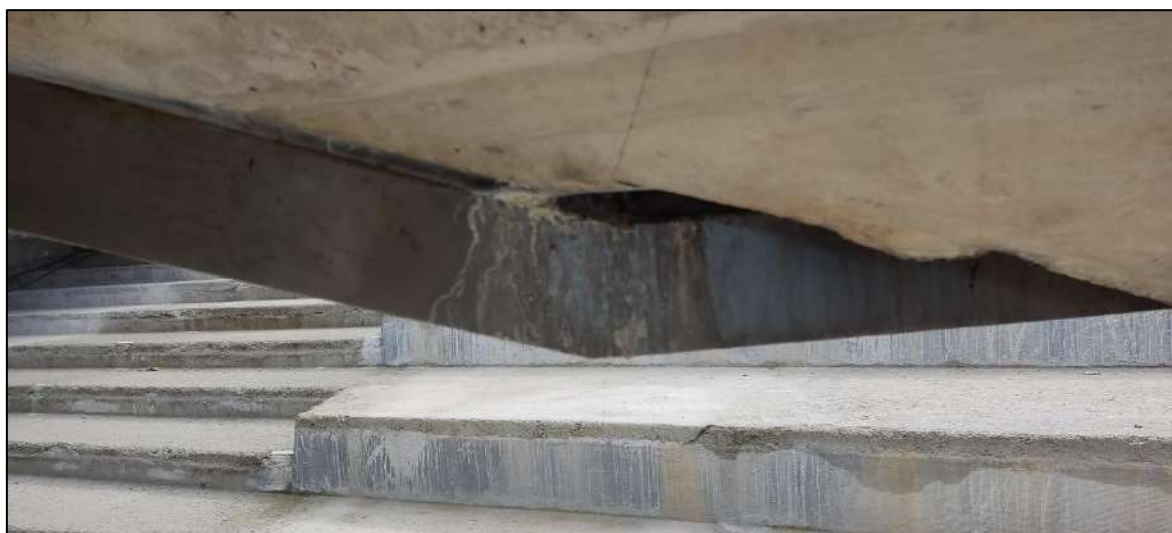
Figura 54: Demonstração da Patologia 14 no painel WW22
