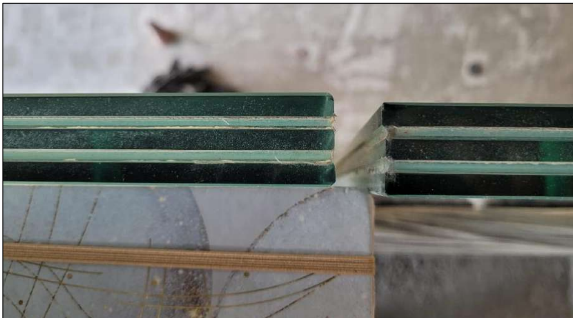
Figura 200: Demonstração da Patologia 4 no guarda corpo interno GCI-2c
