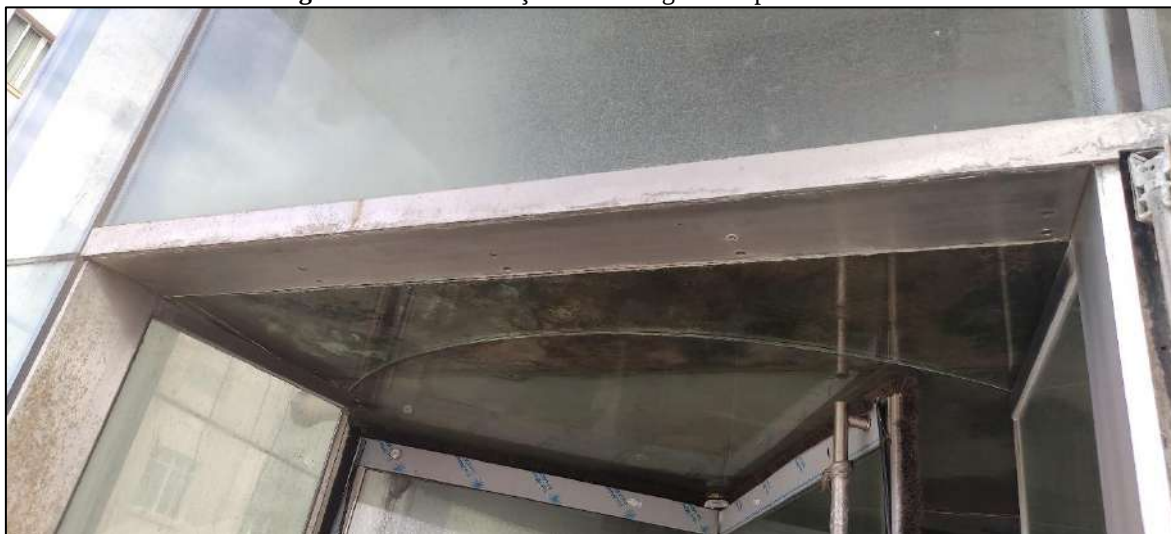
Figura 27: Demonstração da Patologia 5 no painel WW03
