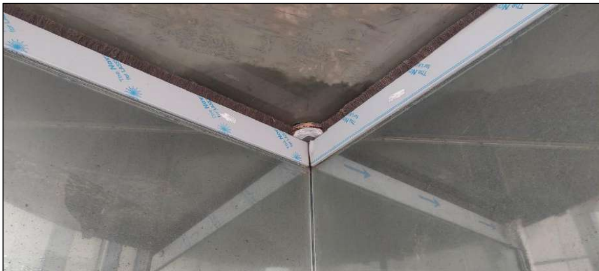
Figura 58: Demonstração da Patologia 15 no painel WW03
