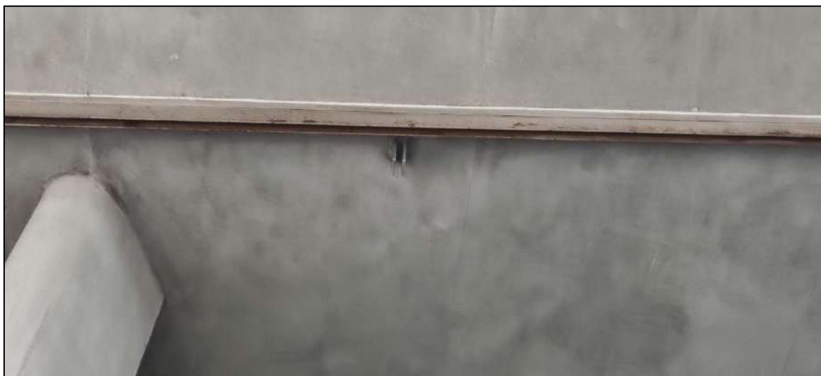
Figura 35: Demonstração da Patologia 7 no painel WW03
