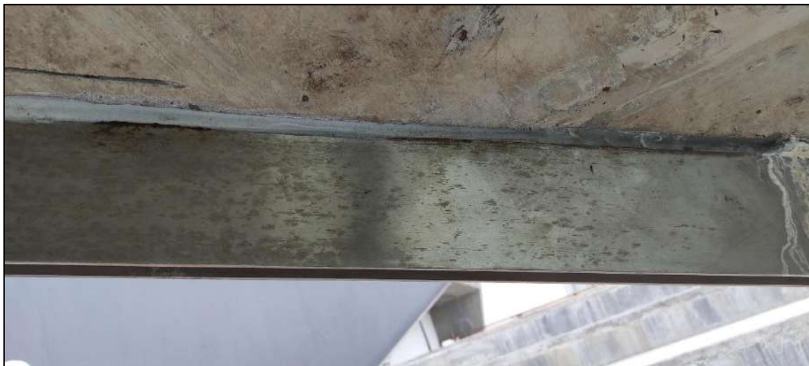
Figura 45: Demonstração da Patologia 7 no painel WW22
