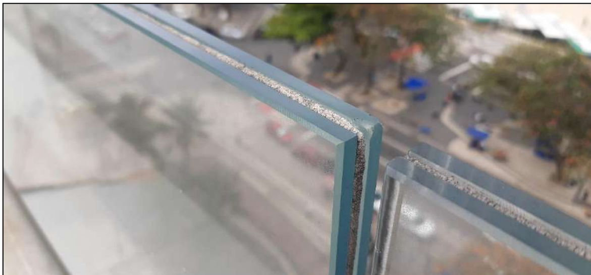
Figura 174: Demonstração da Patologia 14 no guarda-corpo G11A
