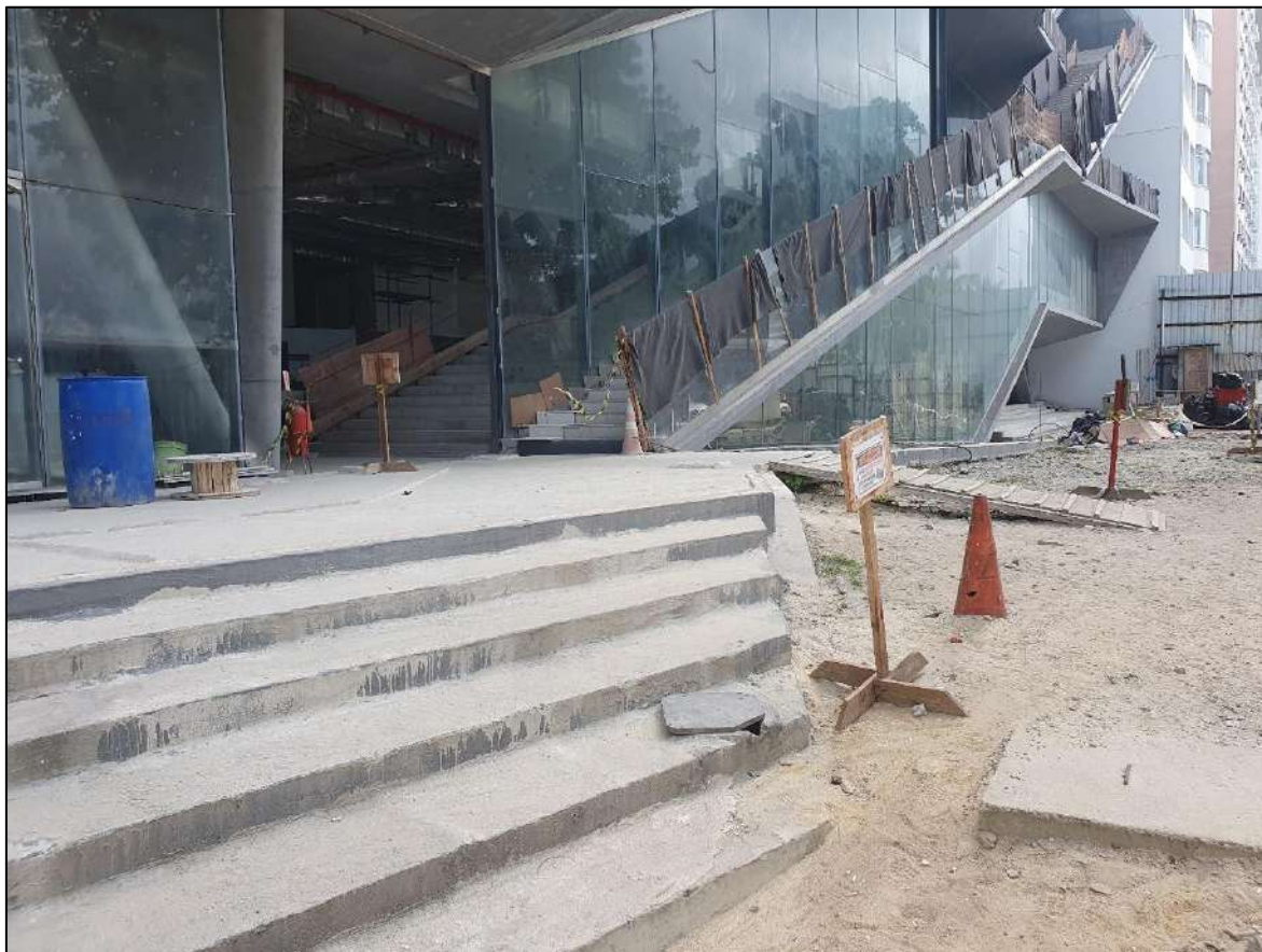
Figura 293: Ausência do corrimão EGR-2.1 (G0)
