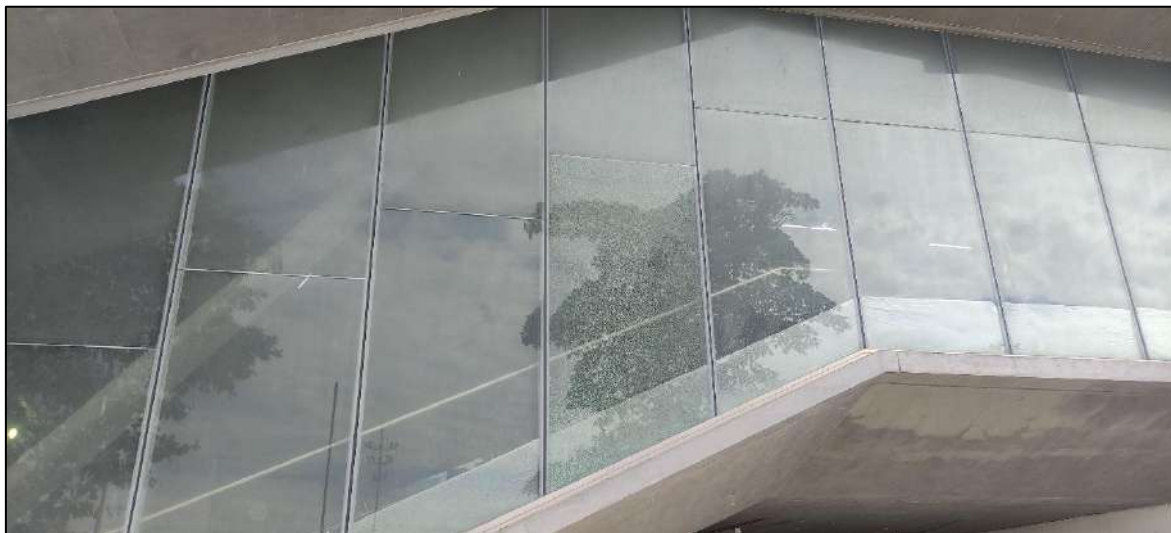
Figura 83: Demonstração da Patologia 2 no painel WW04
