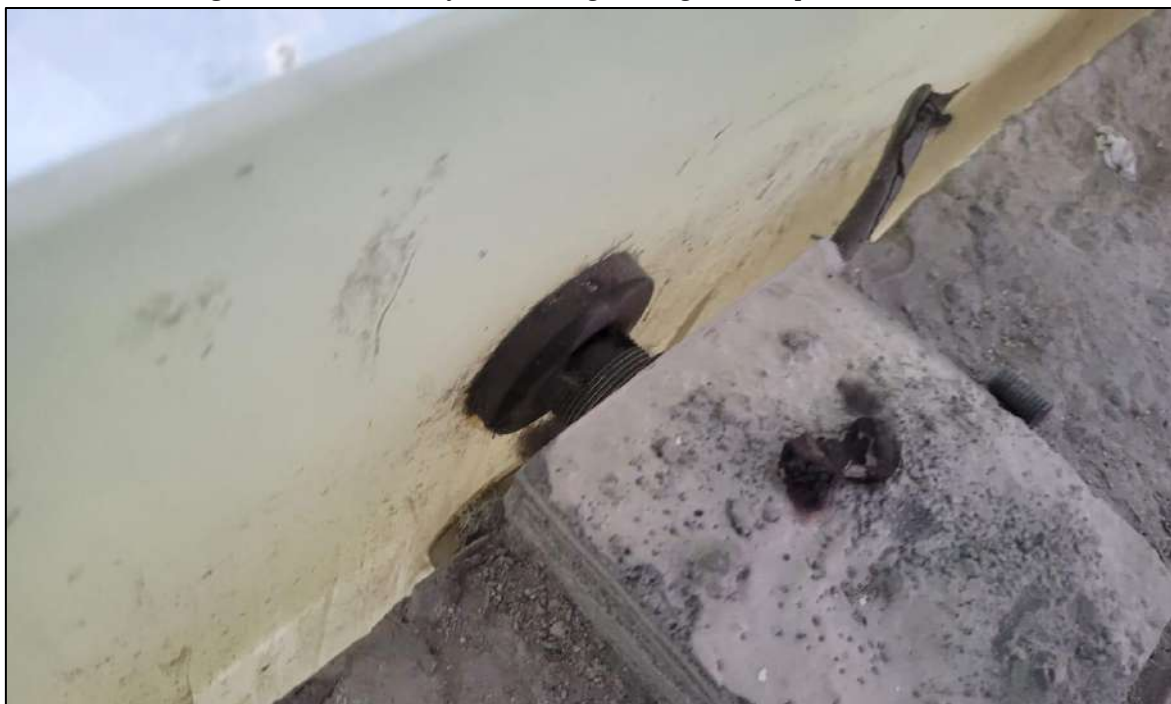
Figura 197: Demonstração da Patologia 3 no guarda-corpo interno GCI-1h
