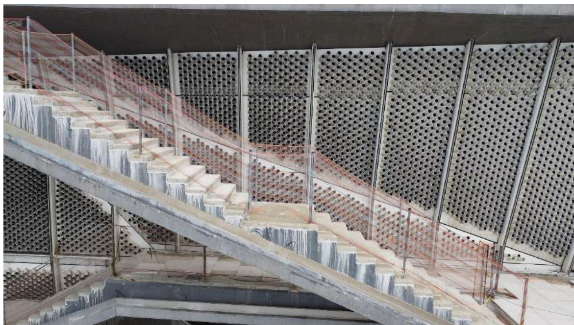
Figura 272: Ausência de vidros, inclusive caixilhos
