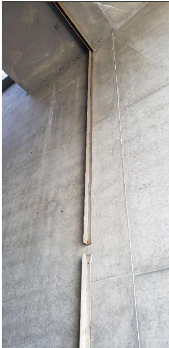
Figura 31: Demonstração da Patologia 6 no painel 4
