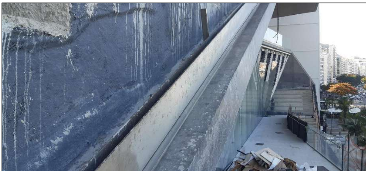
Figura 141: Demonstração da Patologia 9 no guarda corpo G6
