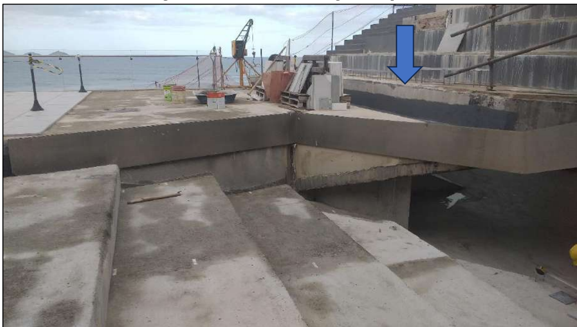
Figura 315: Ausência de vidro no guarda corpo G16
