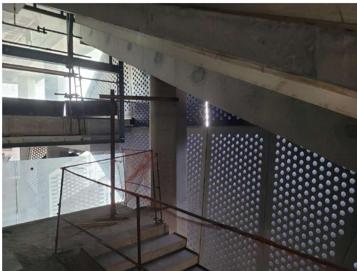
Figura 338: Ausência de vidro, corrimão e perfil U no guarda corpo GCI-1g
