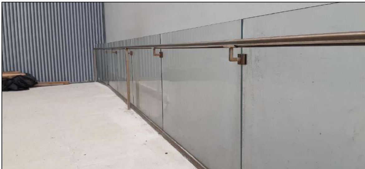
Figura 186: Demonstração da Patologia 17 no guarda-corpo G4B
