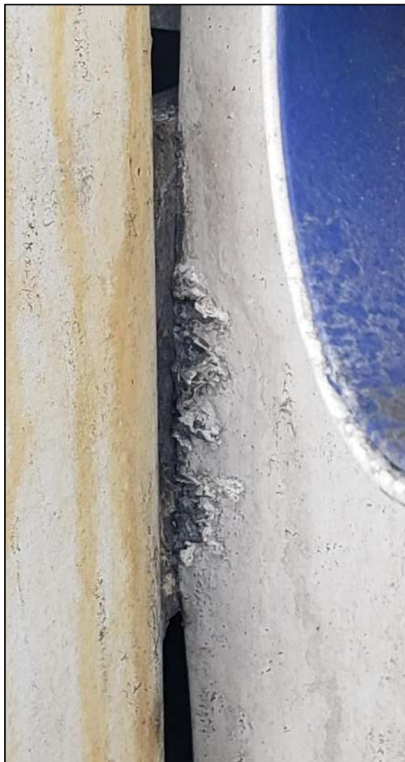
Figura 50: Demonstração da Patologia 10 no painel 3
