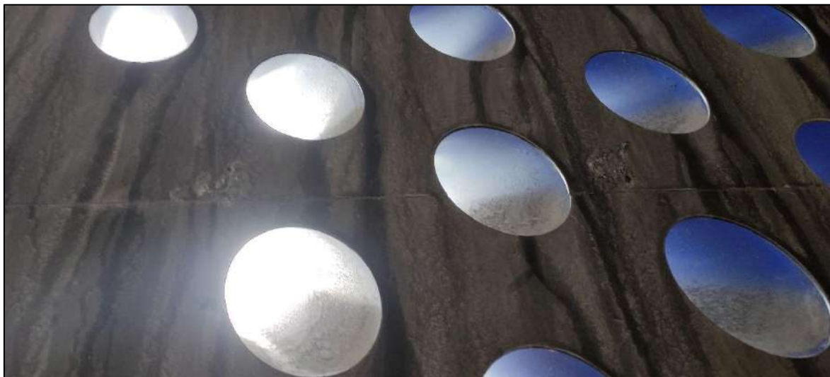
Figura 107: Demonstração da Patologia 8 no painel 4
