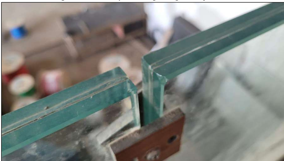
Figura 208: Demonstração da Patologia 8 no guarda-corpo GCI-2f
