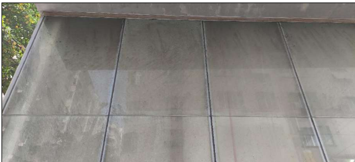
Figura 36: Demonstração da Patologia 7 no painel WW01
