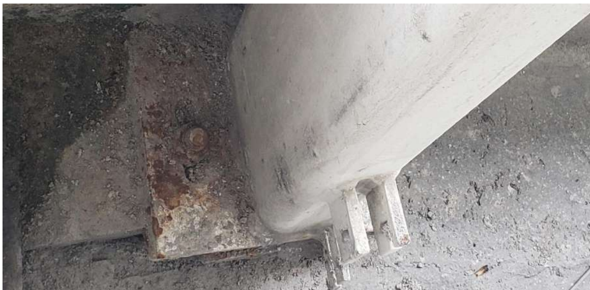
Figura 17: Demonstração da Patologia 1 no painel 3
