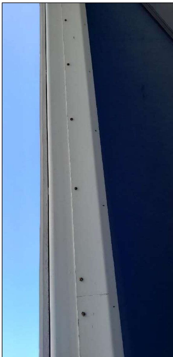
Figura 48: Demonstração da Patologia 9 no painel 3
