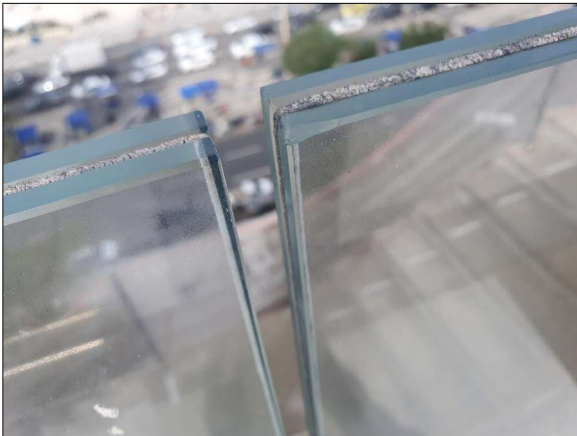
Figura 134: Demonstração da Patologia 8 no guarda corpo G4B
