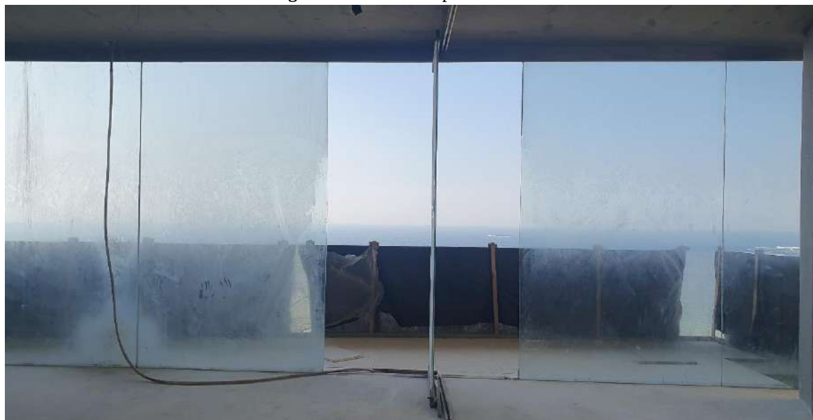
Figura 284: Ausência painel de vidro
