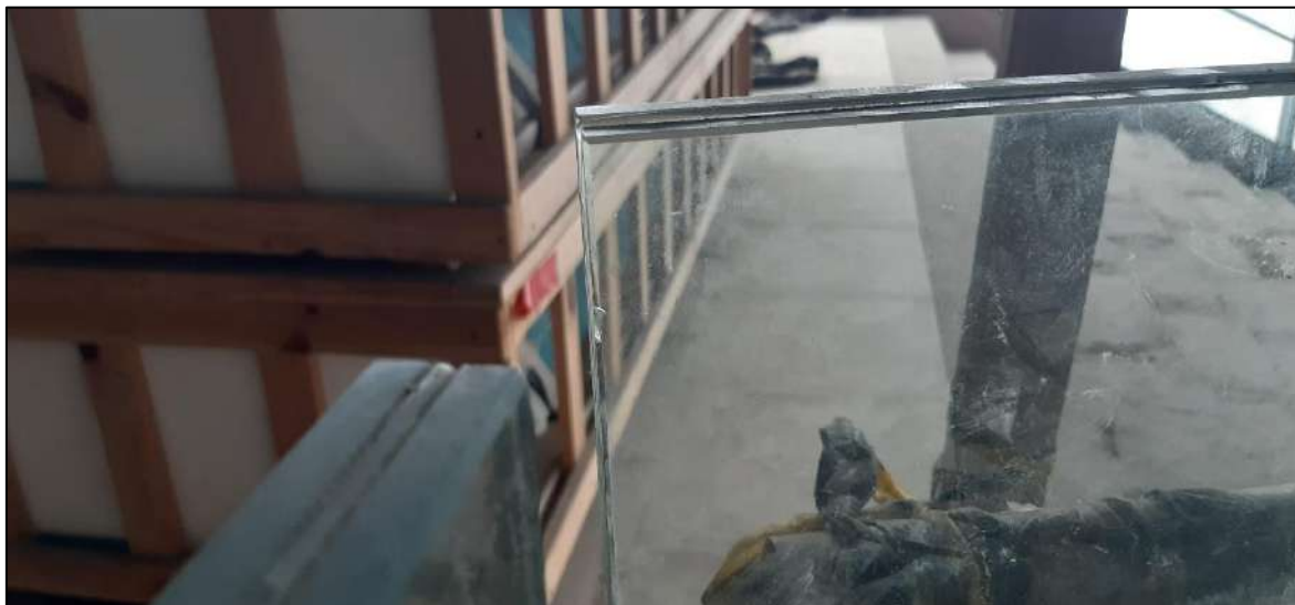
Figura 189: Demonstração da Patologia 1 no guarda-corpo interno GCI-1b
