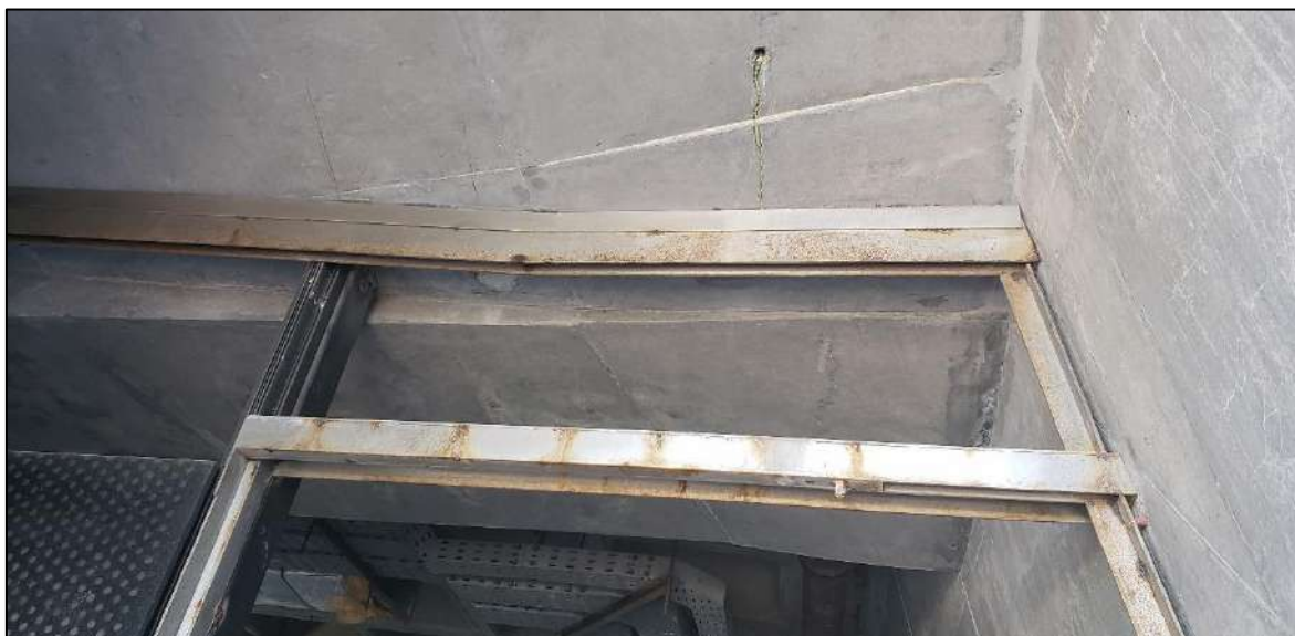
Figura 26: Demonstração da Patologia 5 no painel 2
