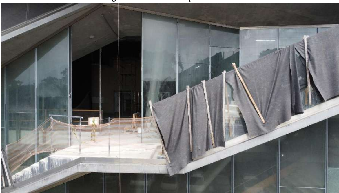
Figura 278: Ausência dos painéis de vidro
