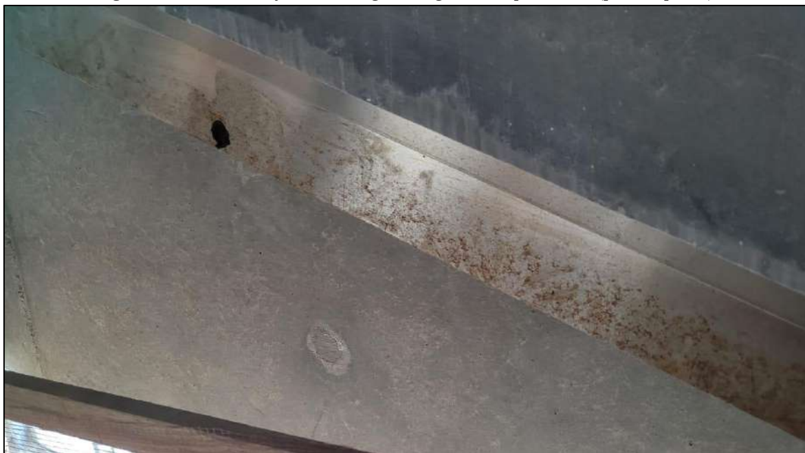
Figura 216: Demonstração da Patologia 9 no guarda-corpo GCI-1d (perfil superior)
