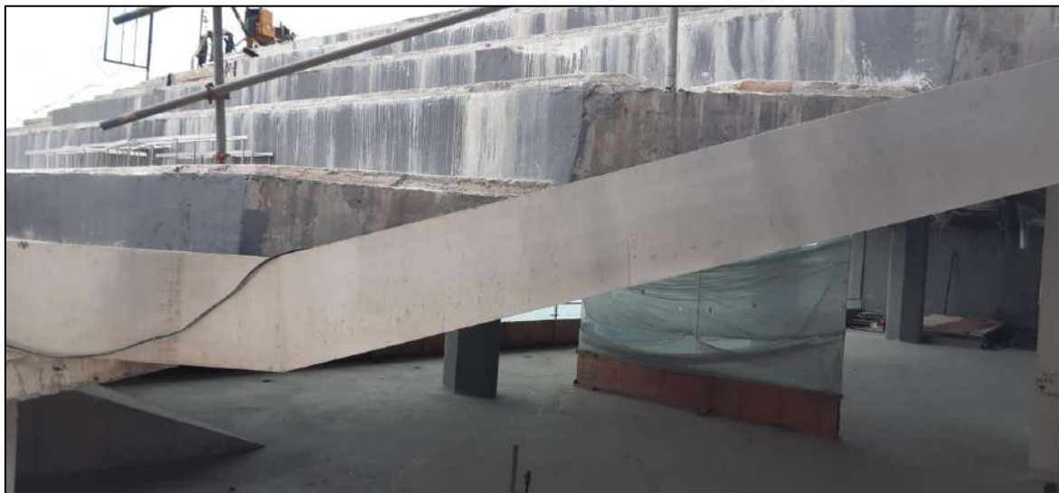
Figura 146: Demonstração da Patologia 9 no guarda corpo G14
