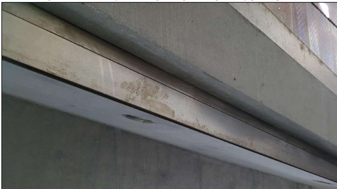
Figura 222: Demonstração da Patologia 9 no guarda-corpo GCI-1j (perfil superior)
