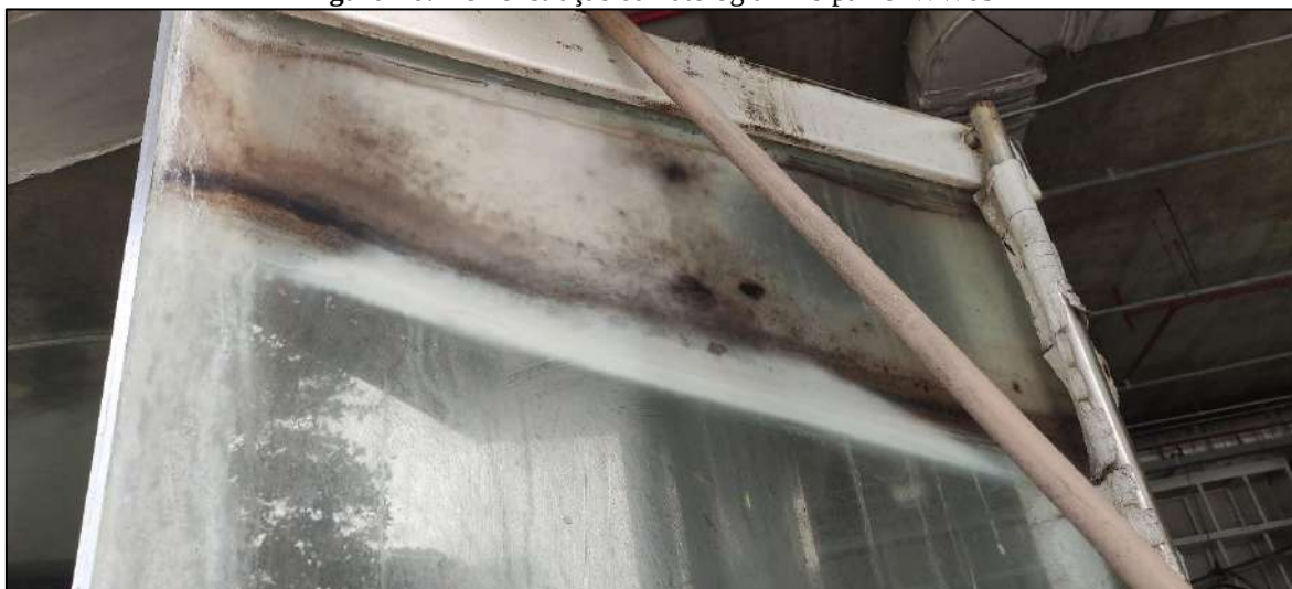
Figura 76: Demonstração da Patologia 1 no painel WW03
