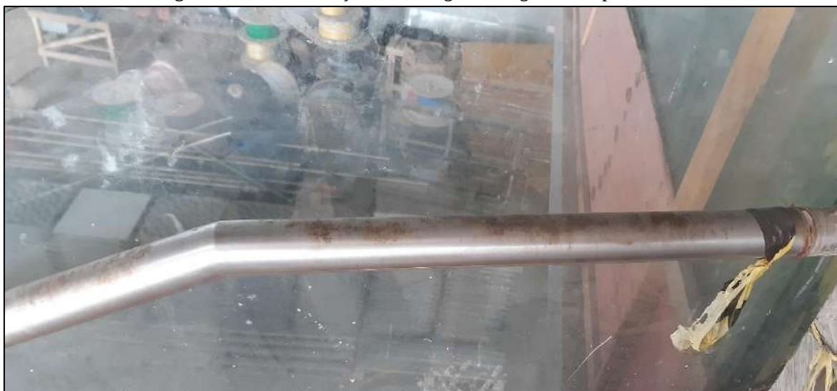
Figura 228: Demonstração da Patologia 12 no guarda-corpo GCI-1b
