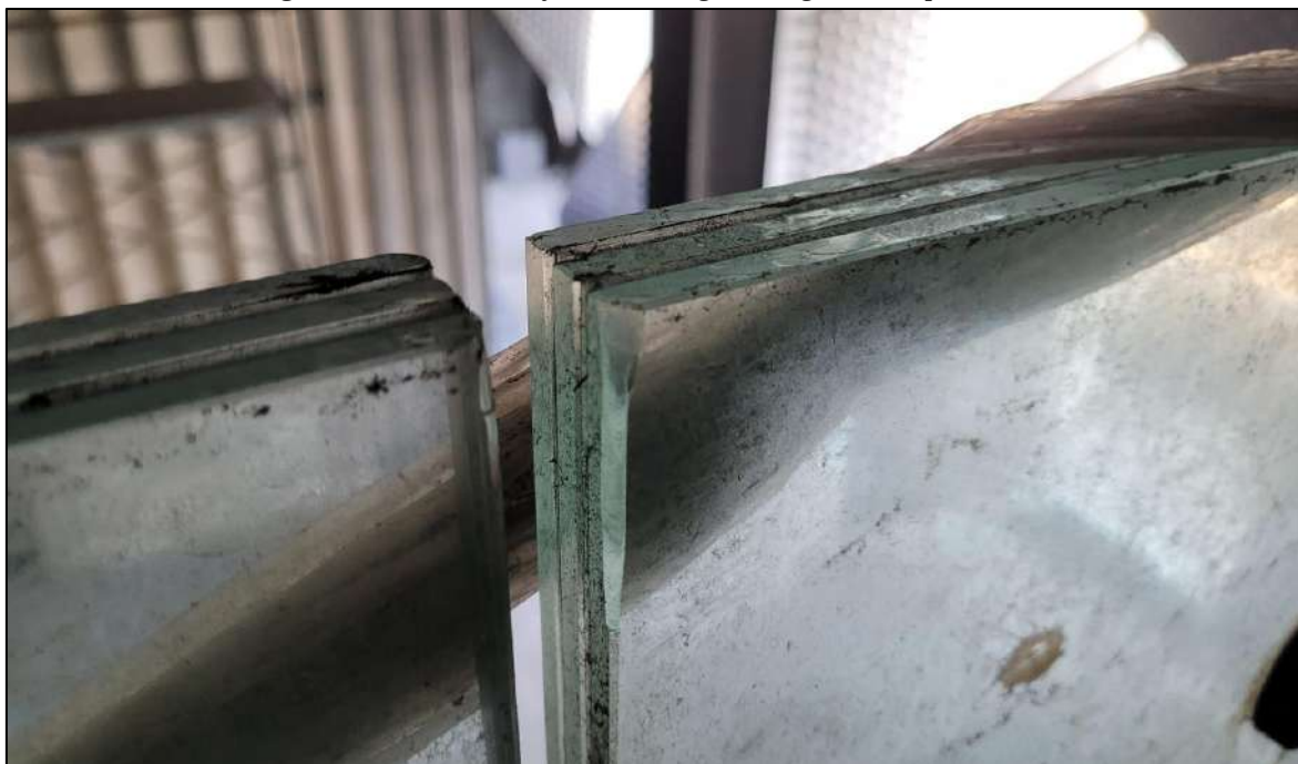
Figura 211: Demonstração da Patologia 8 no guarda corpo GCI-2d
