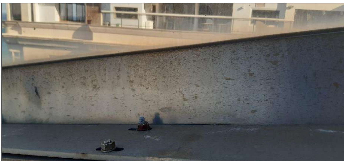
Figura 145: Demonstração da Patologia 9 no guarda corpo G13
