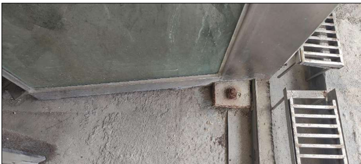
Figura 57: Demonstração da Patologia 15 no painel WW03
