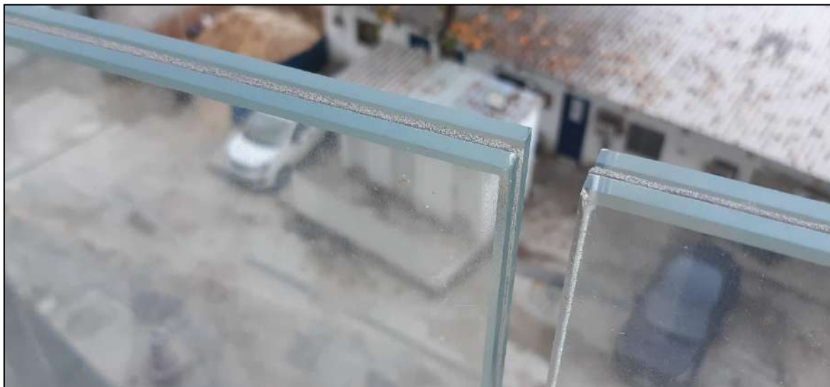
Figura 170: Demonstração da Patologia 14 no guarda corpo G3
