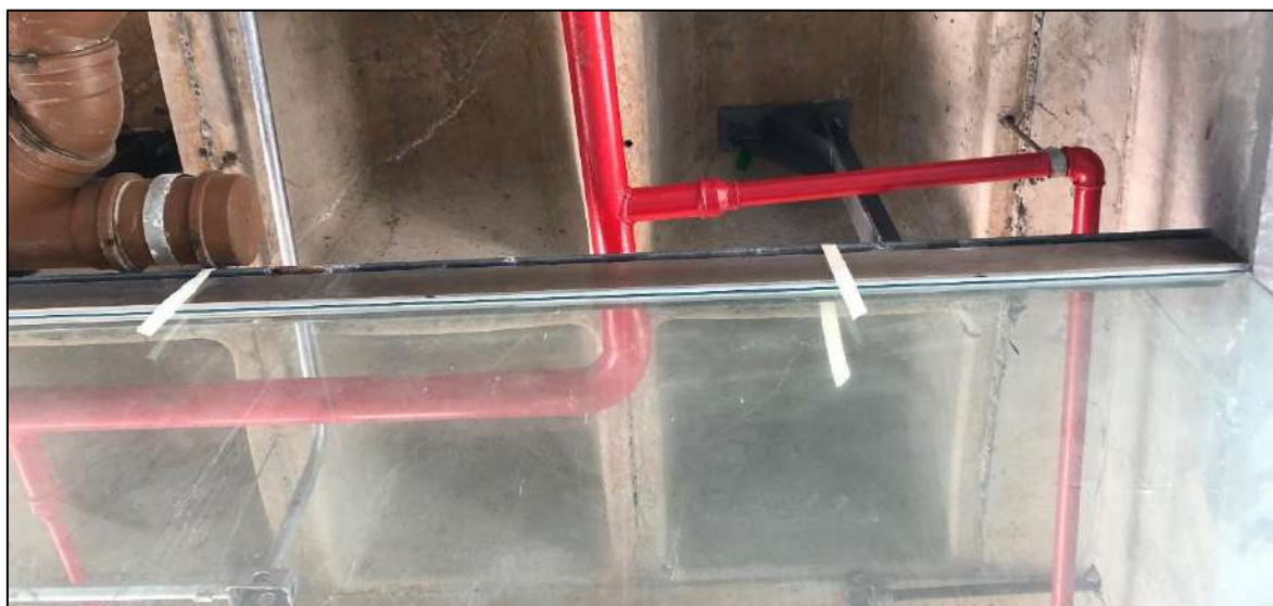
Figura 238: Demonstração da Patologia 1 no 5º pavimento
