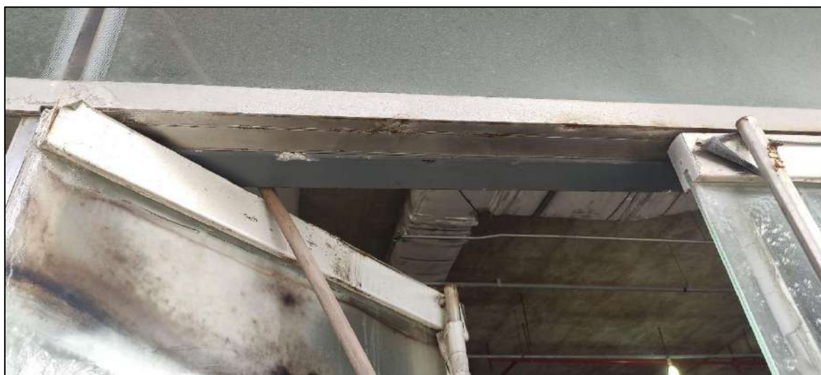
Figura 55: Demonstração da Patologia 15 no painel WW03
