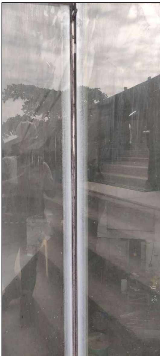
Figura 88: Demonstração da Patologia 3 no painel WW07
