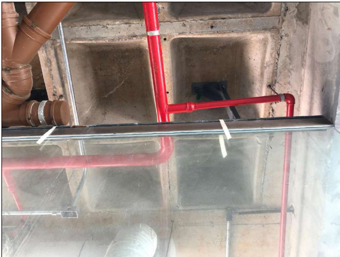
Figura 357: Ausência do silicone da divisória DV6
