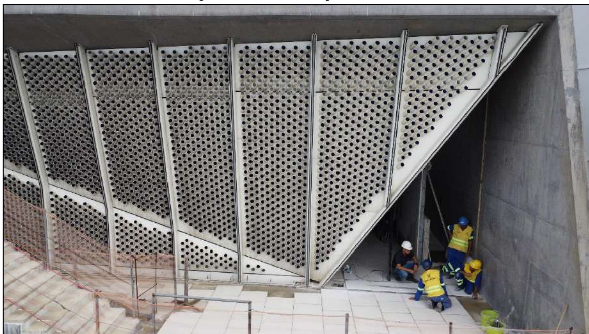
Figura 273: Ausência da porta de vidros
