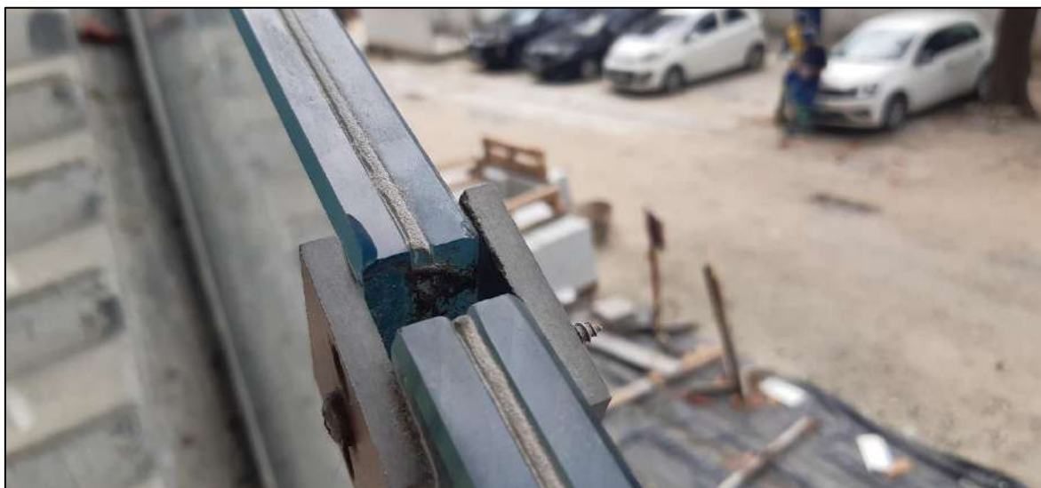
Figura 131: Demonstração da Patologia 8 no guarda-corpo G1A
