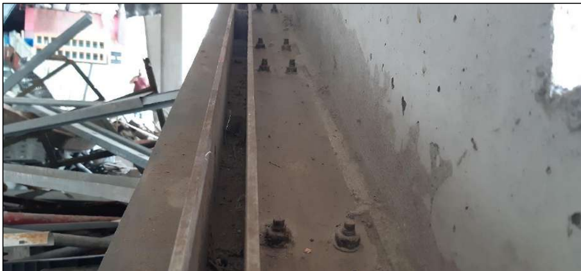
Figura 225: Demonstração da Patologia 10 no guarda-corpo GCI-1a
