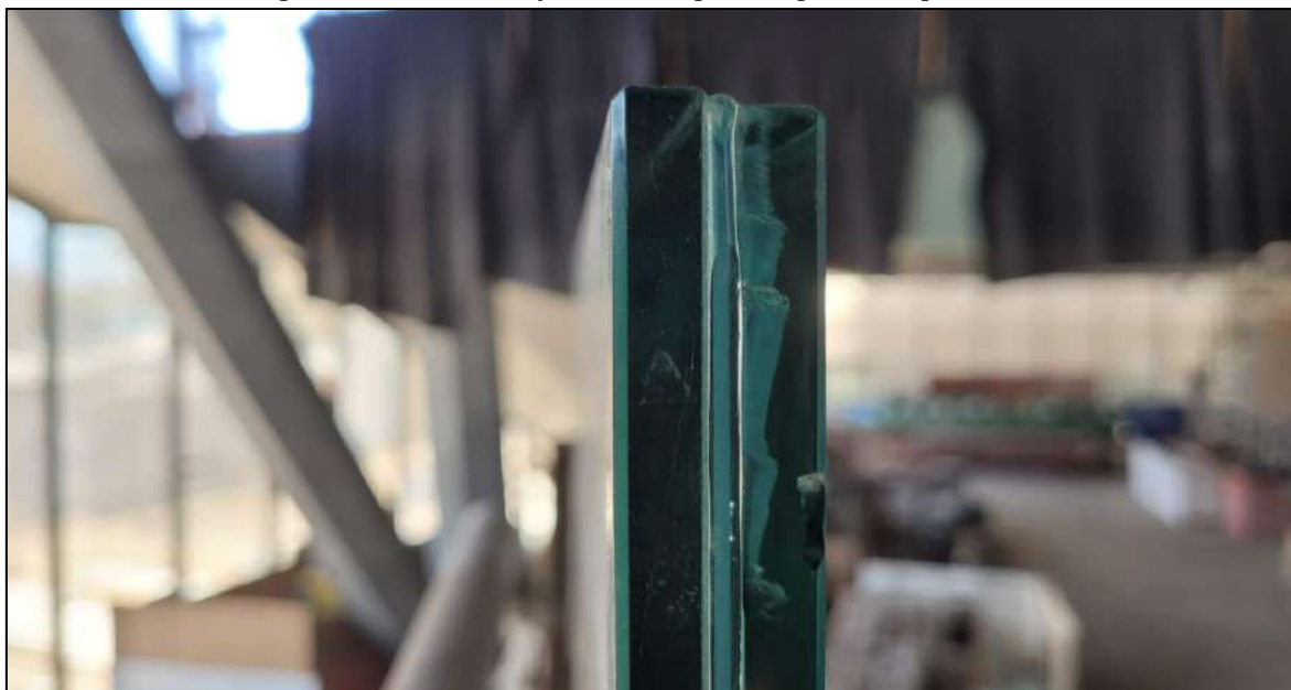
Figura 207: Demonstração da Patologia 8 no guarda-corpo GCI-1b
