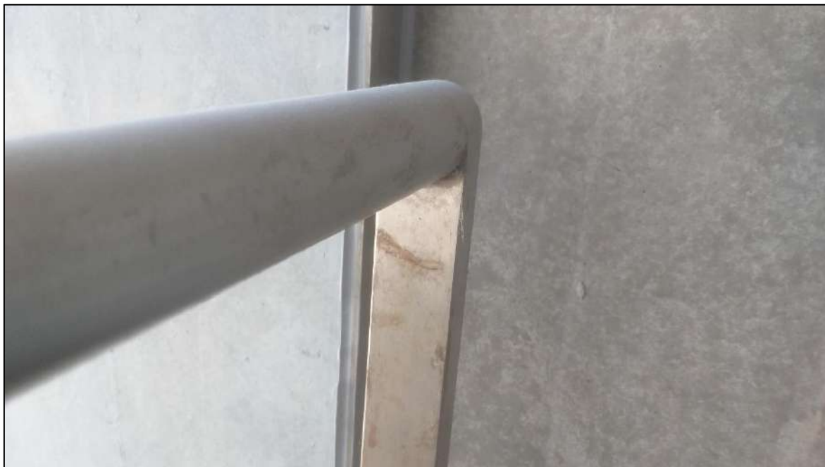
Figura 236: Demonstração da Patologia 1 no corrimão associado ao WW19
