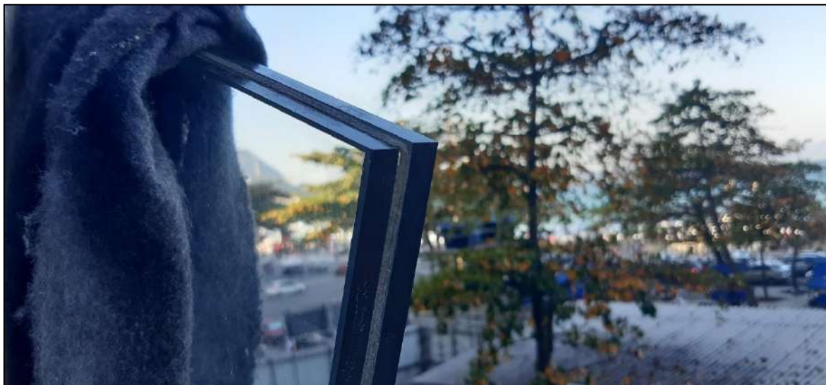
Figura 111: Demonstração da Patologia 1 no guarda corpo G1B
