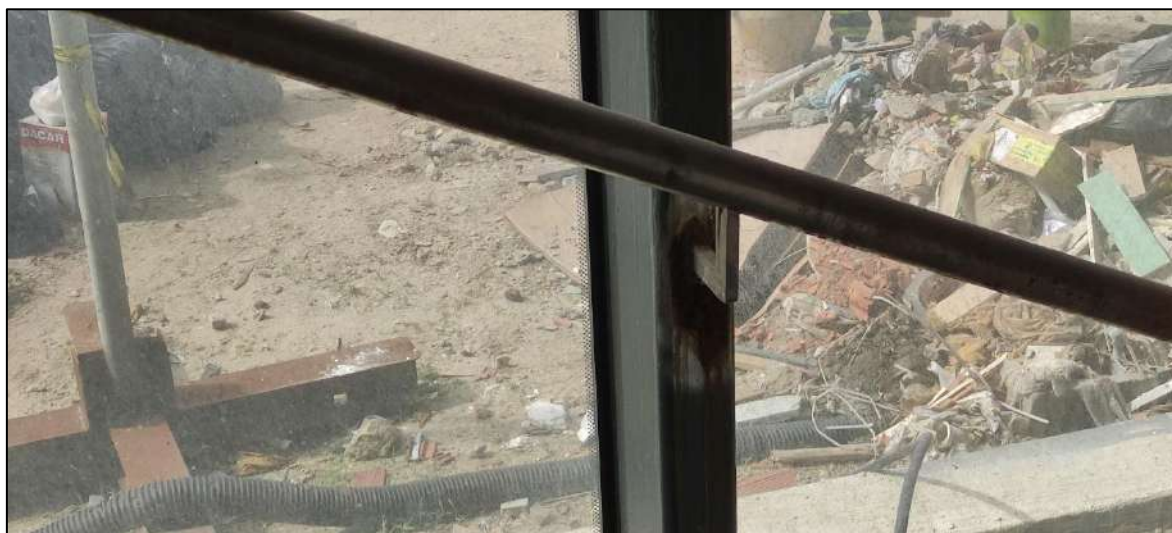
Figura 72: Demonstração da Patologia 18 no painel WW06
