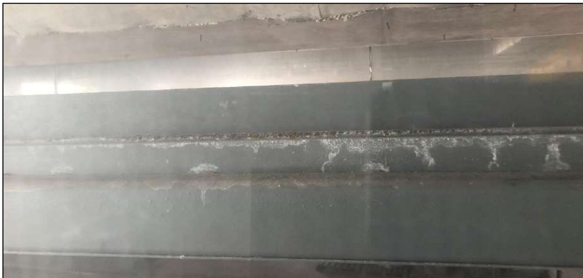
Figura 239: Demonstração da Patologia 1 no 3º pavimento
