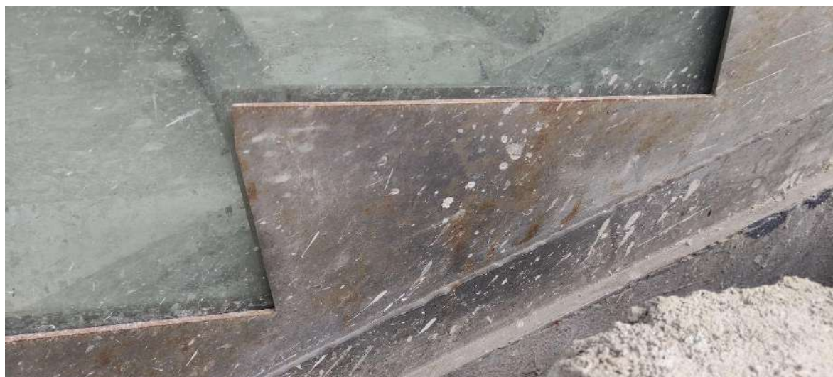
Figura 73: Demonstração da Patologia 19 no painel WW06
