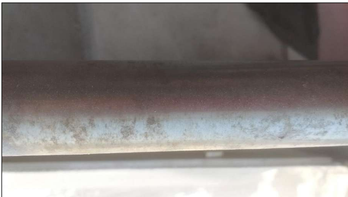
Figura 237: Demonstração da Patologia 1 no corrimão EGR4.1
