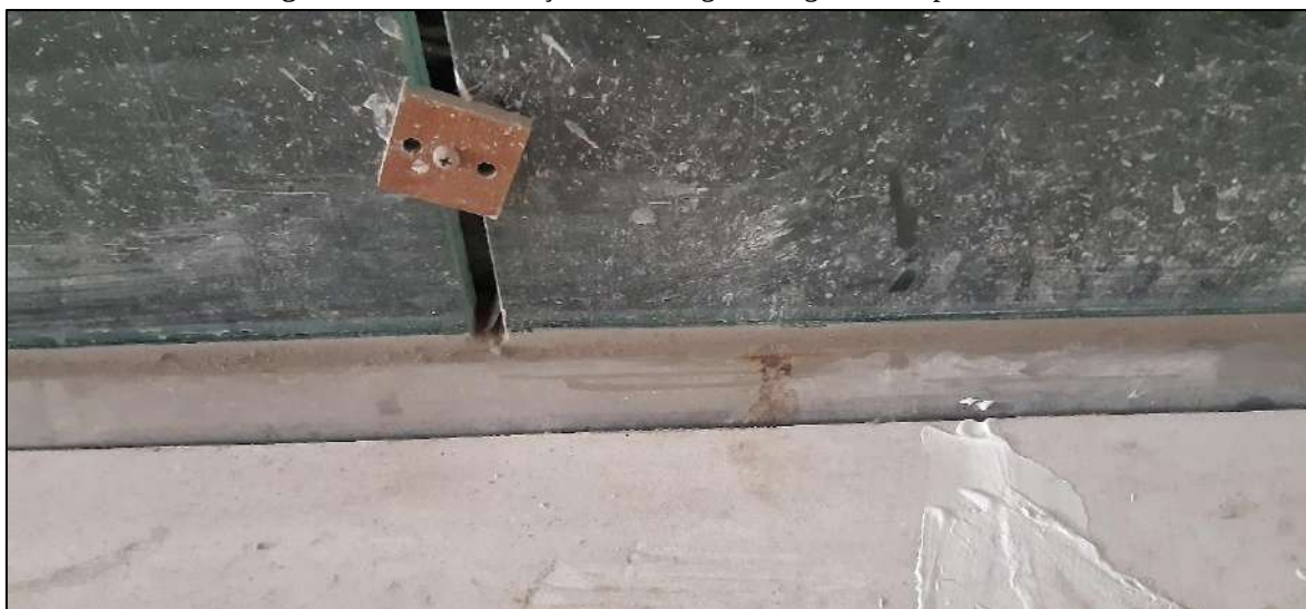
Figura 215: Demonstração da Patologia 9 no guarda-corpo GCI-2f
