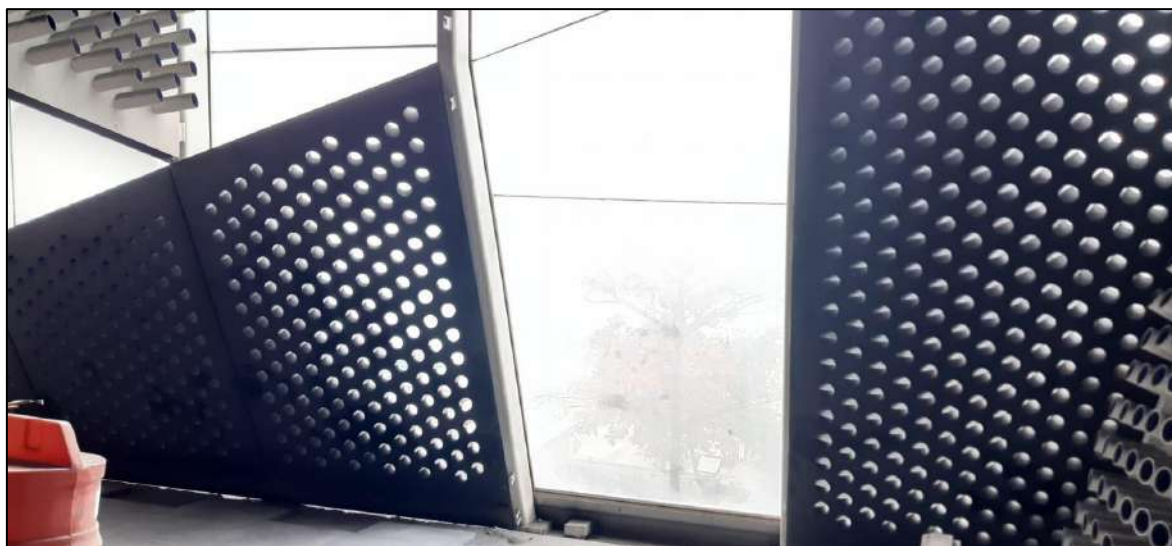
Figura 266: Ausência dos painéis de cobogós
