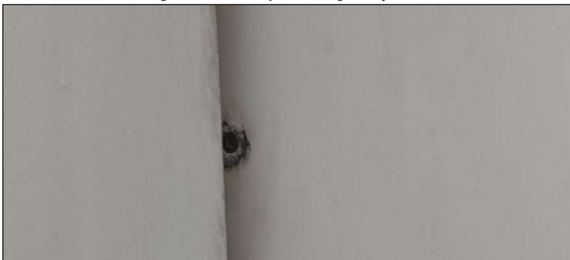
Figura 94: Demonstração da Patologia 2 no painel 2
