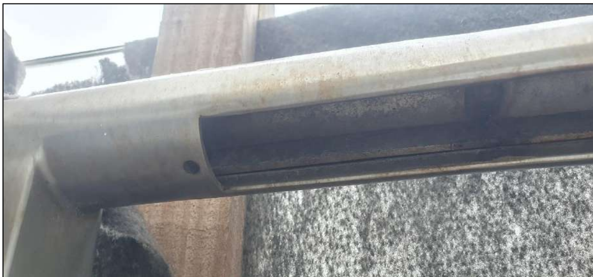
Figura 304: Ausência de iluminação em LED no corrimão no guarda corpo G4A.
