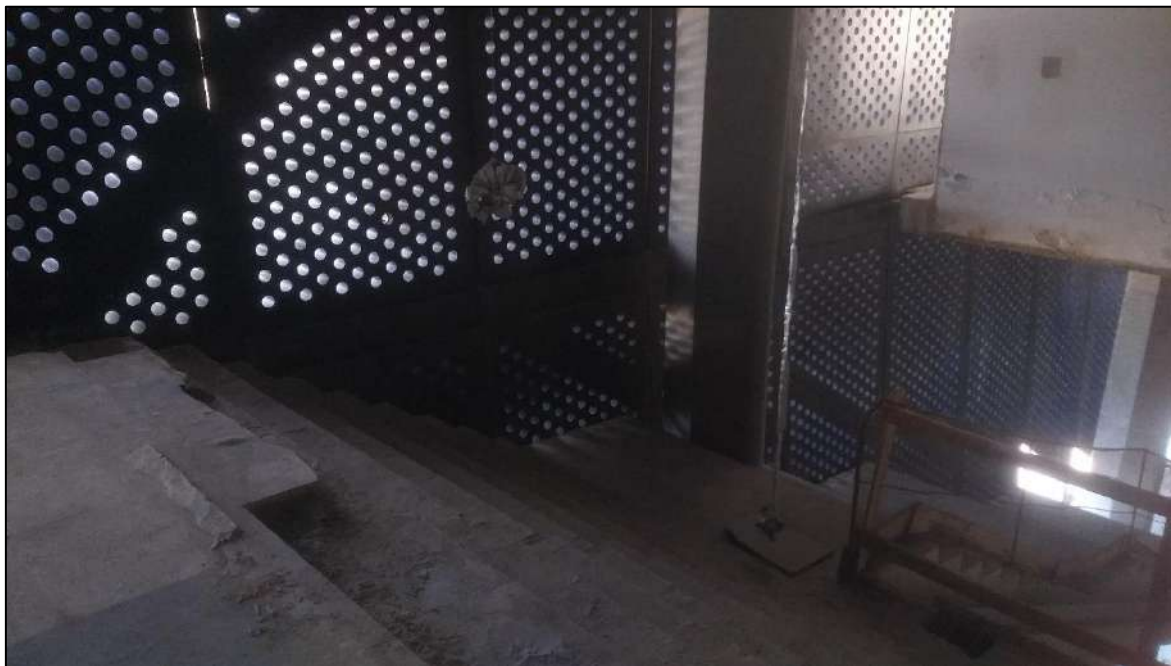
Figura 323: Ausência de corrimão Não Identificado 1 na escada M
