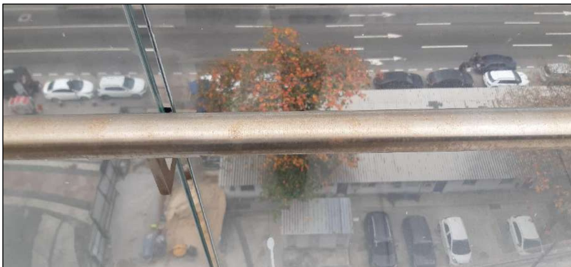
Figura 187: Demonstração da Patologia 17 no guarda-corpo G11A
