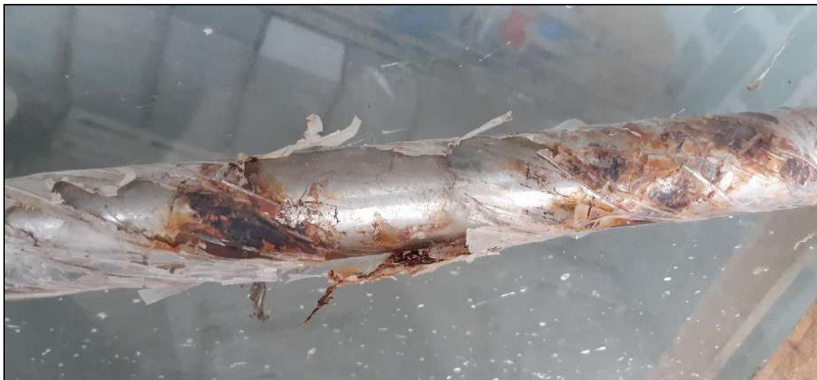
Figura 206: Demonstração da Patologia 7 no guarda-corpo GCI-1b
