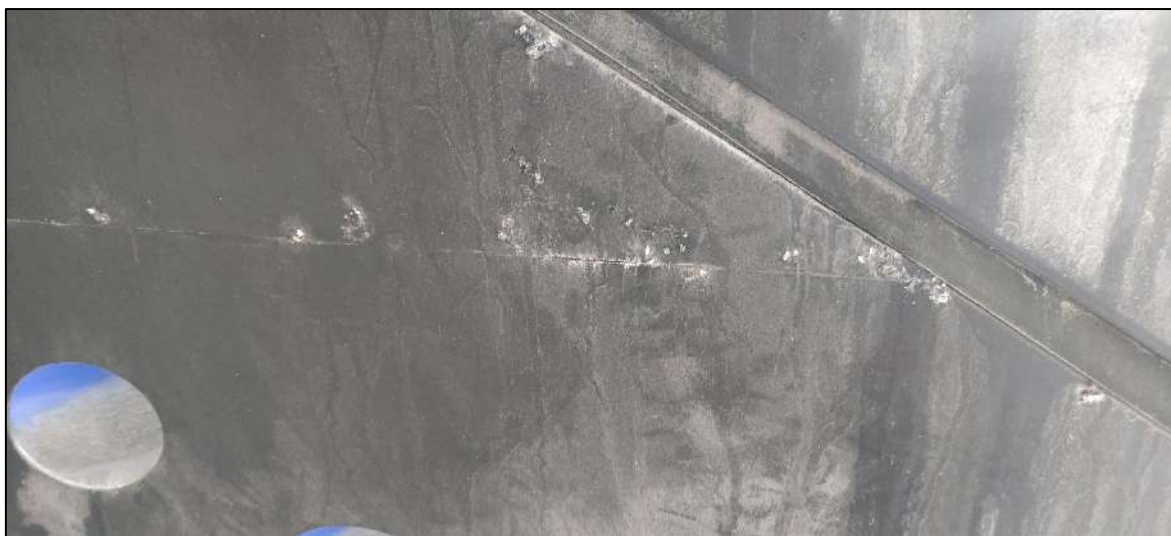
Figura 106: Demonstração da Patologia 8 no painel 3
