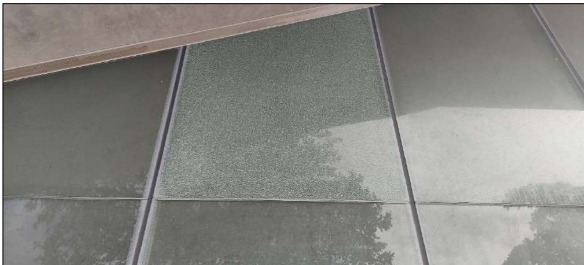
Figura 82: Demonstração da Patologia 2 no painel WW04
