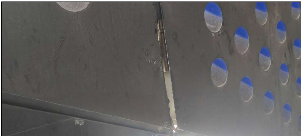
Figura 98: Demonstração da Patologia 3 no painel 2
