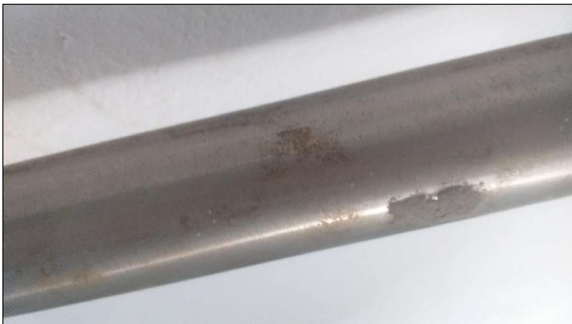
Figura 234: Demonstração da Patologia 1 no corrimão C3
