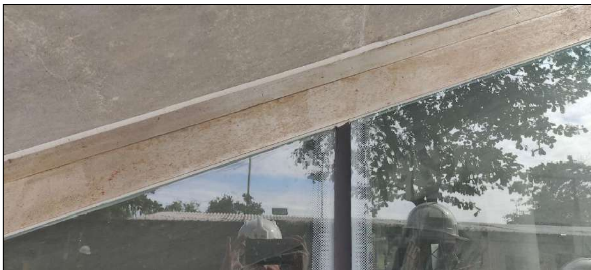
Figura 34: Demonstração da Patologia 7 no painel WW04
