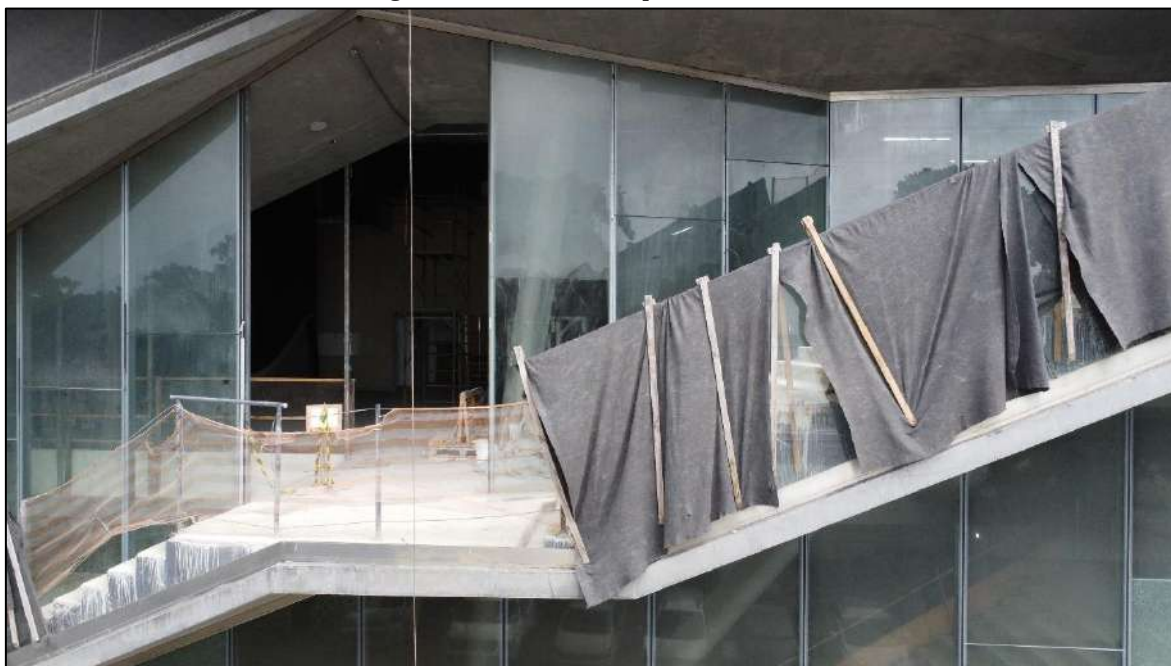
Figura 281: Ausência de painéis de vidro
