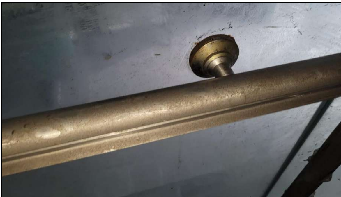
Figura 231: Demonstração da Patologia 12 no guarda-corpo GCI-2d
