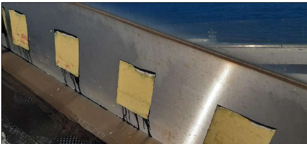
Figura 147: Demonstração da Patologia 9 no guarda corpo G15A
