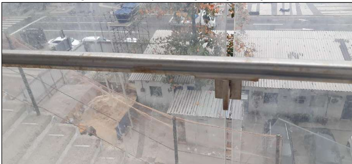
Figura 184: Demonstração da Patologia 17 no guarda-corpo G3
