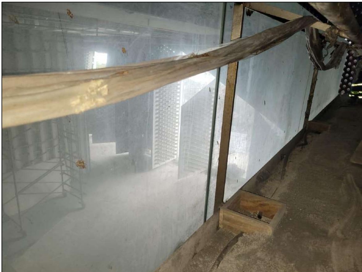
Figura 233: Demonstração da Patologia 13 no guarda-corpo GCI-2d
