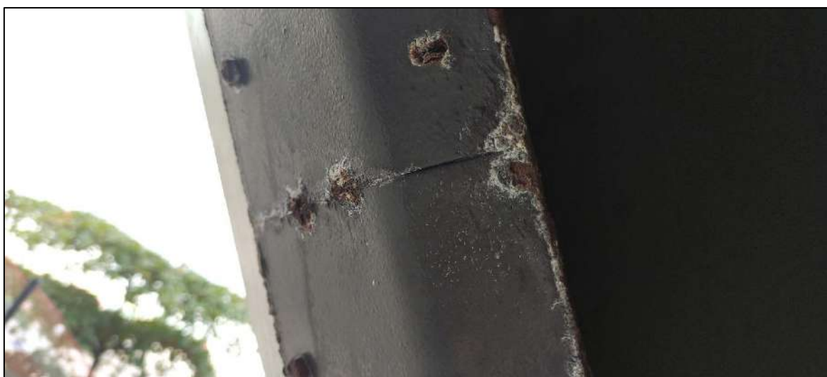
Figura 75: Demonstração da Patologia 21 no painel P2
