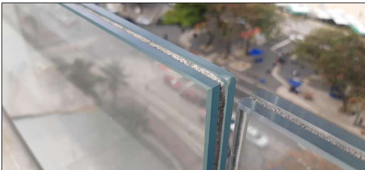
Figura 114: Demonstração da Patologia 1 no guarda corpo G11A
