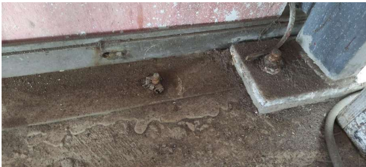
Figura 19: Demonstração da Patologia 1 no painel WW01
