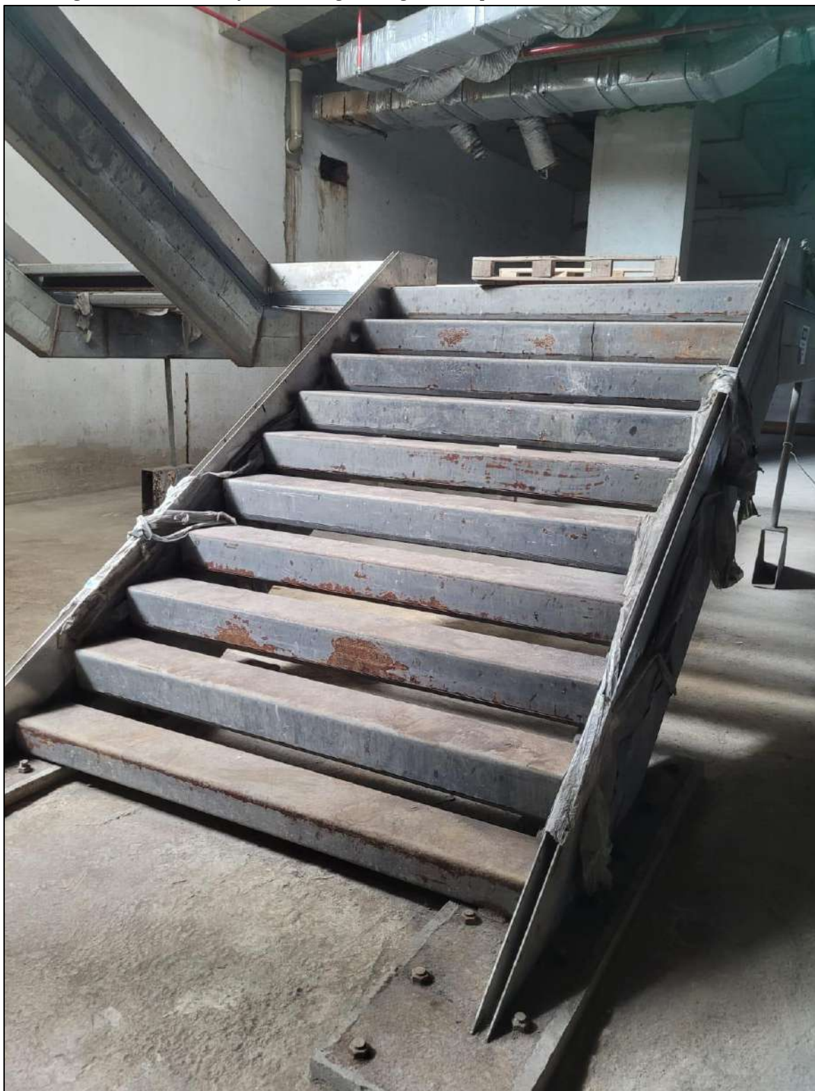
Figura 223: Demonstração da Patologia 9 no guarda-corpo GCI-3a, GCI-3b, GCI-3c e GCI-3d
