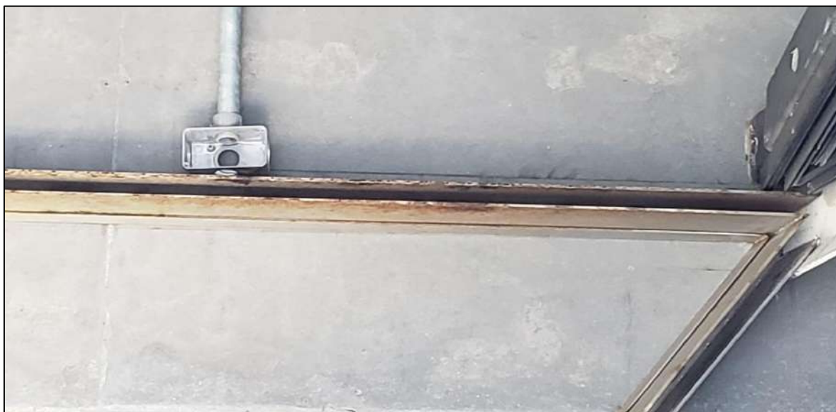
Figura 33: Demonstração da Patologia 7 no painel 4
