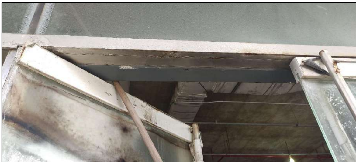
Figura 28: Demonstração da Patologia 5 no painel WW03
