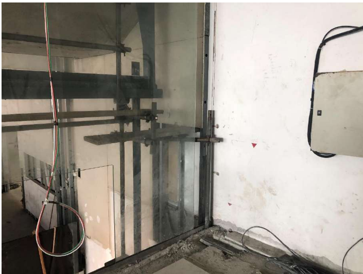
Figura 348: Ausência do vidro da divisória DV8
