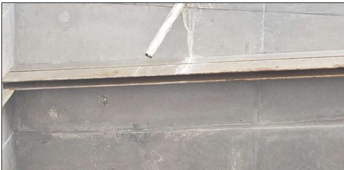
Figura 32: Demonstração da Patologia 7 no painel 3
