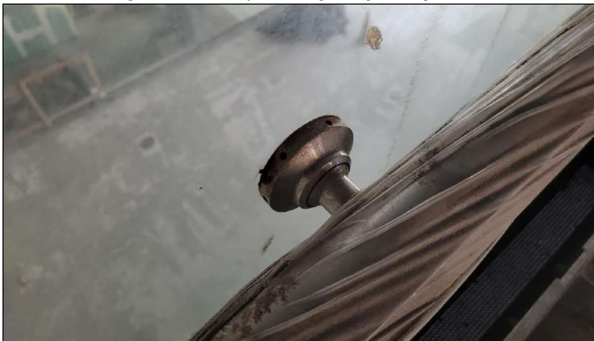
Figura 203: Demonstração da Patologia 6 no guarda-corpo GCI-2b
