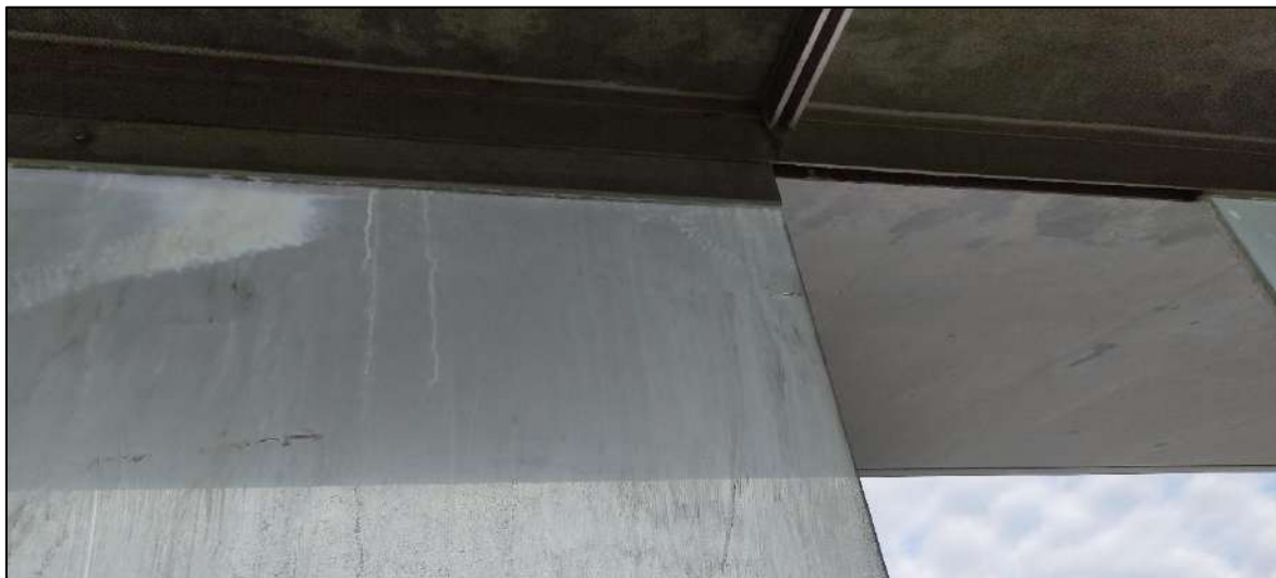
Figura 81: Demonstração da Patologia 1 no painel WW18
