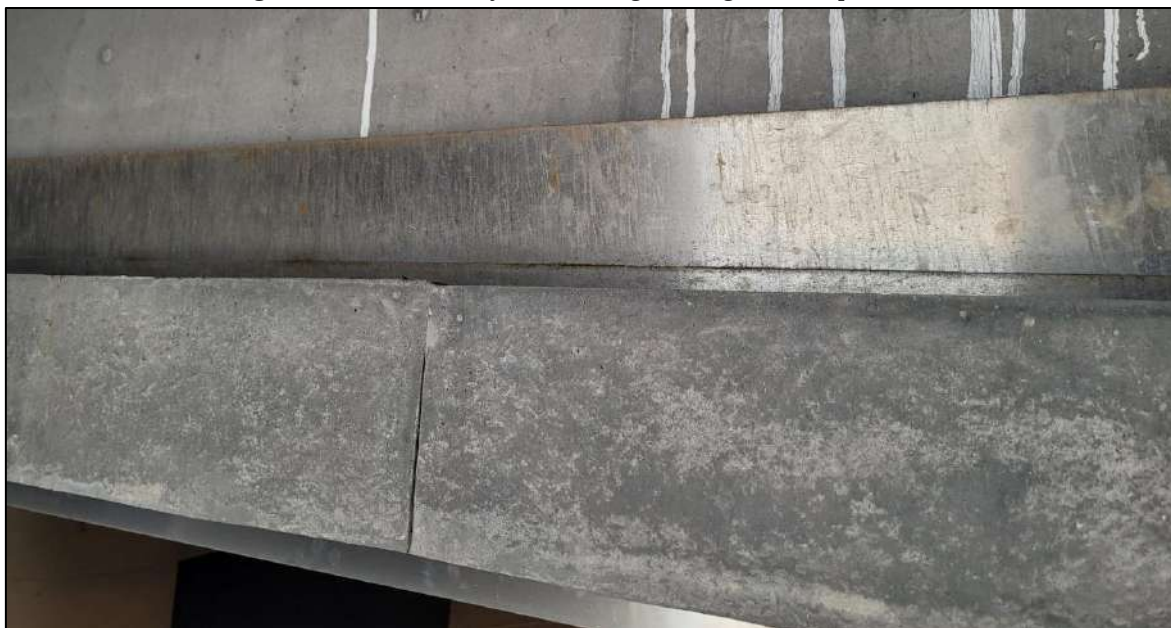
Figura 220: Demonstração da Patologia 9 no guarda-corpo GCI-1f
