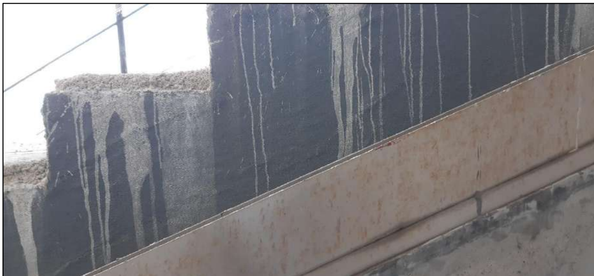
Figura 142: Demonstração da Patologia 9 no guarda corpo G8
