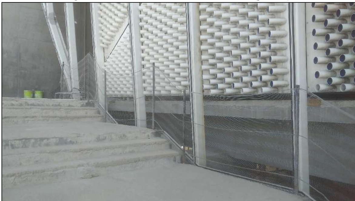
Figura 292: Ausência do corrimão EGR-2.3 na escada K (painel P2)
