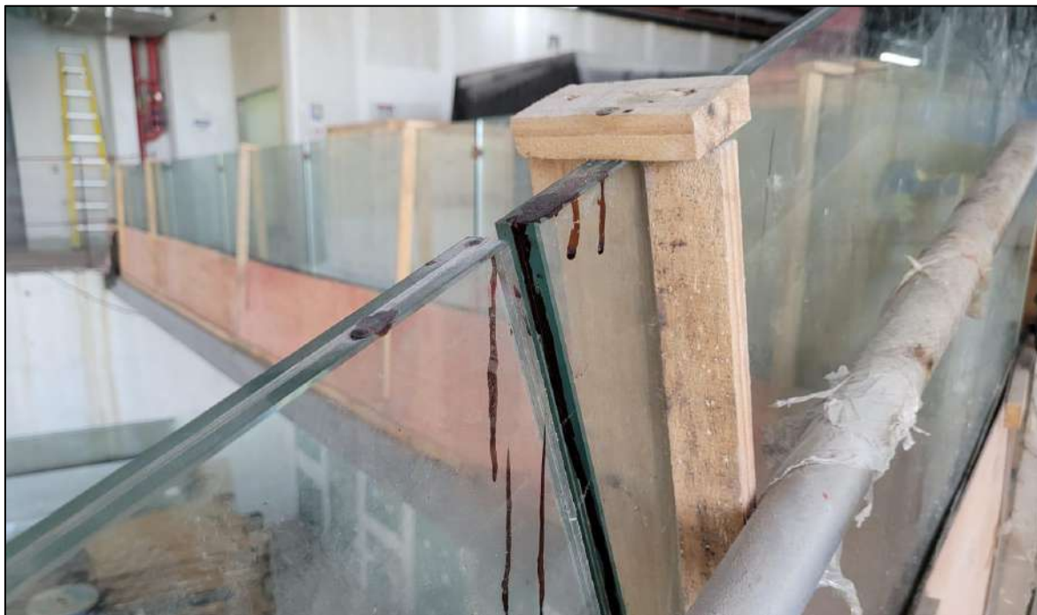
Figura 201: Demonstração da Patologia 6 no guarda-corpo interno GCI-1b
