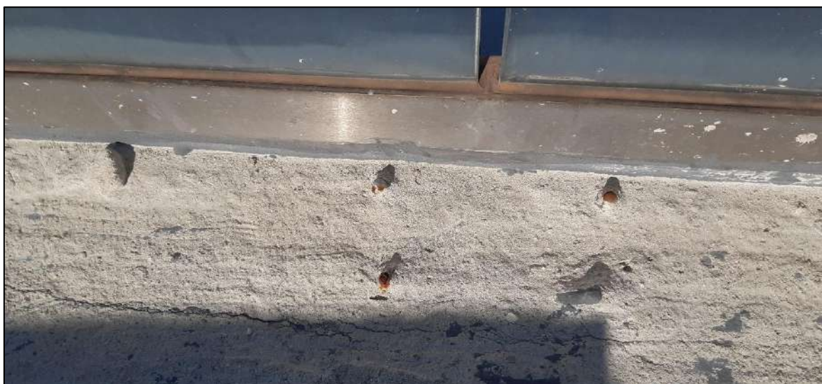
Figura 160: Demonstração da Patologia 10 no guarda corpo G12
