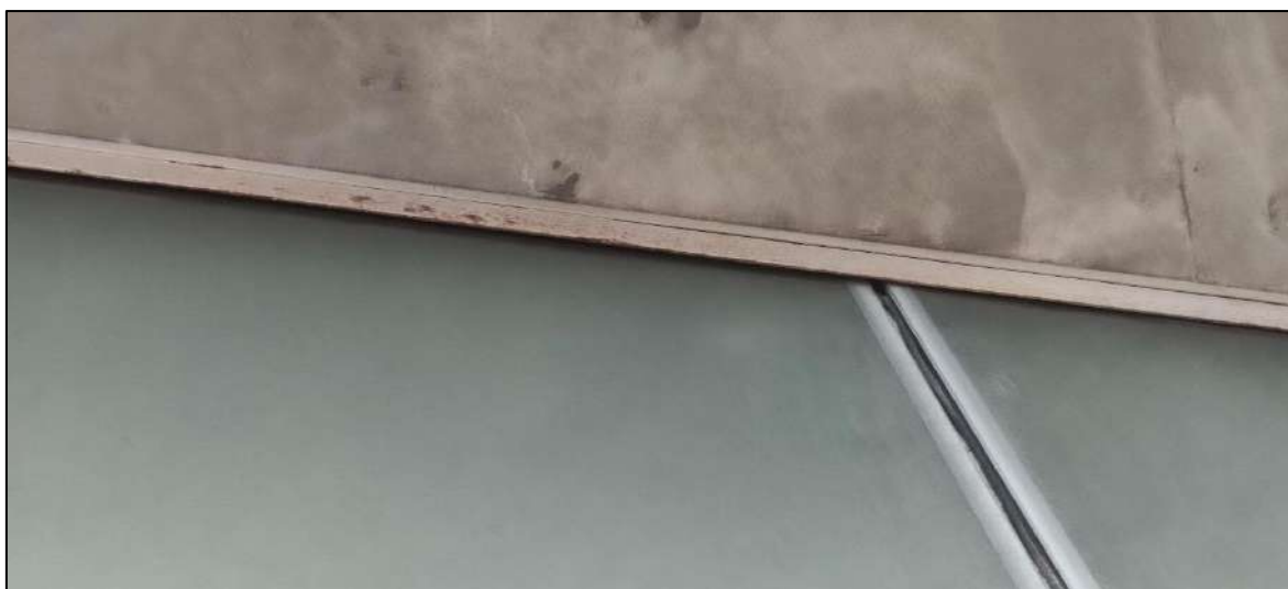
Figura 38: Demonstração da Patologia 7 no painel WW07
