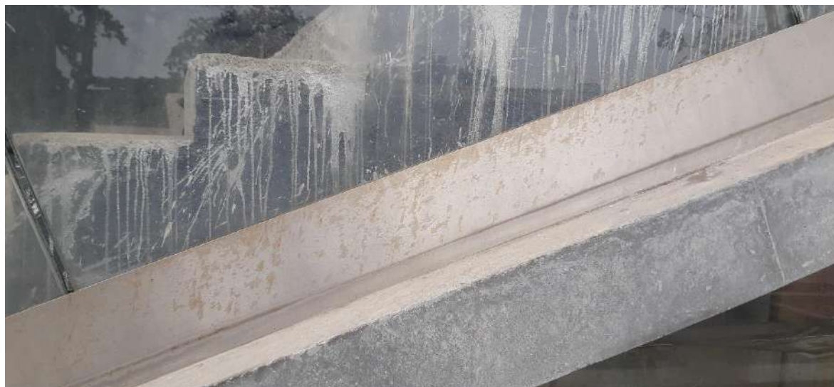
Figura 135: Demonstração da Patologia 9 no guarda corpo G1A
