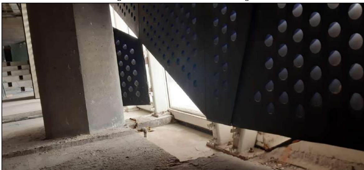
Figura 269: Ausência dos anéis de cobogós
