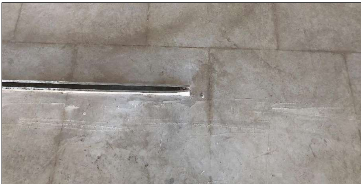
Figura 251: Demonstração da Patologia 7 no 4º pavimento
