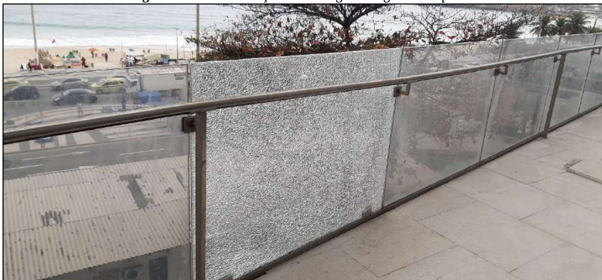
Figura 121: Demonstração da Patologia 2 no guarda corpo G3
