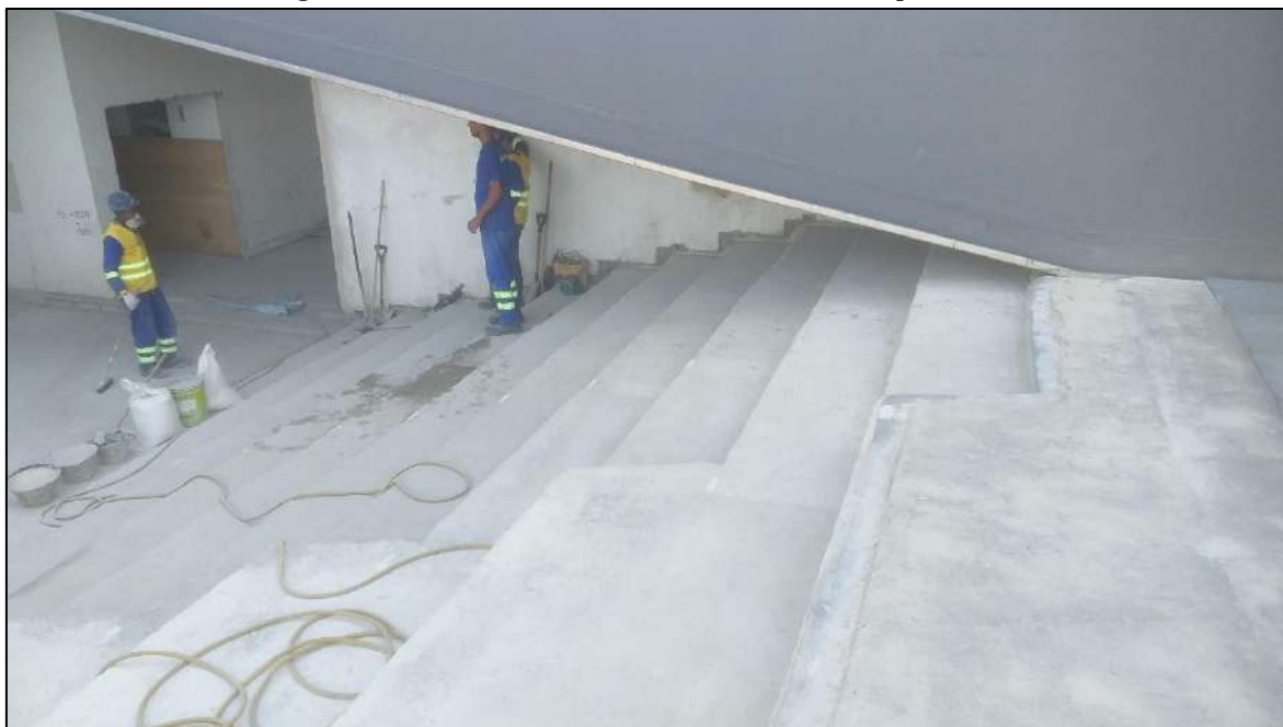
Figura 320: Ausência de corrimão C14 na escada 5º pavimento
