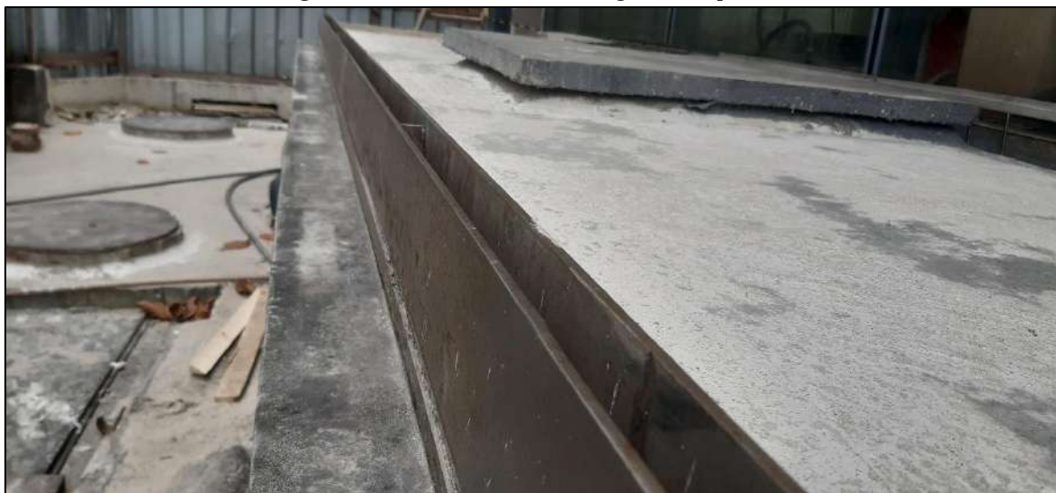
Figura 306: Ausência do vidro no guarda corpo G5.
