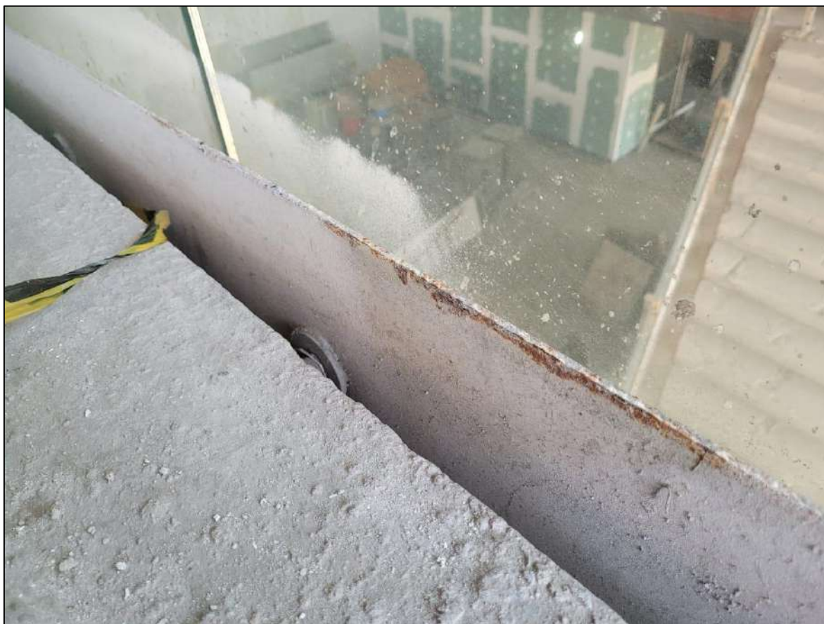
Figura 232: Demonstração da Patologia 13 no guarda-corpo GCI-2a
