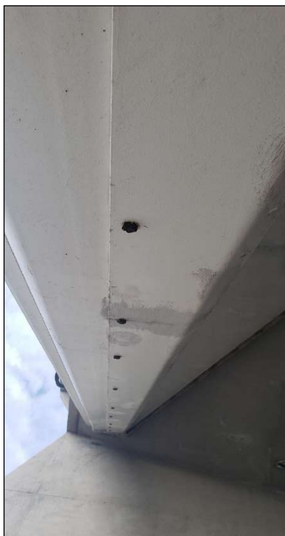
Figura 47: Demonstração da Patologia 9 no painel 3
