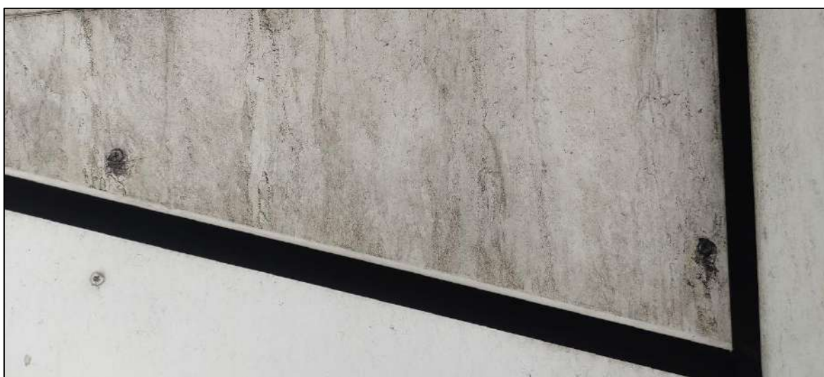
Figura 96: Demonstração da Patologia 2 no painel 4
