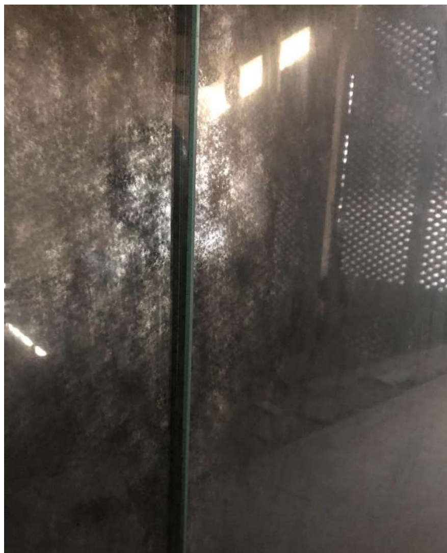
Figura 254: Demonstração da Patologia 9 no 4º pavimento (DV3a)
