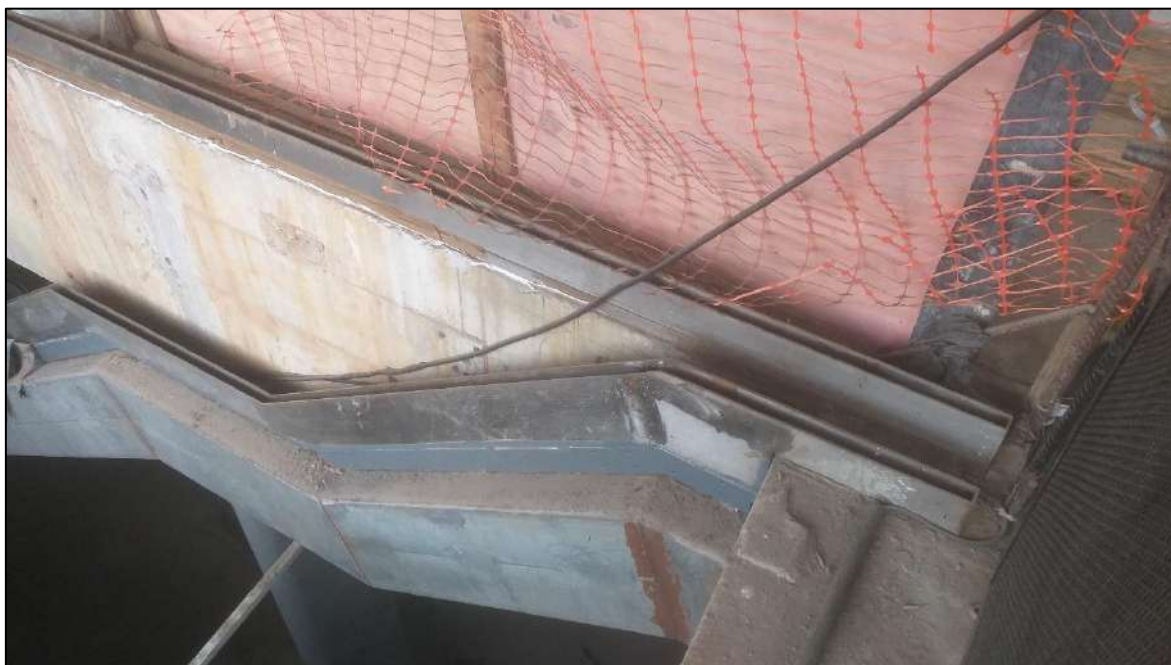
Figura 327: Ausência de vidro e corrimão no guarda corpo GCI-1c
