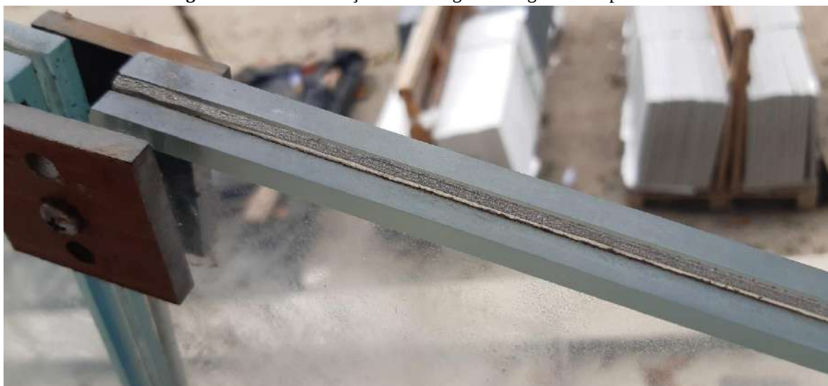
Figura 167: Demonstração da Patologia 14 no guarda-corpo G1A
