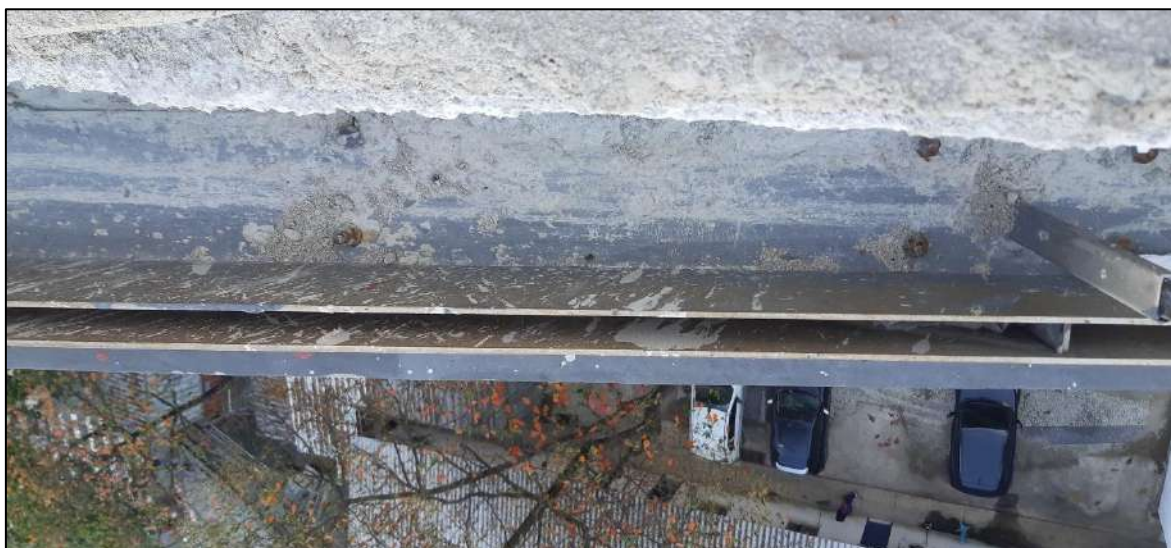
Figura 158: Demonstração da Patologia 10 no guarda corpo G7
