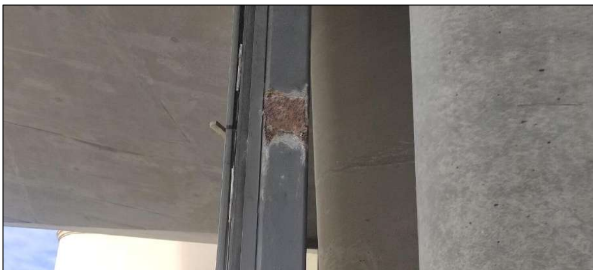
Figura 69: Demonstração da Patologia 17 no painel WW04
