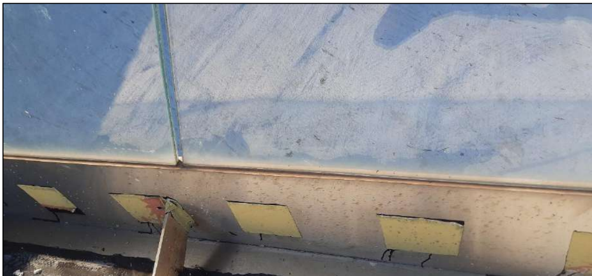
Figura 148: Demonstração da Patologia 9 no guarda corpo G15B
