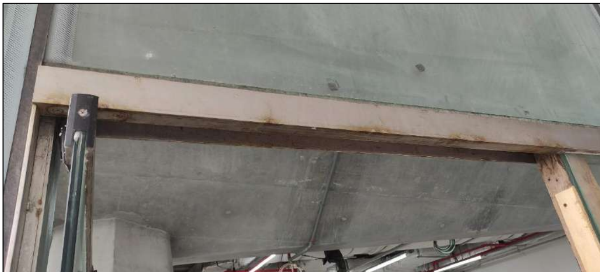
Figura 29: Demonstração da Patologia 5 no painel WW09
