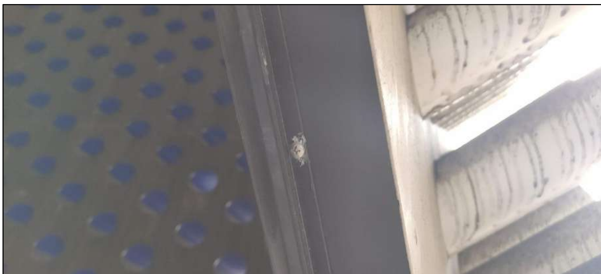
Figura 102: Demonstração da Patologia 5 no painel 2
