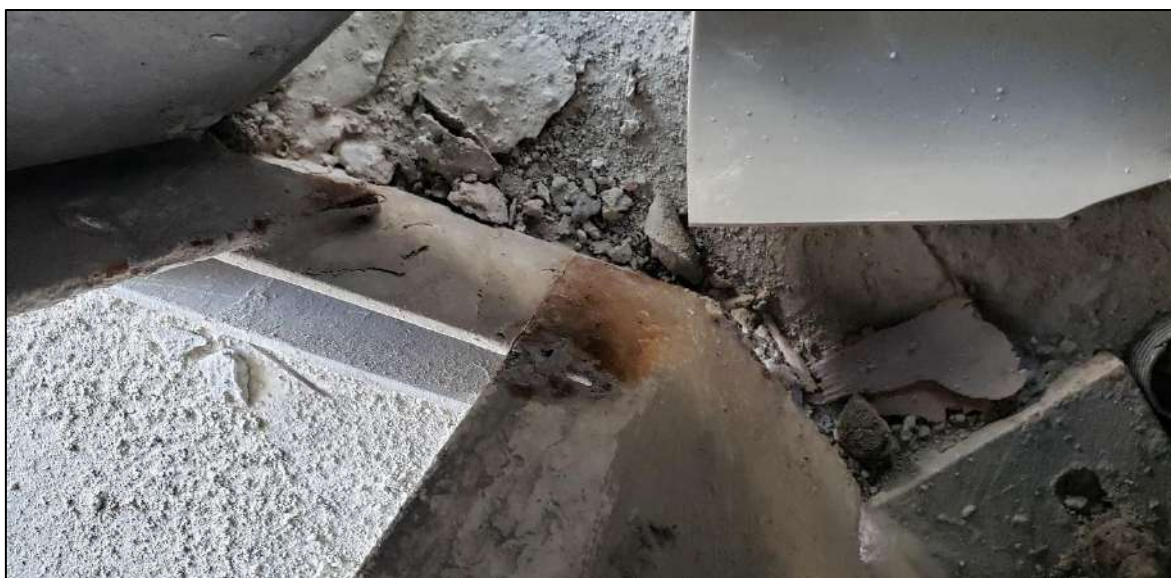
Figura 23: Demonstração da Patologia 3 no painel 4
