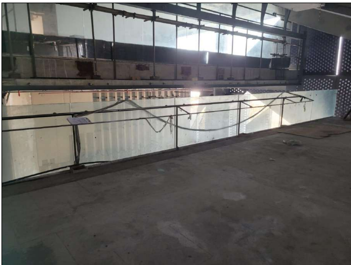
Figura 340: Ausência de corrimão no guarda corpo GCI-2d
