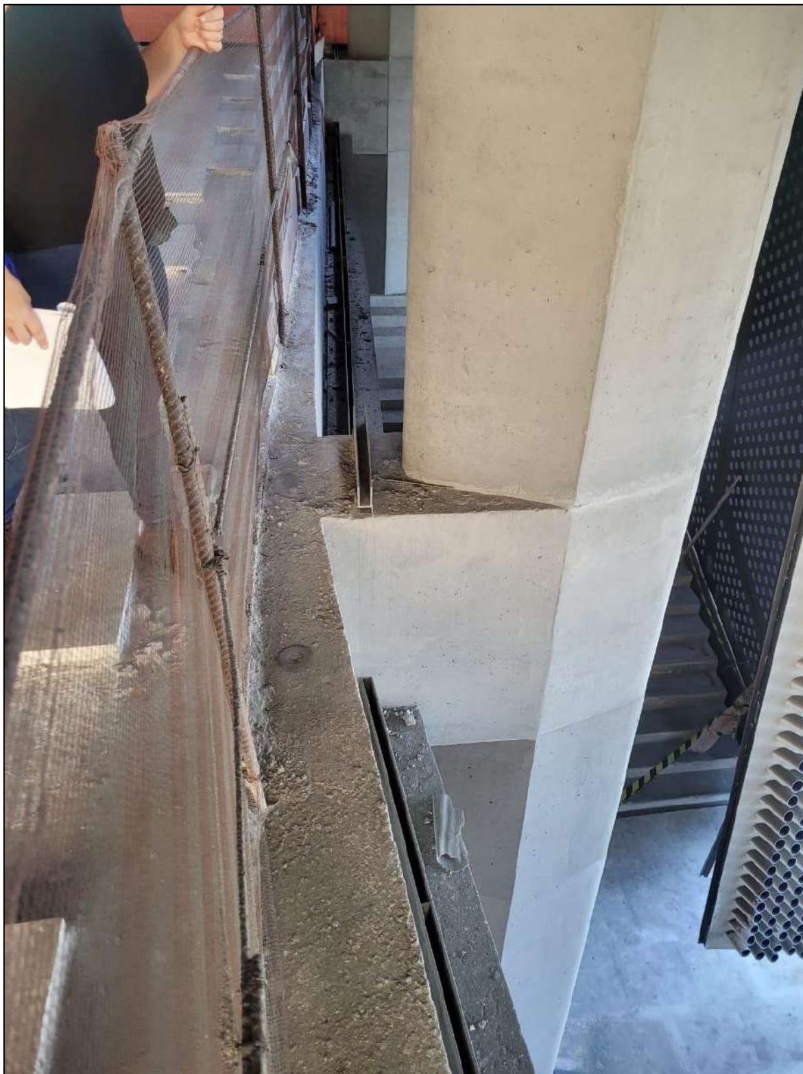
Figura 337: Ausência de vidro no guarda corpo GCI-1f
