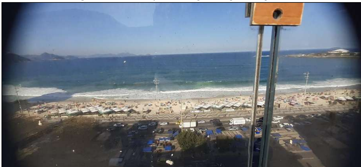
Figura 176: Demonstração da Patologia 14 no guarda-corpo G12
