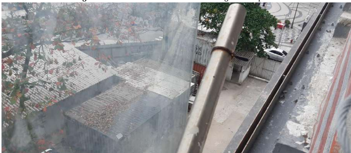
Figura 303: Ausência do vidro e corrimão no guarda corpo G3.
