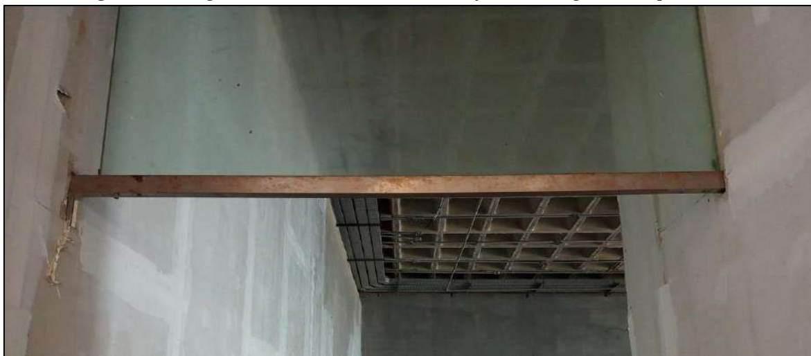
Figura 245: Imagem C - 2º Pavimento – Demonstração da Patologia 3 no 2º pavimento
