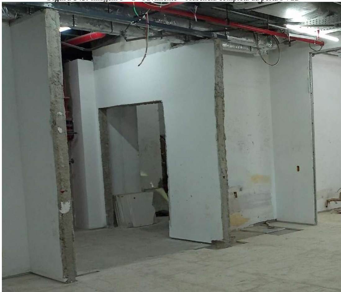
Figura 343: Imagem F - 1 ° Pavimento – Ausência completa da porta PV2a
