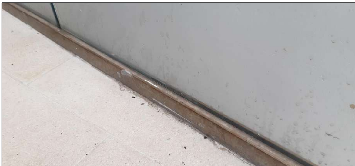
Figura 139: Demonstração da Patologia 9 no guarda corpo G4A
