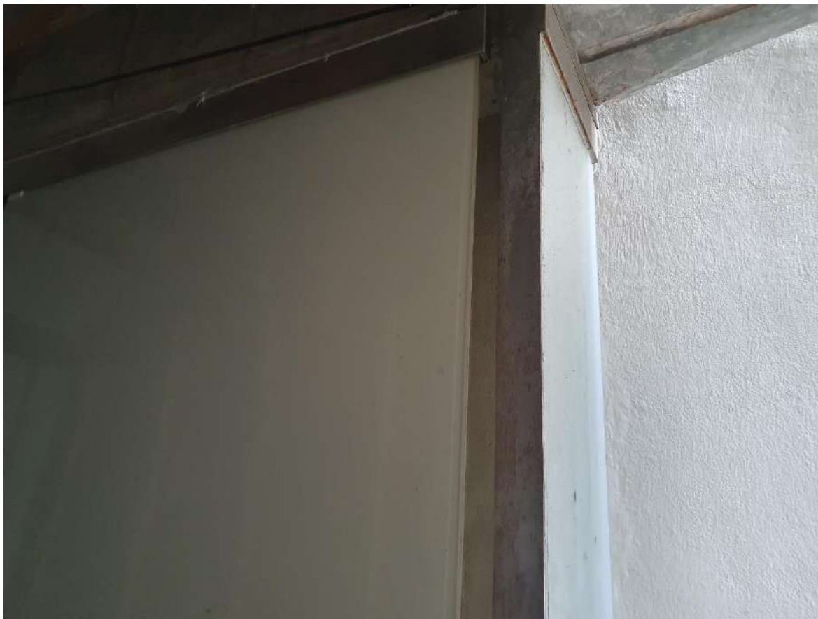
Figura 260: Demonstração da Patologia 2 no EWS 2.4
