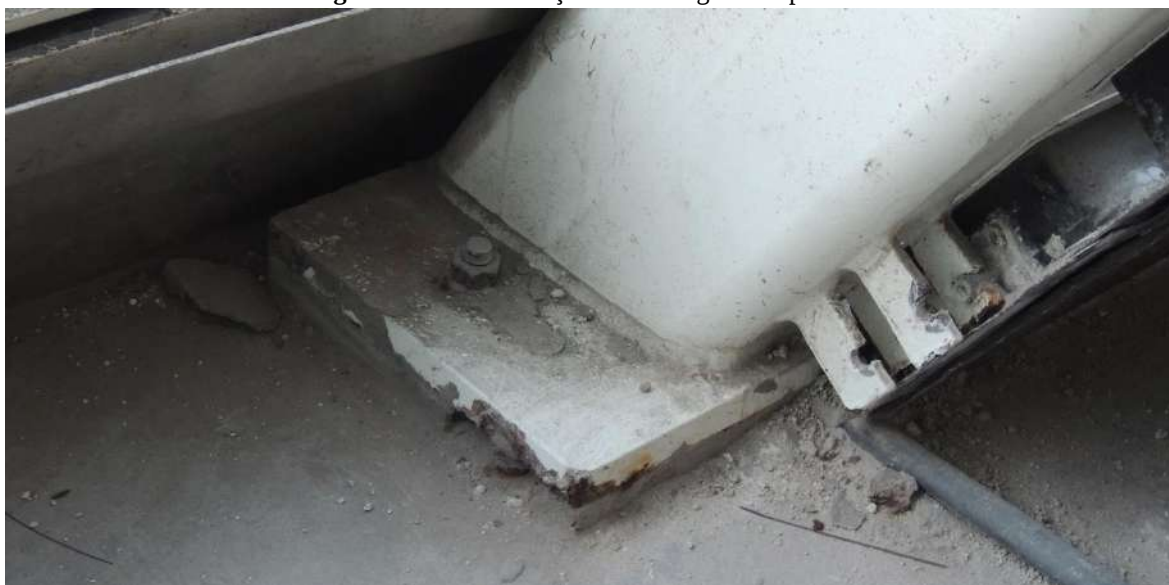
Figura 15: Demonstração da Patologia 1 no painel 1
