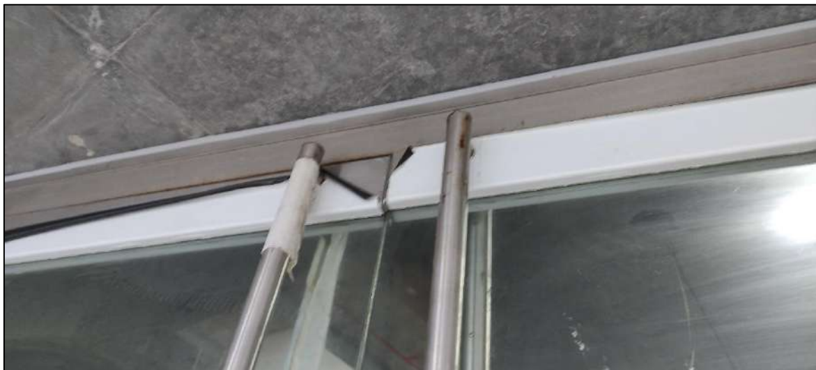
Figura 64: Demonstração da Patologia 15 no painel WW05
