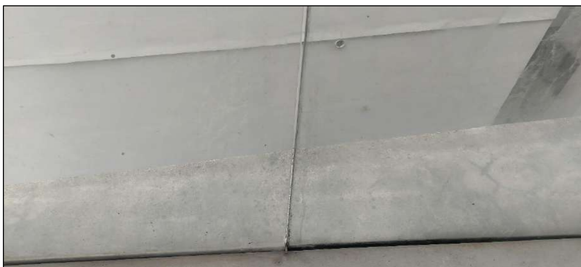
Figura 282: Ausência de silicone nas juntas
