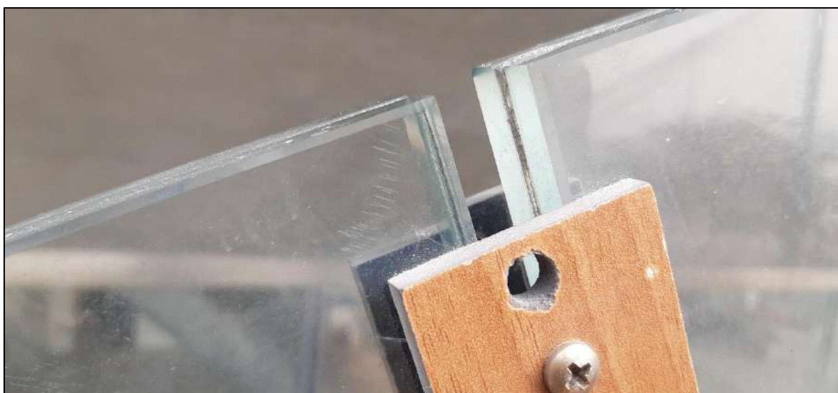
Figura 169: Demonstração da Patologia 14 no guarda-corpo G2
