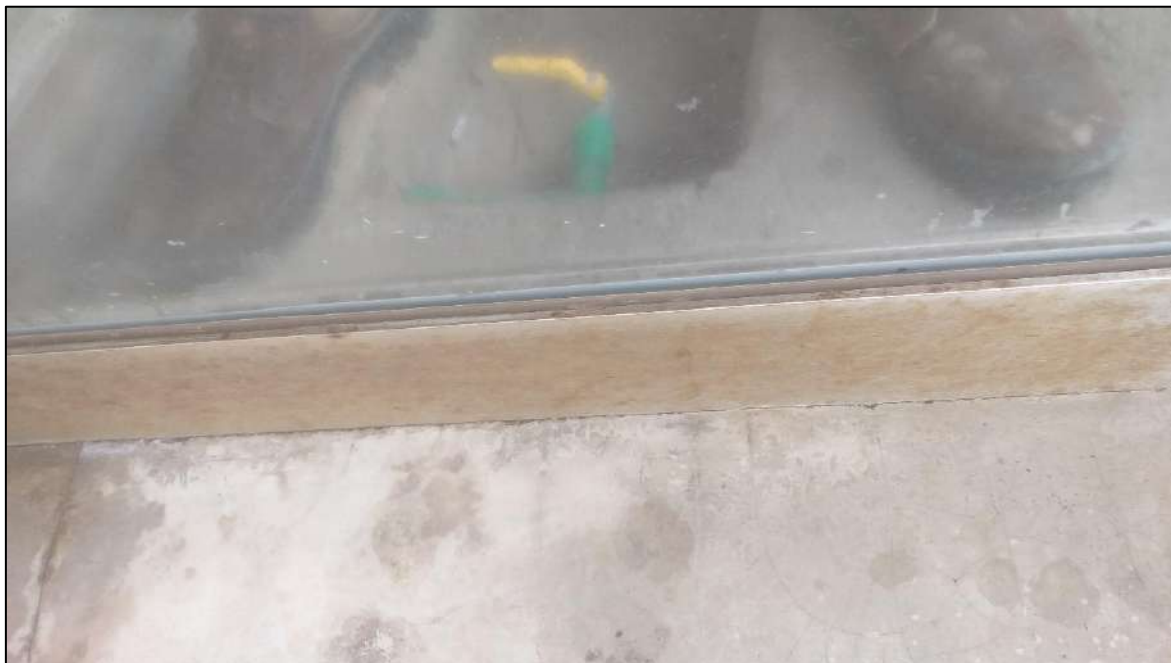
Figura 150: Demonstração da Patologia 9 no guarda corpo G10
