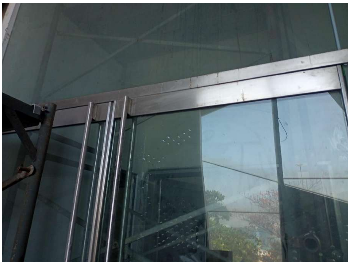
Figura 255: Demonstração da Patologia 10 no 1º Pavimento
