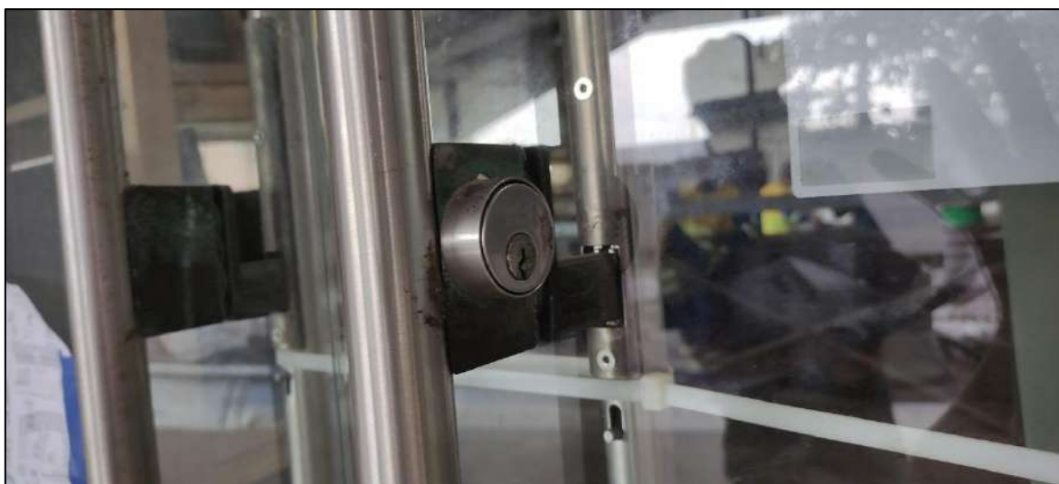
Figura 63: Demonstração da Patologia 15 no painel WW05
