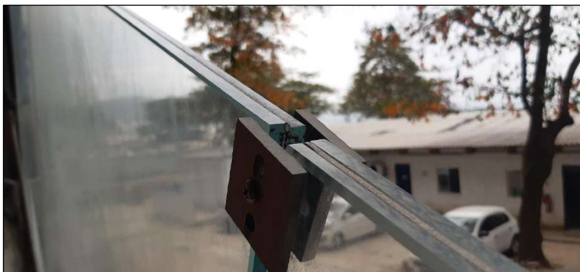
Figura 110: Demonstração da Patologia 1 no guarda corpo G1A
