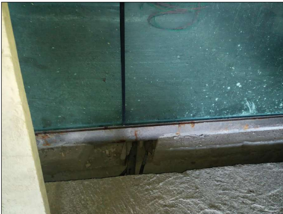
Figura 249: Imagem A - 2º Pavimento – Demonstração da Patologia 5 no 2º pavimento
