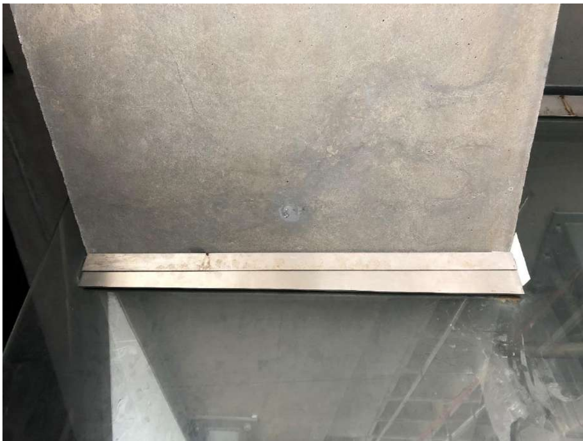
Figura 9: Recorte na divisória DV8 com acabamento metálico devido à conflito com escada L (superior) não previsto em projeto
