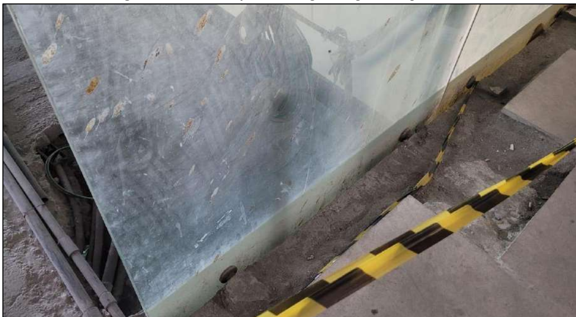
Figura 205: Demonstração da Patologia 6 no guarda corpo GCI-1h
