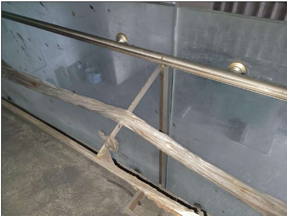
Figura 360: Ausência de vidro na Mesa Interativa do 3º Pavimento
