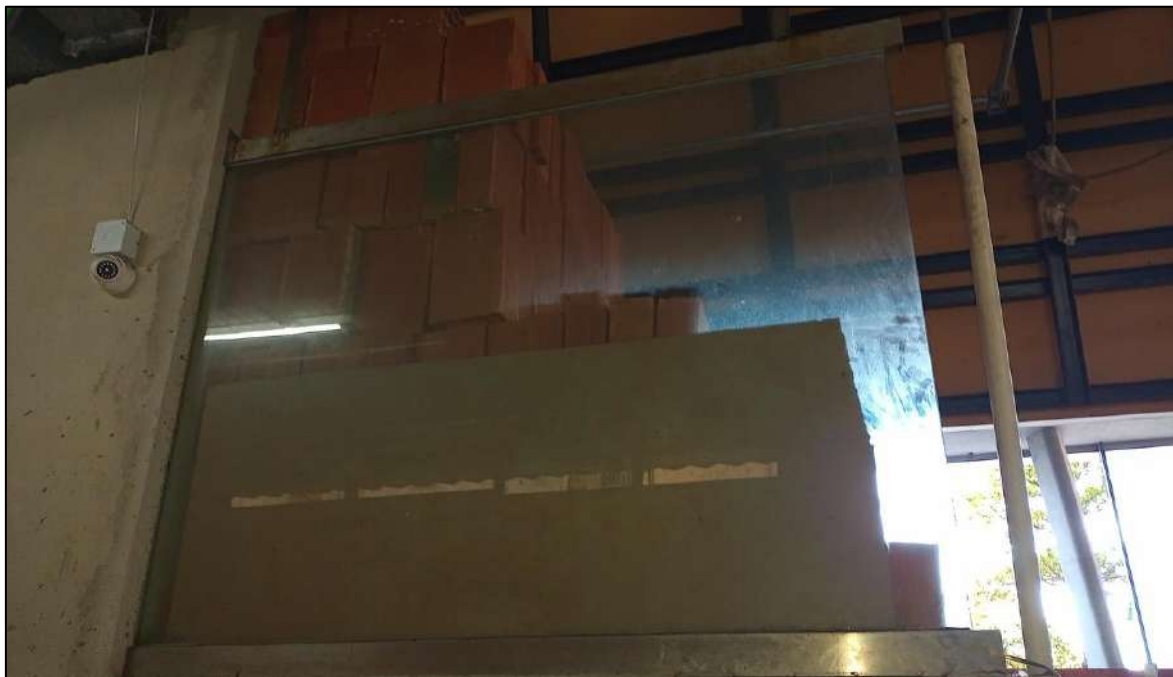
Figura 243: Imagem A – Térreo – Demonstração da Patologia 3 no Térreo
