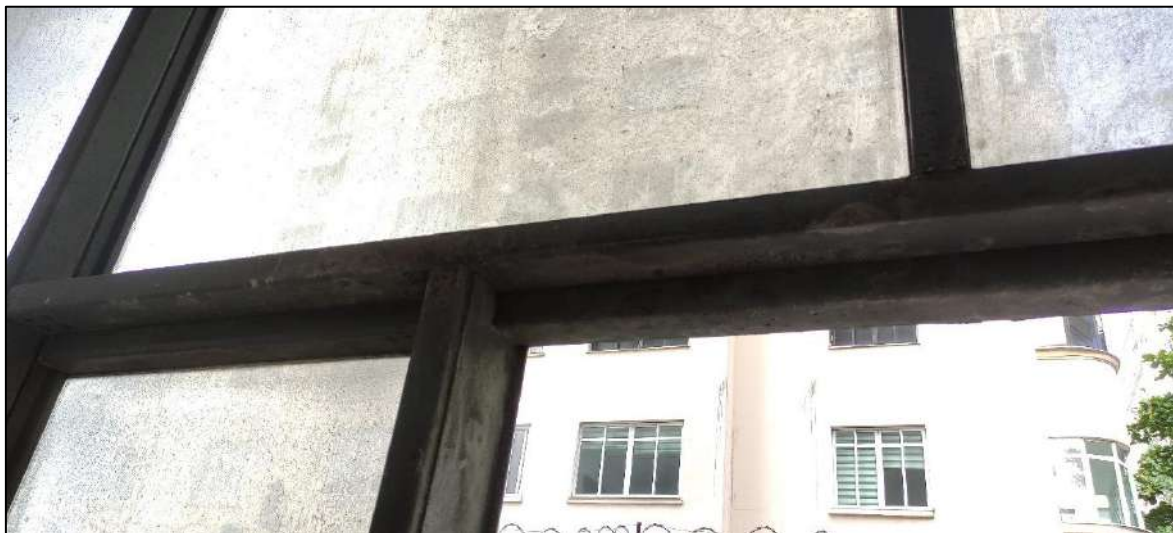
Figura 70: Demonstração da Patologia 17 no painel WW01
