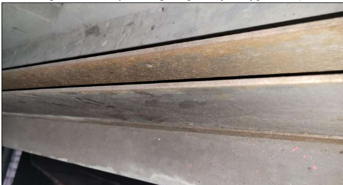
Figura 221: Demonstração da Patologia 9 no guarda-corpo GCI-1j (perfil inferior)
