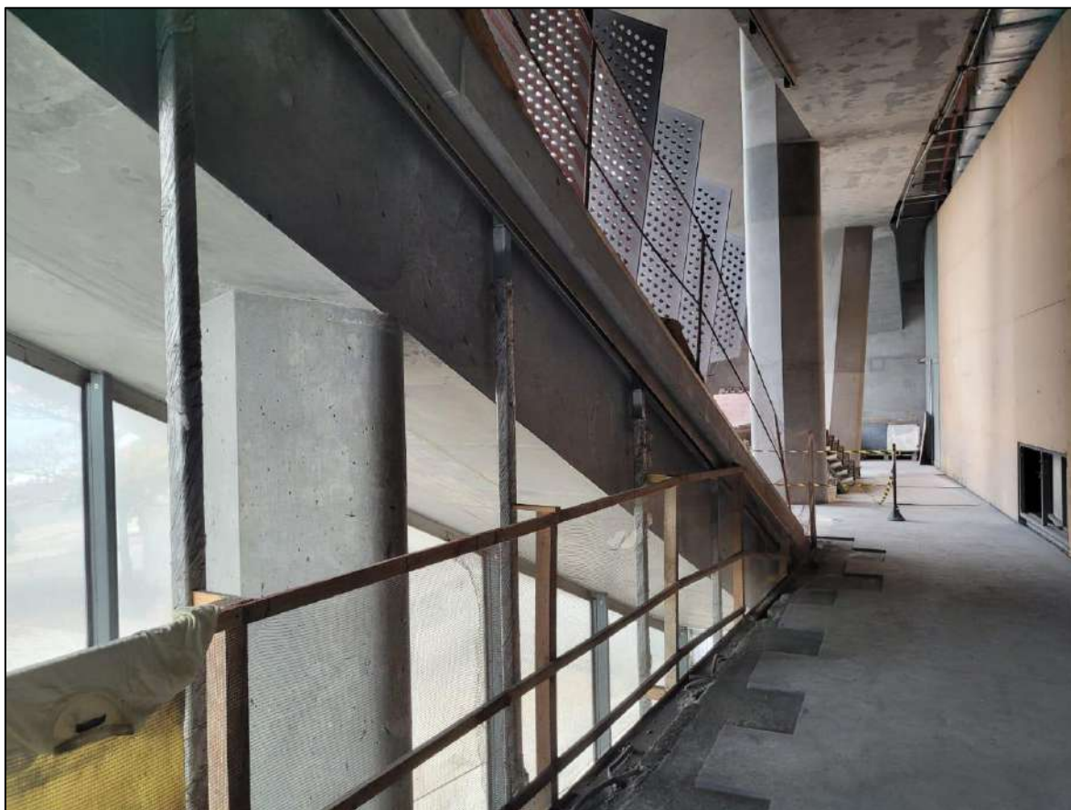
Figura 330: Ausência de vidro no guarda corpo GCI-1d
