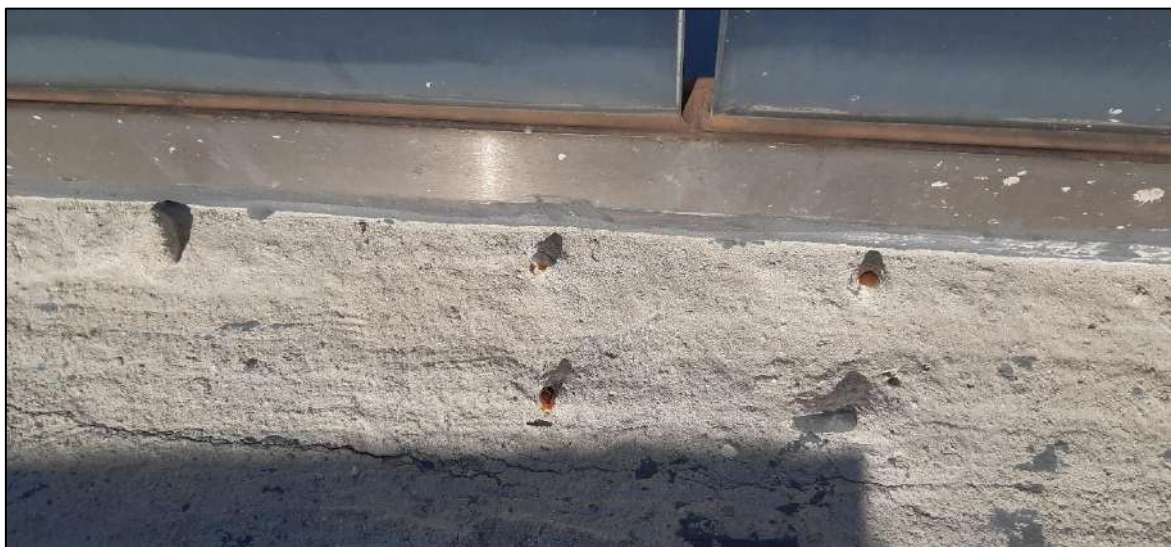
Figura 144: Demonstração da Patologia 9 no guarda corpo G12
