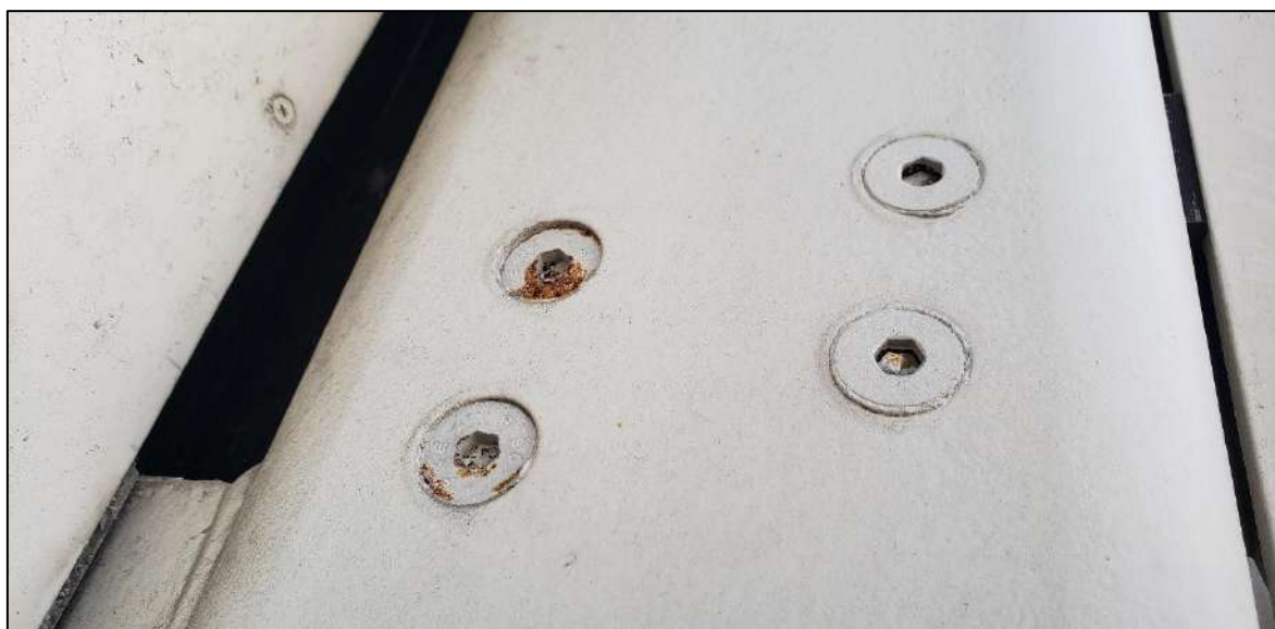
Figura 52: Demonstração da Patologia 12 no painel 4
