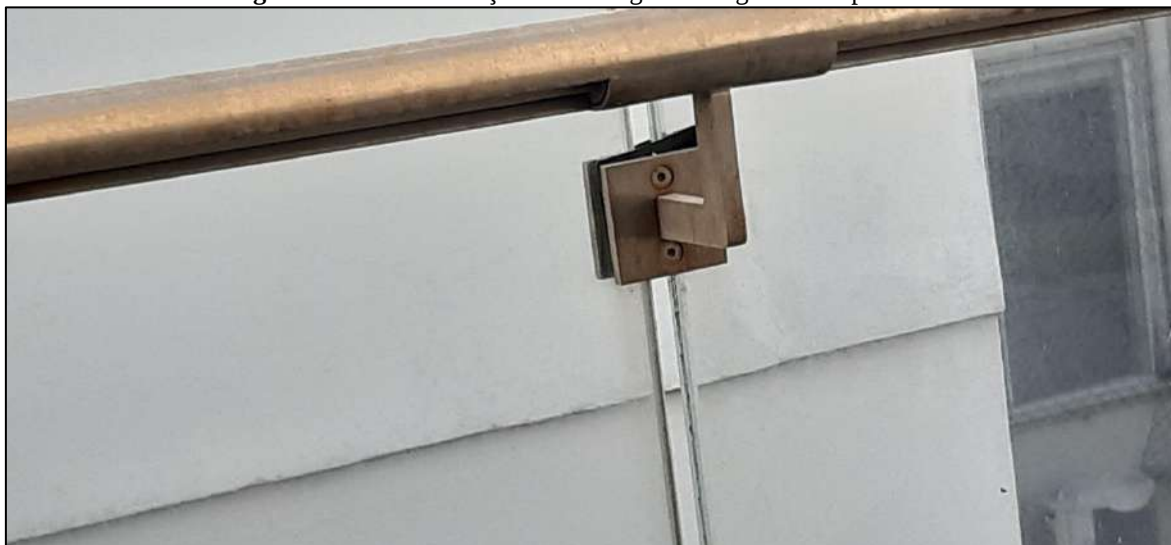
Figura 166: Demonstração da Patologia 13 no guarda-corpo G11B
