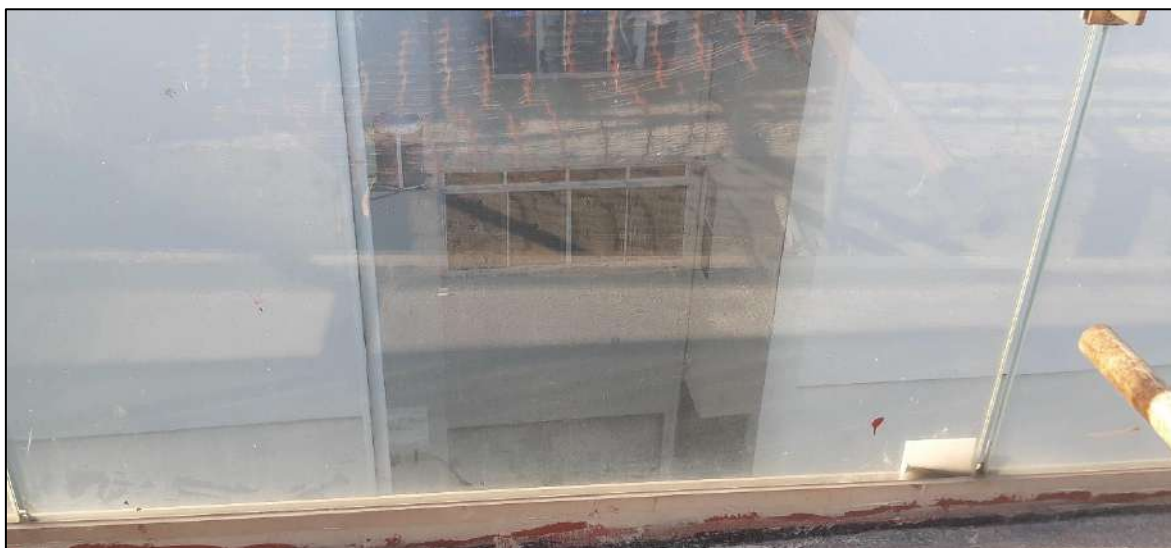
Figura 143: Demonstração da Patologia 9 no guarda corpo G11B
