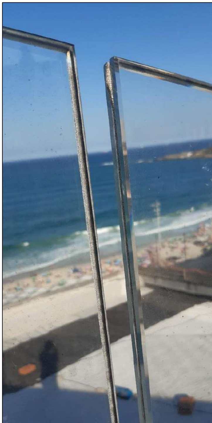
Figura 178: Demonstração da Patologia 14 no guarda-corpo G15A
