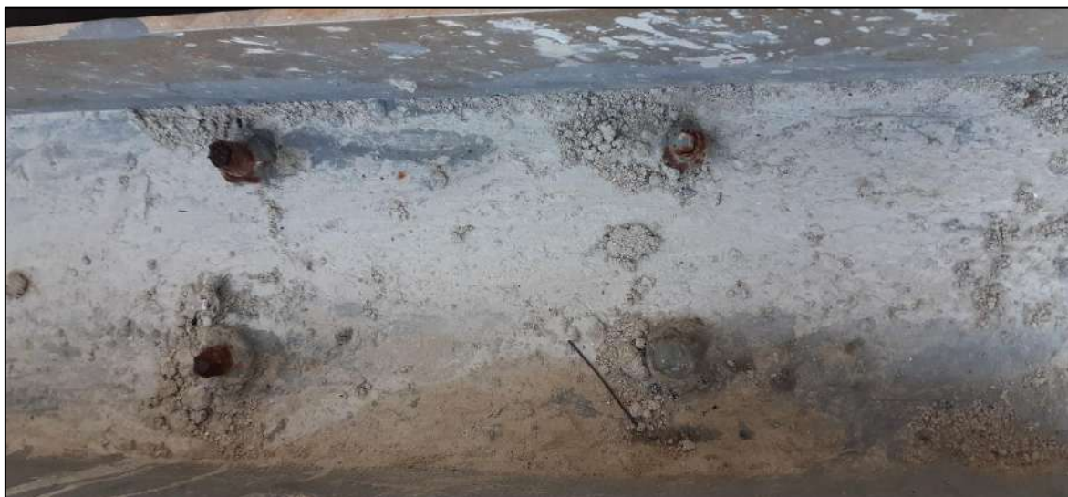
Figura 159: Demonstração da Patologia 10 no guarda corpo G8
