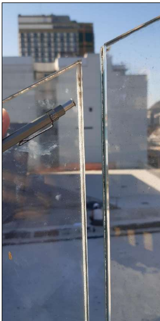
Figura 163: Demonstração da Patologia 11 no guarda-corpo
