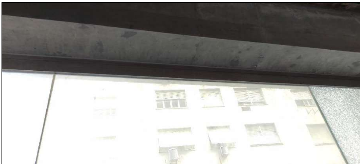
Figura 41: Demonstração da Patologia 7 no painel WW10
