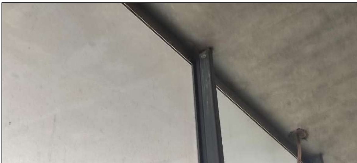
Figura 65: Demonstração da Patologia 16 no painel WW03
