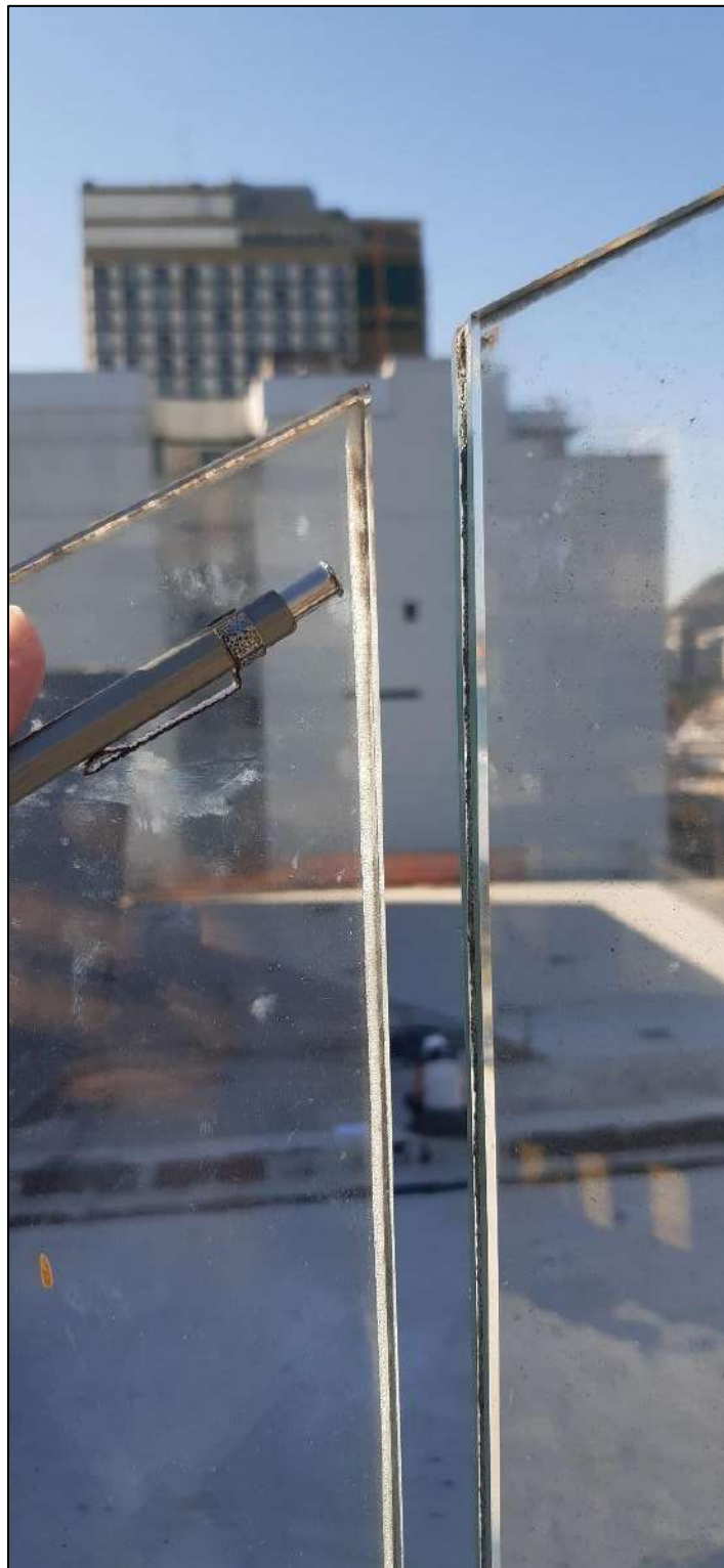
Figura 179: Demonstração da Patologia 14 no guarda-corpo G15B
