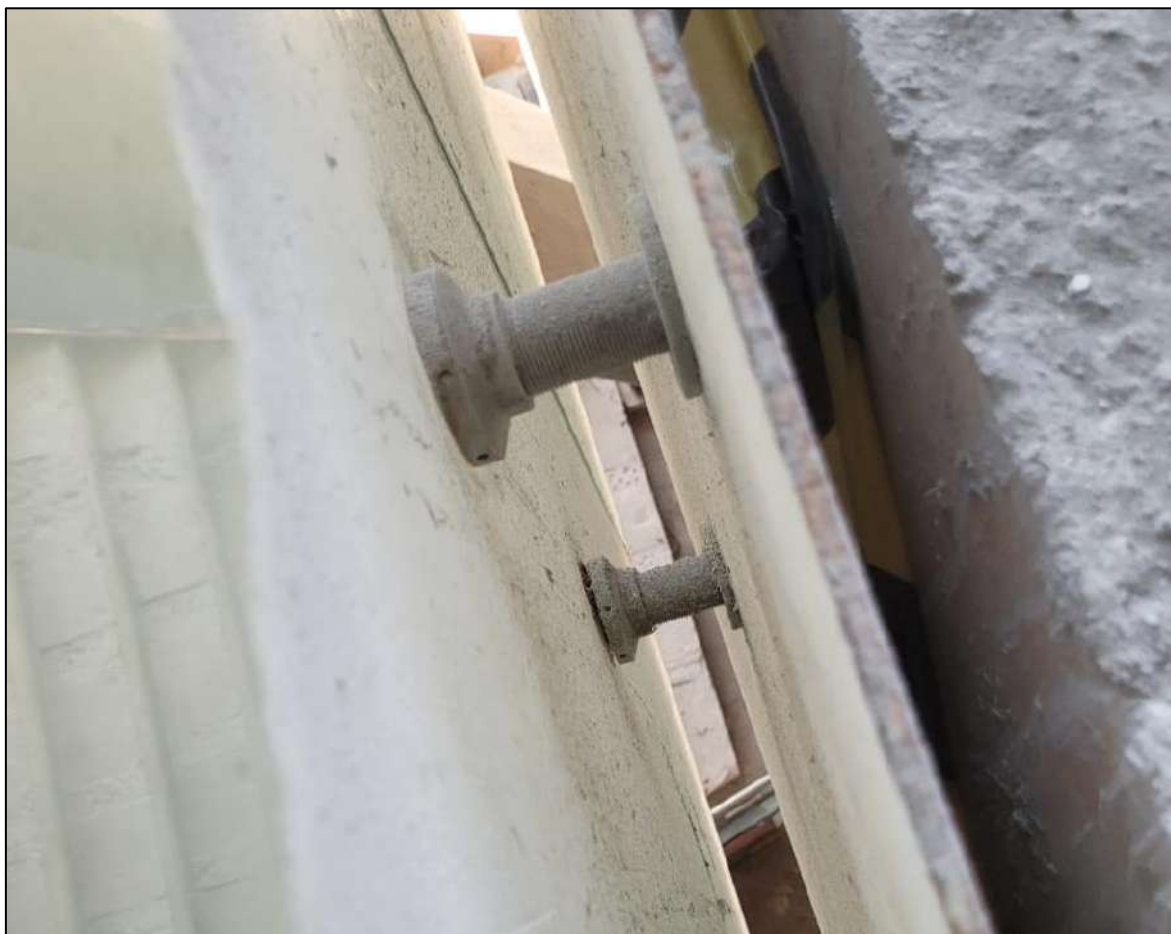
Figura 194: Demonstração da Patologia 3 no guarda-corpo interno GCI-2a
