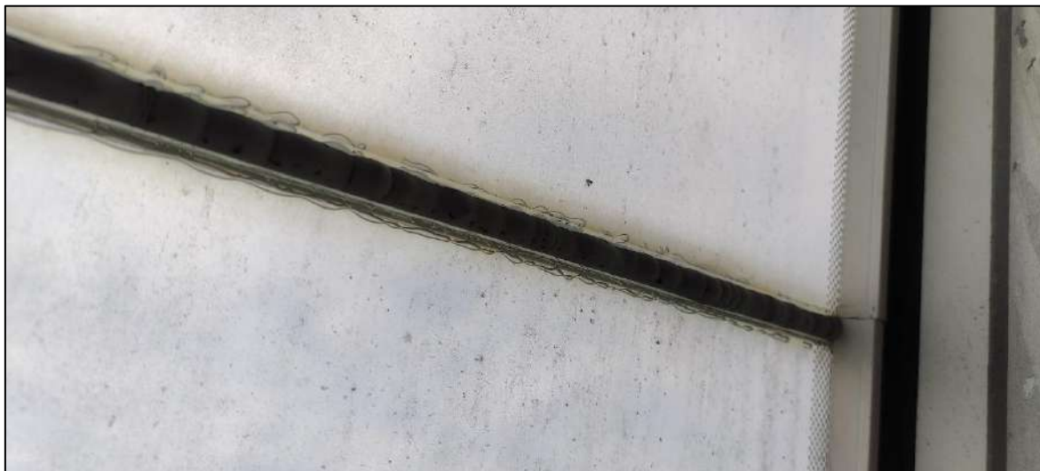
Figura 89: Demonstração da Patologia 3 no painel 1
