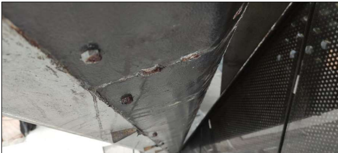
Figura 49: Demonstração da Patologia 9 no painel 2
