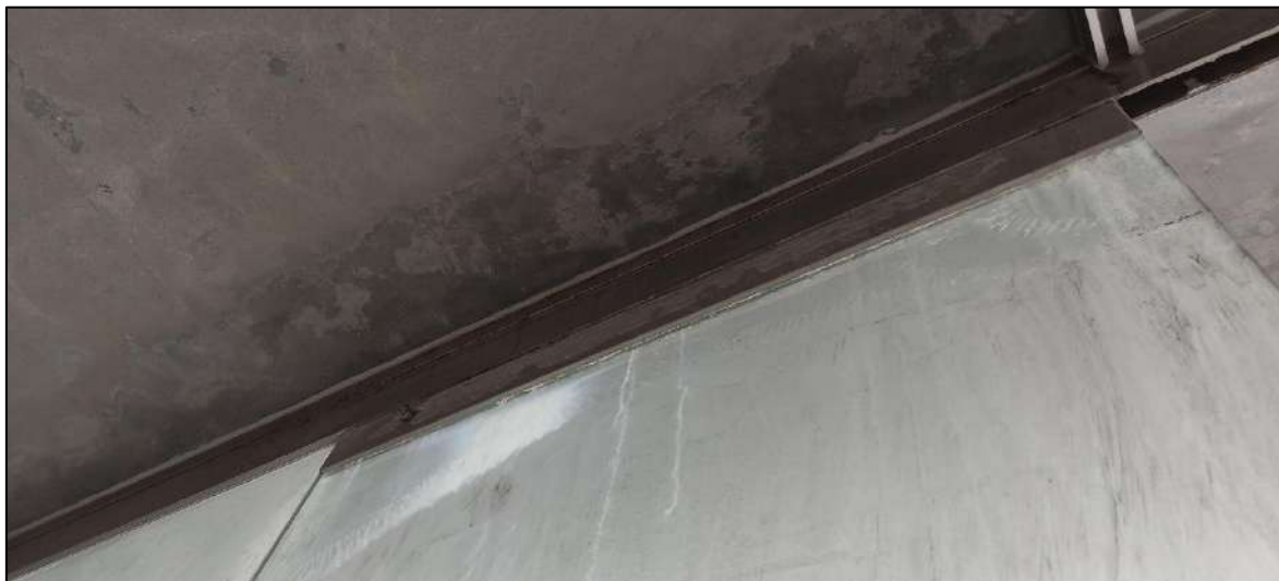
Figura 43: Demonstração da Patologia 7 no painel WW18
