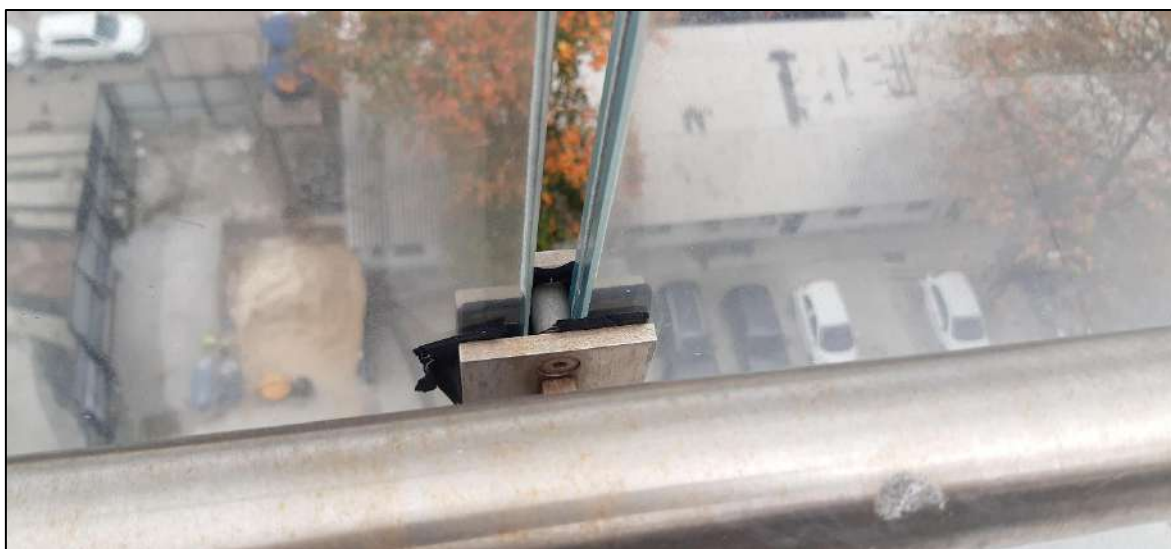
Figura 165: Demonstração da Patologia 13 no guarda-corpo G11A
