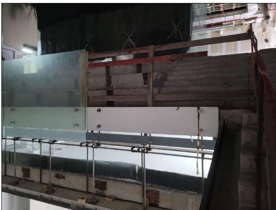
Figura 341: Ausência de corrimão no guarda corpo GCI-2e
