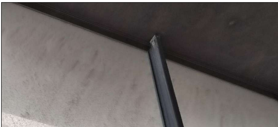
Figura 66: Demonstração da Patologia 16 no painel WW01
