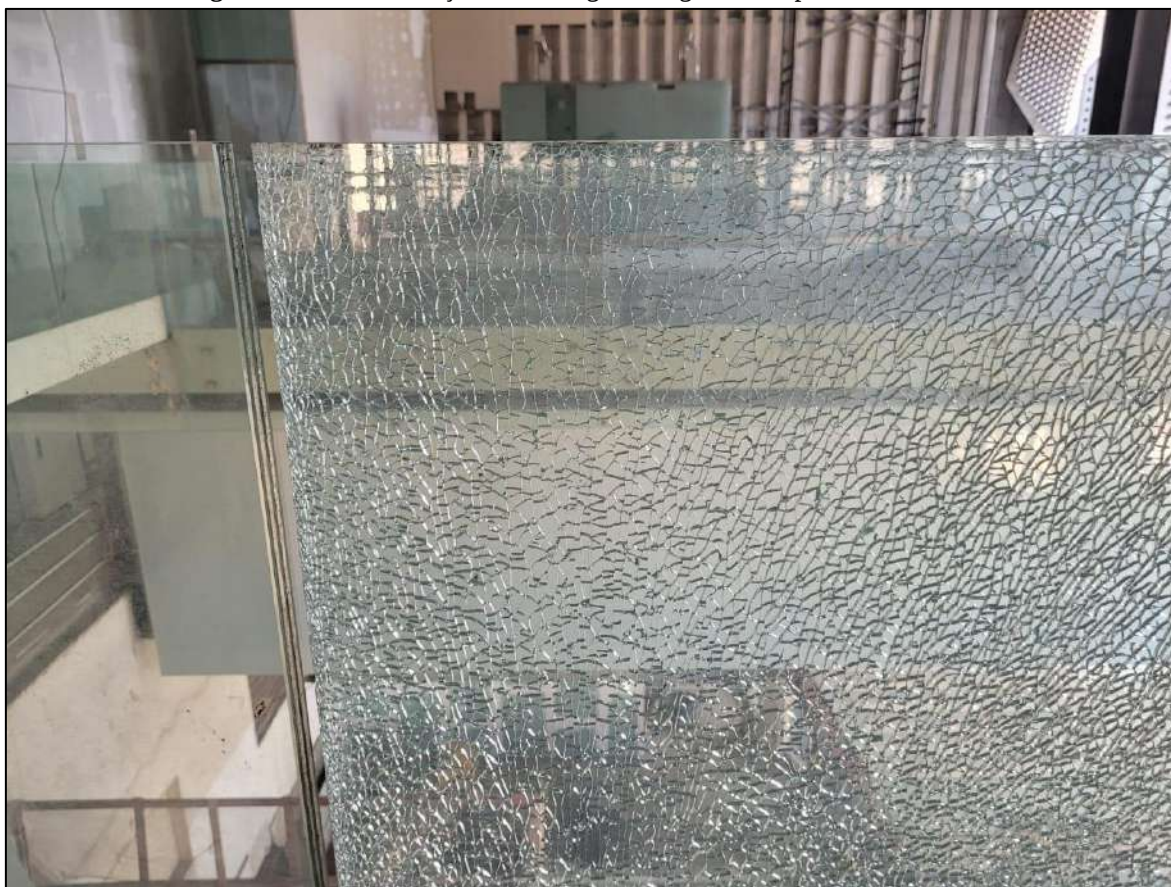
Figura 193: Demonstração da Patologia 2 no guarda-corpo interno GCI-2b
