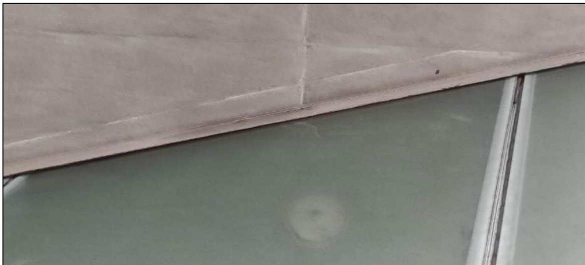
Figura 37: Demonstração da Patologia 7 no painel WW06
