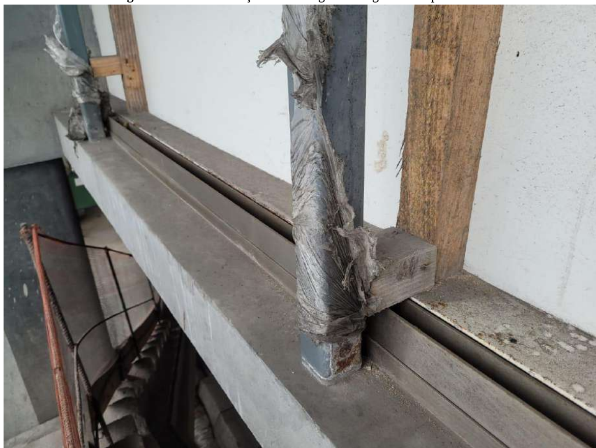
Figura 227: Demonstração da Patologia 16 no guarda-corpo GCI-1d
