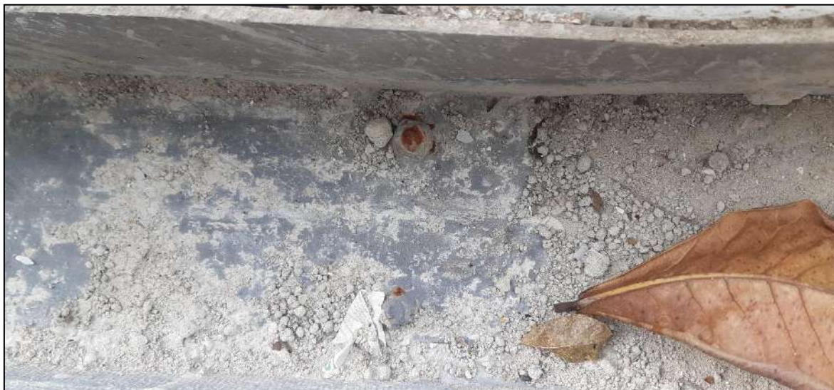
Figura 153: Demonstração da Patologia 10 no guarda corpo G1B
