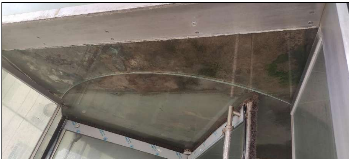
Figura 79: Demonstração da Patologia 1 no painel WW03
