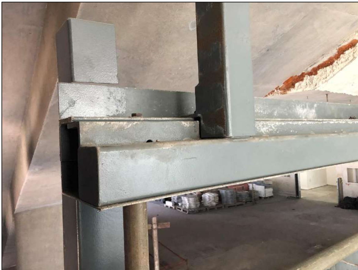
Figura 252: Demonstração da Patologia 8 no 3º pavimento
