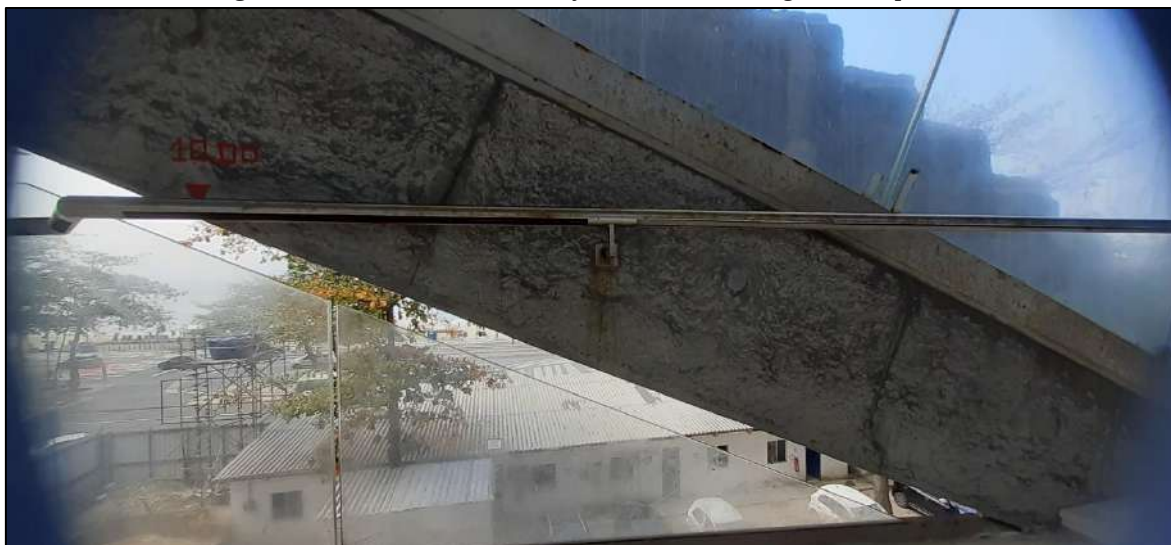
Figura 302: Ausência de iluminação no corrimão no guarda corpo G2.
