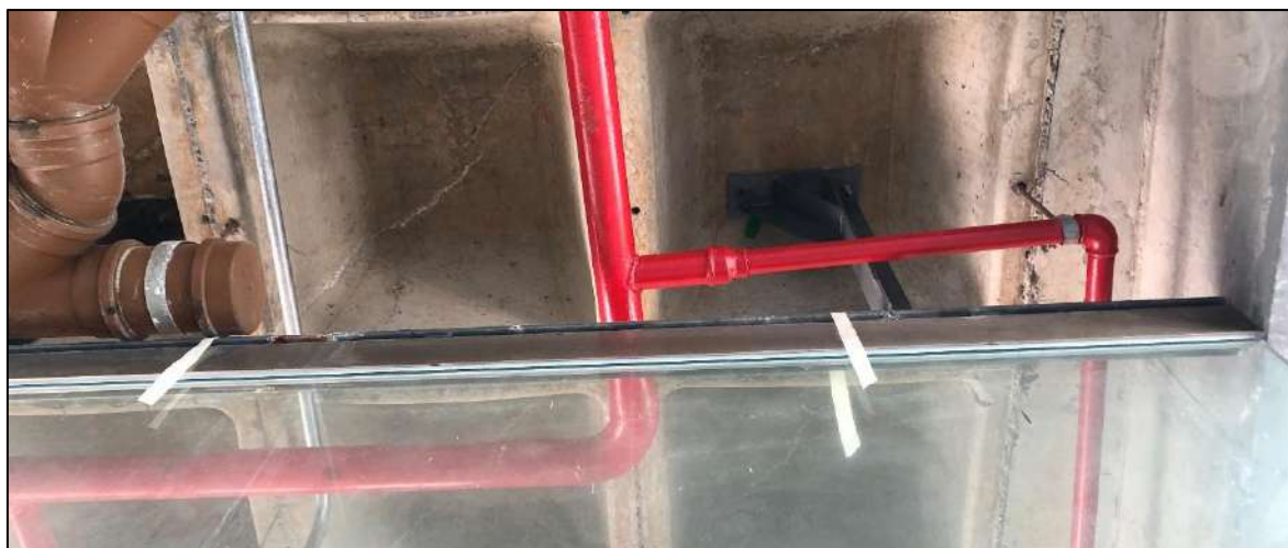
Figura 242: Demonstração da Patologia 3 no 5º pavimento
