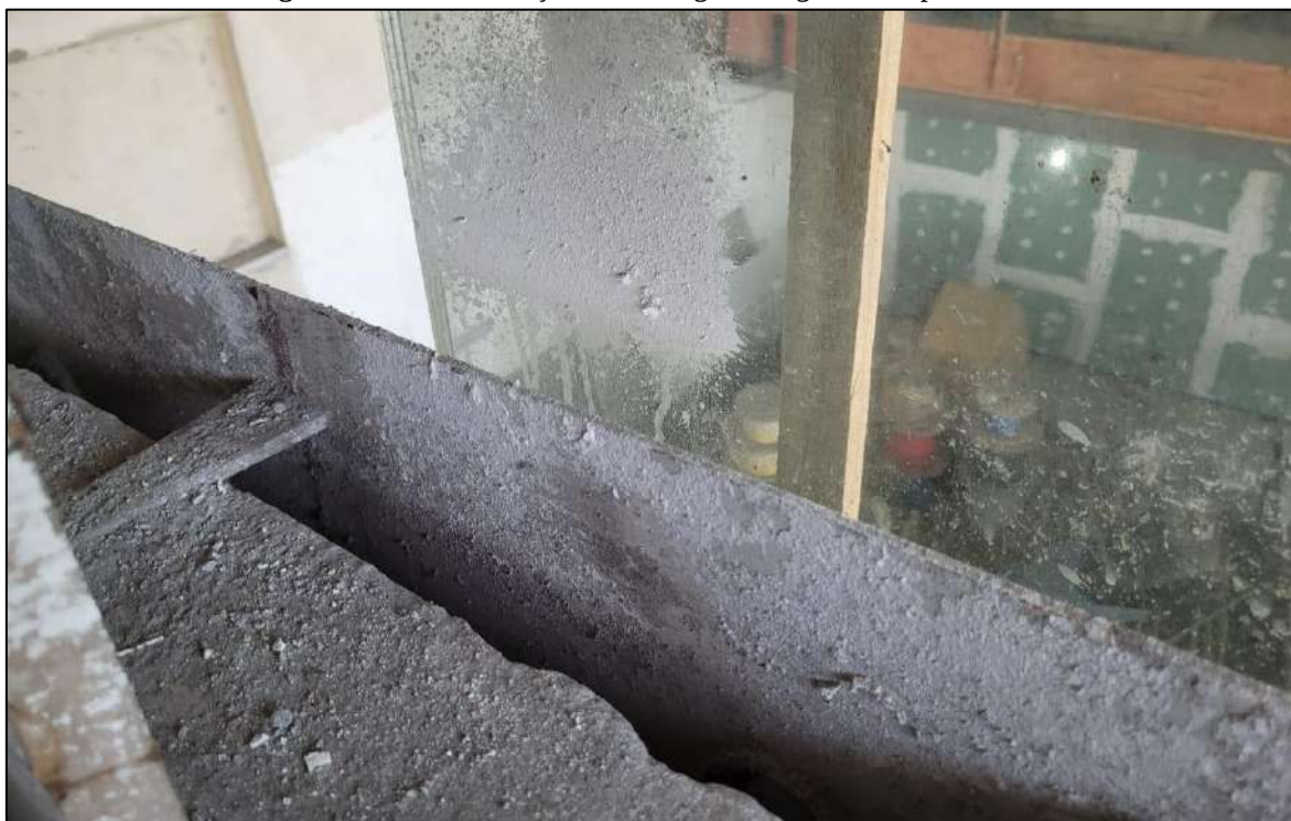
Figura 204: Demonstração da Patologia 6 no guarda corpo GCI-2a
