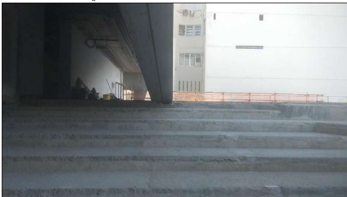
Figura 322: Ausência de corrimão EGR-4.1 na escada E
