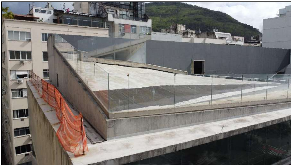
Figura 313: Ausência de corrimão no guarda corpo G13
