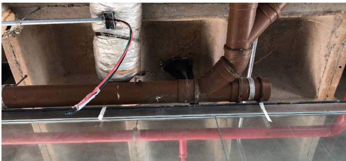
Figura 253: Demonstração da Patologia 8 no 5º pavimento
