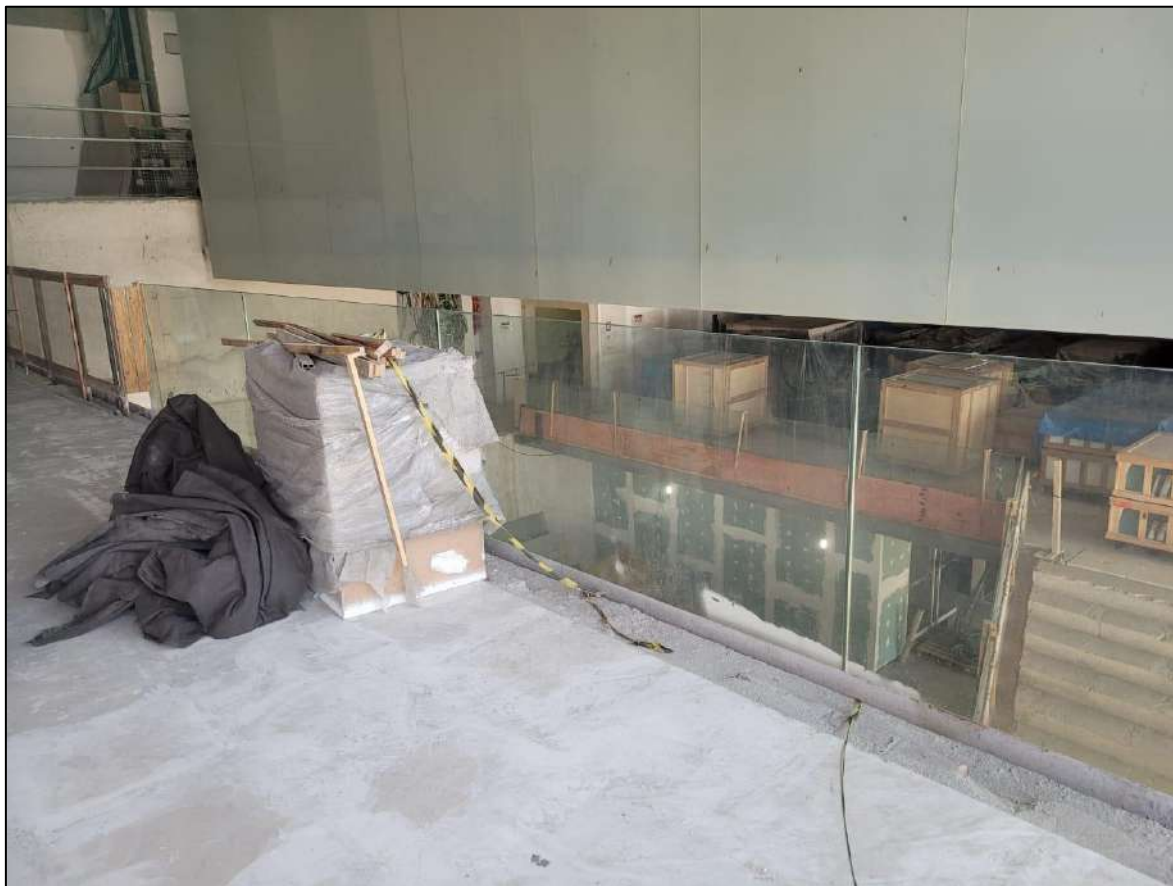
Figura 332: Ausência de vidro no guarda corpo GCI-2a
