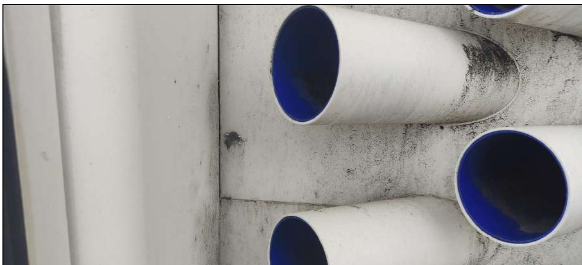
Figura 95: Demonstração da Patologia 2 no painel 3
