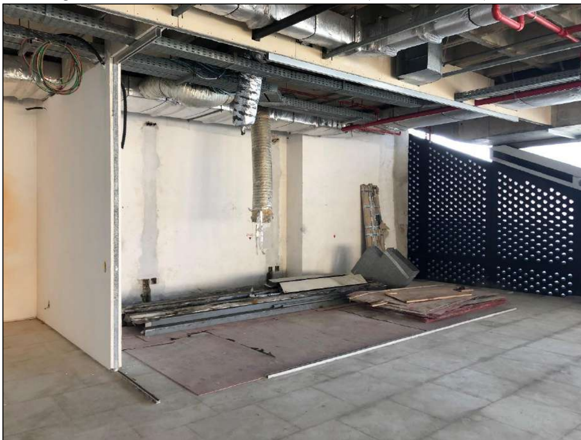
Figura 351: Ausência do vidro das divisórias DV7f, DV7i (sem estrutura inferior) e DV7h
