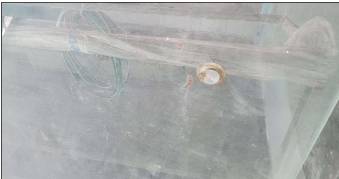
Figura 196: Demonstração da Patologia 3 no guarda-corpo interno GCI-2b
