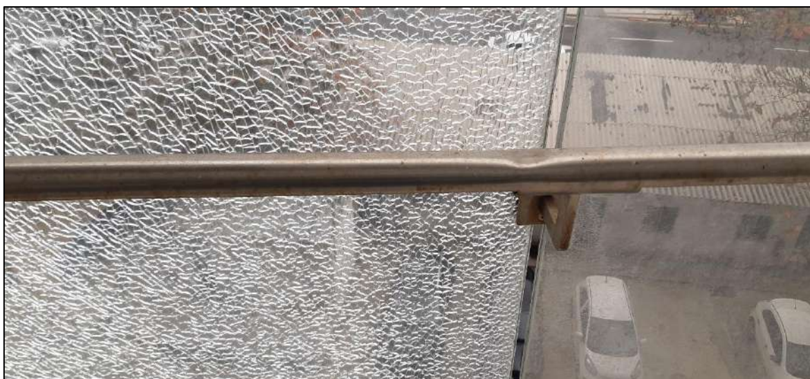
Figura 164: Demonstração da Patologia 12 no guarda-corpo G3
