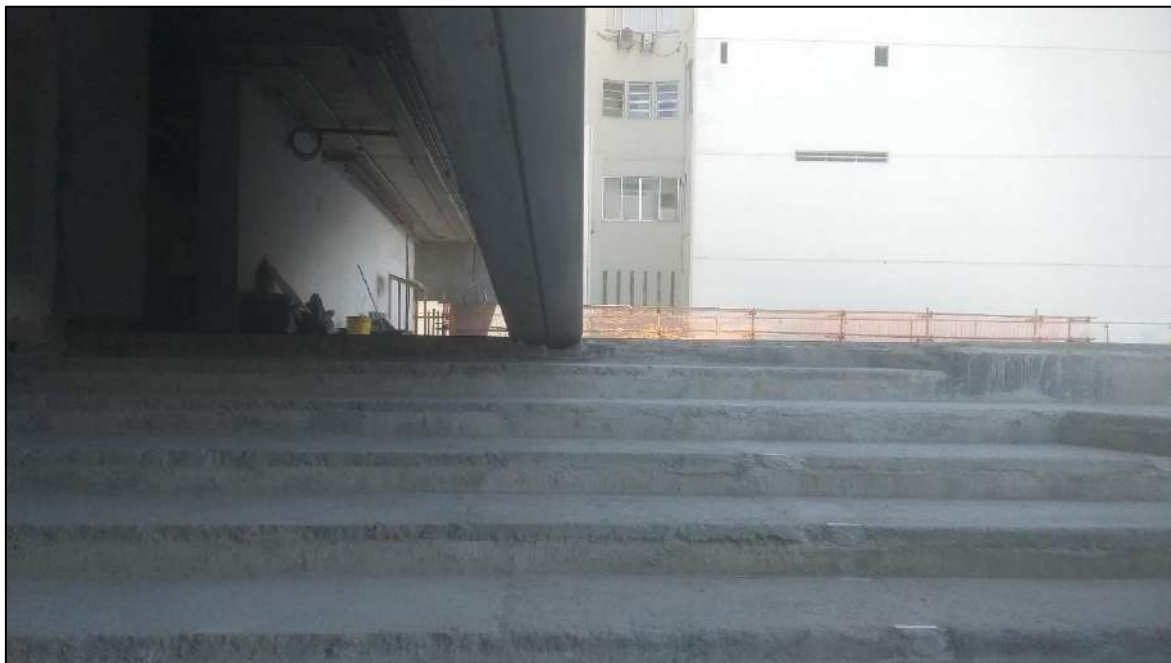
Figura 321: Ausência de corrimão C15 na escada 2º pavimento
