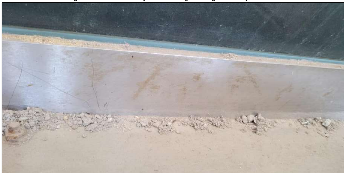
Figura 213: Demonstração da Patologia 9 no guarda-corpo GCI-1b
