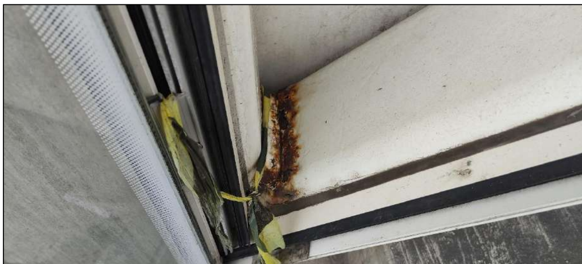
Figura 74: Demonstração da Patologia 20 no painel P2
