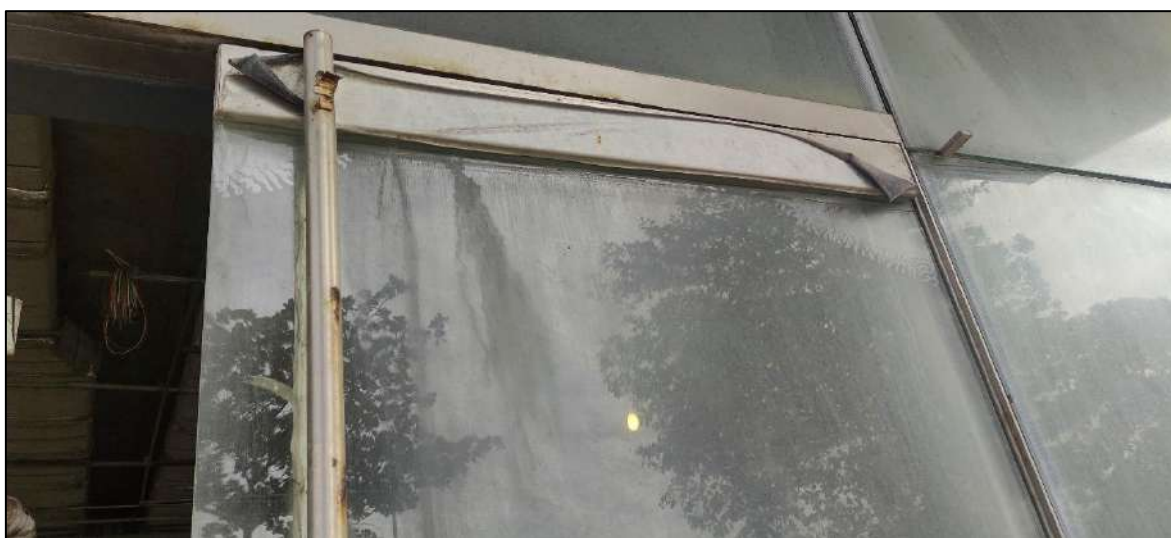
Figura 78: Demonstração da Patologia 1 no painel WW03
