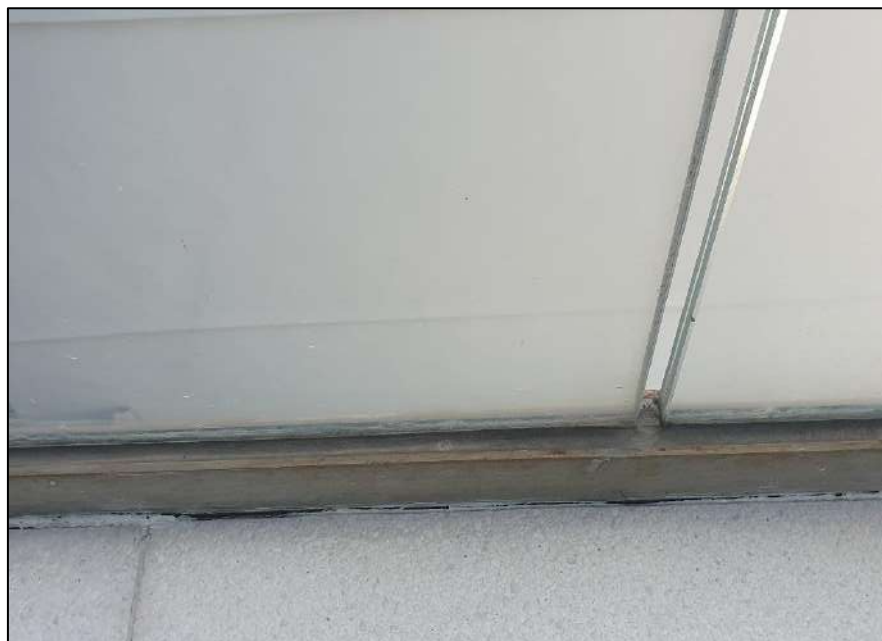
Figura 151: Demonstração da Patologia 9 no guarda corpo G9
