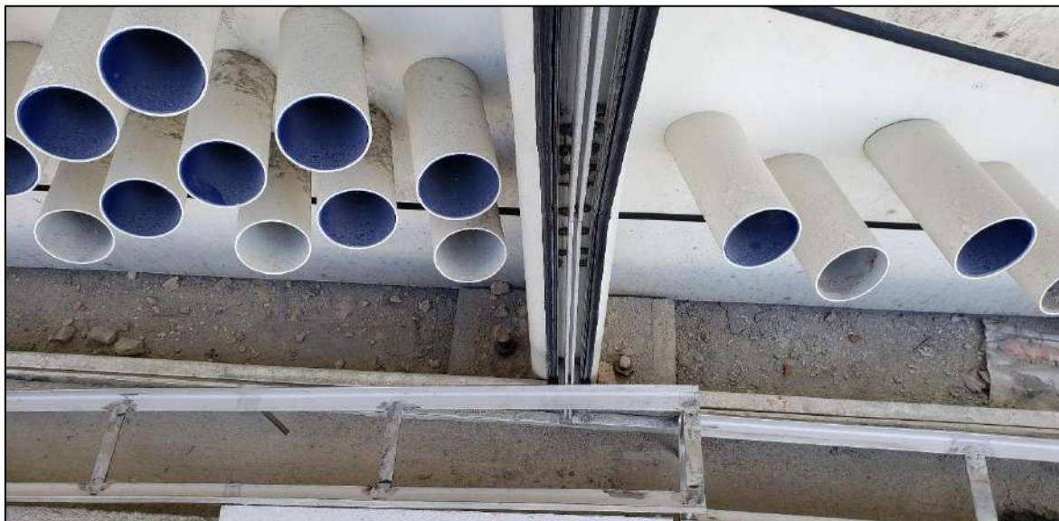
Figura 101: Demonstração da Patologia 4 no painel 4
