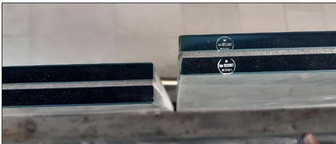
Figura 125: Demonstração da Patologia 4 no guarda corpo G2
