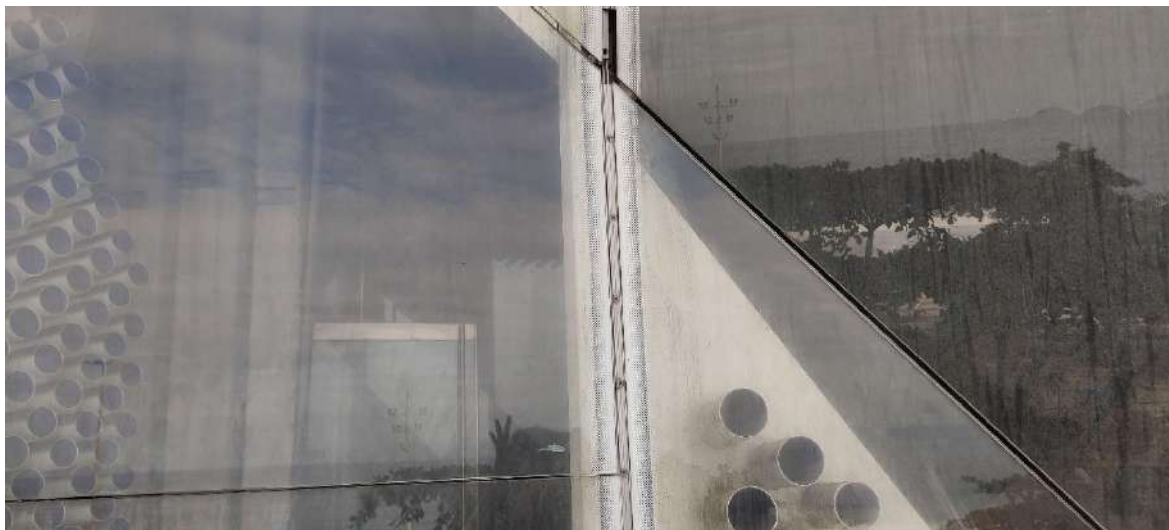
Figura 91: Demonstração da Patologia 4 no painel 2
