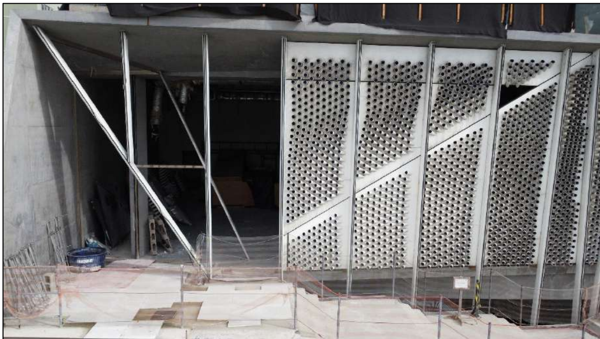
Figura 271: Ausência de painéis de cobogós e porta de vidro
