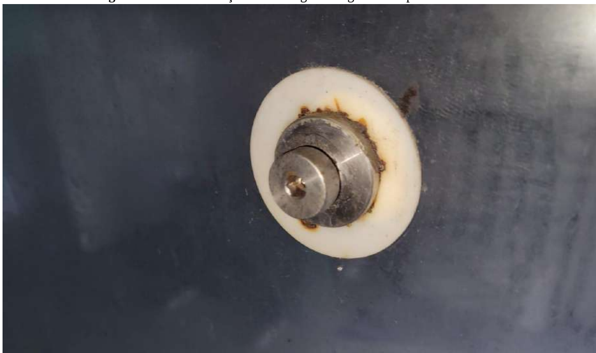
Figura 198: Demonstração da Patologia 3 no guarda-corpo interno GCI-2d
