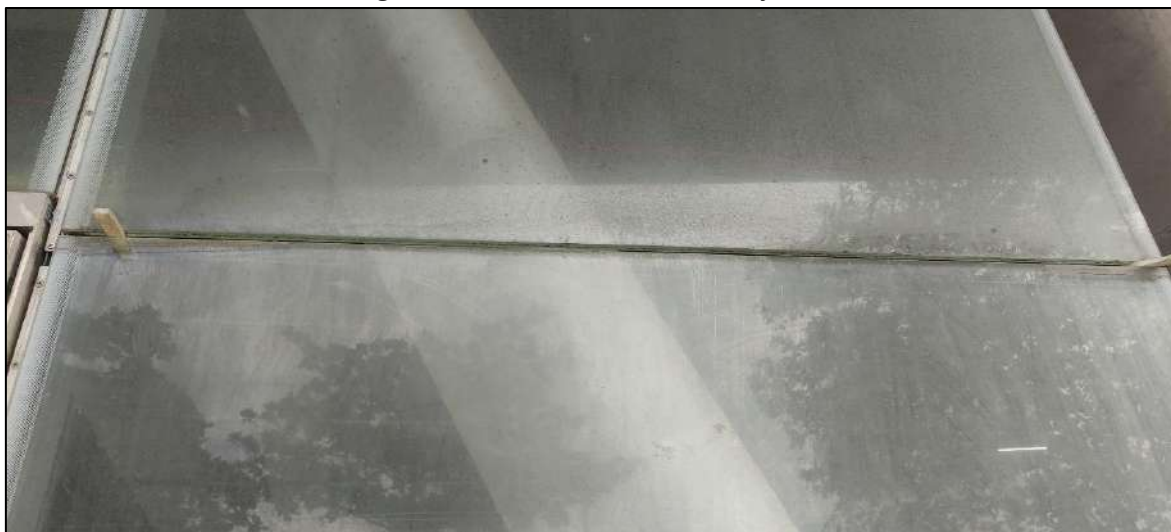
Figura 276: Ausência de silicone nas juntas
