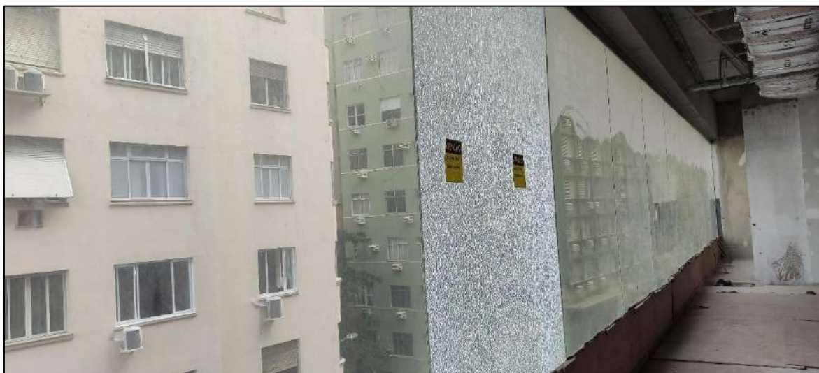
Figura 85: Demonstração da Patologia 2 no painel WW10
