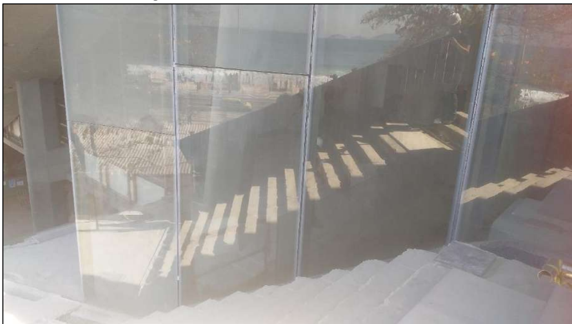
Figura 290: Ausência do corrimão EGR-2.3 – escada H
