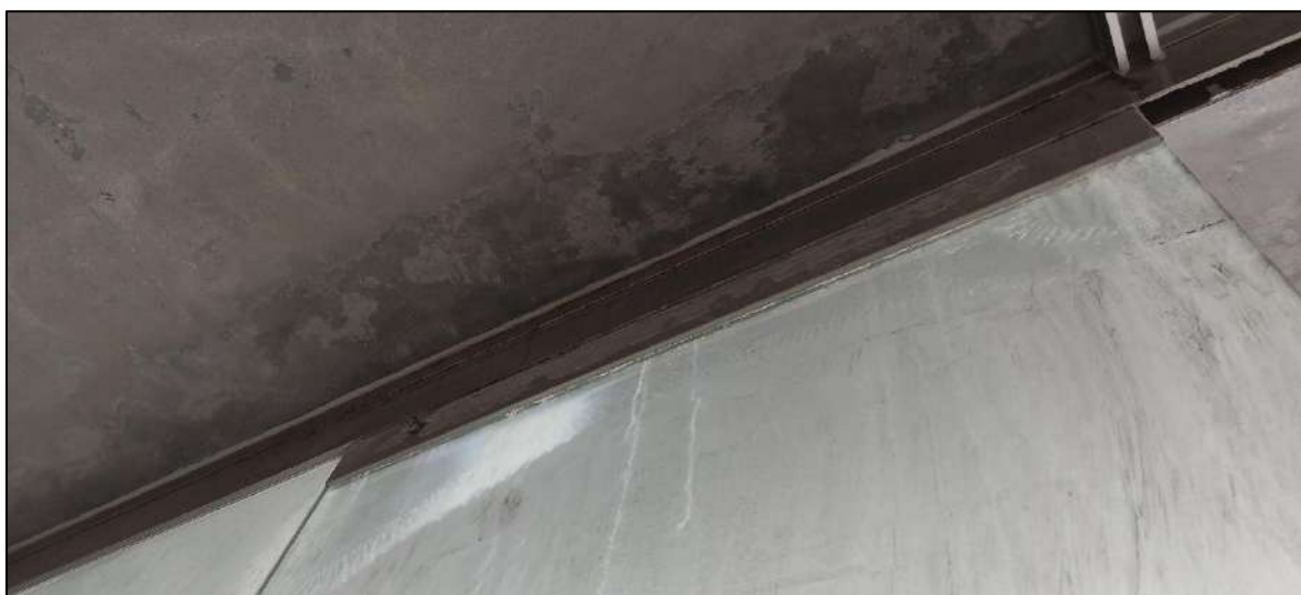
Figura 61: Demonstração da Patologia 15 no painel WW18
