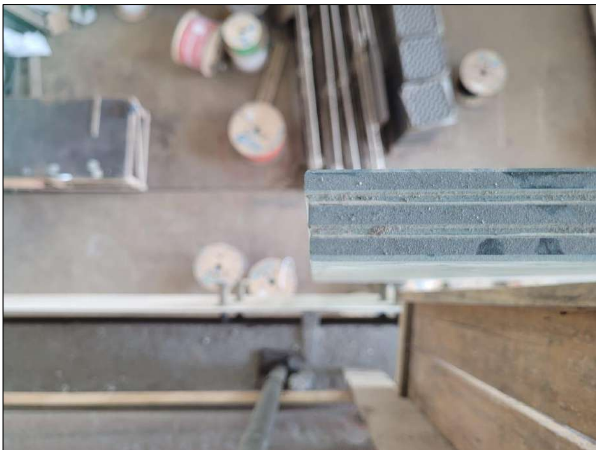
Figura 192: Demonstração da Patologia 1 no guarda-corpo interno GCI-2a
