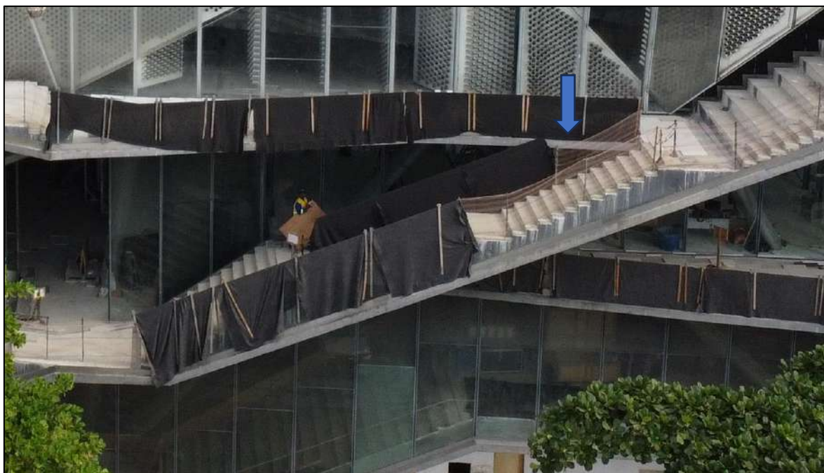
Figura 299: Ausência do vidro no guarda corpo G2.
