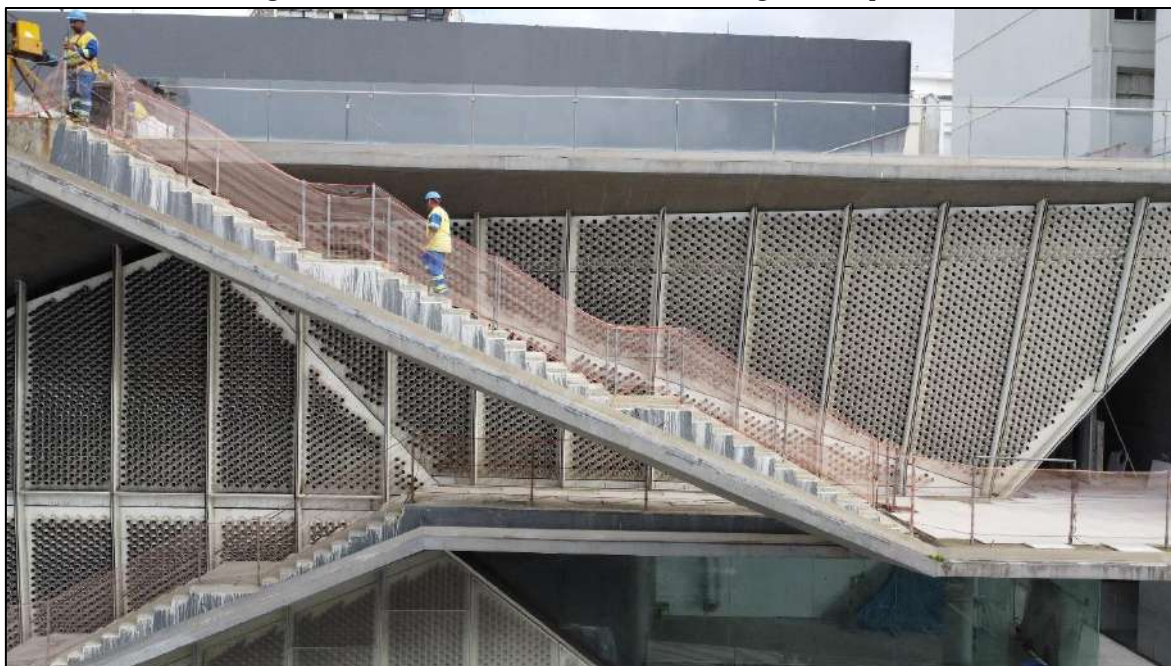
Figura 309: Ausência de vidro e de corrimão no guarda corpo G7
