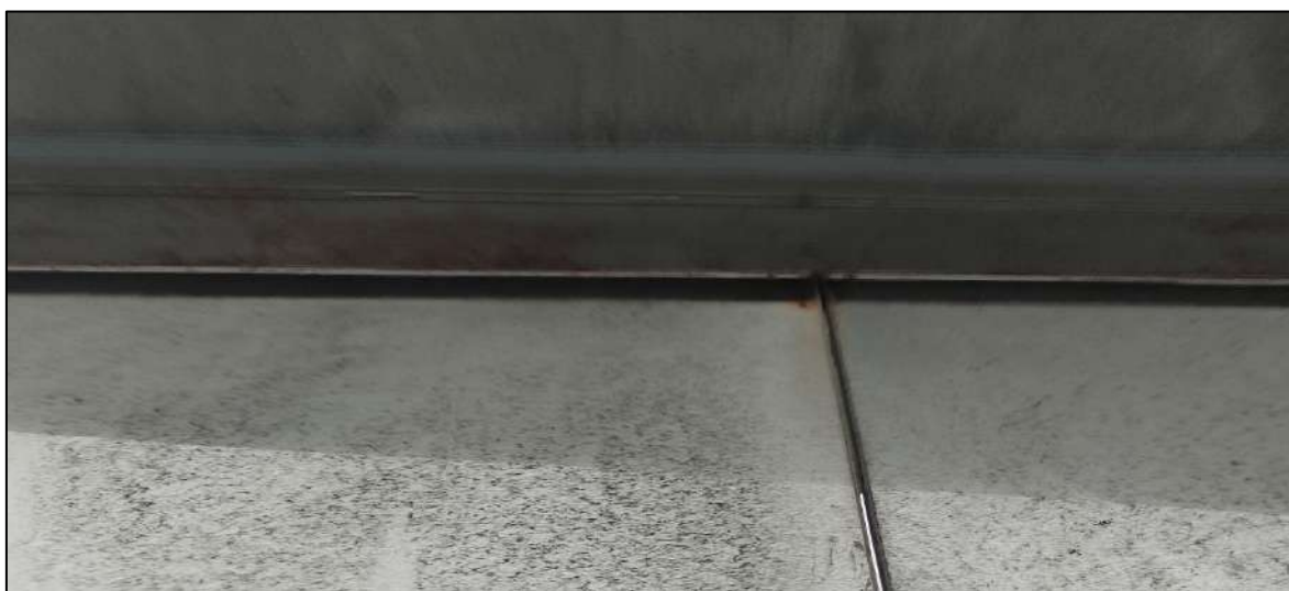
Figura 42: Demonstração da Patologia 7 no painel WW14
