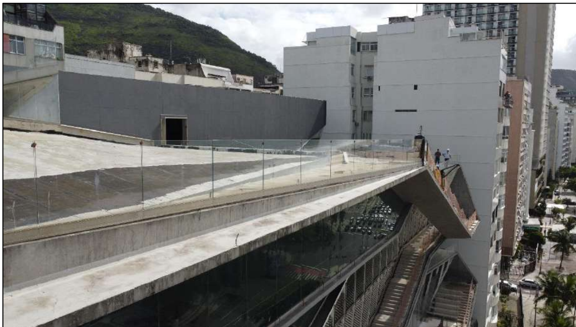
Figura 312: Ausência de corrimão no guarda corpo G12
