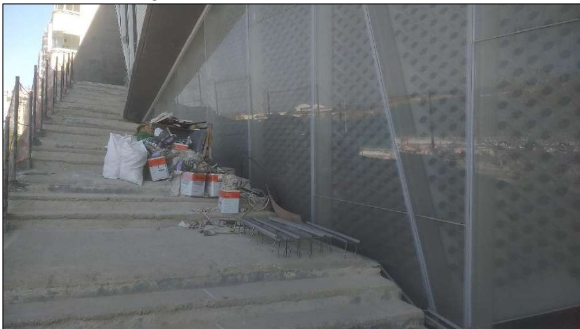
Figura 287: Ausência do corrimão EGR-2.2 na escada K
