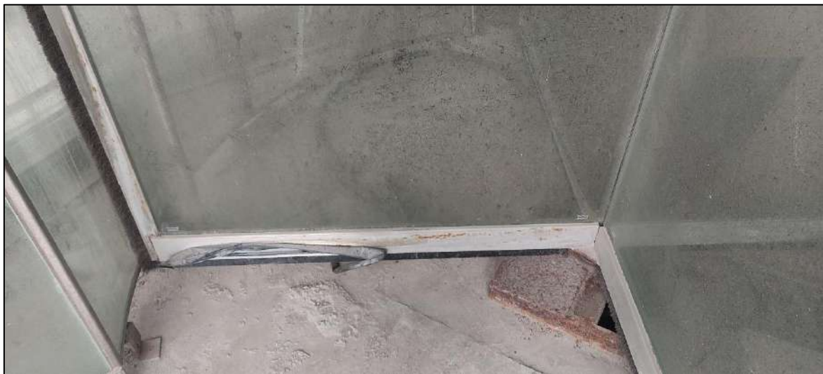
Figura 56: Demonstração da Patologia 15 no painel WW03
