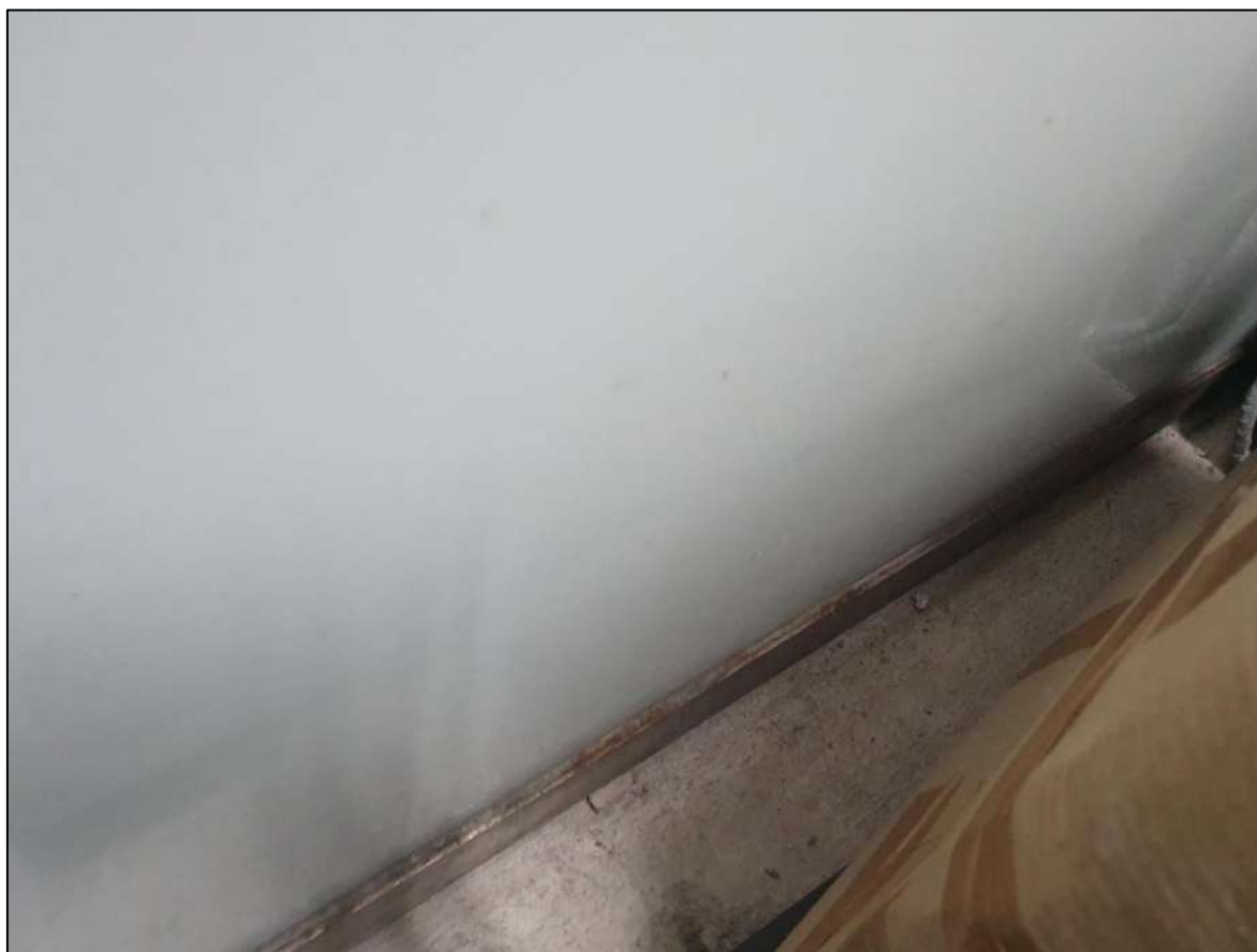
Figura 261: Demonstração da Patologia 3 no EWS 2.4
