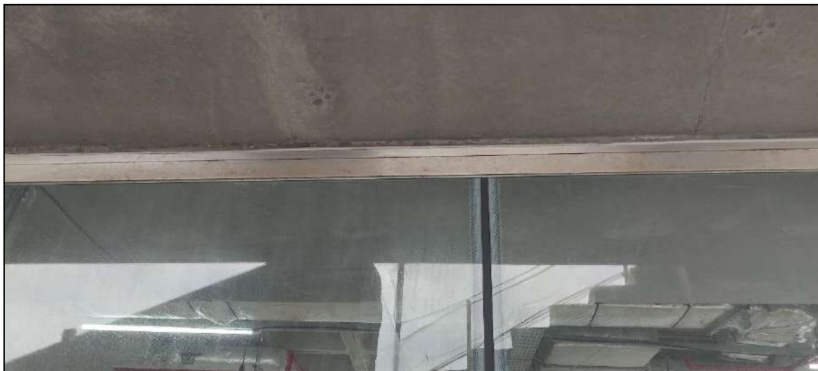
Figura 39: Demonstração da Patologia 7 no painel WW08
