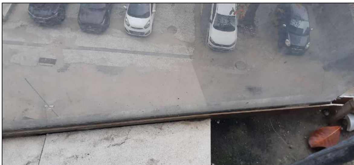
Figura 128: Demonstração da Patologia 6 no guarda corpo G3
