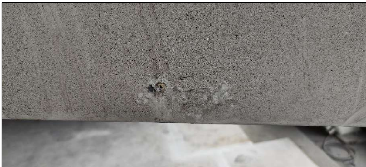
Figura 93: Demonstração da Patologia 2 no painel 1
