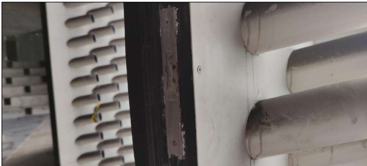
Figura 92: Demonstração da Patologia 1 no painel 2
