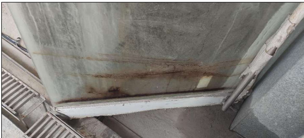
Figura 77: Demonstração da Patologia 1 no painel WW03
