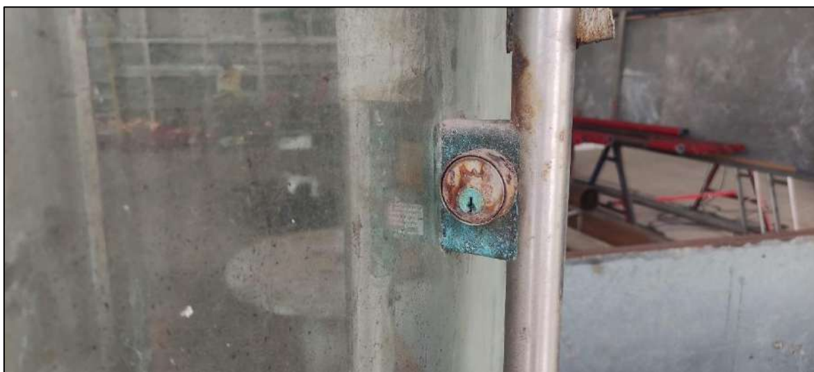
Figura 59: Demonstração da Patologia 15 no painel WW03
