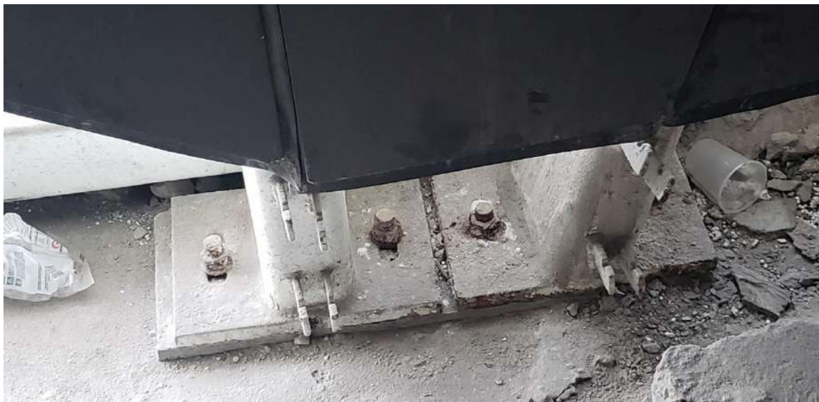
Figura 16: Demonstração da Patologia 1 no painel 2
