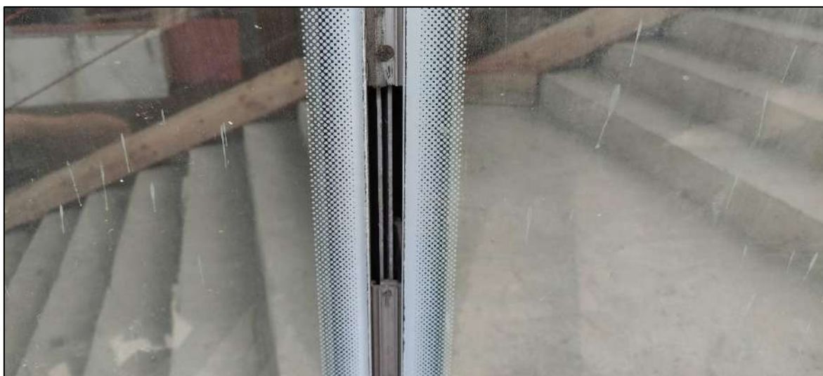
Figura 25: Demonstração da Patologia 3 no painel WW06
