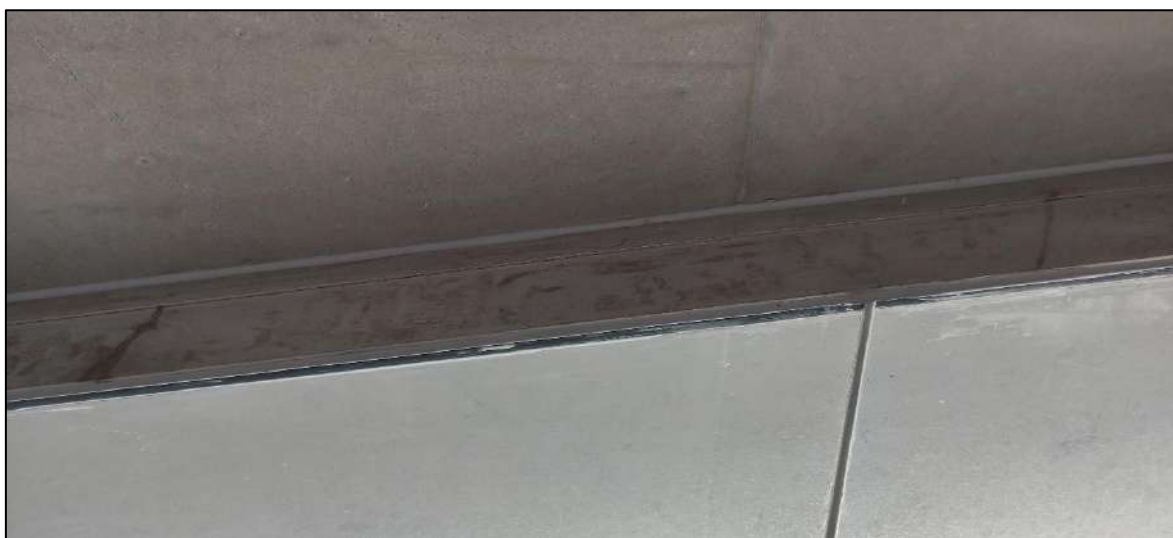
Figura 44: Demonstração da Patologia 7 no painel WW19
