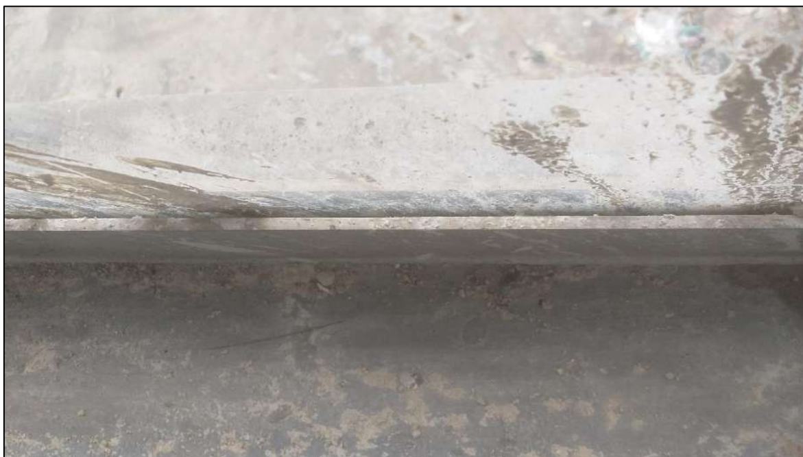
Figura 149: Demonstração da Patologia 9 no guarda corpo G1B
