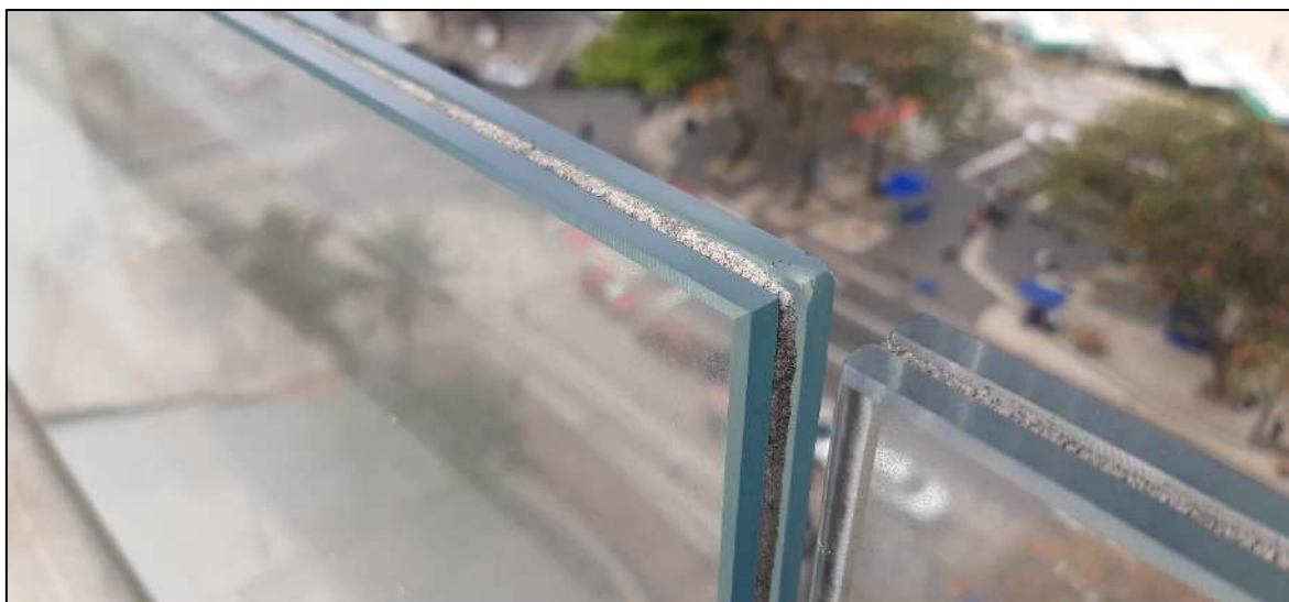
Figura 132: Demonstração da Patologia 8 no guarda corpo
