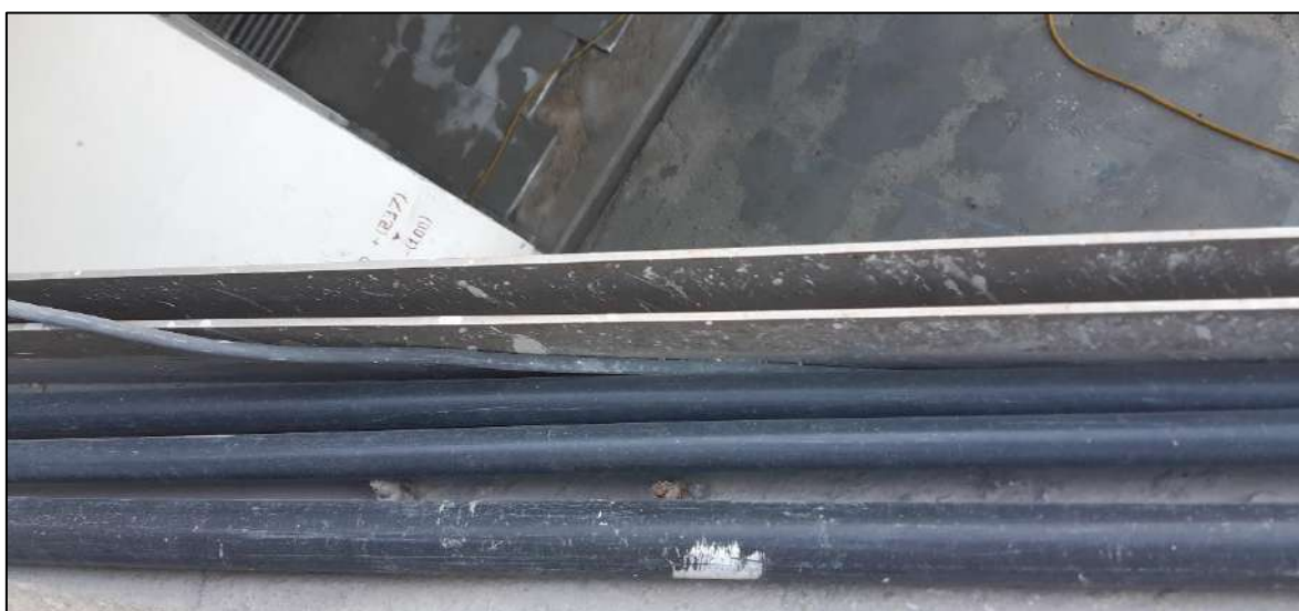
Figura 162: Demonstração da Patologia 10 no guarda-corpo
