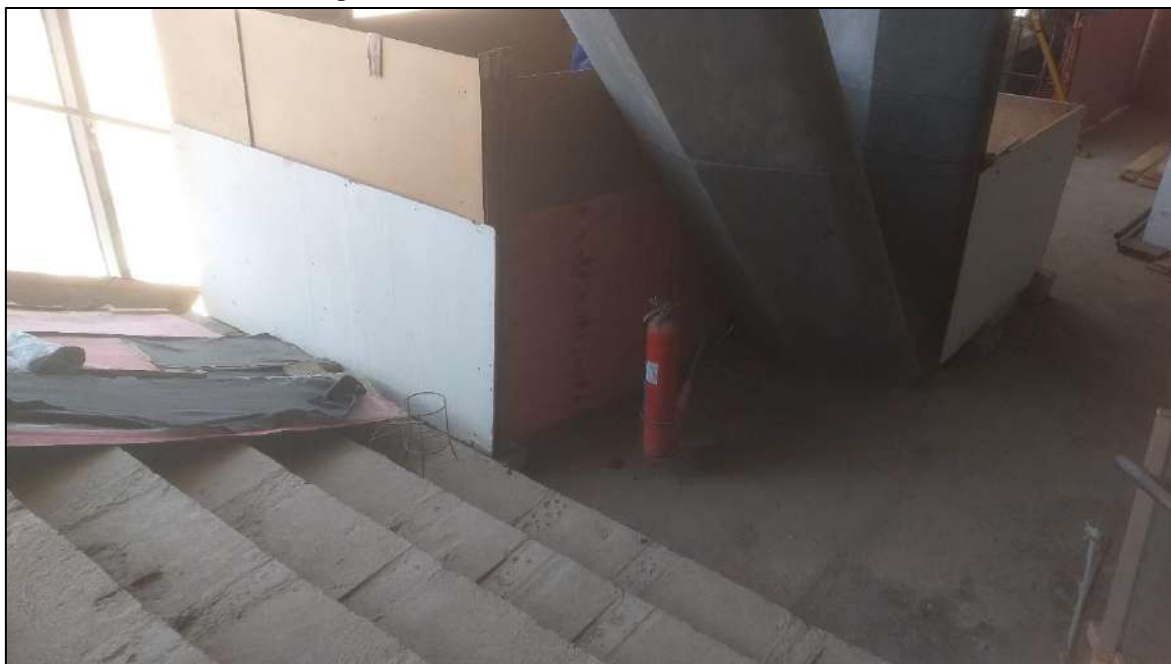
Figura 318: Ausência de corrimão C12 na escada F
