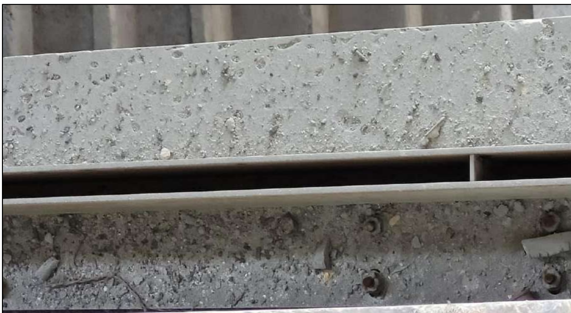
Figura 226: Demonstração da Patologia 10 no guarda-corpo GCI-1f
