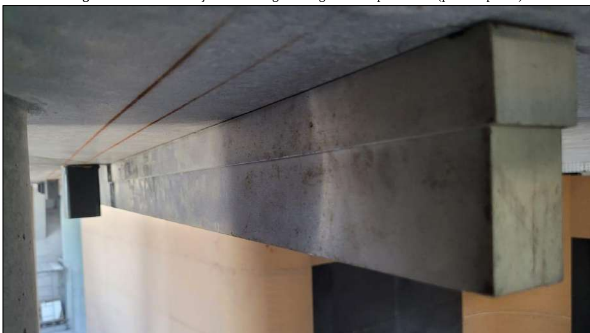
Figura 219: Demonstração da Patologia 9 no guarda-corpo GCI-1e (perfil superior)
