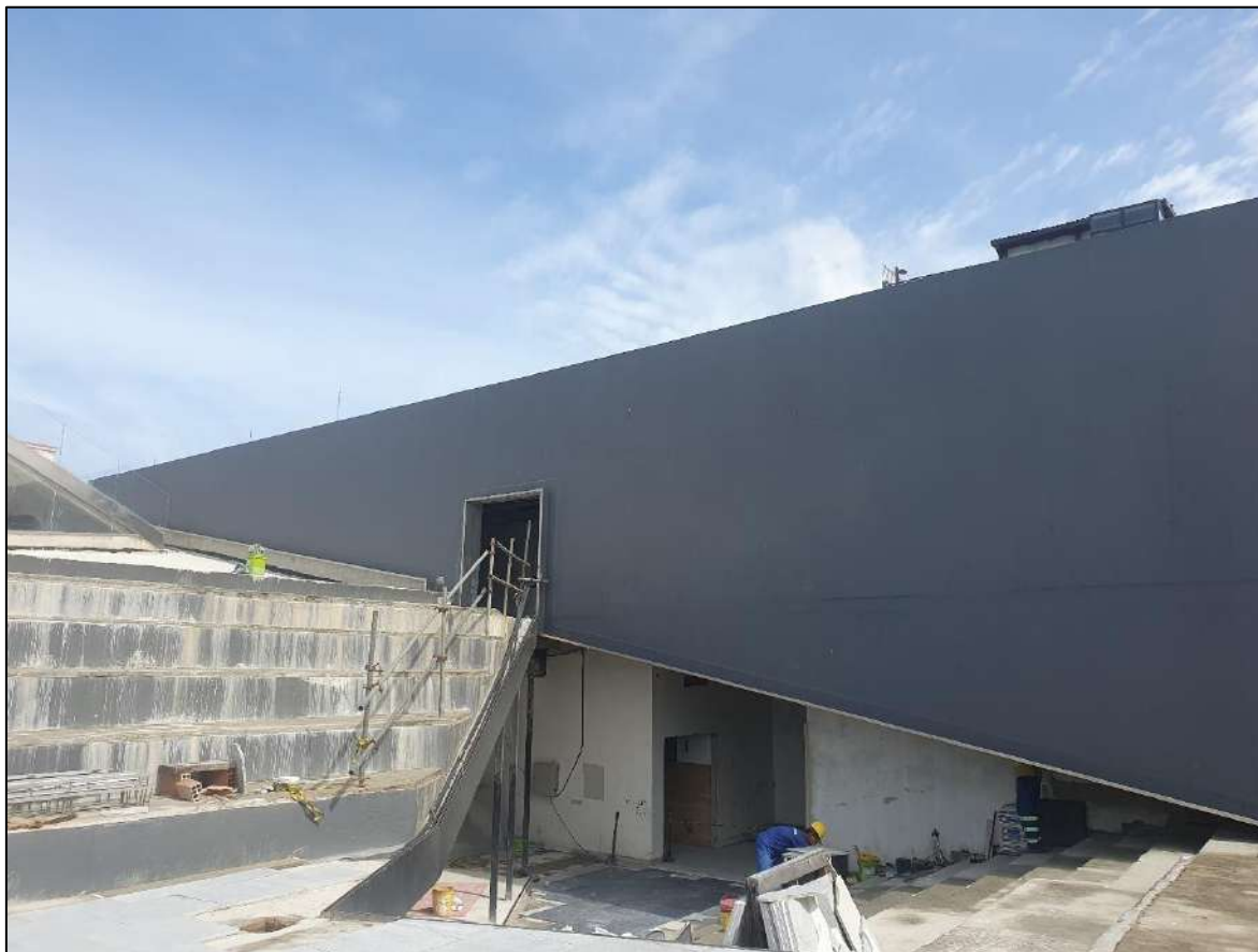
Figura 362: Ausência completa de todo o vidro e estrutura no revestimento EWS 1.3
