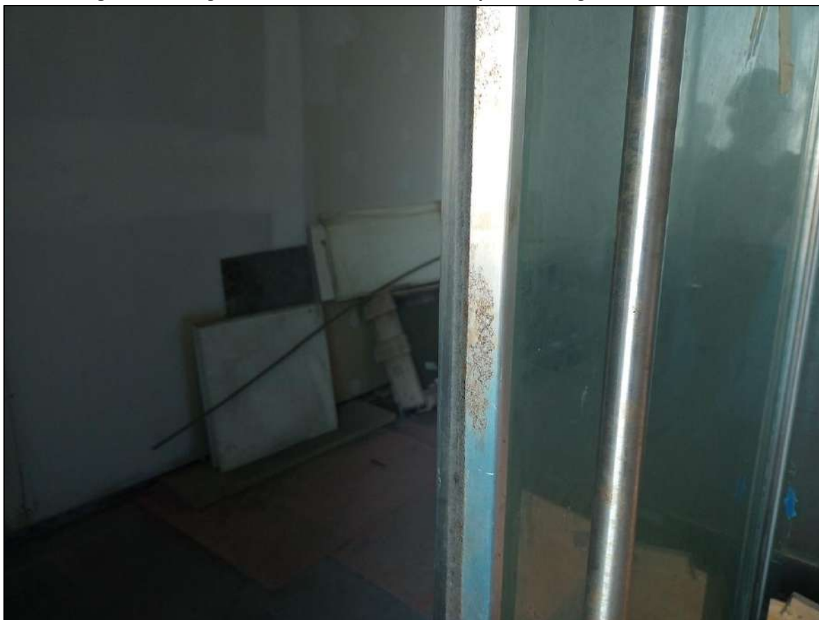
Figura 248: Imagem D - 2 ° Pavimento – Demonstração da Patologia 4 no 2° Pavimento
