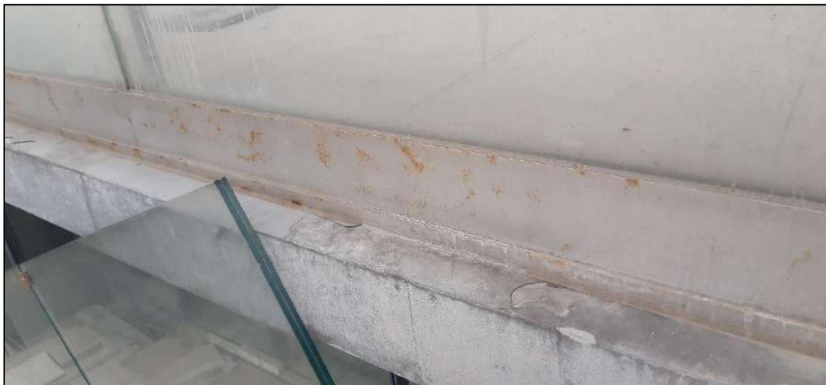
Figura 138: Demonstração da Patologia 9 no guarda corpo G3
