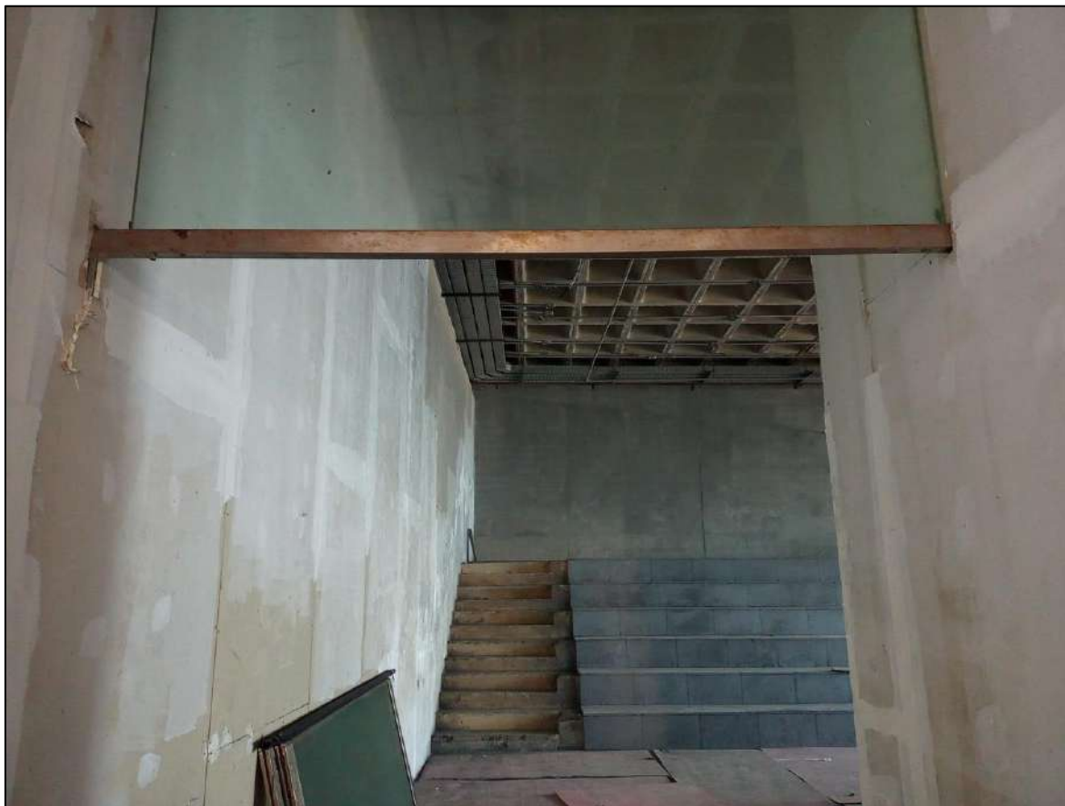
Figura 346: Imagem C - 2º Pavimento – Ausência completa da porta PV6
