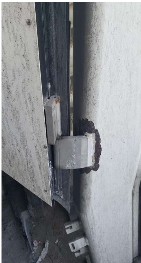
Figura 21: Demonstração da Patologia 2 no painel 2
