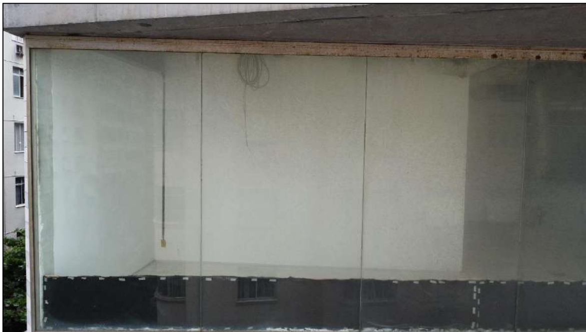
Figura 283: Ausência de silicone nas juntas
