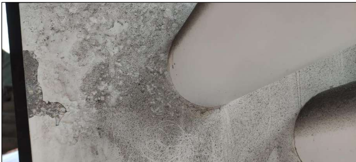
Figura 103: Demonstração da Patologia 6 no painel 1
