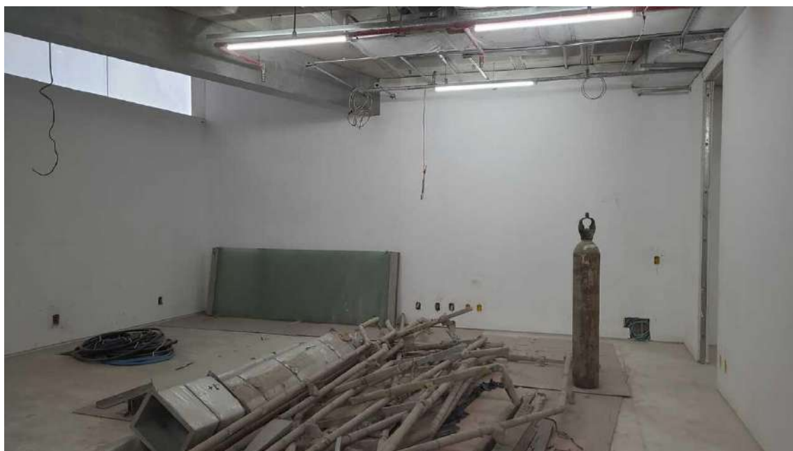
Figura 344: Imagem H - 1 ° Pavimento – Ausência completa da janela JV3
