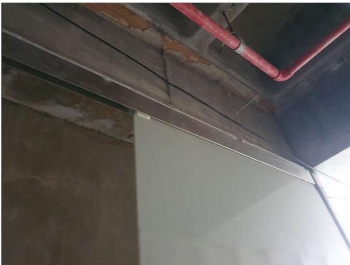
Figura 258: Demonstração da Patologia 1 no EWS 2.4
