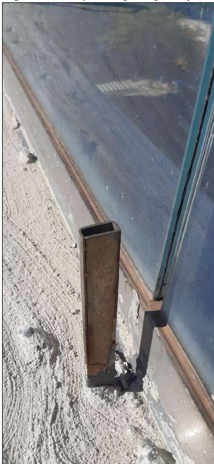
Figura 182: Demonstração da Patologia 16 no guarda-corpo G12
