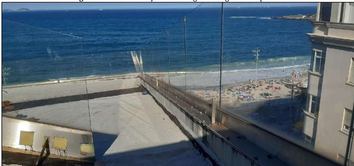
Figura 181: Demonstração da Patologia 16 no guarda-corpo G13
