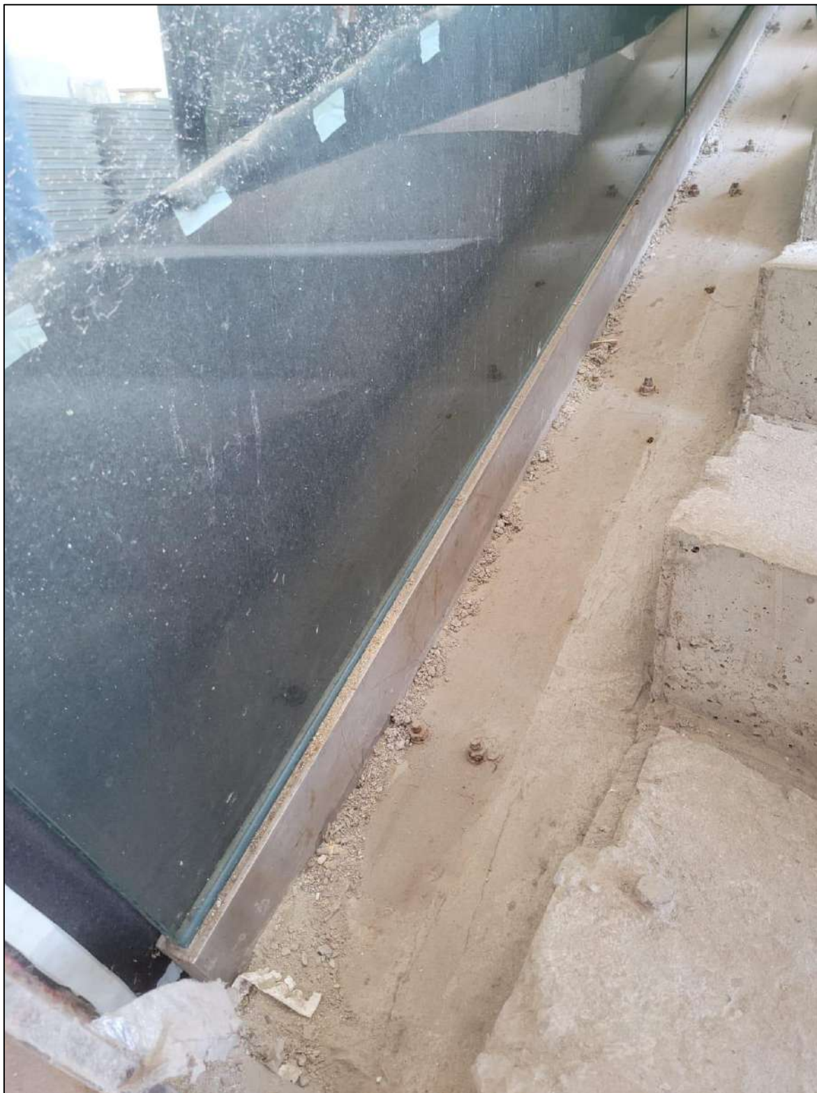
Figura 329: Ausência de vidro e corrimão no guarda corpo GCI-1b
