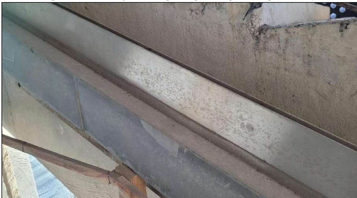
Figura 218: Demonstração da Patologia 9 no guarda-corpo GCI-1e (perfil inferior)
