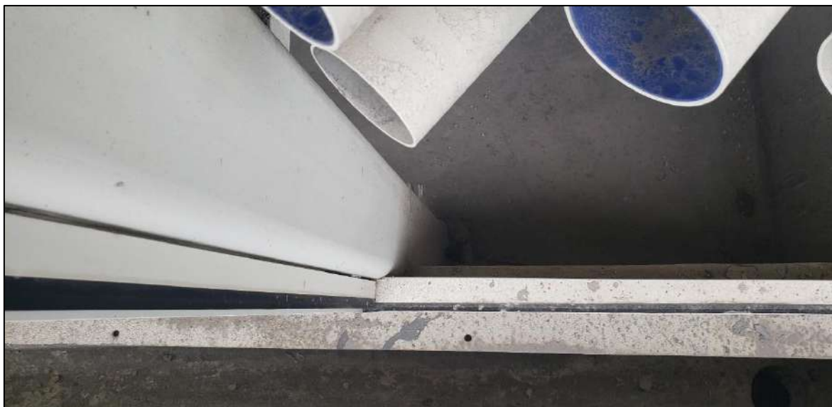
Figura 100: Demonstração da Patologia 4 no painel 3
