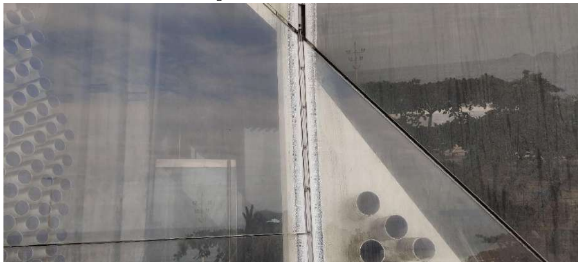
Figura 267: Ausência de silicone
