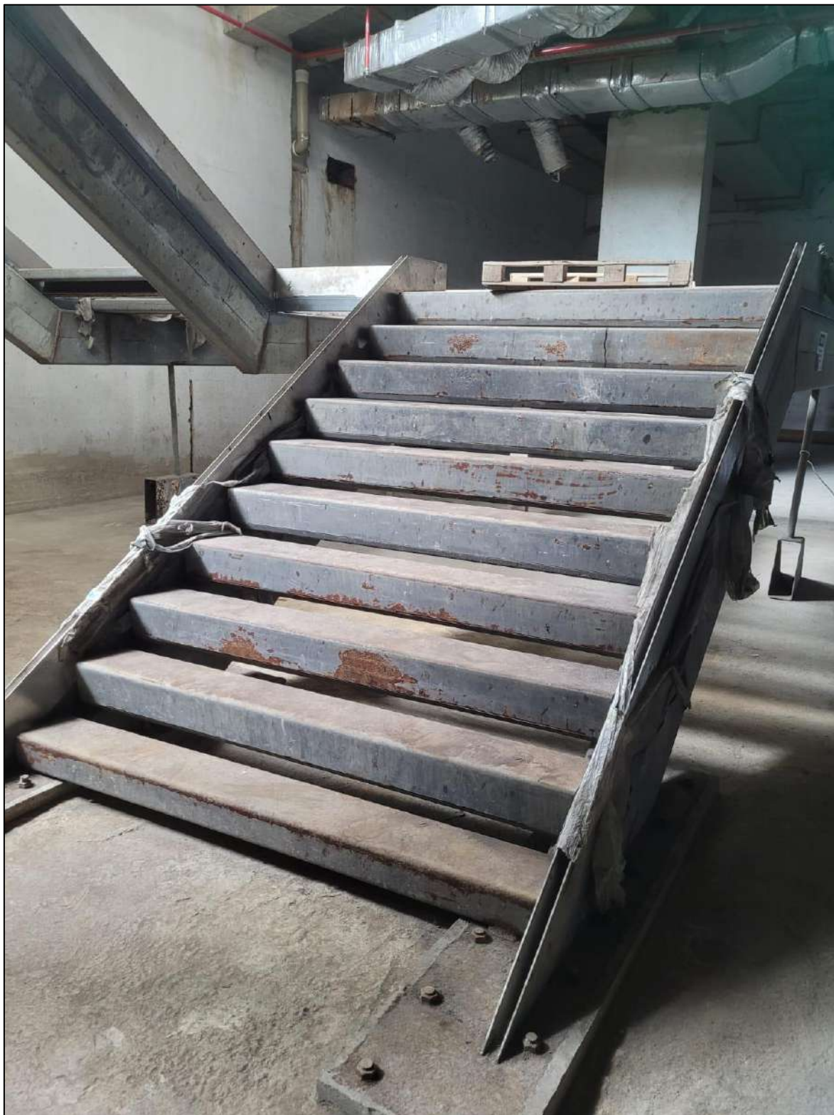
Figura 326: Ausência de vidro e corrimão no guarda corpo GCI-3a, GCI-3b, GCI-3c, GCI-3d
