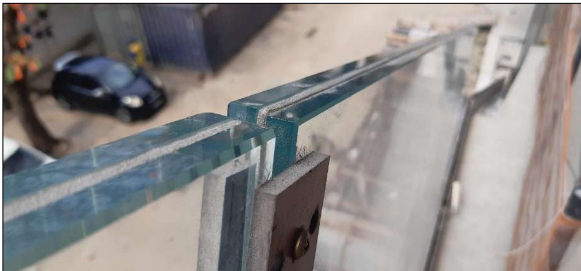
Figura 168: Demonstração da Patologia 14 no guarda-corpo G1B
