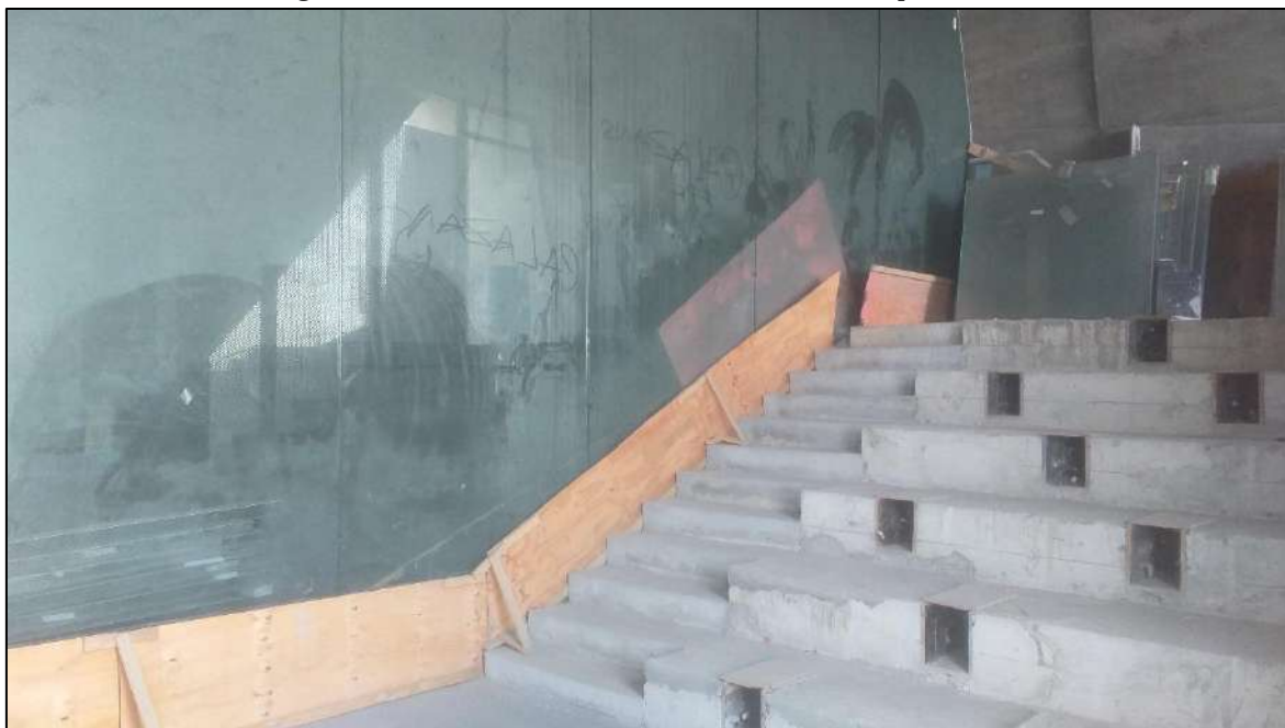
Figura 319: Ausência de corrimão C13 na escada 2º pavimento
