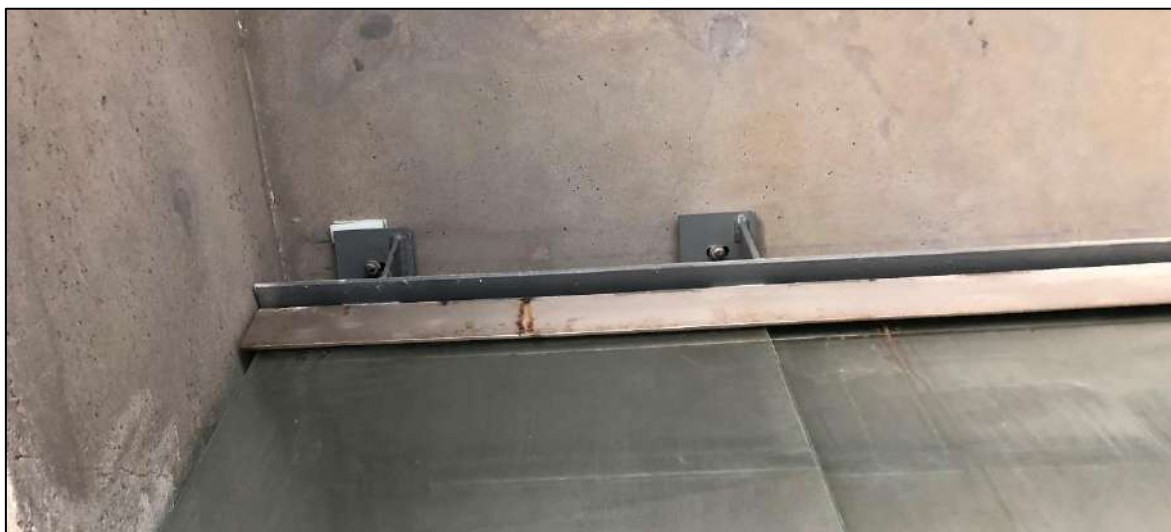
Figura 250: Demonstração da Patologia 6 no 3º pavimento
