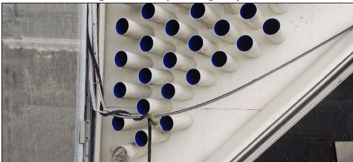
Figura 24: Demonstração da Patologia 3 no painel 2
