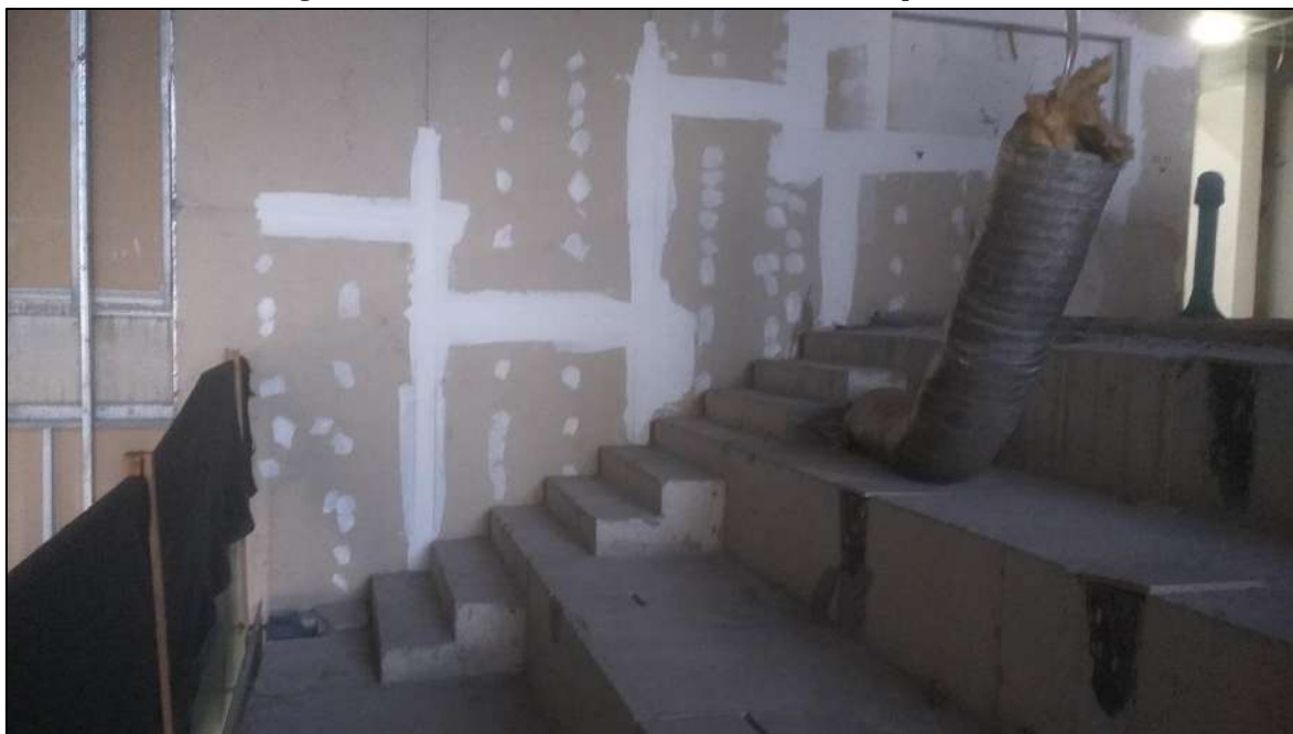
Figura 317: Ausência de corrimão C11 na escada 4º pavimento
