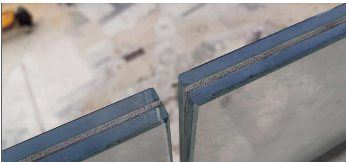
Figura 171: Demonstração da Patologia 14 no guarda-corpo G4A
