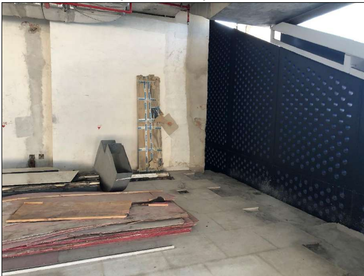
Figura 352: Ausência completa da DV7m
