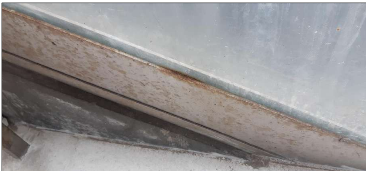
Figura 137: Demonstração da Patologia 9 no guarda corpo G2
