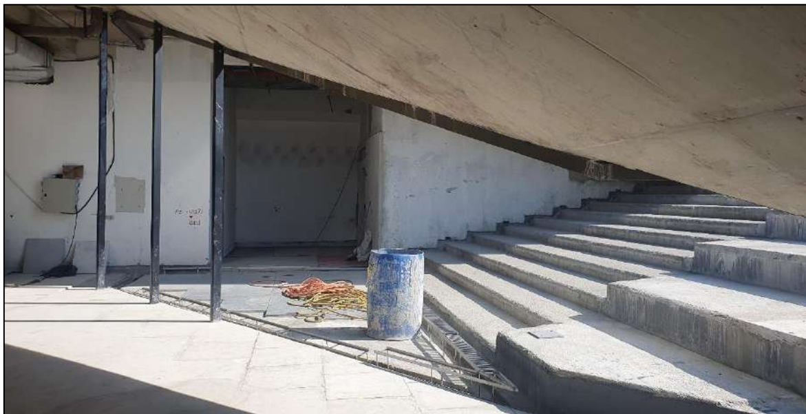
Figura 286: Ausência da porta de vidro
