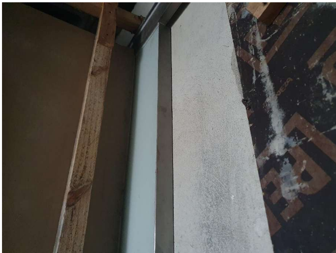
Figura 259: Demonstração da Patologia 2 no EWS 2.4
