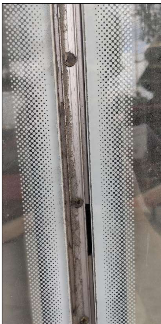
Figura 87: Demonstração da Patologia 3 no painel WW06
