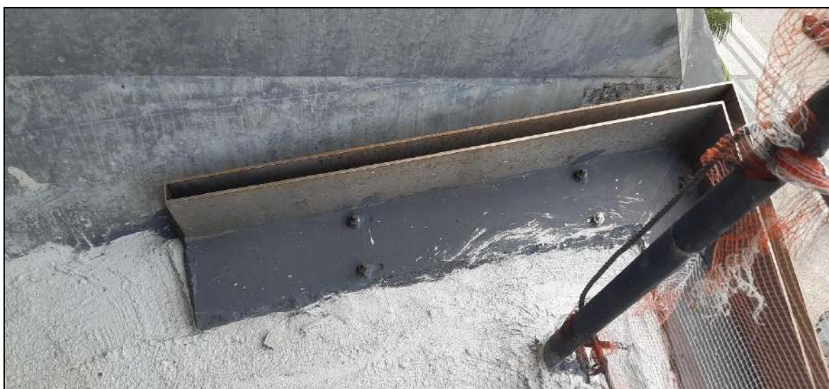
Figura 298: Ausência do vidro no guarda corpo G1C.
