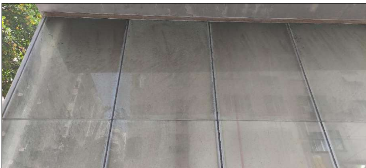
Figura 84: Demonstração da Patologia 2 no painel WW01
