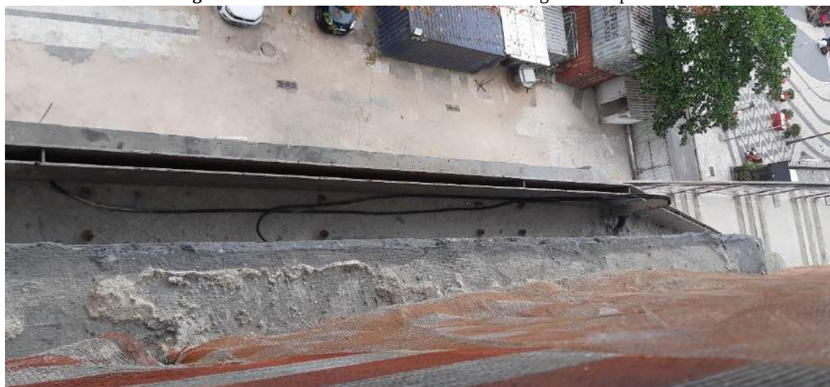
Figura 308: Ausência de vidro e de corrimão no guarda corpo G6
