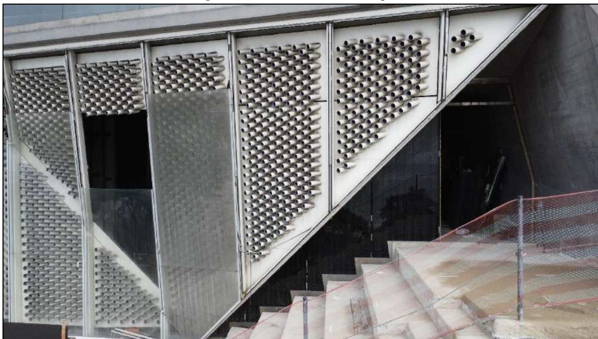
Figura 268: Ausência de vidros e porta
