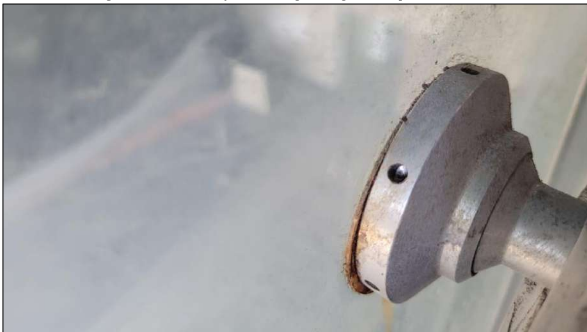
Figura 195: Demonstração da Patologia 3 no guarda-corpo interno GCI-2c
