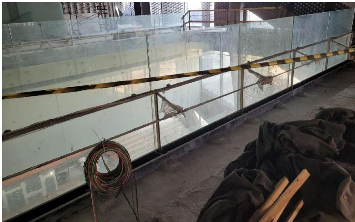
Figura 264: Demonstração da Patologia 1 nas Mesas Interativas do 2º pavimento
