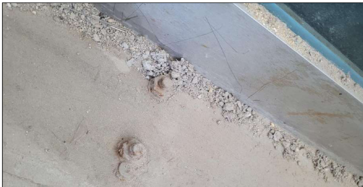
Figura 224: Demonstração da Patologia 10 no guarda-corpo GCI-1b
