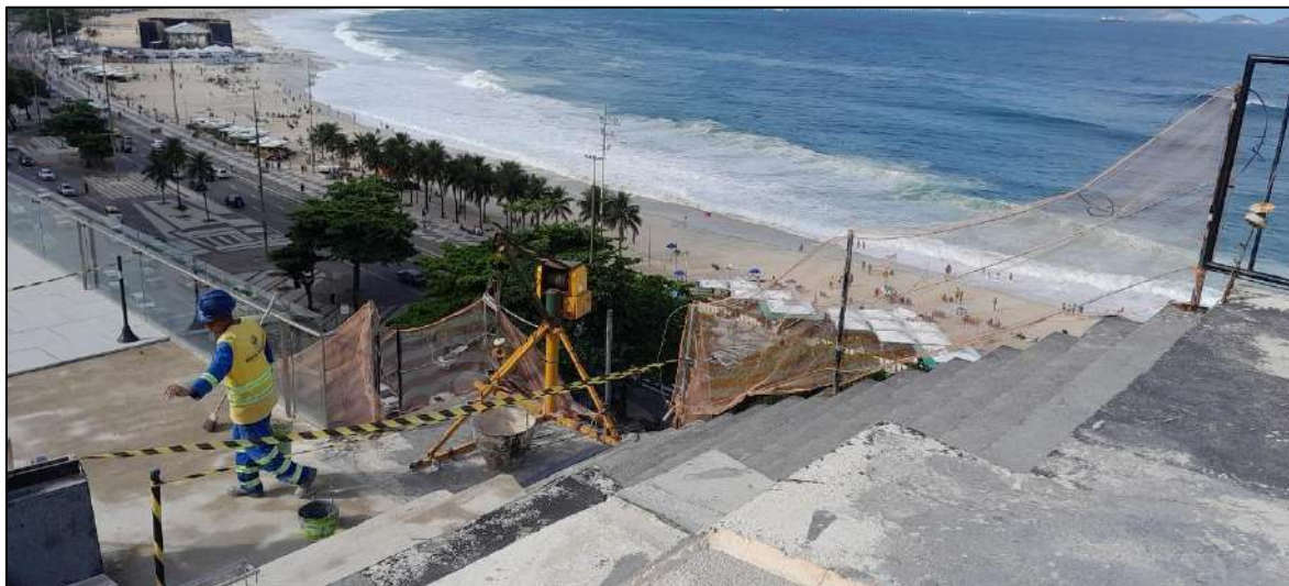
Figura 288: Ausência do corrimão EGR-2.2 na escada P
