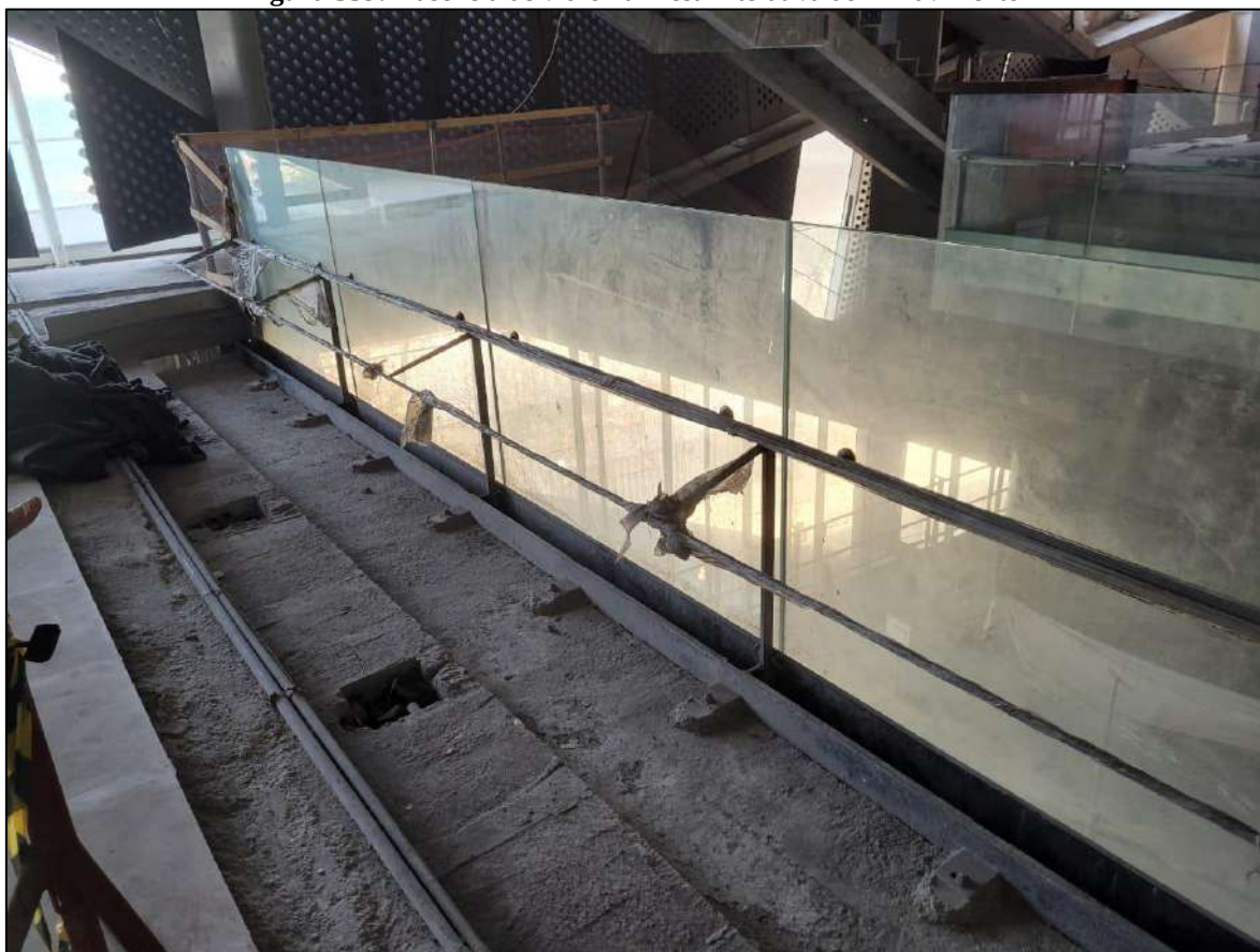
Figura 359: Ausência de vidro na Mesa Interativa do 2º Pavimento
