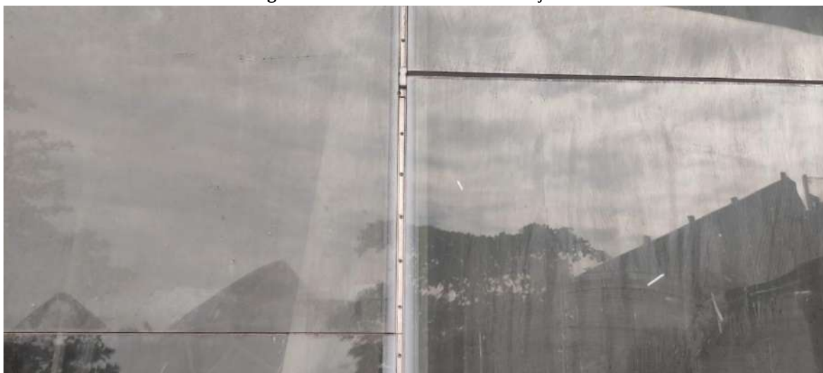
Figura 280: Ausência de silicone nas juntas
