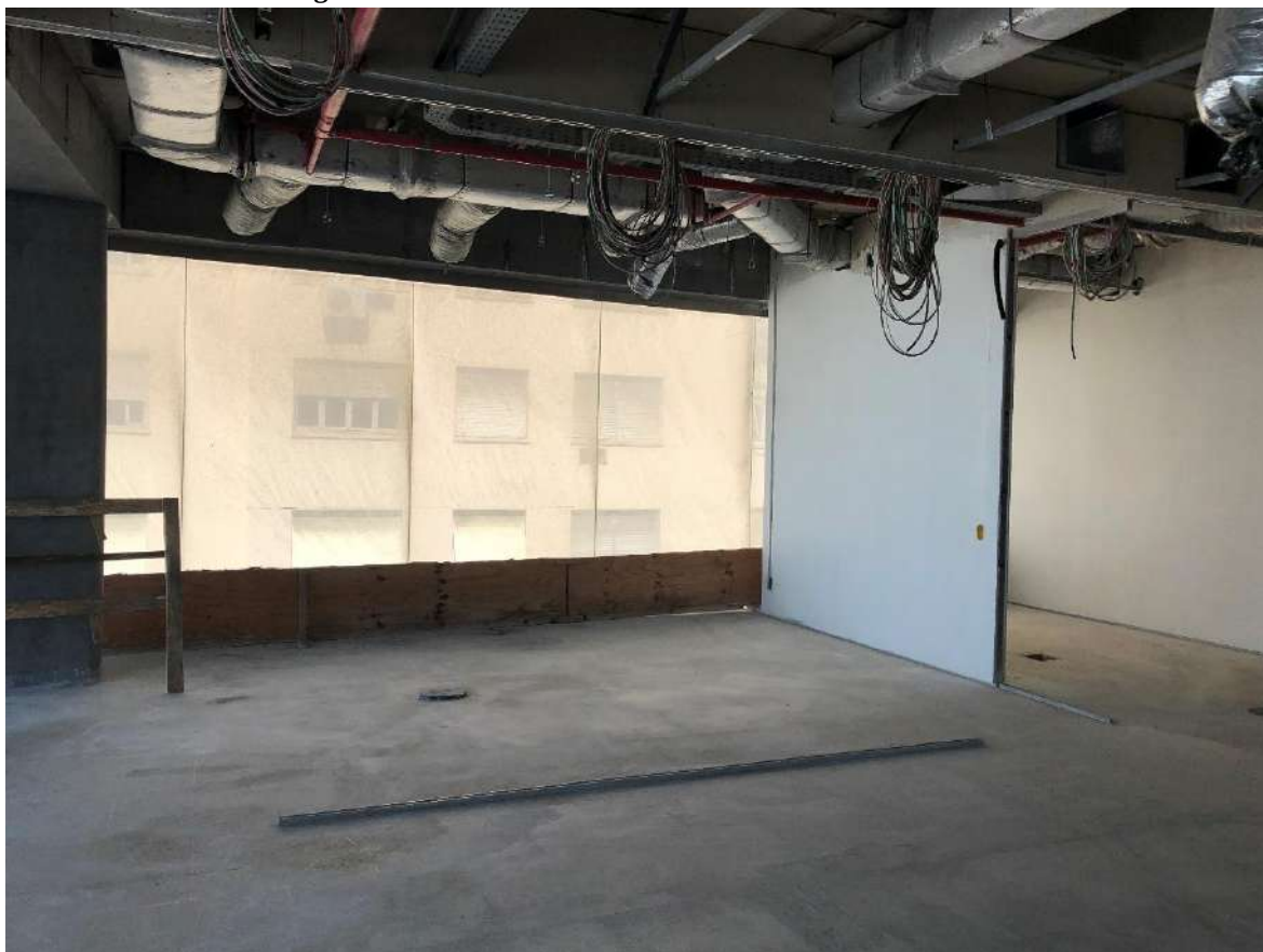
Figura 354: Ausência do vidro das divisórias DV7h e DV7k
