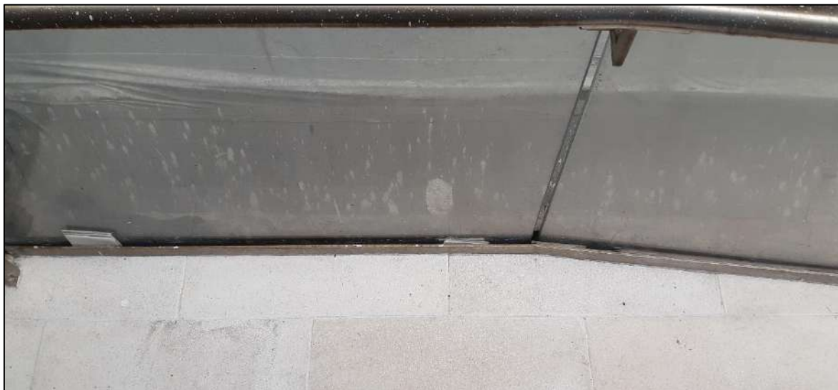
Figura 123: Demonstração da Patologia 3 no guarda corpo G4B
