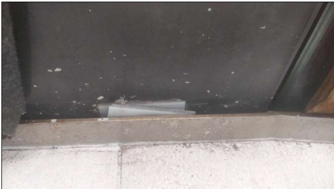
Figura 305: Ausência de silicone no guarda corpo G4B.
