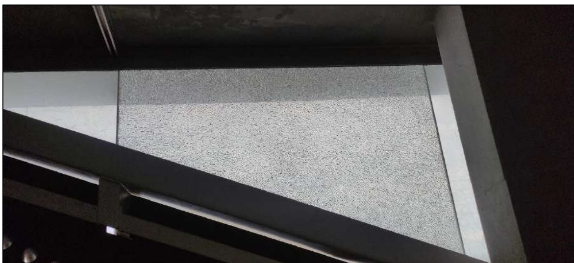
Figura 86: Demonstração da Patologia 2 no painel WW18
