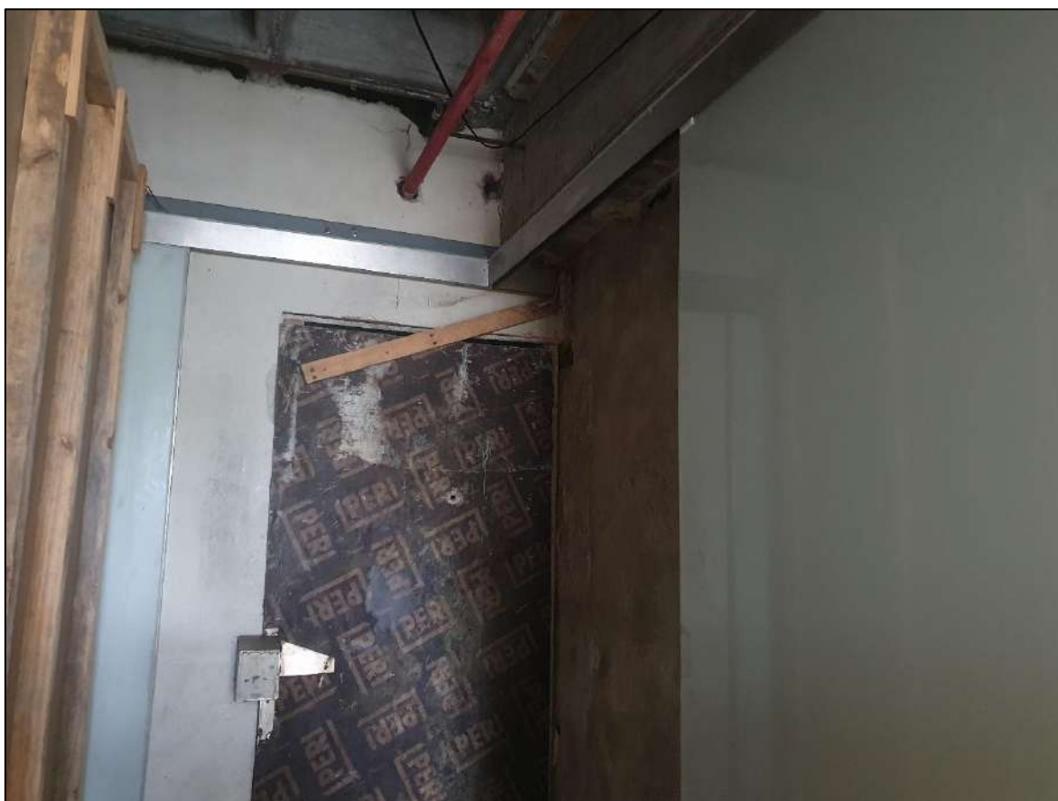
Figura 361: Ausência de vidro no revestimento EWS 2.4
