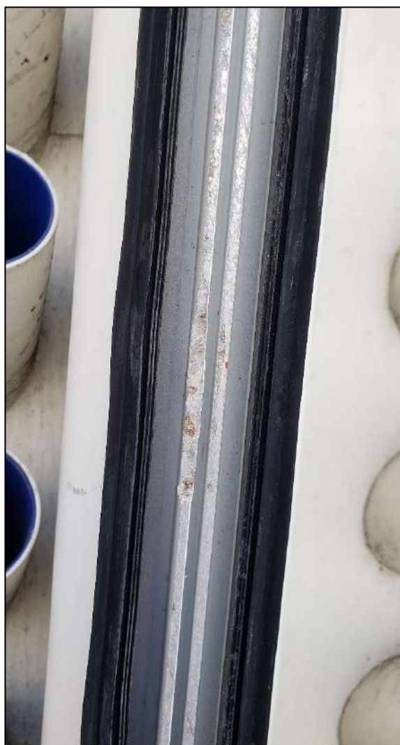
Figura 53: Demonstração da Patologia 13 no painel 4
