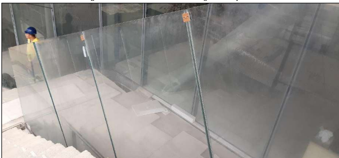
Figura 301: Ausência de corrimão no guarda corpo G2.
