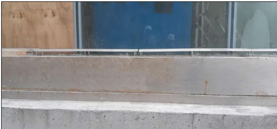
Figura 140: Demonstração da Patologia 9 no guarda corpo G5
