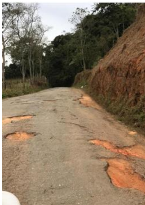
Figura 2 - Situação atual da principal via de acesso ao bairro de Boa Esperança, no município de Areal/RJ
