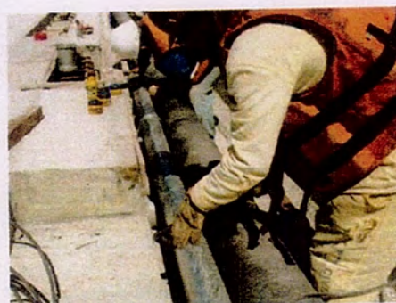
Figura 32: Rede de Água Potável e Combate a Incêndio instalada na canaleta de utilidades
