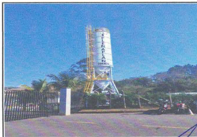
USINA DE CONCRETO
