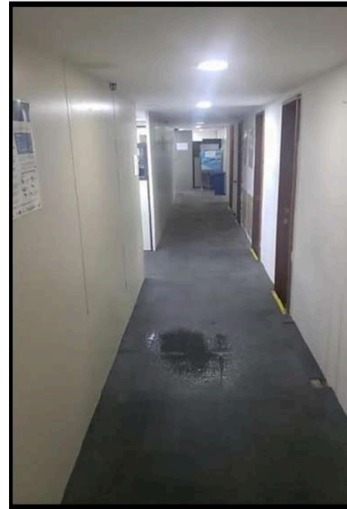
Foto 18/20 Poças de água sobre o piso elevado - 01
