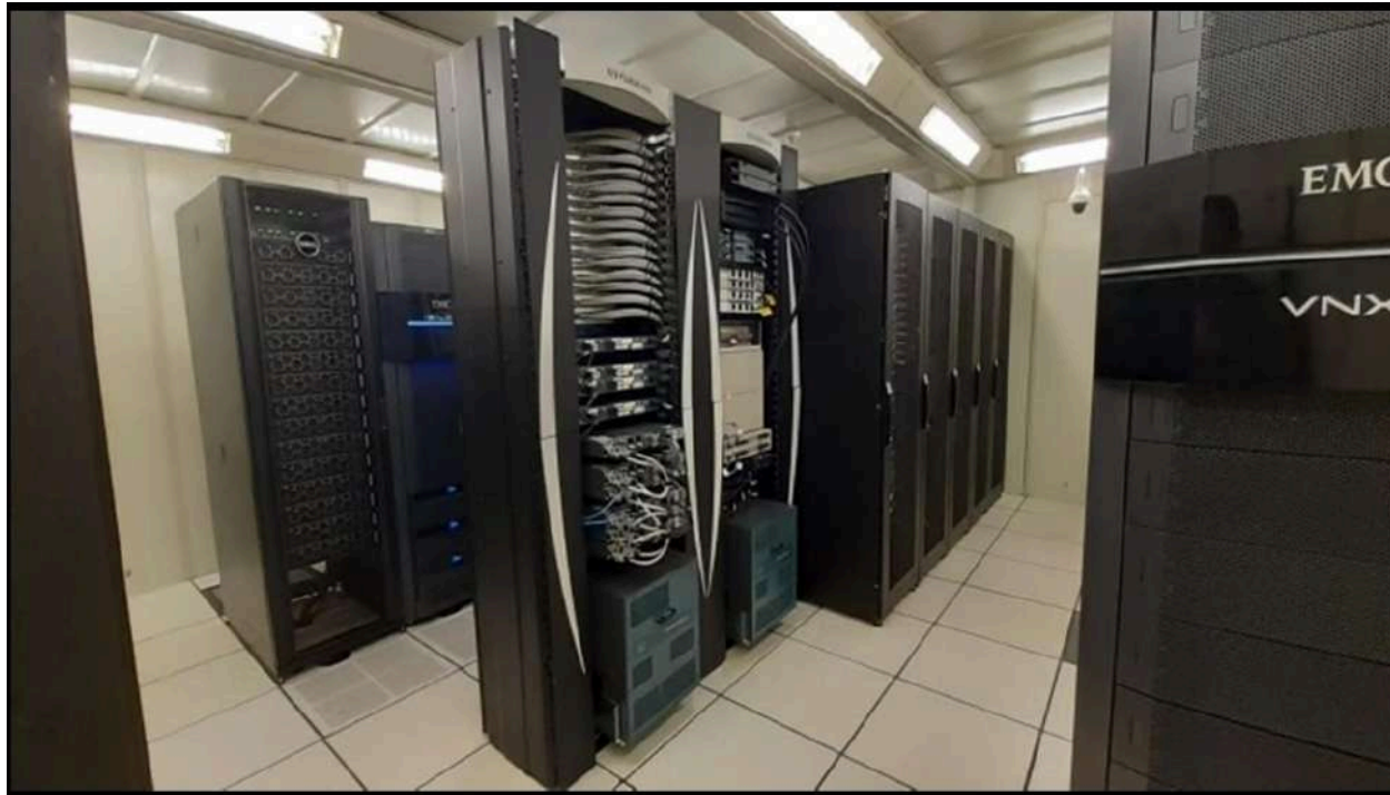
Foto 3/4 Data Center no Centro de Comando e Controle - CICC
