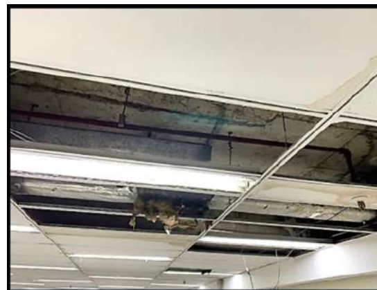
Foto 04/20 Estado do forro após sinistro - 04
