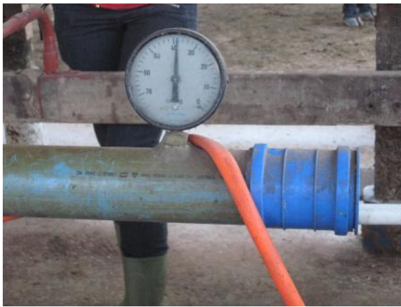
Figura 11: Registro de intensidade de vácuo.
