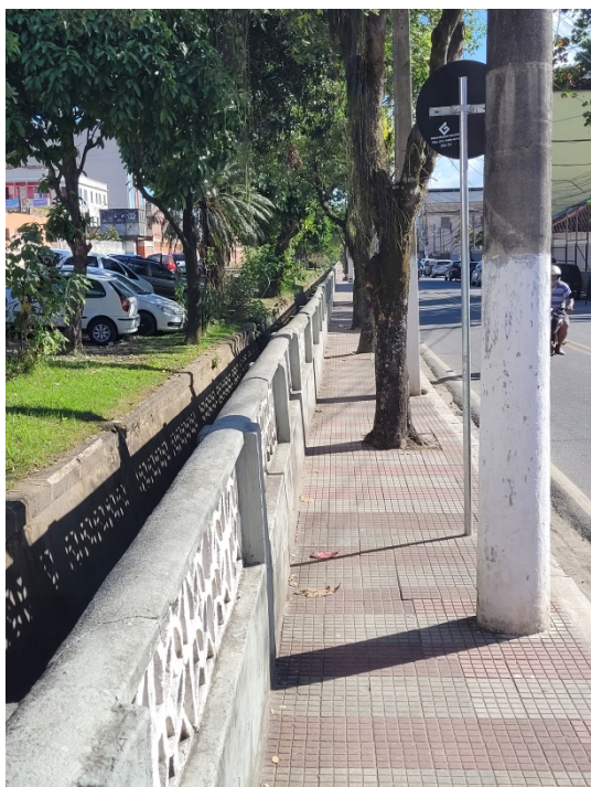
Figura 9: Calçada com largura insuficiente
