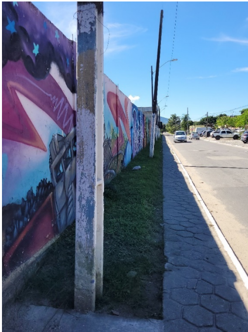
Figura 135: Calçada sem largura adequada
