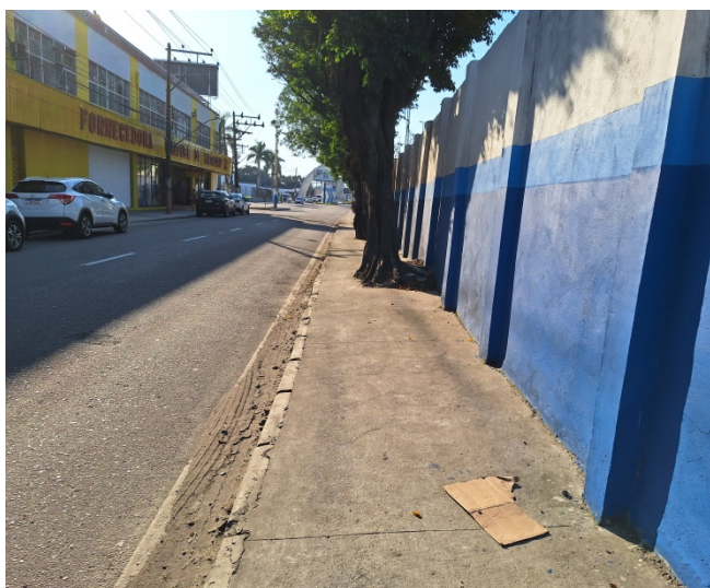
Figura 5: Calçada com largura insuficiente (Obstáculos fixos)
