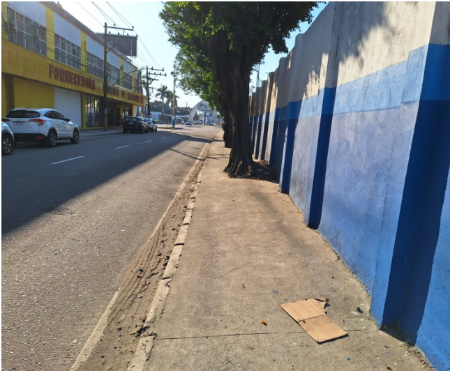
Figura 130: Calçada com largura insuficiente (obstáculos fixos)
