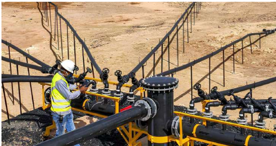
Figura 47: Poço de Captação de Biogás
