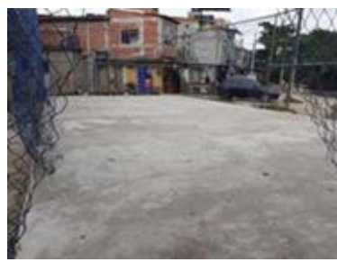
Figura 08: Foto de uma quadra incompleta com proteção danificada tirada durante a visita técnica.
