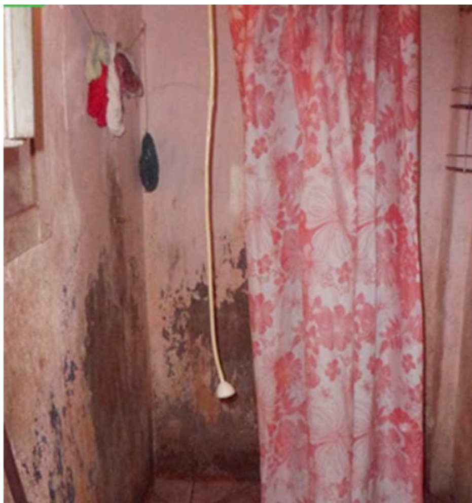
Figura 01: Umidade em banheiro (LEANDRO HABERLI, 2015)
