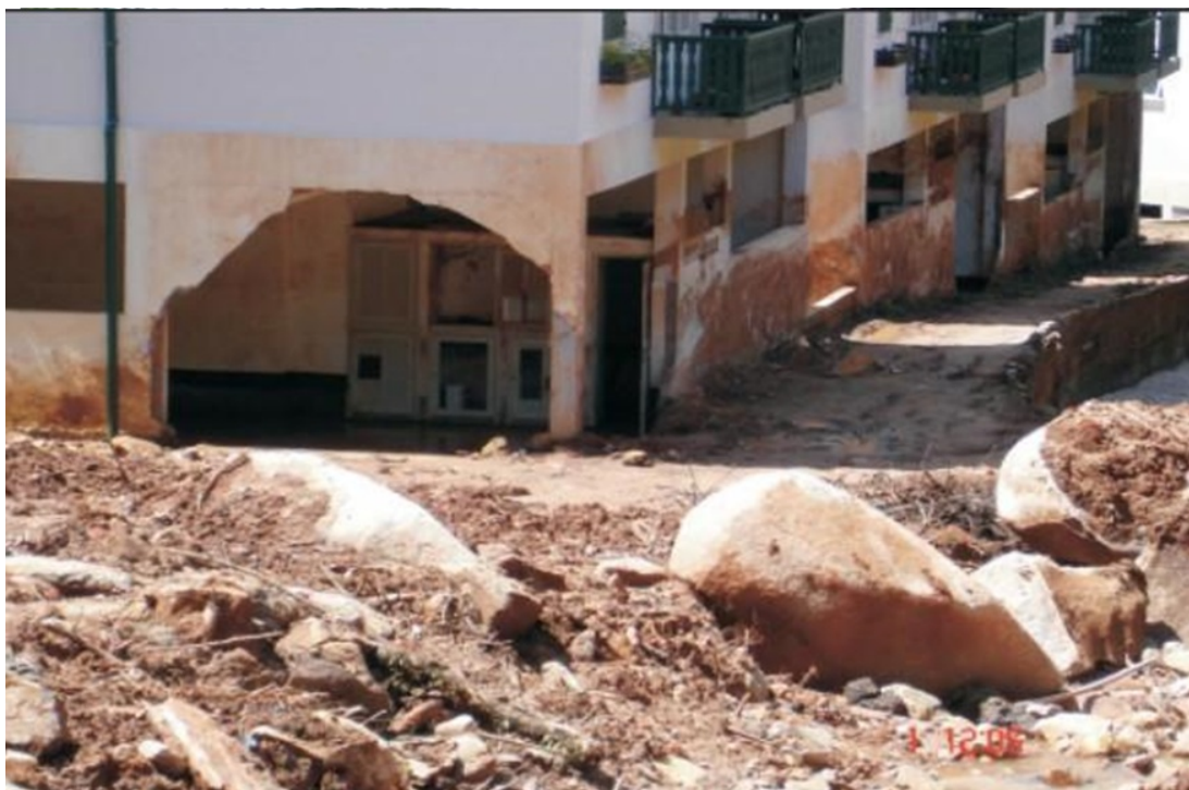
Figura 14: Fotografia de localidade em Vila Nova, após o incidente de 2011 (Fonte: CPRM)
