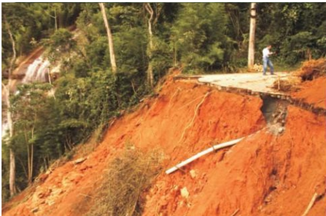
Figura 12: Fotografia de localidade em Vila Nova, após o incidente de 2011 (Fonte: CPRM)
