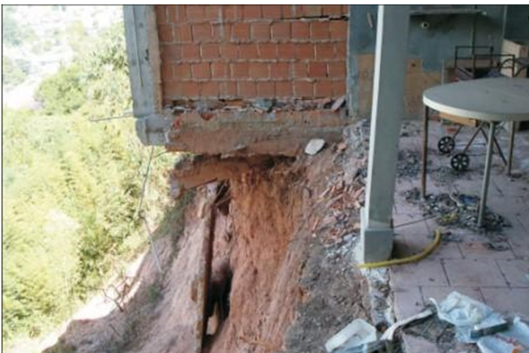
Figura 07: Fotografia de localidade em Vila Nova, após o incidente de 2011 (Fonte: CPRM)
