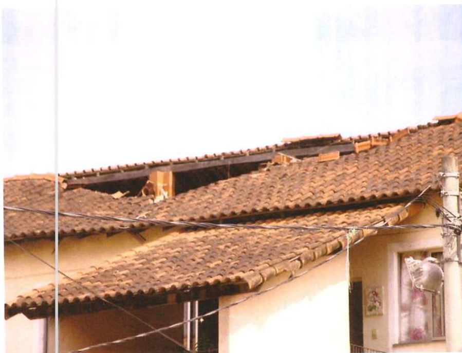
Foto 11: Telhado parcialmente quebrado, necessita urgentemente da troca dessas telhas. (Fonte: SEINFRA/SUBHAB)
