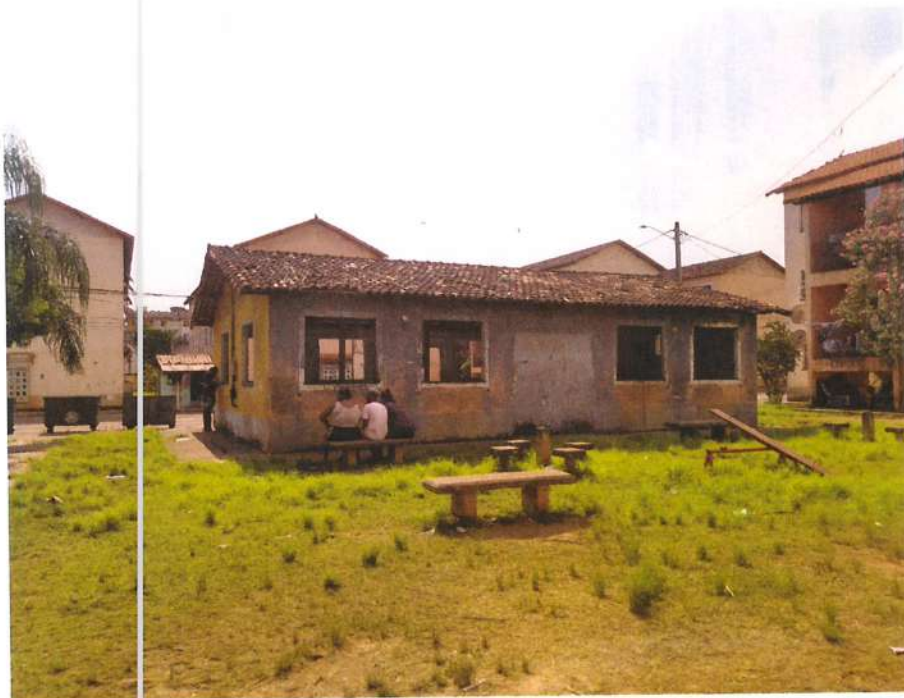
Foto 6: Salão de festas em péssimo estado de conservação, brinquedos e mesas quebrados. (Fonte: SEINFRA/SUEHAB)
