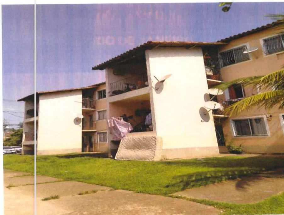
Foto 3: Pintura de fachada dos prédios em má conformidade. (Fonte: SEINFRA/SUBHAB)
