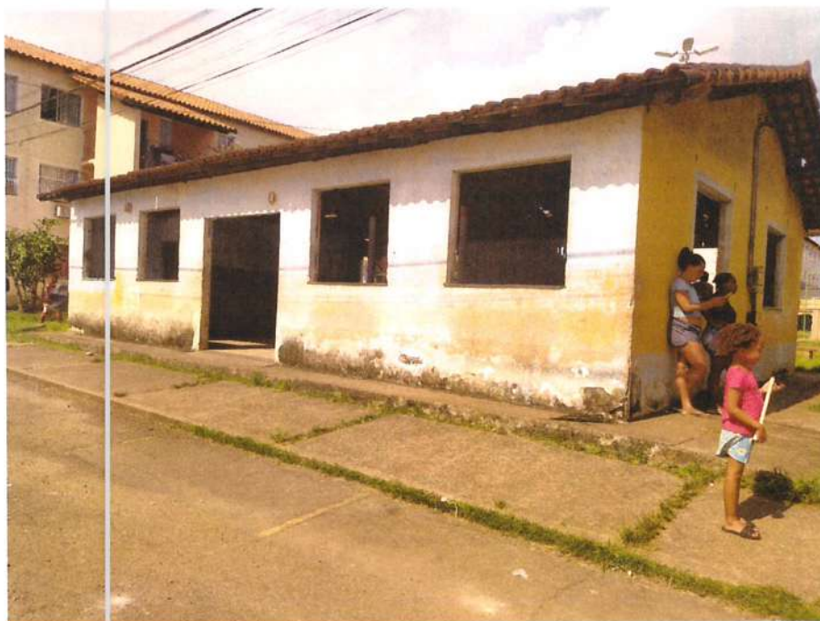
Foto 5: Salão de festas do conjunto em péssimo estado de conservação. (Fonte: SEINFRA/SUBHAB)
