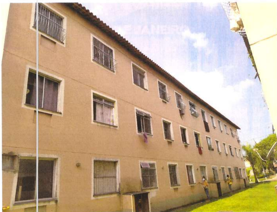
Foto 4: Pintura de fachada dos prédios em má conformidade. (Fonte: SEINFRA/SUBHAB)
