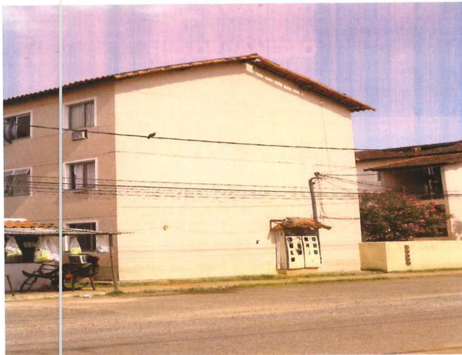
Foto 10: Prédio necessitando de pintura de fachadas e troca de algumas telhas. (Fonte: SEINFRA/SUBHAB)
