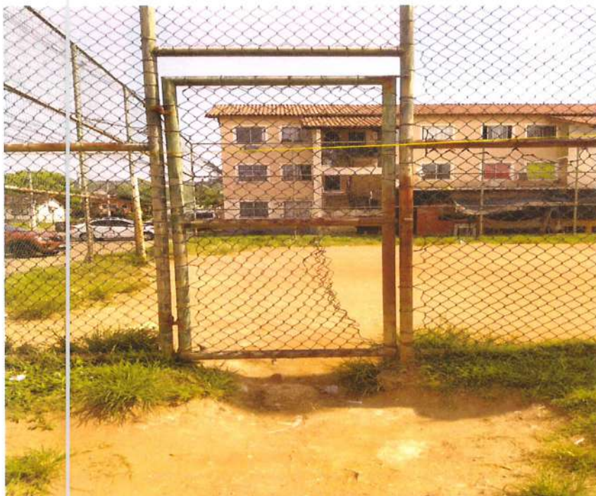
Foto 8: Alambrado da quadra com as telas danificadas. (Fonte: SEINFRA/SUBHAB)
