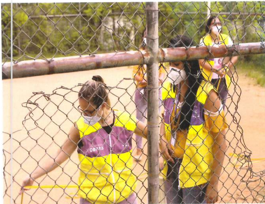
Foto 14: Quadra de terra batida necessita de troca de alambrado e traves. (Fonte: SEINFRA/SUBHAB)
