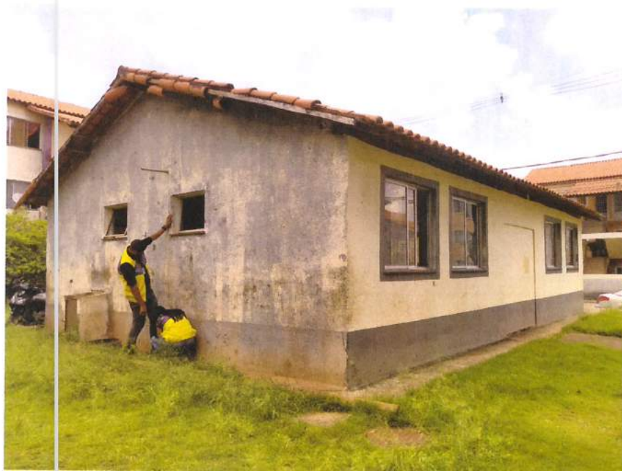
Foto 5: Área de salão de festas em péssimo estado de conservação. (Fonte: SEINFRA/SUBHAB)
