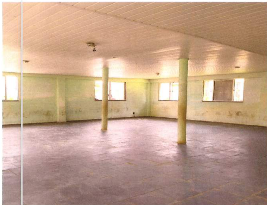
Foto 6: Área de salão de festas em péssimo estado de conservação. (Fonte: SEINFRA/SUBHAB)
