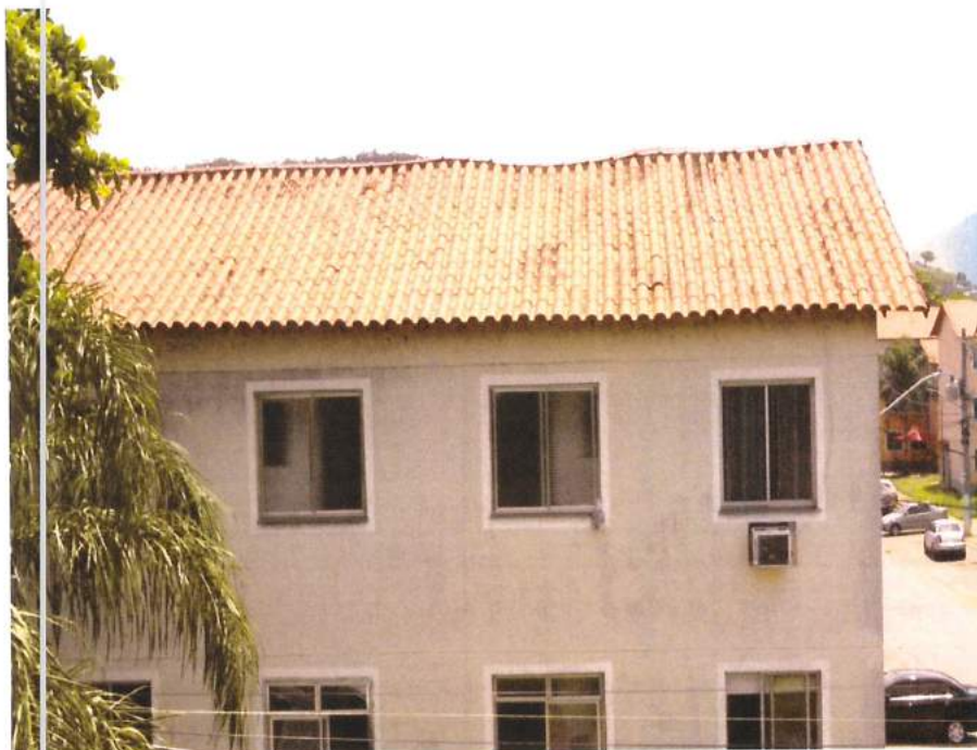
Foto 12: Madeiramento de sustentação do telhado em estado de má conformidade. (Fonte: SEINFRA/SUBHAB)
