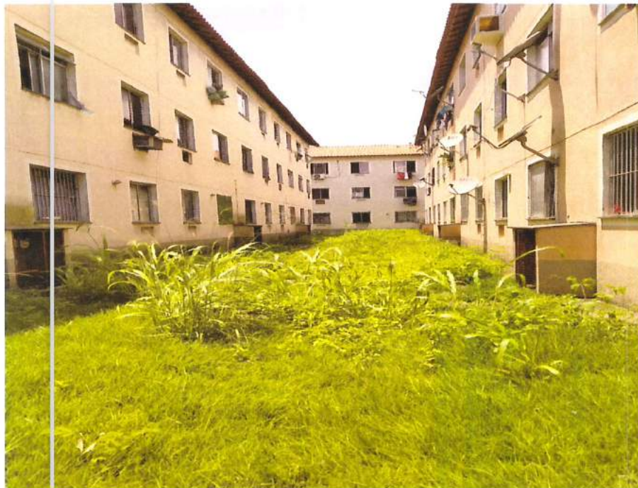
Foto 10: Área de vegetação em má estado de conservação, necessitando de manutenção. (Fonte: SEINFRA/SUBHAB)
