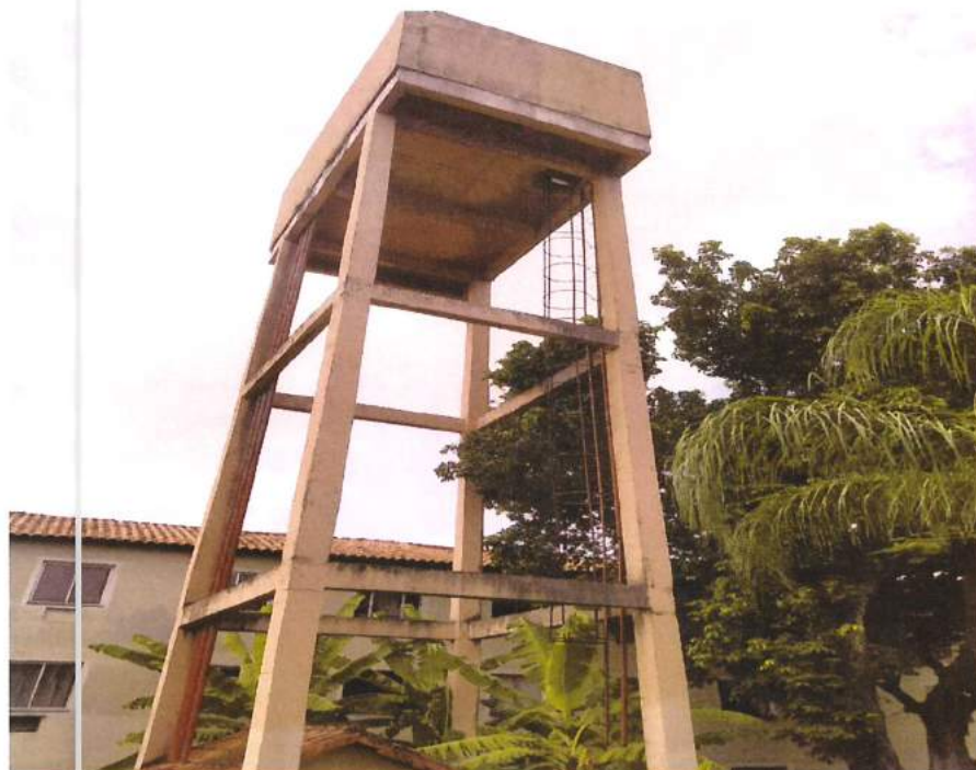
Foto 13: Área de caixa d'água, necessitando de manutenção. (Fonte: SEINFRA/SUBHAB)
