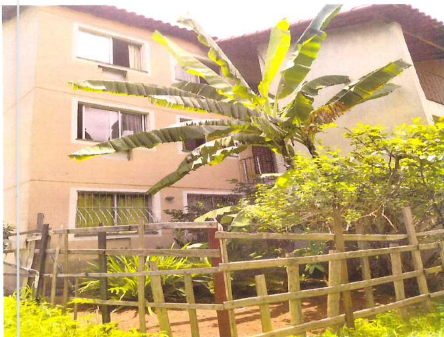
Foto 9: Ocupação irregular de área comum. (Fonte: SEINFRA/SUBHAB)
