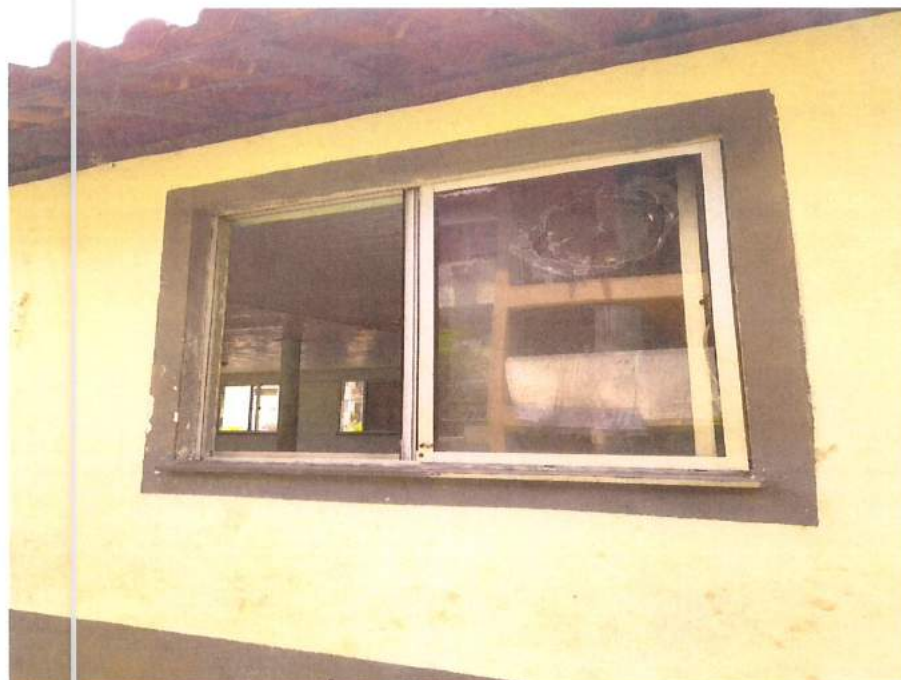
Foto 7: Área de salão de festas em péssimo estado de conservação. (Fonte: SEINFRA/SUBHAB)
