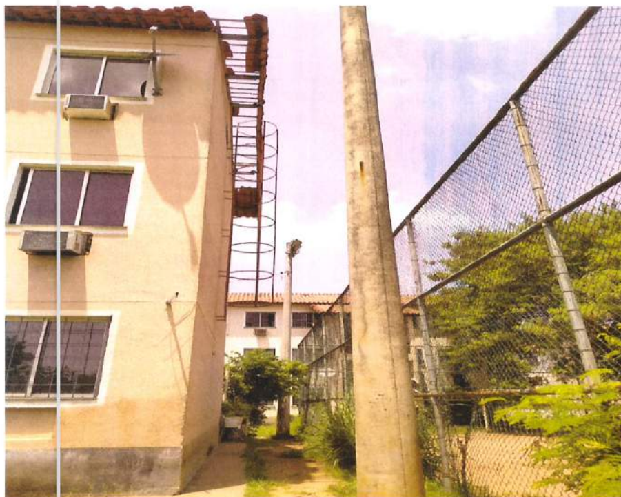
Foto 16: Cobertura do prédio apresentando estado de conservação precário, diversas telhas quebradas. (Fonte: SEINFRA/SUBHAB)
