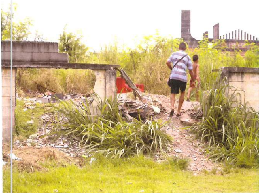
Foto 13: Parte do muro nos fundos do conjunto quebrado, moradores utilizam área para acesso a estação de trem. (Fonte: SEINFRA/SUBHAB)
