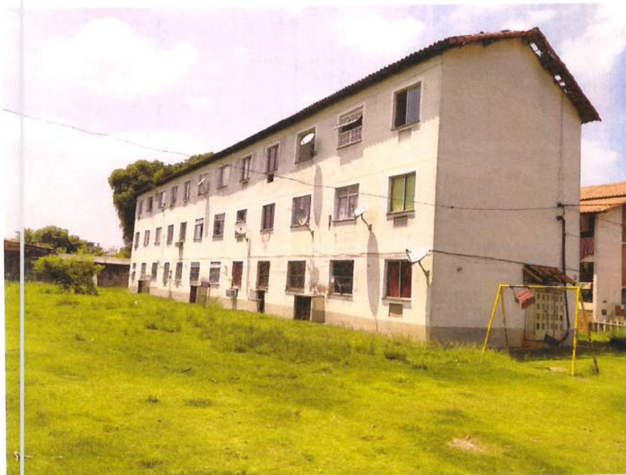
Foto 15: Fachada do prédio apresentando estado de conservação ruim. (Fonte: SEINFRA/SUBHAB)
