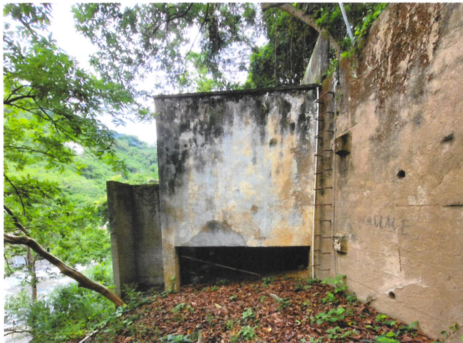
Foto 8: Reservatório maior com mofo e cobertura vegetal (Fonte: SEINFRA/SUBHAB)
