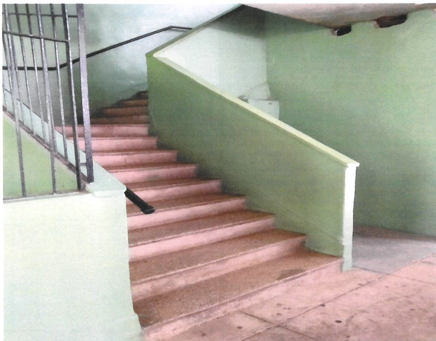
Foto 10: Há necessidade de corrimão no outro lado da escada. (Fonte: SEINFRA/SUBHAB)
