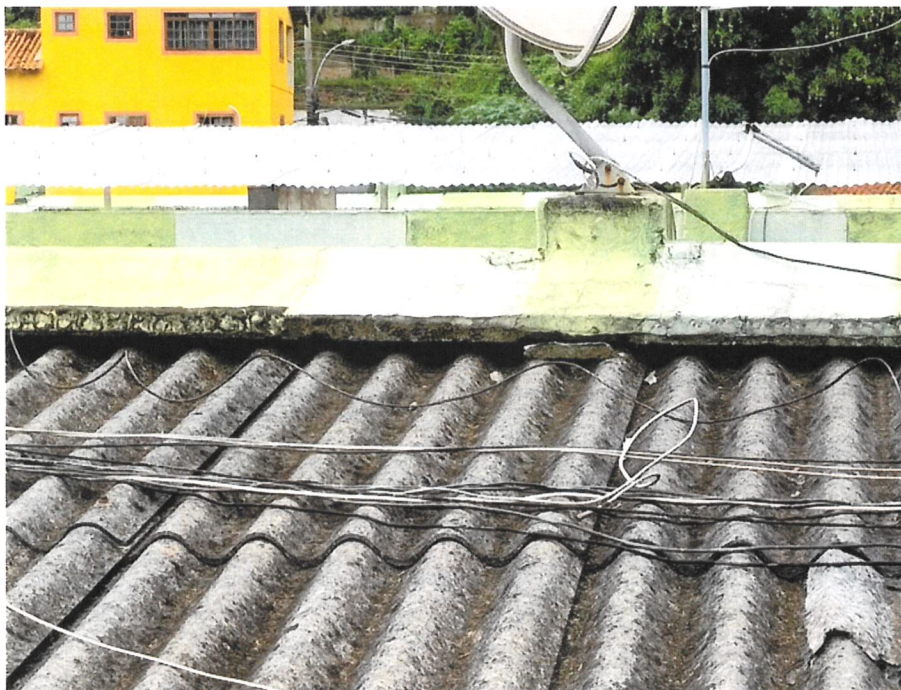
Foto 6: Rufos com deslocamento sobre telhado. (Fonte: SEINFRA/SUBHAB)
