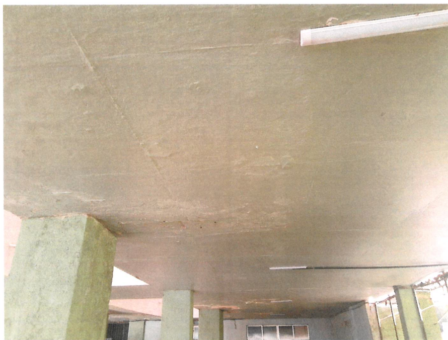
Foto 3: Pintura danificada. (Fonte: SEINFRA/SUBHAB)
