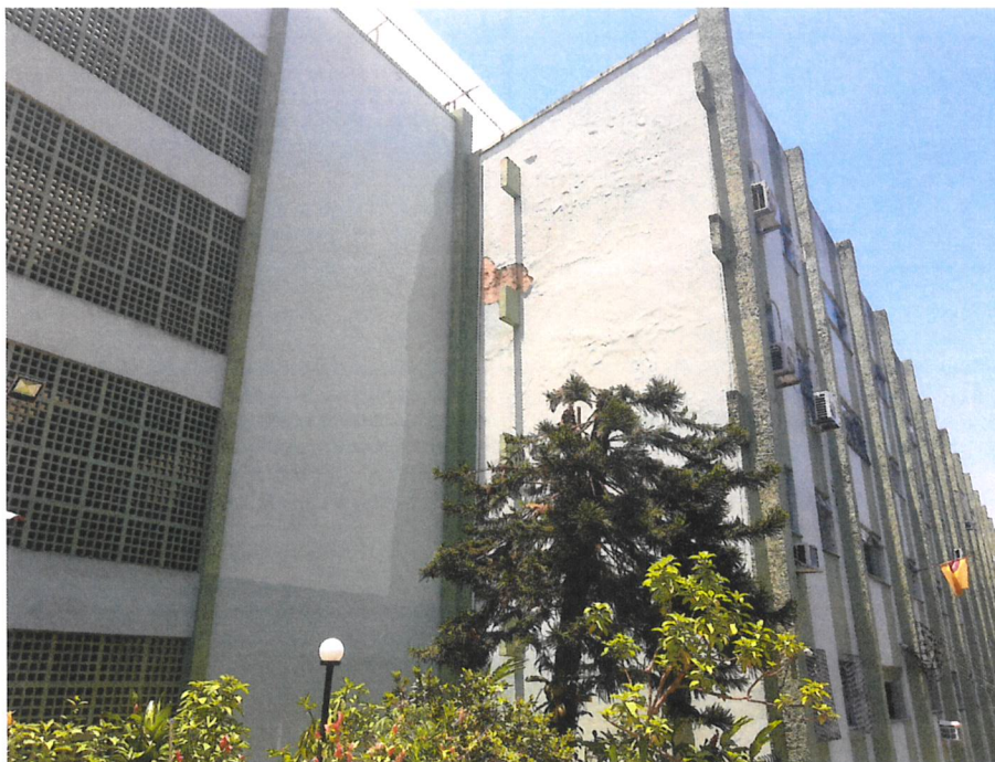
Foto 2: Pintura deteriorada. (Fonte: SEINFRA/SUBHAB)
