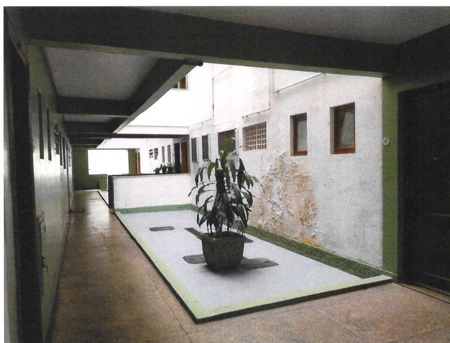
Foto 18: Circulação comum apresentando infiltrações. (Fonte: SEINFRA/SUBHAB)
