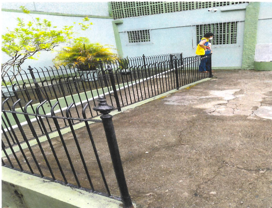
Foto 15: Parte da calçada na parte interna do conjunto danificada. (Fonte: SEINFRA/SUBHAB)
