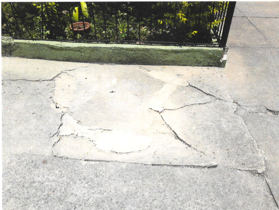
Foto 12: Parte da calçada na parte interna do conjunto danificada. (Fonte: SEINFRA/SUBHAB)
