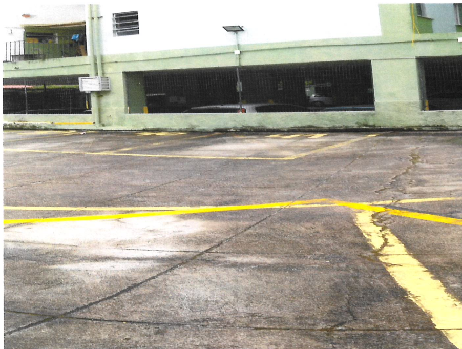
Foto 16: Parte do piso do estacionamento do conjunto danificada. (Fonte: SEINFRA/SUBHAB)
