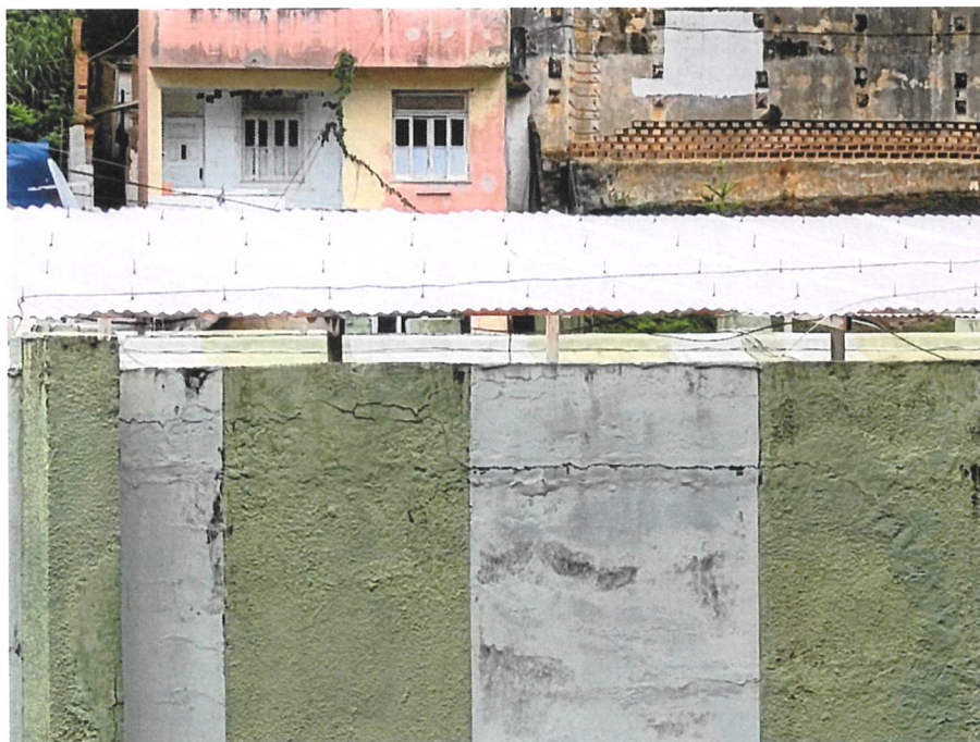
Foto 9: Fissuramento próximo a ligação laje-platibanda. (Fonte: SEINFRA/SUBHAB)
