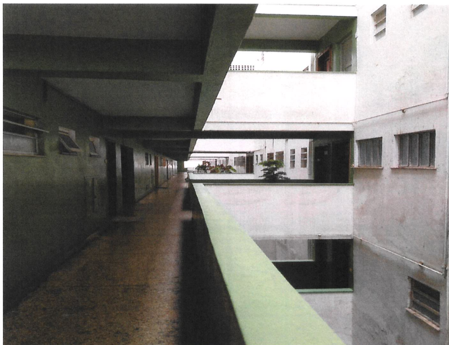
Foto 17: Circulação comum apresentando infiltrações. (Fonte: SEINFRA/SUBHAB)
