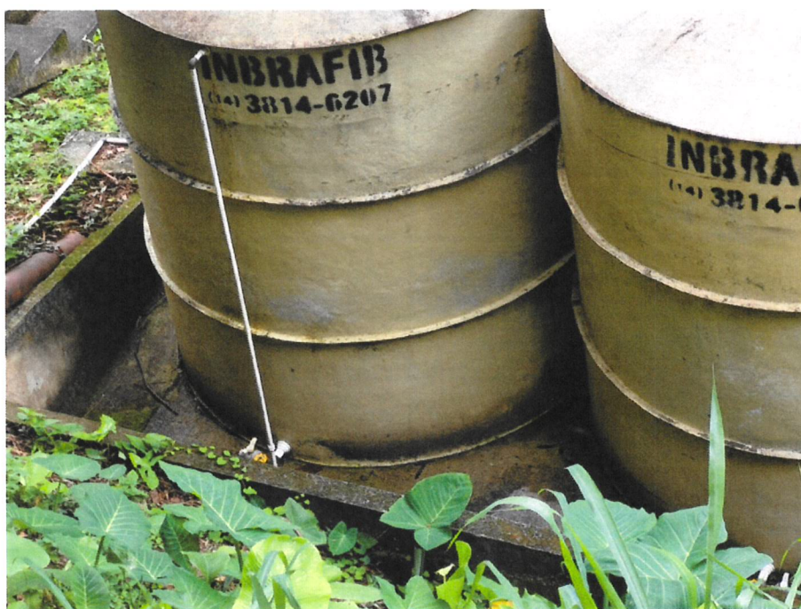
Foto 5: Caixa de fibra com vazamento pequeno. (Fonte: SEINFRA/SUBHAB)
