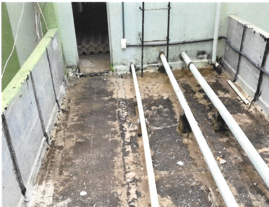
Foto 4: Laje com impermeabilização deficiente. (Fonte: SEINFRA/SUBHAB)
