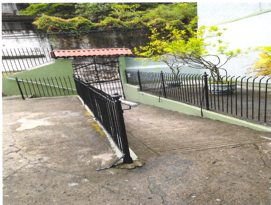
Foto 14: Parte rampa de acessibilidade ao conjunto danificada. (Fonte: SEINFRA/SUBHAB)
