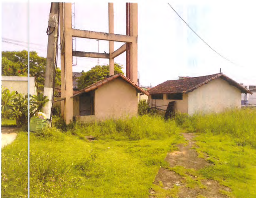
Foto 10: Castelo metálico d'água e casa de bomba em mau estado de conservação. (Fonte: SEINFRA/SUBHAB)
