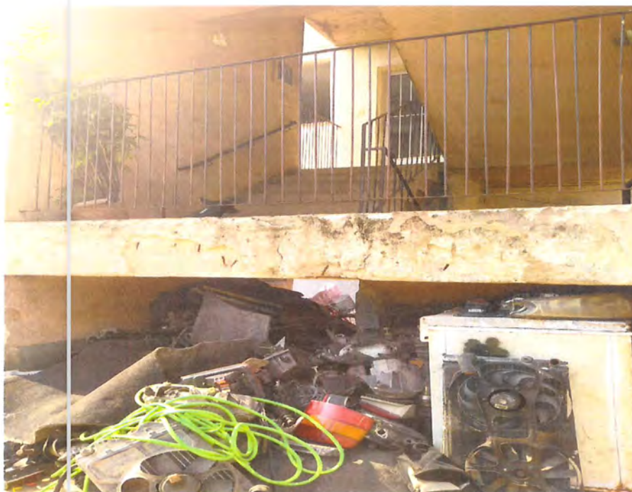
Foto 5: Área de acesso a escada com grande concentração de lixo. (Fonte: SEINFRA/SUBHAB)
