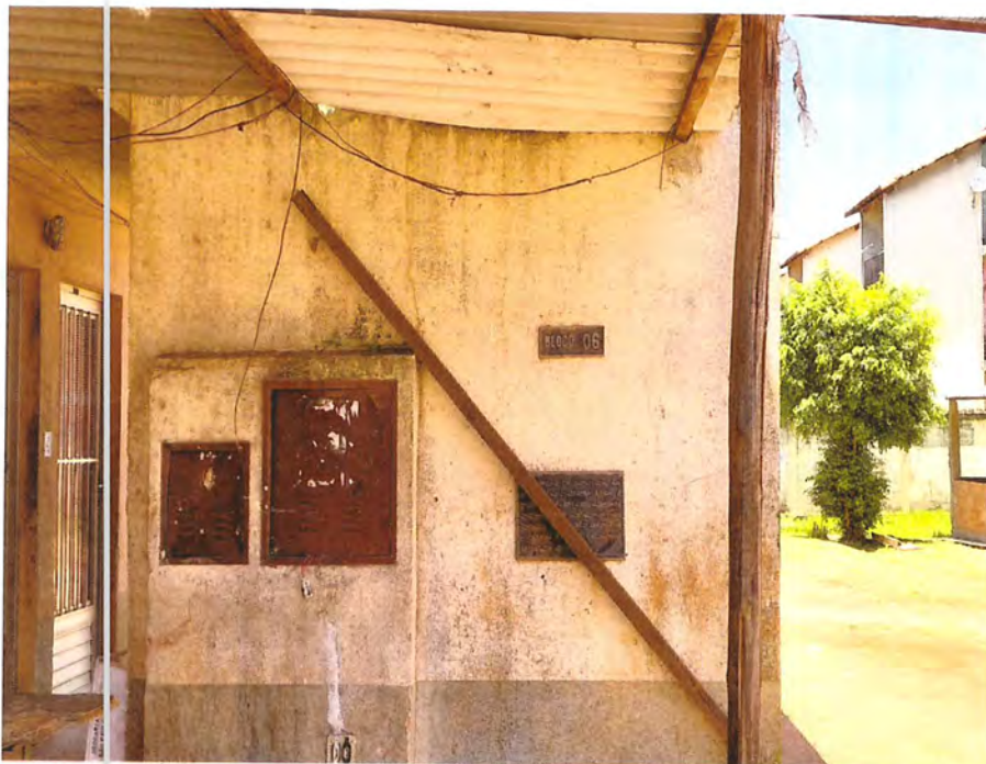
Foto 12: Área de construções irregulares nos blocos em mau estado de conservação. (Fonte: SEINFRA/SUBHAB)
