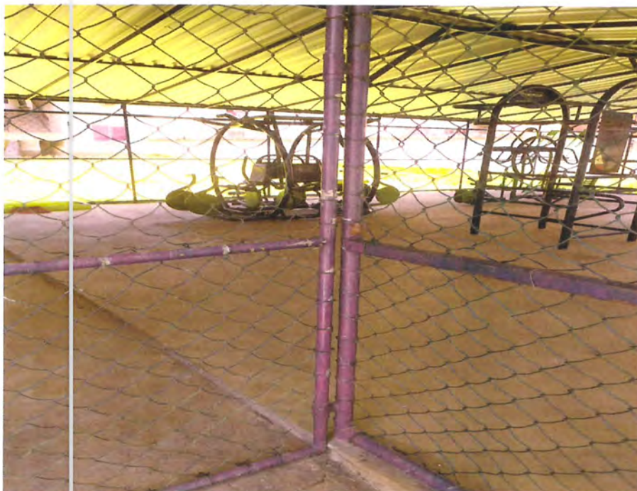
Foto 14: Área de academia 3ª idade necessitando de pintura. (Fonte: SEINFRA/SUBHAB)
