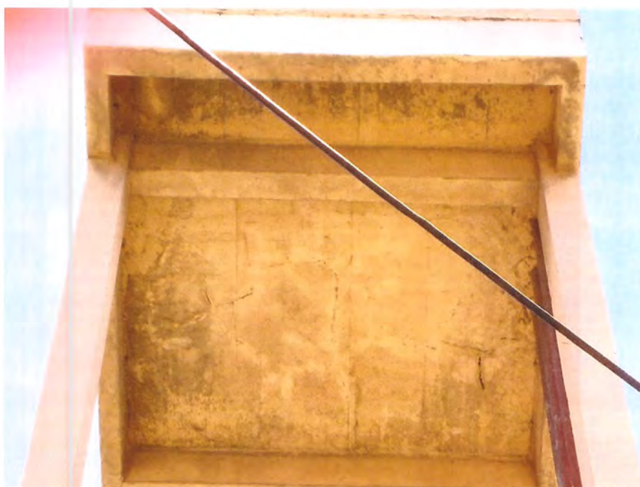
Foto 9: Castelo d'água necessitando de pintura e impermeabilização. (Fonte: SEINFRA/SUBHAB)
