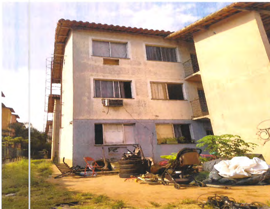
Foto 4: Fachada dos prédios necessitando de pintura. Concentração de lixo no entorno do bloco. (Fonte: SEINFRA/SUBHAB)
