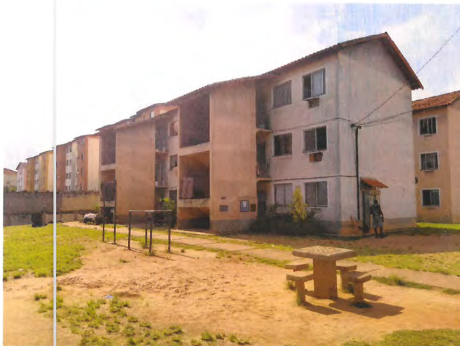
Foto 3: Fachada dos prédios necessitando de pintura. (Fonte: SEINFRA/SUBHAB)
