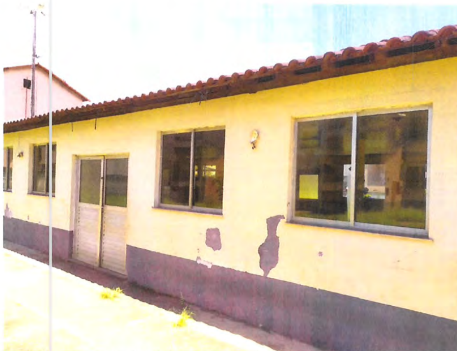
Foto 8: Área externa do salão de festas necessitando de pintura e alguns vidros das janelas quebrados. (Fonte: SEINFRA/SUBHAB)
