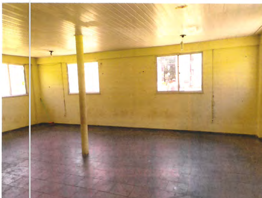
Foto 7: Área interna do salão de festas em mau estado de conservação. (Fonte: SEINFRA/SUBHAB)
