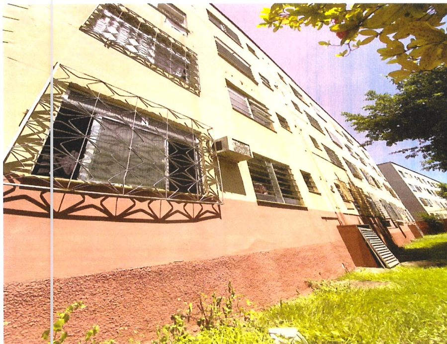
Foto 10: Área lateral do conjunto necessitando de manutenção. (Fonte: SEINFRA/SUBHAB)
