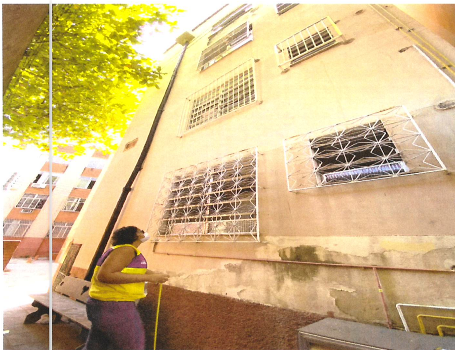
Foto 4: Fachada dos prédios necessitando de pintura, apresenta problemas hidráulicos na parte interna de alguns apartamentos. (Fonte: SEINFRA/SUBHAB)
