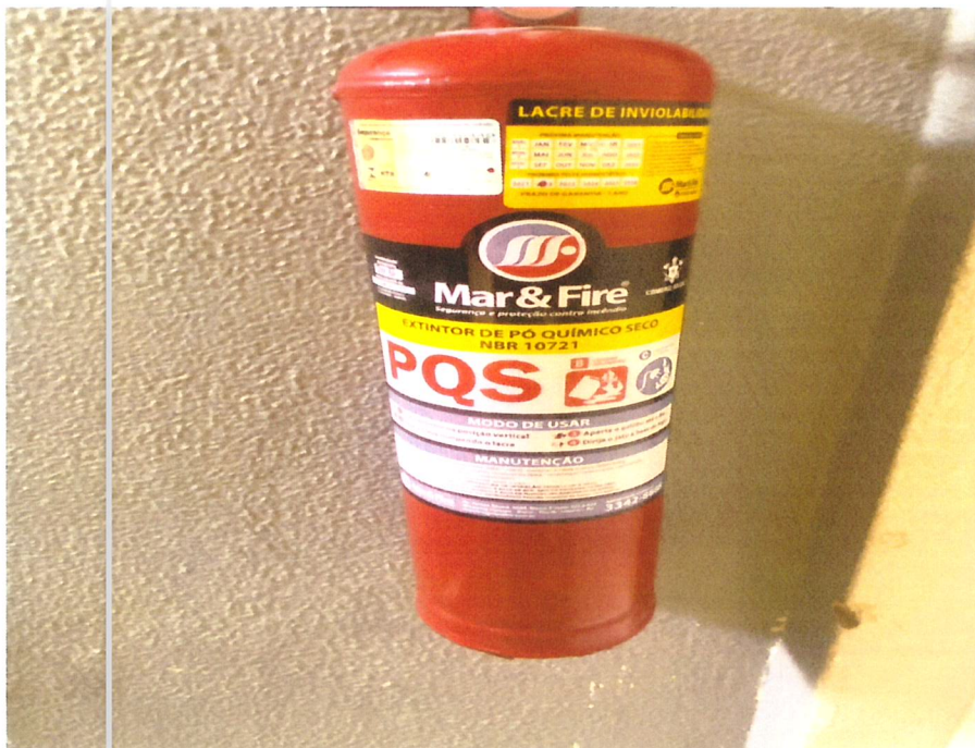
Foto 16: Extintores de incêndio dentro do prazo de validade para uso. (Fonte: SEINFRA/SUBHAB)
