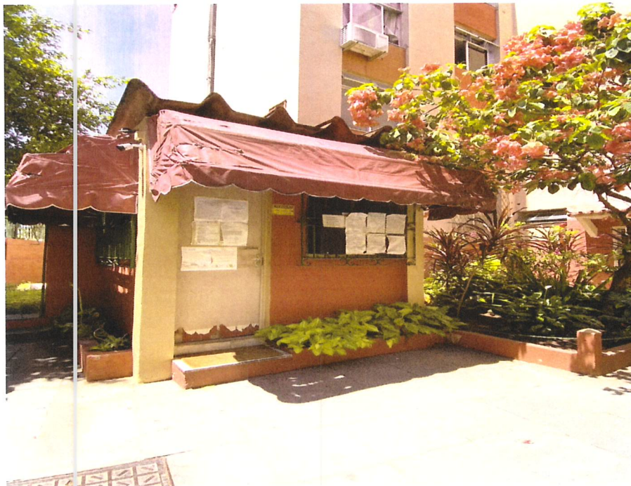
Foto 6: Portaria do conjunto necessita de manutenção e pintura. (Fonte: SEINFRA/SUBHAB)
