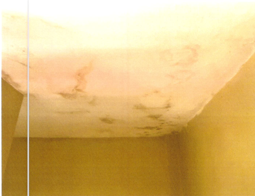
Foto 12: Foi verificado alguns pontos de infiltrações no 4º andar nos blocos. (Fonte: SEINFRA/SUBHAB)
