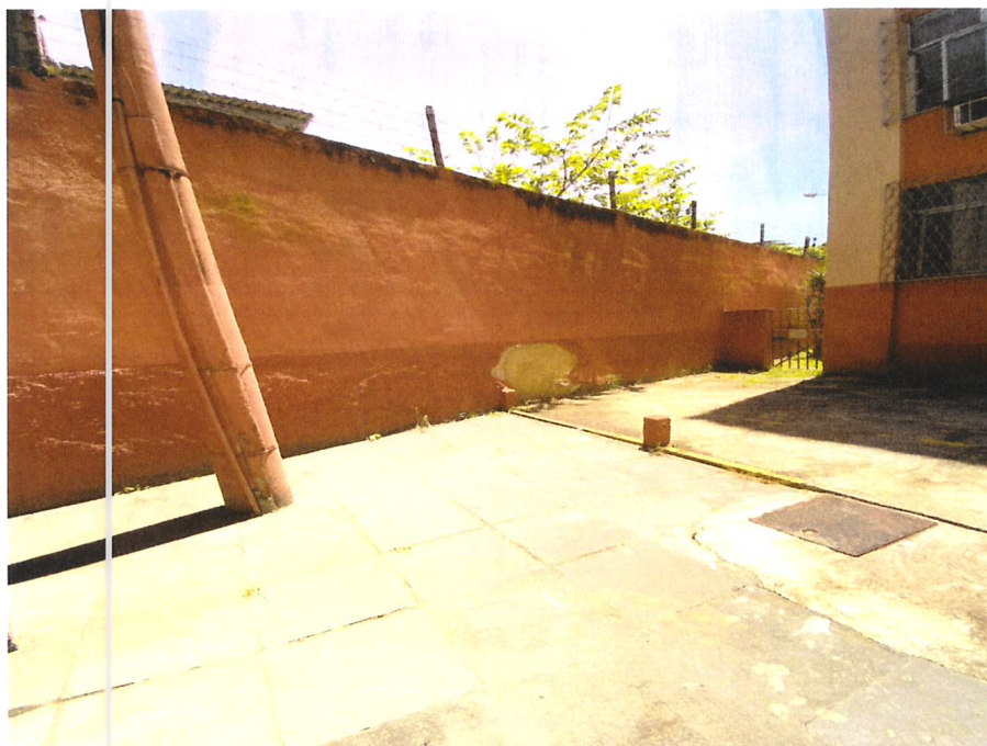
Foto 5: Os muros necessitam de reparos e pintura. (Fonte: SEINFRA/SUBHAB)
