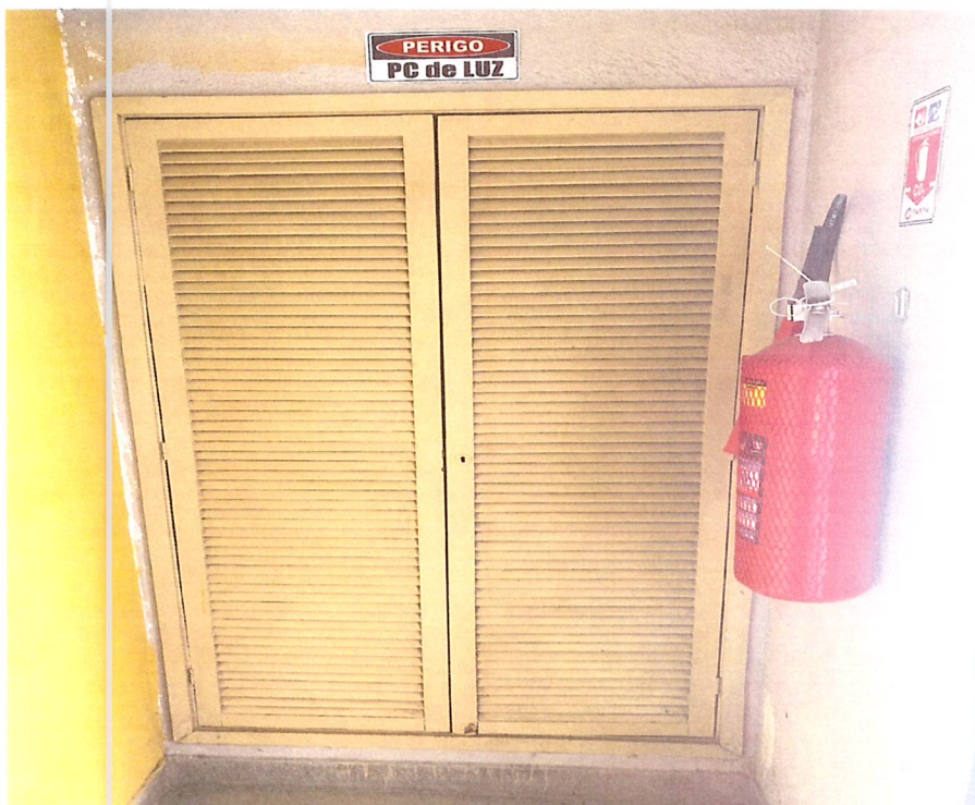
Foto 14: Necessita de atualizações dos Pc's elétricos segundo as Normas da Recon 2021. (Fonte: SEINFRA/SUBHAB)
