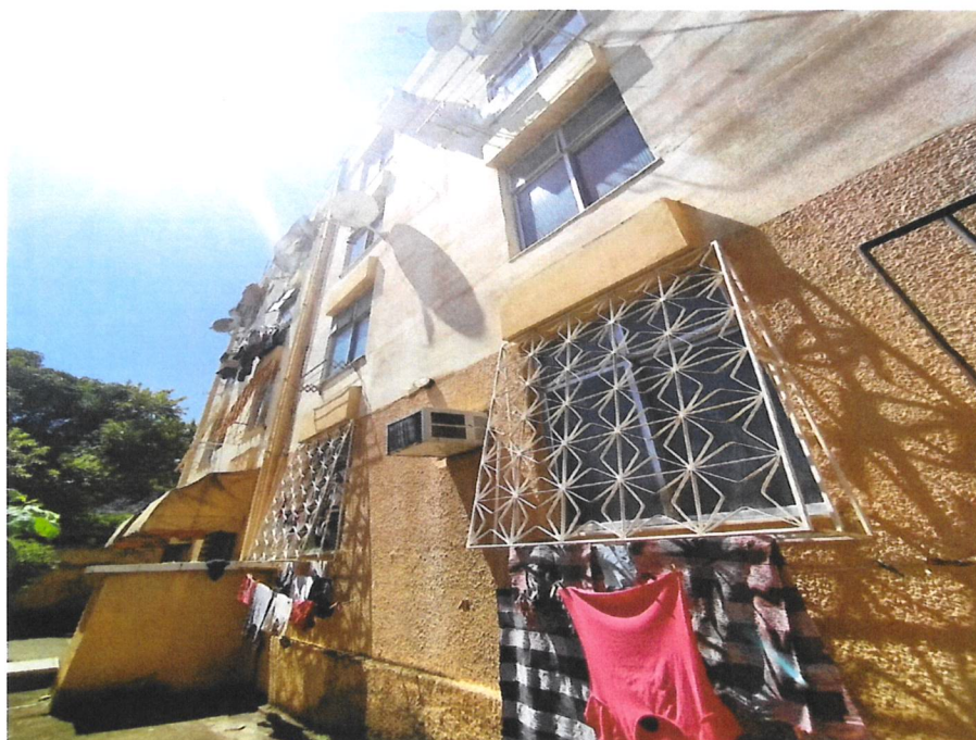
Foto 10: Algumas fachadas descaracterizadas, com a colocação de aparelhos de ar condicionado, telhados e esquadrias. (Fonte: SEINFRA/SUBHAB)
