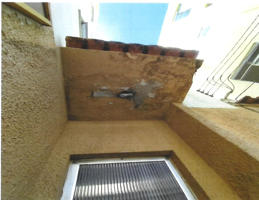
Foto 11: Área de circulação necessitando de reparos (Fonte: SEINFRA/SUBHAB)
