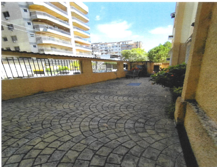
Foto 5: Necessita de pintura no muro e grades no conjunto. (Fonte: SEINFRA/SUBHAB)
