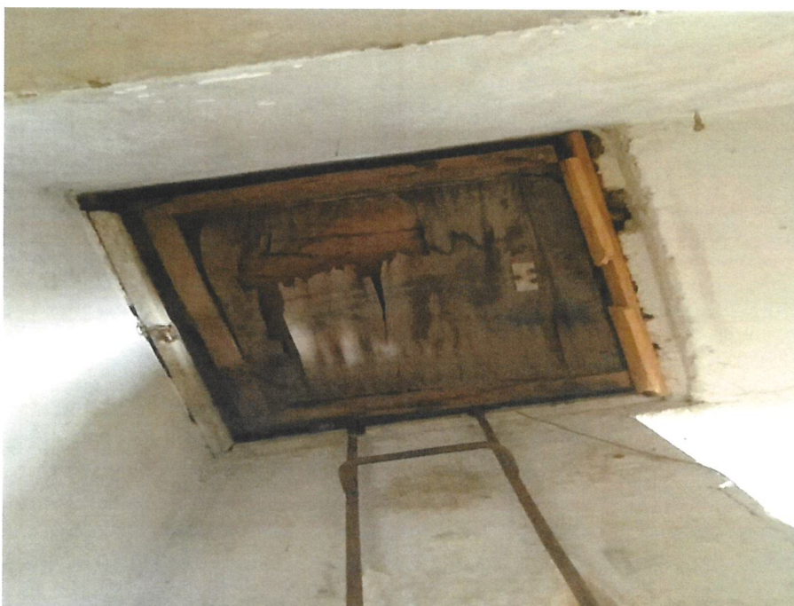
Foto 12: Necessita de troca de alçapão para acesso aos telhados dos prédios (Fonte: SEINFRA/SUBHAB)
