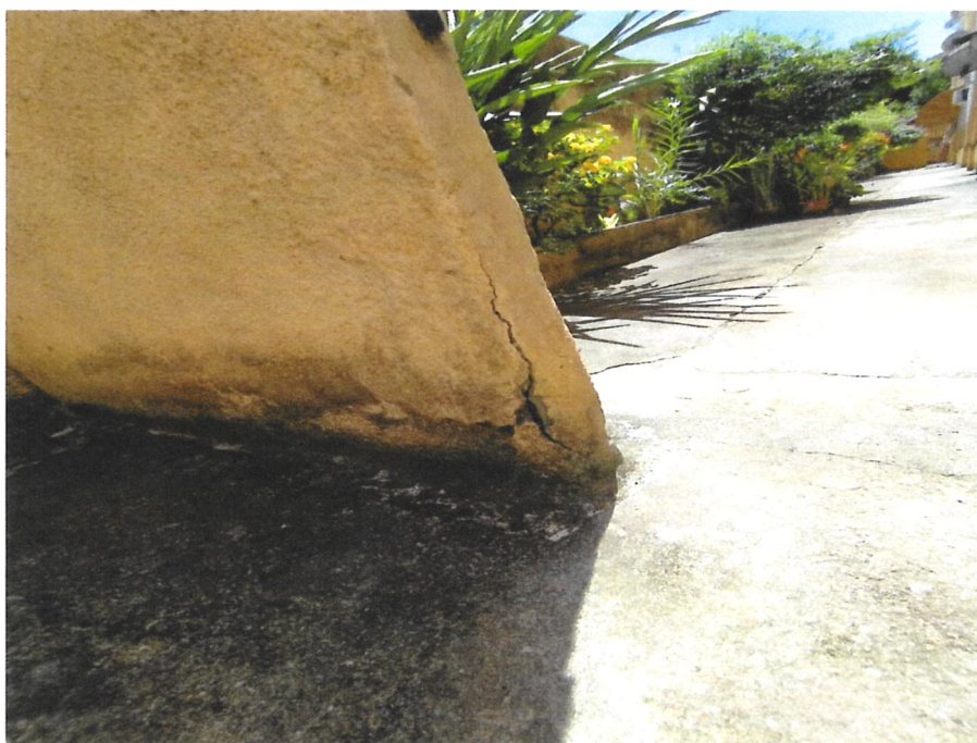
Foto 8: Existe pequenos trechos do muro apresentando patologias, devendo ser reparadas (Fonte: SEINFRA/SUBHAB)
