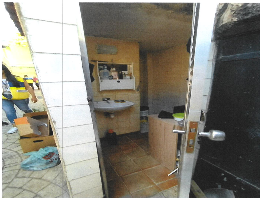
Foto 4: Banheiro adaptado para o uso dos porteiros, necessitam de reparos para melhores condições de uso. (Fonte: SEINFRA/SUBHAB)
