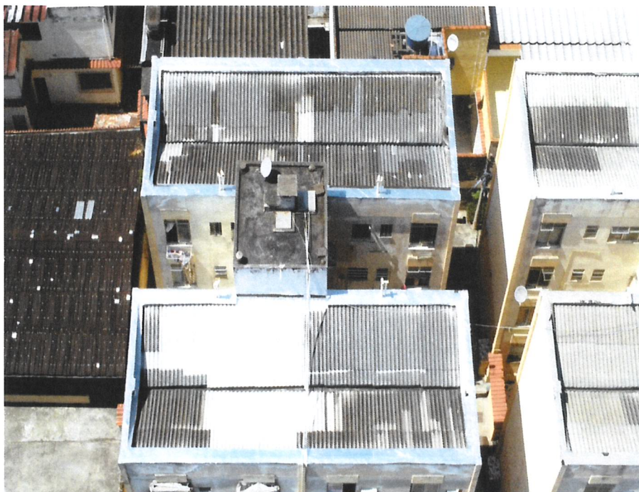
Foto 15: Parte do telhado e madeiramento deve ser trocado. (Fonte: SEINFRA/SUBHAB)
