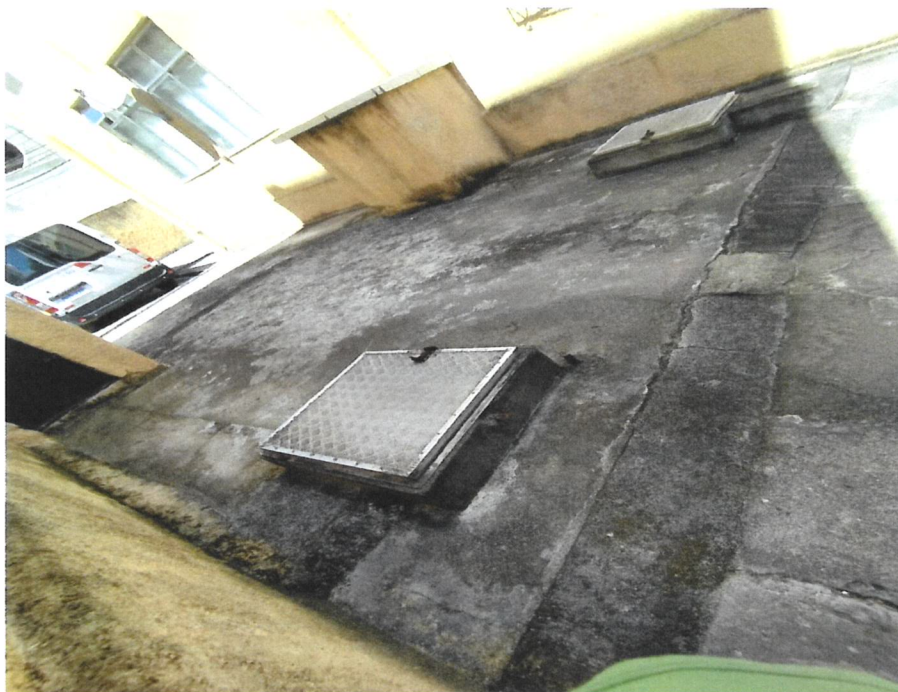
Foto 7: As cisternas do conjunto necessitando de impermeabilização (Fonte: SEINFRA/SUBHAB)
