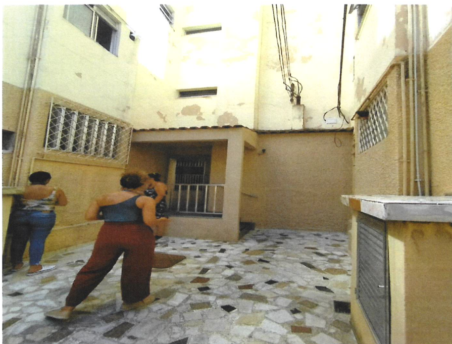
Foto 6: Interior dos blocos necessitando de pintura das fachadas, impermeabilização de cisternas e acessibilidade para os moradores. (Fonte: SEINFRA/SUBHAB)
