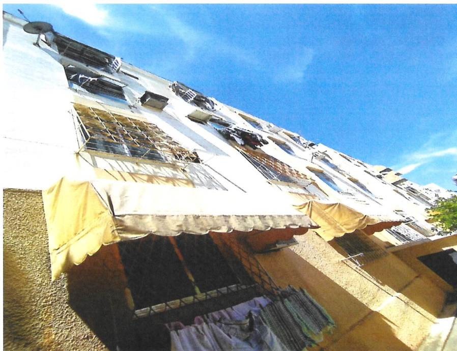
Foto 9: Diversas Janelas com esquadrias diferentes do formato original. (Fonte: SEINFRA/SUBHAB)
