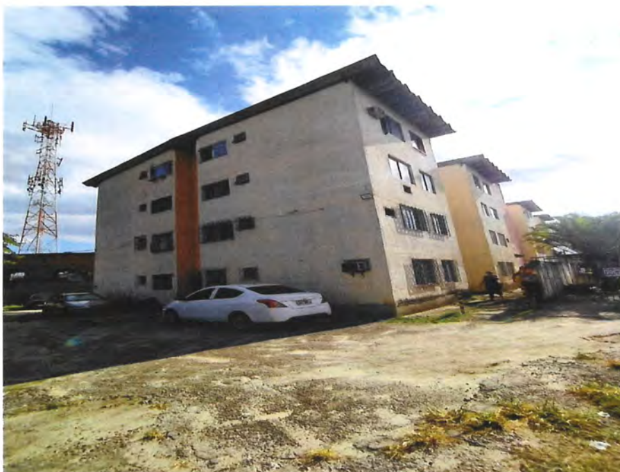
Foto 7: Falta acessibilidade aos moradores do conjunto habitacional (Fonte: SEINFRA/SUBHAB)
