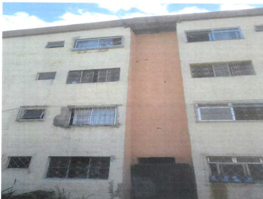
Foto 9: Existe a necessidade da troca de algumas telhas, devido a infiltrações nos apartamentos.
