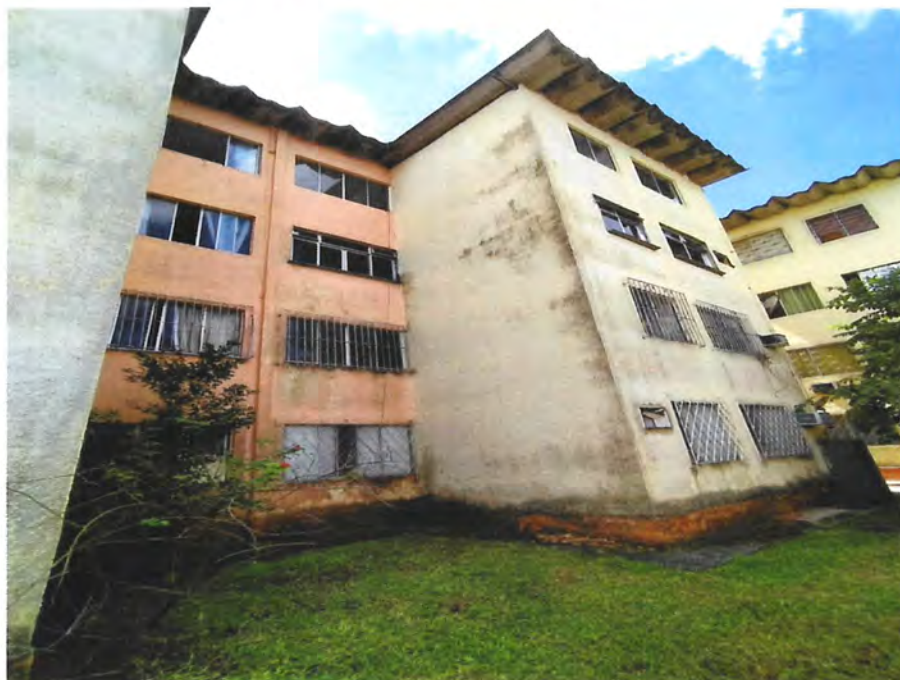
Foto 3: Fachada dos prédios em mau estado de conservação. (Fonte: SEINFRA/SUBHAB)
