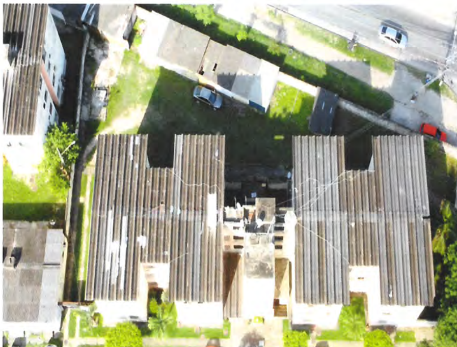
Foto 14: Foto aérea dos telhados, apresentando mau estado de conservação. (Fonte: SEINFRA/SUBHAB)
