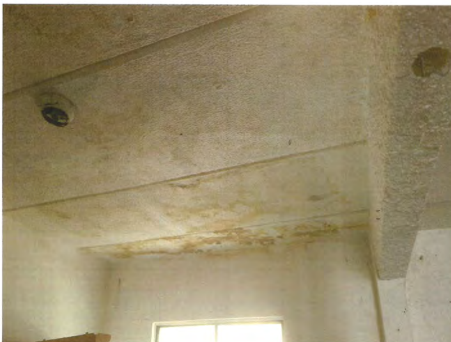
Foto 11: Teto do último pavimento apresentando infiltrações (Fonte: SEINFRA/SUBHAB)
