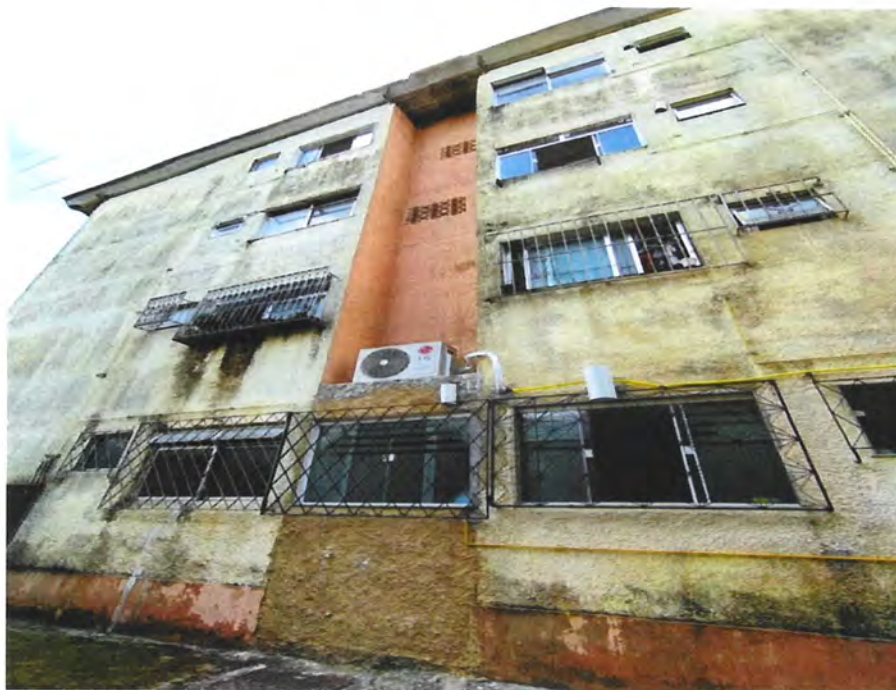
Foto 4: Fachada dos prédios necessitando de pintura. (Fonte: SEINFRA/SUBHAB)
