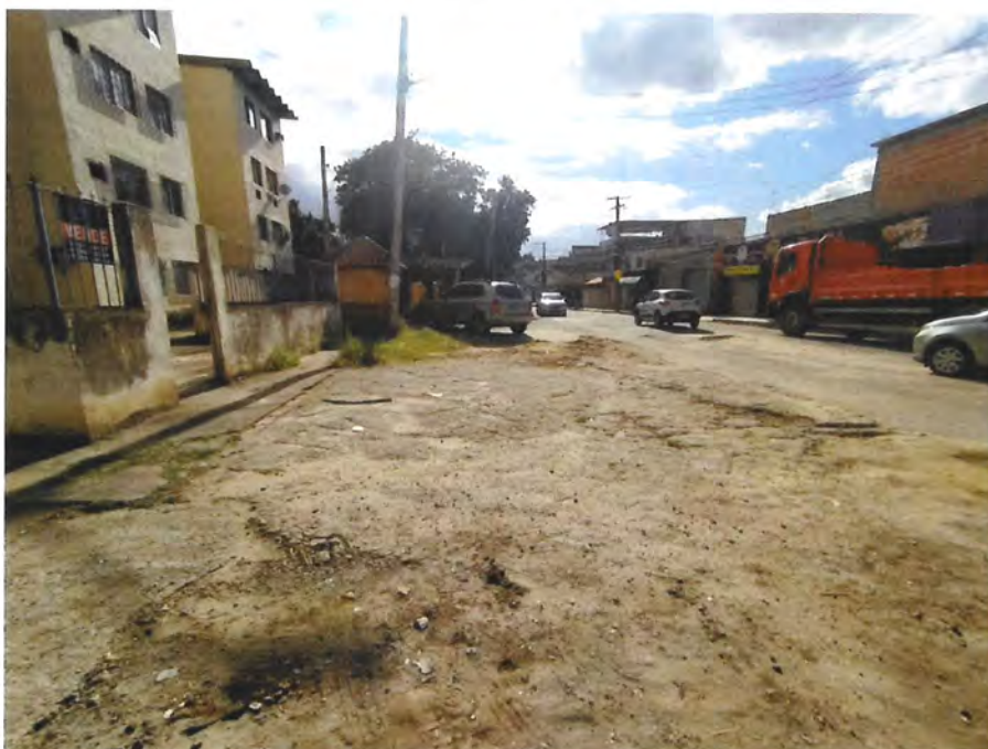
Foto 5: Muro e grade necessitam de pintura, falta acessibilidade no condomínio e a pavimentação se encontra deteriorada. (Fonte: SEINFRA/SUBHAB)
