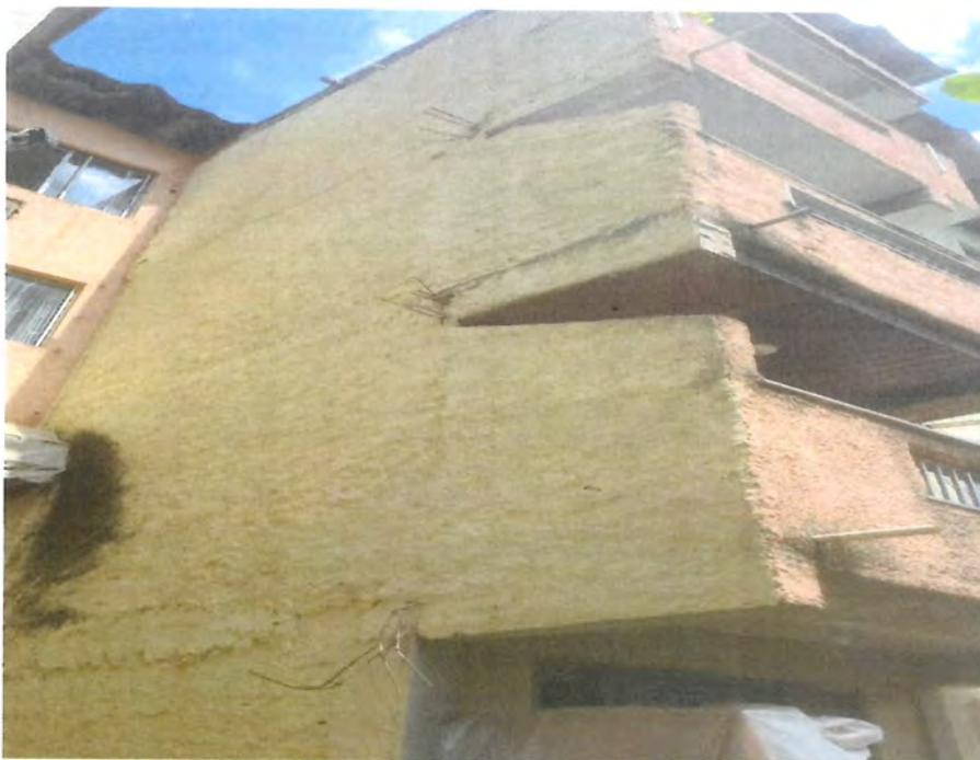
Foto 8: Foram feitos adições irregulares nos blocos, alterando o modelo original dos prédios (Fonte: SEINFRA/SUBHAB)
