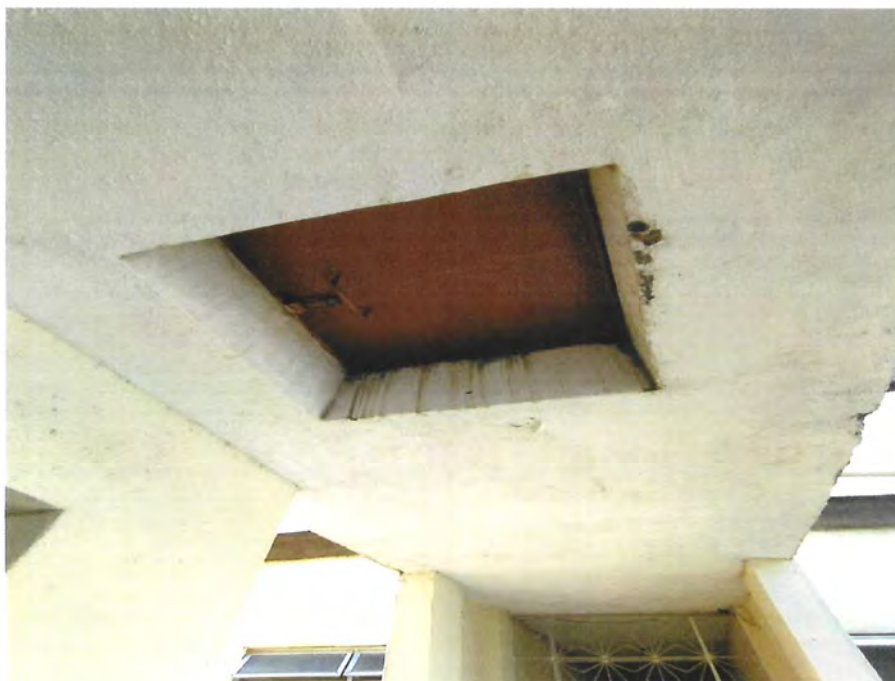
Foto 12: Alçapão de acesso ao telhado, necessitando de reparos. (Fonte: SEINFRA/SUBHAB)
