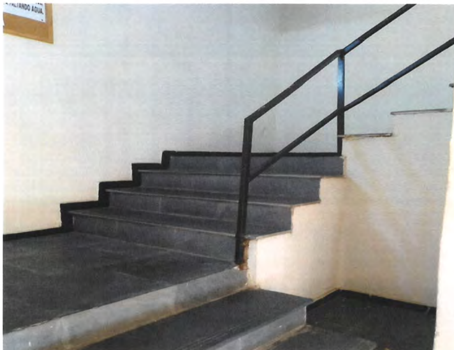
Foto 11: Alguns pisos estão desgastados e falta corrimão de um lado das escadas. (Fonte: SEINFRA/SUBHAB)
