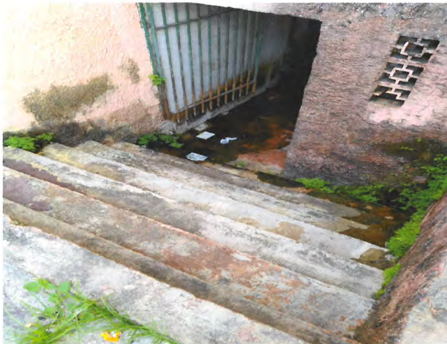
Foto 6: Área não é mais utilizada como casa de bomba, algumas usadas como lixeira (Fonte: SEINFRA/SUBHAB)
