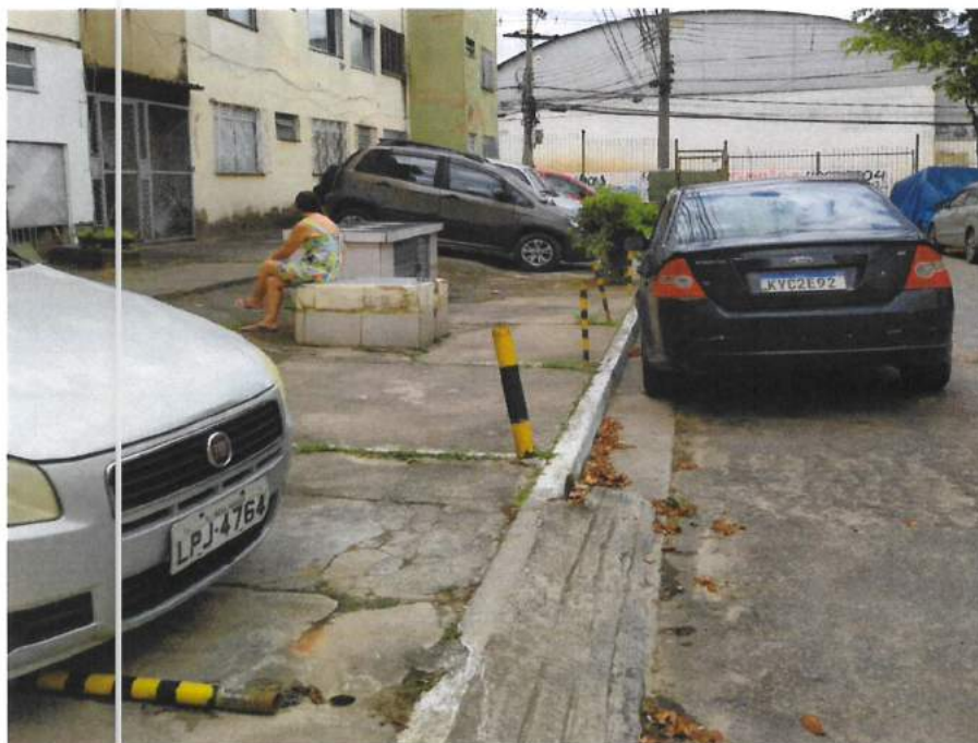
Foto 11: Parte das calçadas danificadas e sem acessibilidade, utilizadas como estacionamento (Fonte: SEINFRA/SUBHAB)
