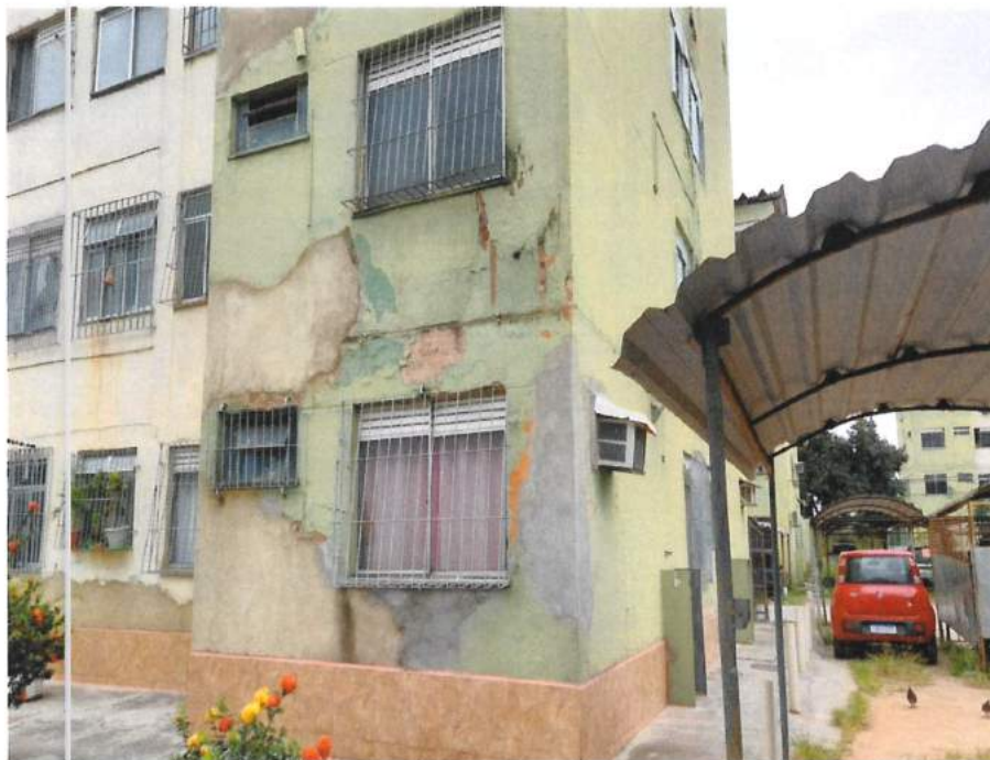
Foto 6: Fachada deteriorada (Fonte: SEINFRA/SUBHAB)
