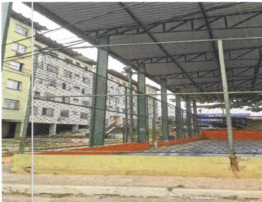
Foto 14: Quadra esportiva com pintura deteriorada (Fonte: SEINFRA/SUBHAB)
