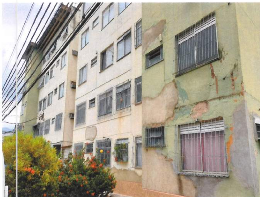
Foto 7: Fachada deteriorada (Fonte: SEINFRA/SUBHAB)
