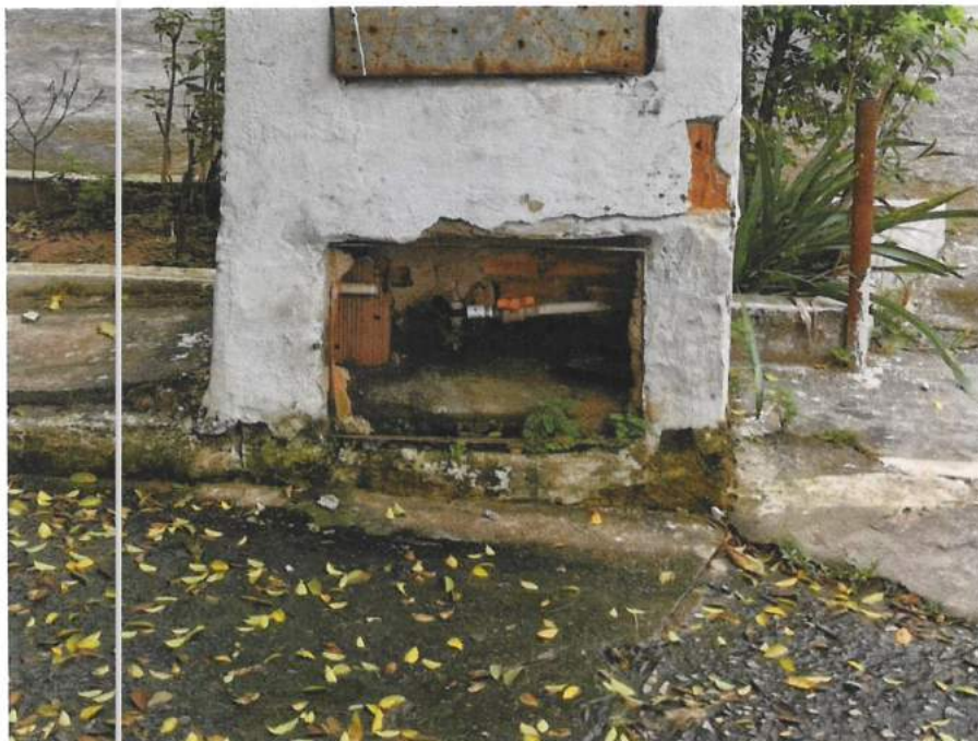
Foto 17: Área comum apresenta vazamento (Fonte: SEINFRA/SUBHAB)
