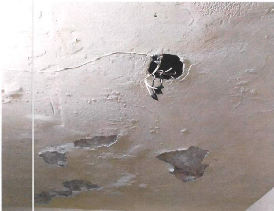
Foto 8: Infiltração na laje do último pavimento (Fonte: SEINFRA/SUBHAB)
