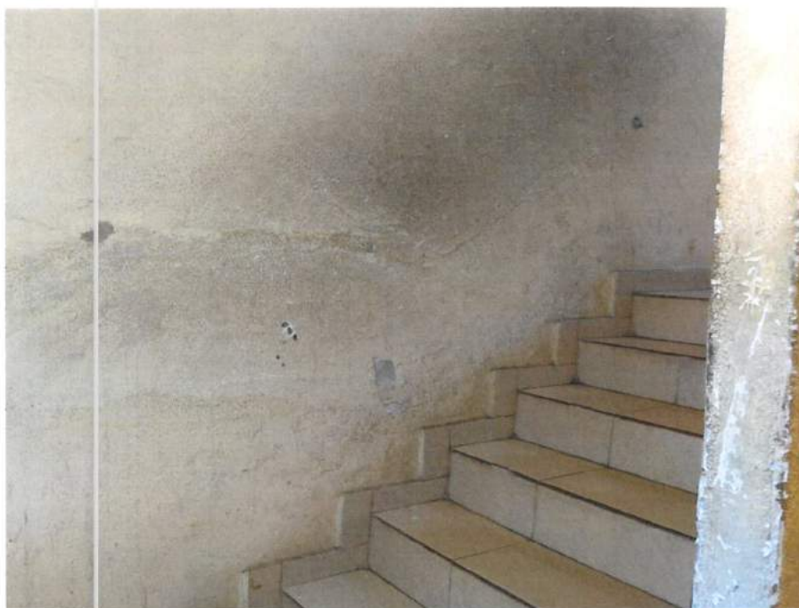
Foto 9: Pintura interna dos corredores em má estado de conservação (Fonte: SEINFRA/SUBHAB)
