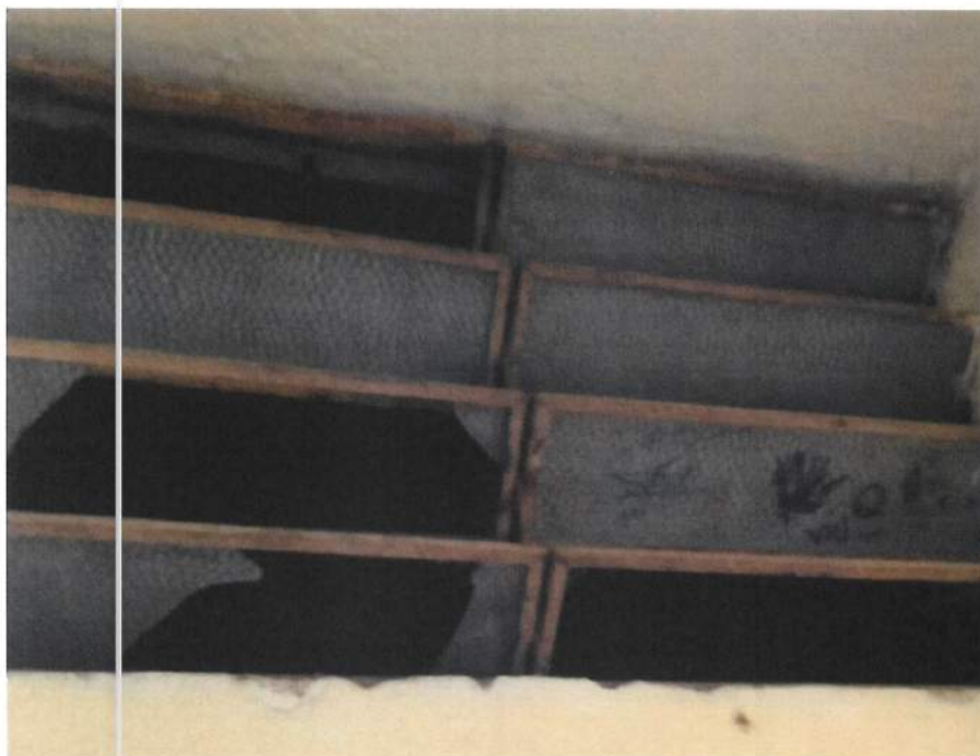
Foto 10: Vidro da janela quebrado (Fonte: SEINFRA/SUBHAB)
