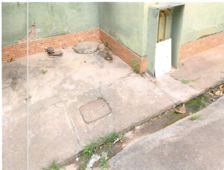
Foto 15: Pavimentação danificada. (Fonte: SEINFRA/SUBHAB)
