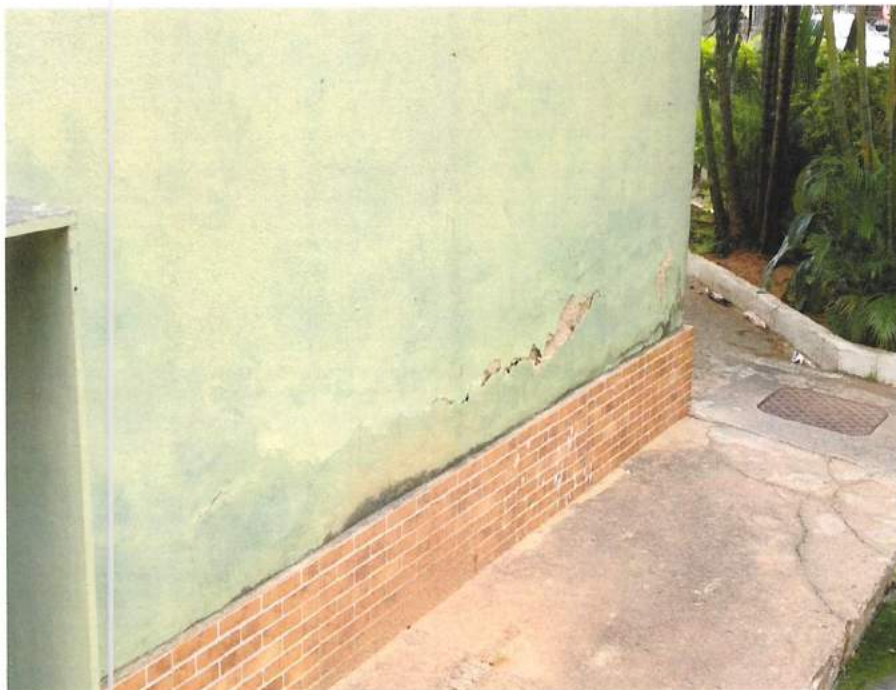
Foto 16: Revestimento das fachadas deteriorado. (Fonte: SEINFRA/SUBHAB)
