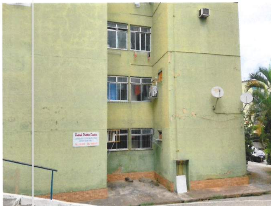
Foto 5: Pintura da fachada deteriorada (Fonte: SEINFRA/SUBHAB)
