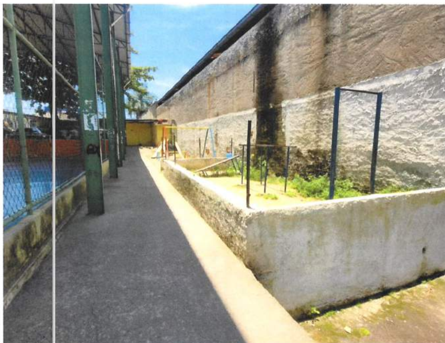
Foto 18: Parquinho sem guarda-corpo (Fonte: SEINFRA/SUBHAB)
