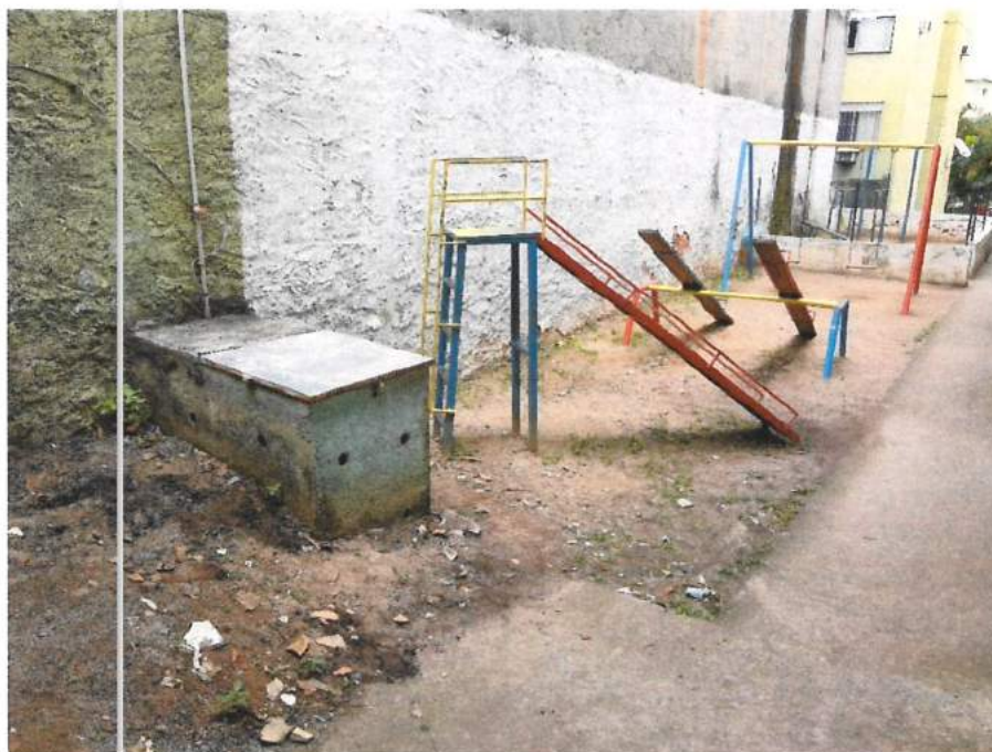
Foto 19: Brinquedos do parquinho inadequados e em péssimo estado de conservação.(Fonte: SEINFRA/SUBHAB)
