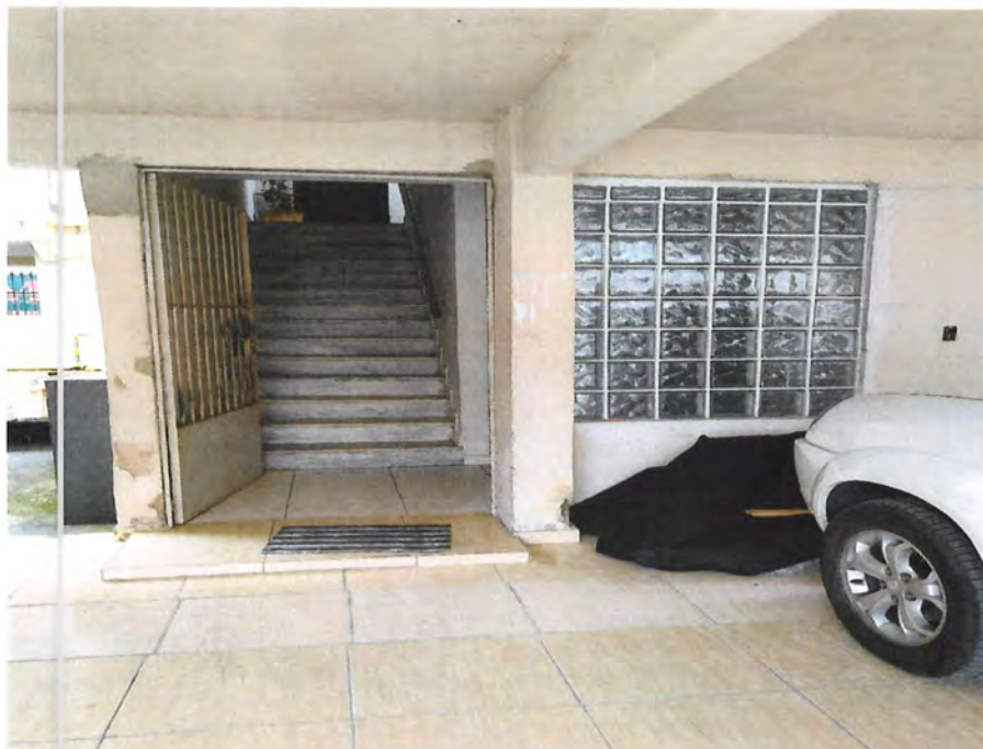
Foto 7: Área de acesso aos blocos, necessita de corrimão nos 2 lados da escada e manutenção de alguns degraus da escada. (Fonte: SEINFRA/SUBHAB)
