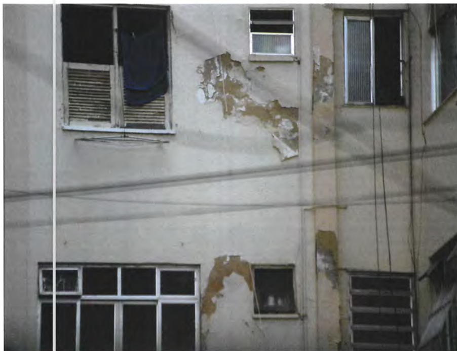
Foto 3: Fachada dos prédios em mau estado de conservação. (Fonte: SEINFRA/SUBHAB)
