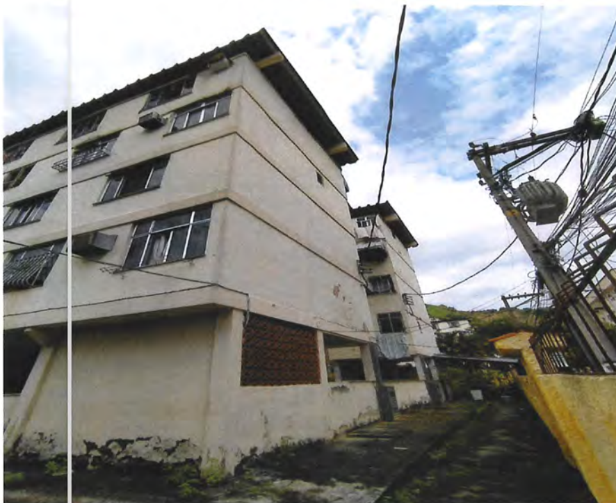
Foto 5: Área lateral do prédio com piso deteriorado por umidade e falta de acessibilidade para pedestres. (Fonte: SEINFRA/SUBHAB)
