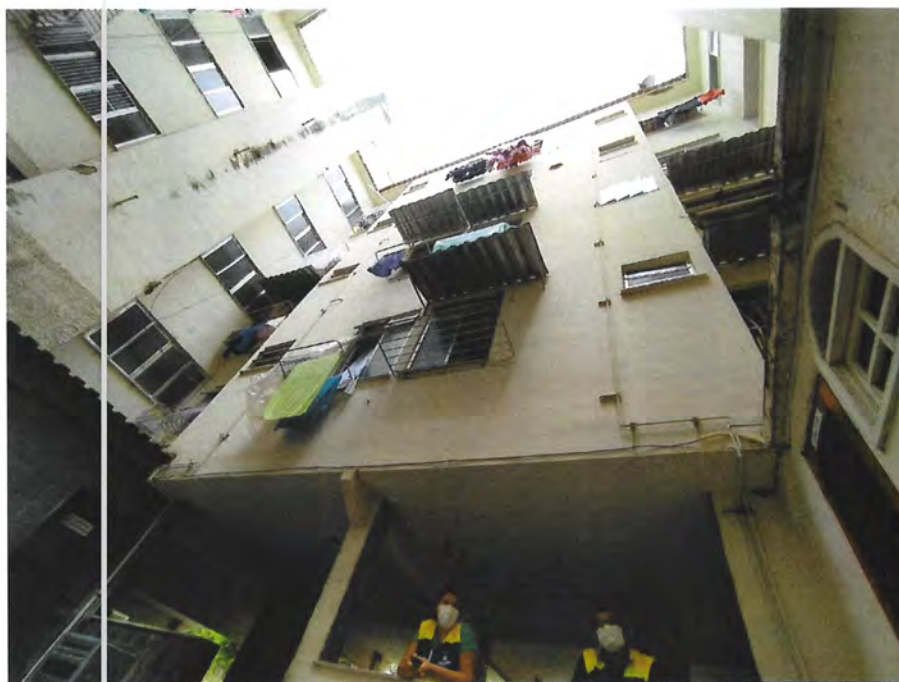
Foto 4: Fachada dos prédios necessitando de pintura. (Fonte: SEINFRA/SUBHAB)
