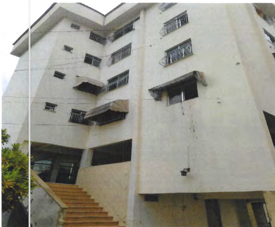
Foto 8: Área de acesso aos blocos, necessita de corrimão dos 2 lados da escada e pintura das fachadas. (Fonte: SEINFRA/SUBHAB)
