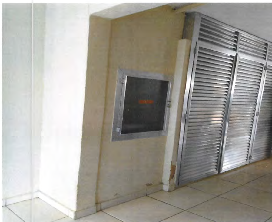
Foto 10: Os Pc's elétricos serão atualizados no formato da RECON utilizado pela Enel (Fonte: SEINFRA/SUBHAB)
