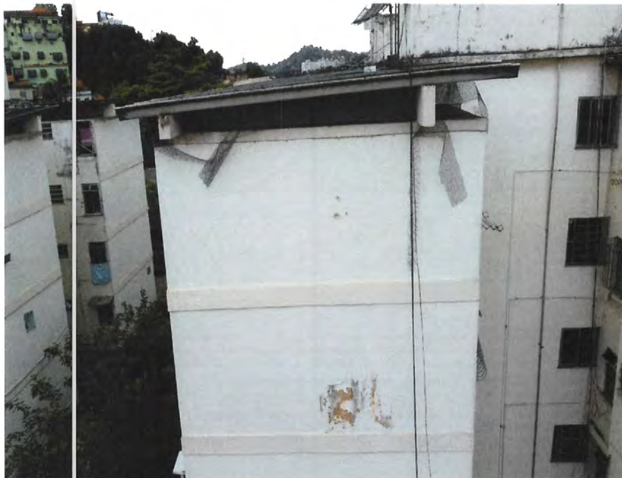
Foto 9: Área entre os blocos e o telhado necessitando de reparo na tela devido a problemas com pombos. (Fonte: SEINFRA/SUBHAB)
