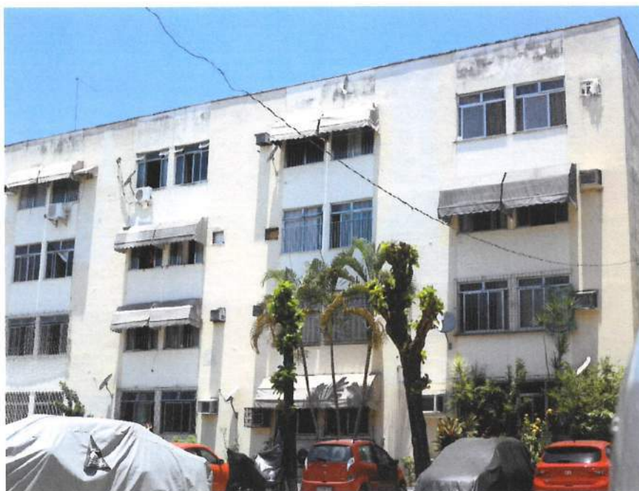
Foto 4: Pintura da fachada deteriorada (Fonte: SEINFRA/SUBHAB)
