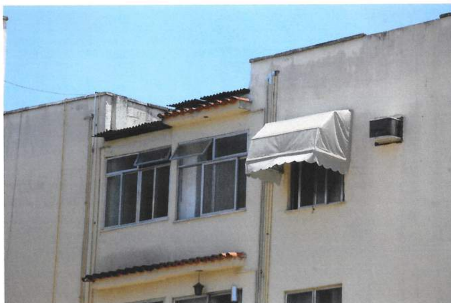
Foto 5: Pingadeira e telhado danificado (Fonte: SEINFRA/SUBHAB)
