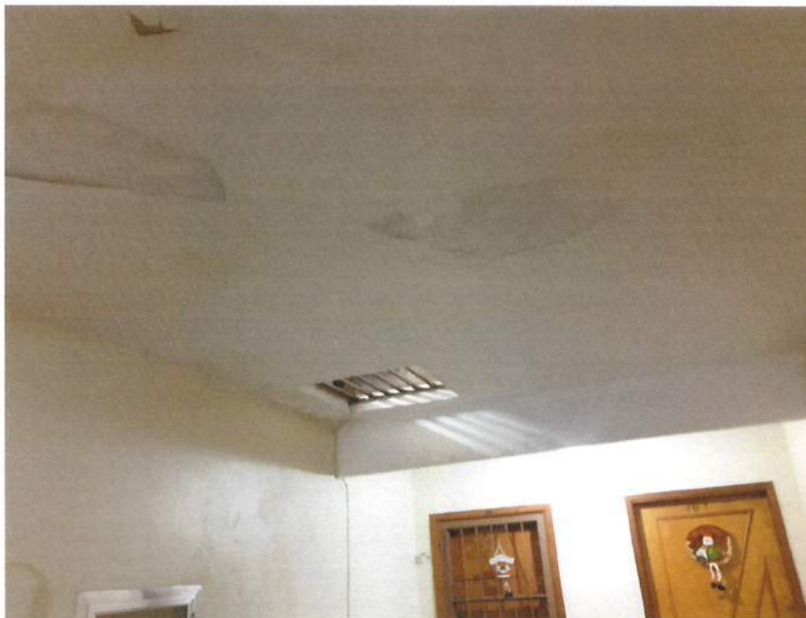
Foto 6: Infiltração na circulação do último pavimento (Fonte: SEINFRA/SUBHAB)
