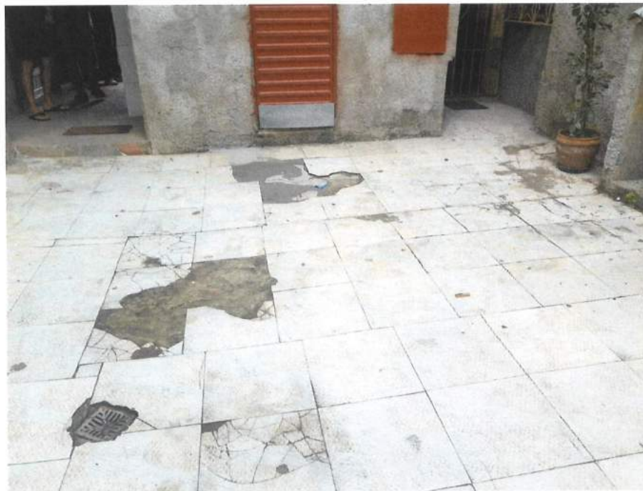
Foto 5: Revestimento cerâmico da área comum danificado (Fonte: SEINFRA/SUBHAB)
