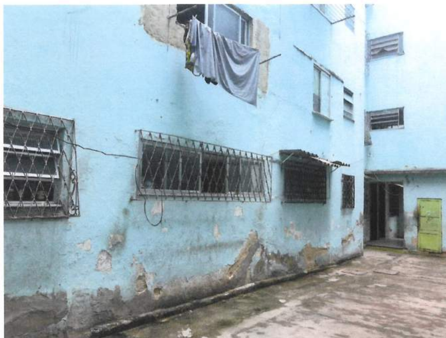
Foto 2: Revestimento da fachada do condomínio deteriorado (Fonte: SEINFRA/SUBHAB)
