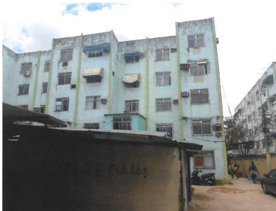
Foto 3: Revestimento da fachada do condomínio deteriorado (Fonte: SEINFRA/SUBHAB)
