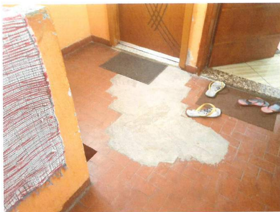
Foto 6: Revestimento cerâmico da área comum danificado (Fonte: SEINFRA/SUBHAB)
