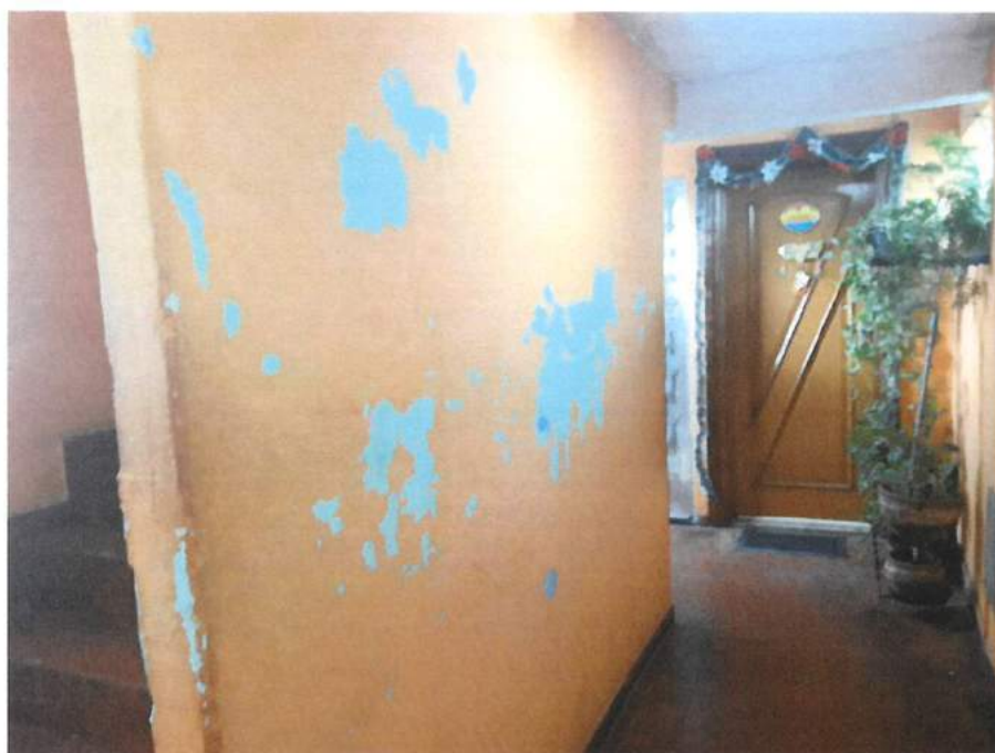
Foto 4: Pintura da parte comum do bloco danifica (Fonte: SEINFRA/SUBHAB)
