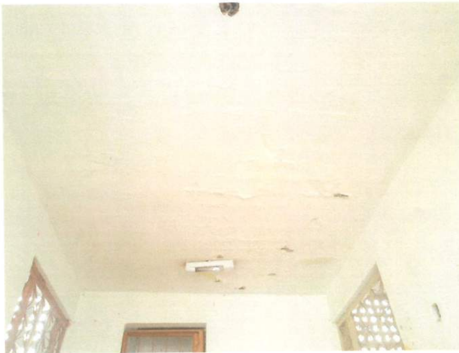
Foto 6: Infiltração na laje do último pavimento (Fonte: SEINFRA/SUBHAB)
