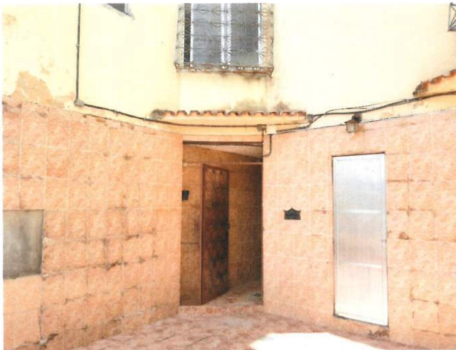
Foto 4: Revestimento cerâmico danificado e desnível de piso (Fonte: SEINFRA/SUBHAB)
