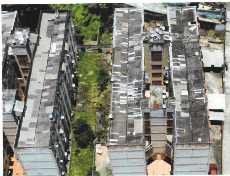
Foto 7: Telhado dos blocos danificado (Fonte: SEINFRA/SUBHAB)
