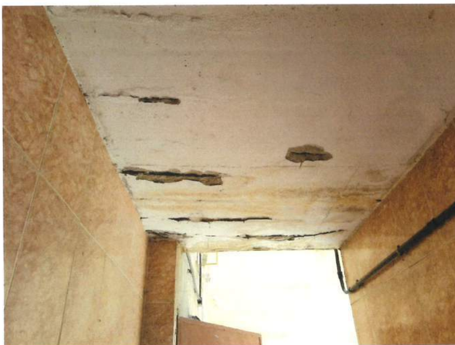
Foto 5: Laje na área comum do térreo apresenta armadura exposta (Fonte: SEINFRA/SUBHAB)
