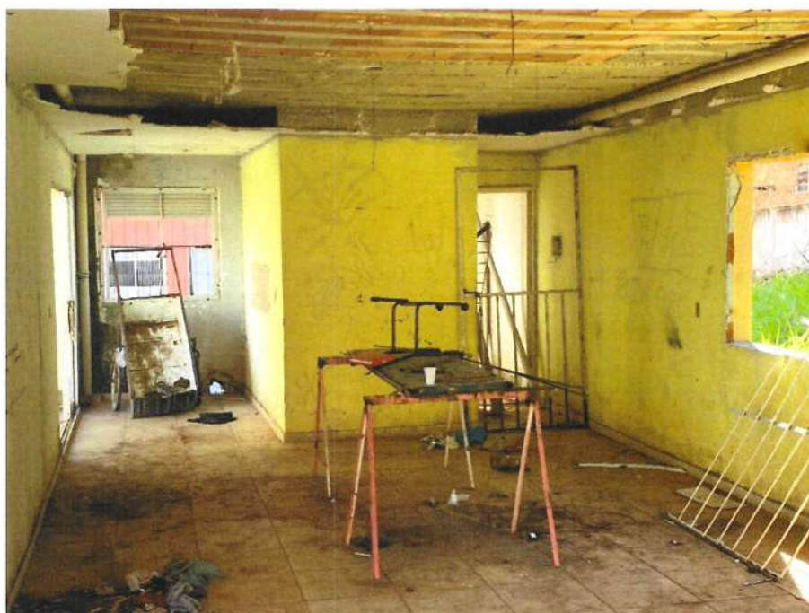
Foto 6 – Áreas internas deterioradas dos salões de festas – (Fonte: SUBHAB julho/2021)
