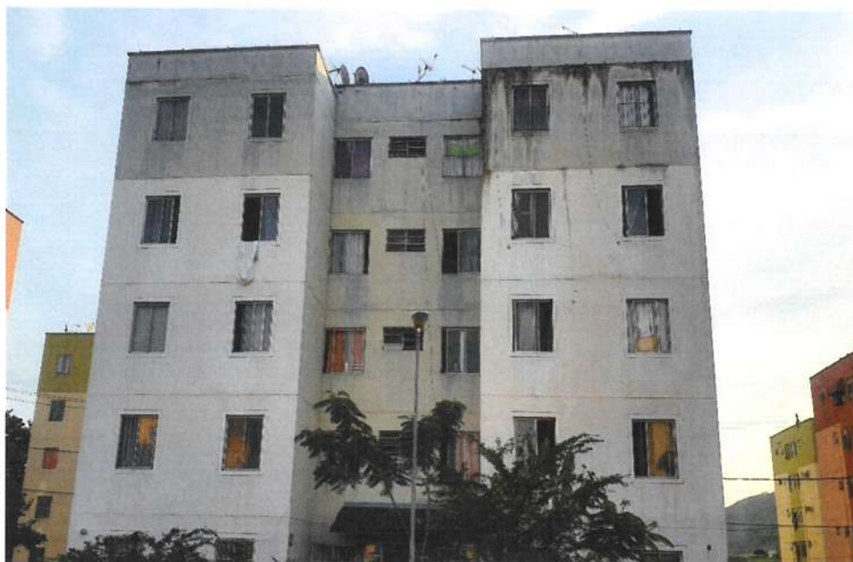
Foto 4 – Infiltração na fachada. (Fonte: SUBHAB julho/2021)
