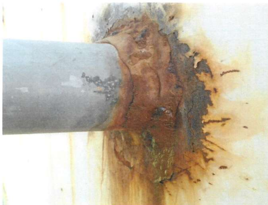
Foto 9 – Solda com alto grau de oxidação no Silo de água – (Fonte: SUBHAB out/2021)
