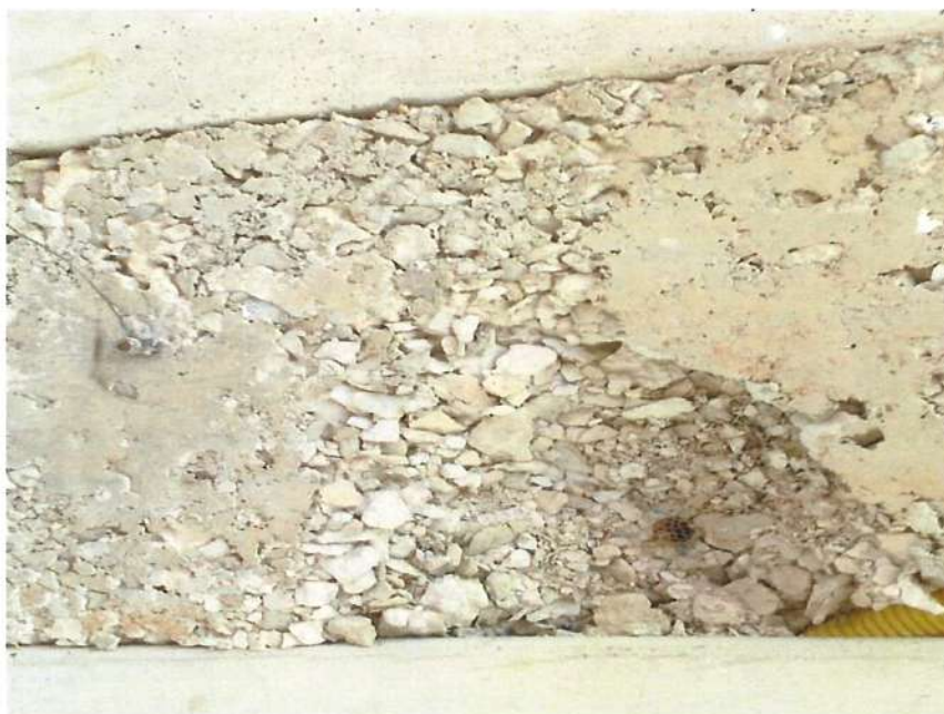
Foto 10 – Segregação do agregado da laje do Espaço Gourmet – (Fonte: SUBHAB out/2021)
