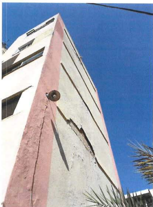
Foto 1: Fachada deteriorada (Fonte: SEINFRA/SUBHAB - julho/2021)
