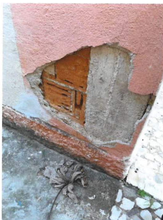
Foto 2: Fachada deteriorada (Fonte: SEINFRA/SUBHAB - julho/2021)
