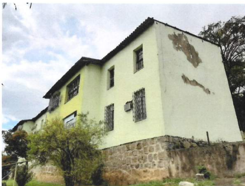
Foto 4: Vista de fachada deteriorada por causa de intempéries devido à supressão de cobertura lateral (Fonte: SEINFRA/SUBHAB - julho/2021)
