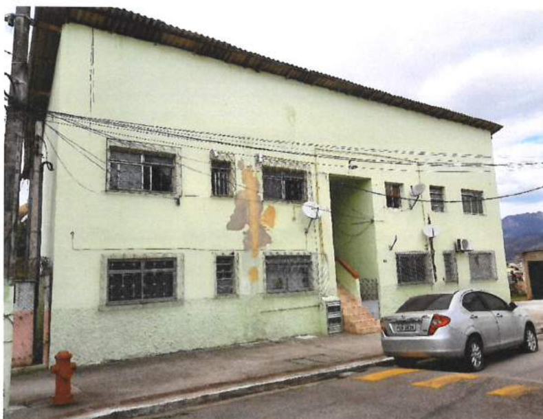
Foto 3: Vista de fachada com infiltrações devido a vazamentos de tubulações (Fonte: SEINFRA/SUBHAB - julho/2021)
