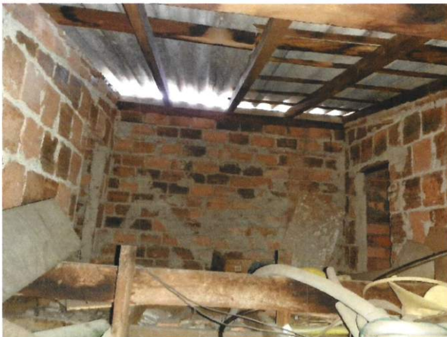
Foto 6: Vista parcial da área interna da cobertura de um dos prédios (Fonte: SEINFRA/SUBHAB - julho/2021)
