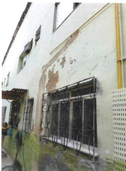
Foto 1: Fachada deteriorada por infiltrações (Fonte: SEINFRA/SUBHAB - julho/2021)
