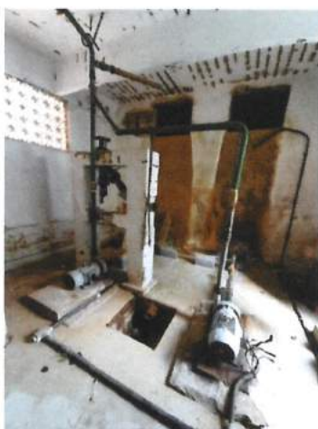
Foto 14: Casa de Bombas (Fonte: SEINFRA/SUBHAB - julho/2021)
