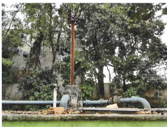
Foto 16: Tubulação de entrada de água ao Reservatório Superior Solicitaram a substituição, mas não foi detectado nenhum vazamento. (Fonte: SEINFRA/SUBHAB - julho/2021)
