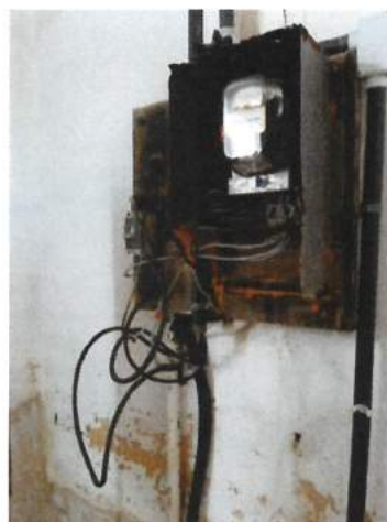
Foto 15: Quadro elétrico / Casa de Bombas (Fonte: SEINFRA/SUBHAB - julho/2021)
