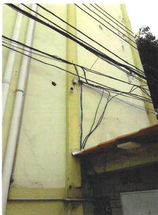
Foto 2 – Fixação de fiações na fachada – Fonte: SUBHAB julho/2021)
