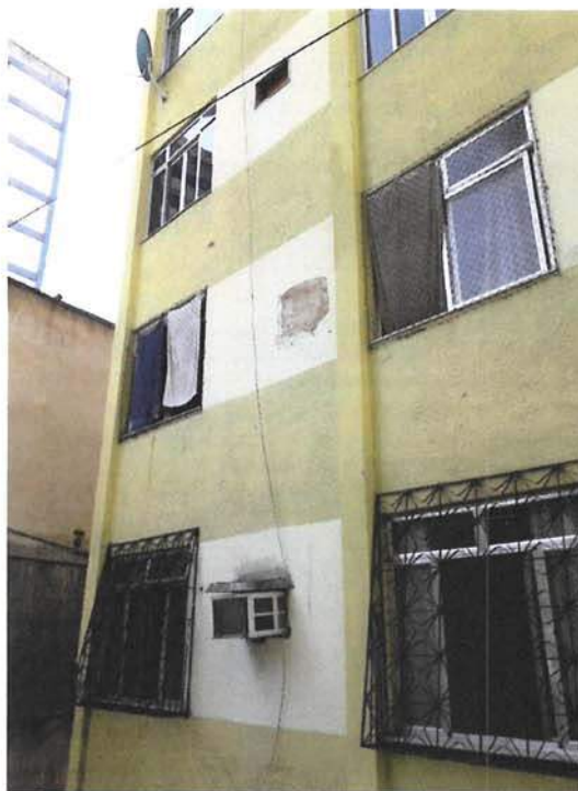
Foto 5 – Necessidade de acabamento – Fonte: SUBHAB julho/2021)
