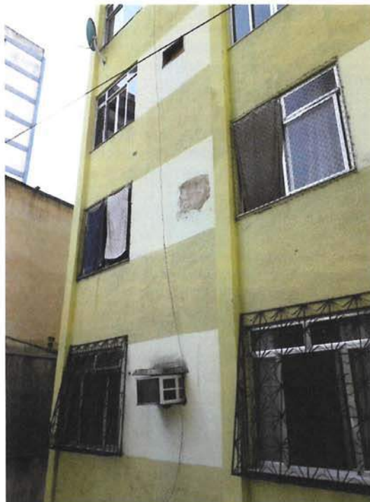
Foto 5 – Necessidade de acabamento – Fonte: SUBHAB julho/2021)
