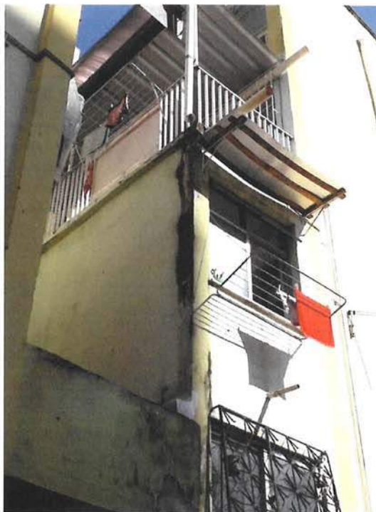
Foto 1 – Colocação de Cobertura, guarda-corpo, varal, descaracterizando a fachada original.
