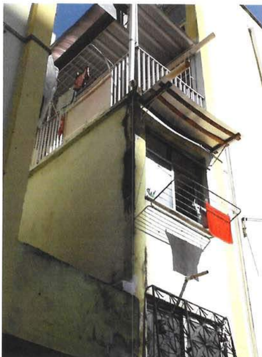
Foto 1 – Colocação de cobertura, guarda-corpo, varal, descaracterizando a fachada original. (Fonte: SUBHAB julho/2021)
