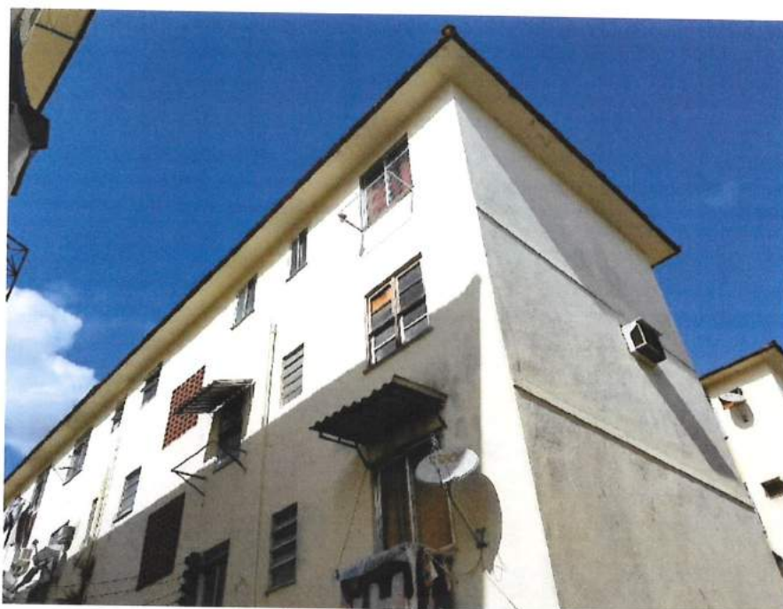
Foto 12: Fachadas descaracterizadas (Fonte: SEINFRA/SUBHAB - julho/2021)
