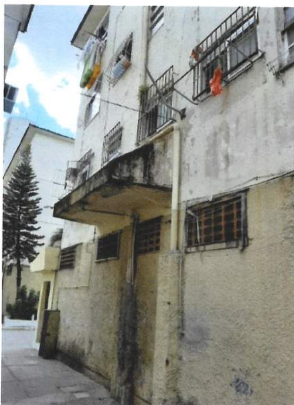
Foto 3: Fachada com manchas devido as intempéries (Fonte: SEINFRA/SUBHAB - julho/2021)
