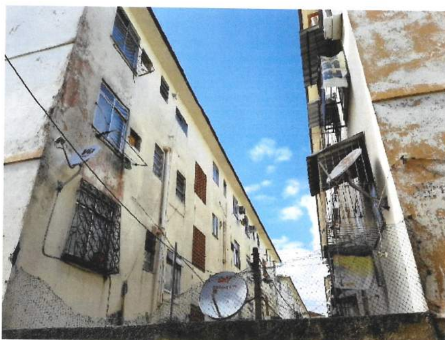
Foto 13: Fachadas descaracterizadas (Fonte: SEINFRA/SUBHAB - julho/2021)
