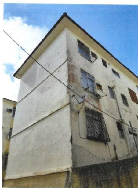
Foto 2: Revestimento deteriorado (Fonte: SEINFRA/SUBHAB - julho/2021)
