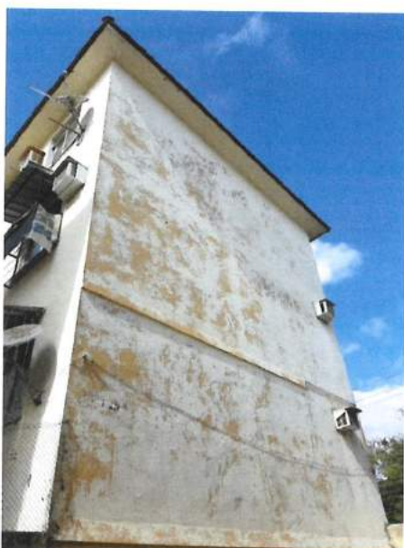
Foto 1: Fachada deteriorada por intempéries (Fonte: SEINFRA/SUBHAB - julho/2021)
