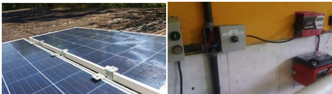
Figura 5- placa solar e sistema de armazenamento de energia para aeração de emergência dos tanques de girinos da EAAPM
