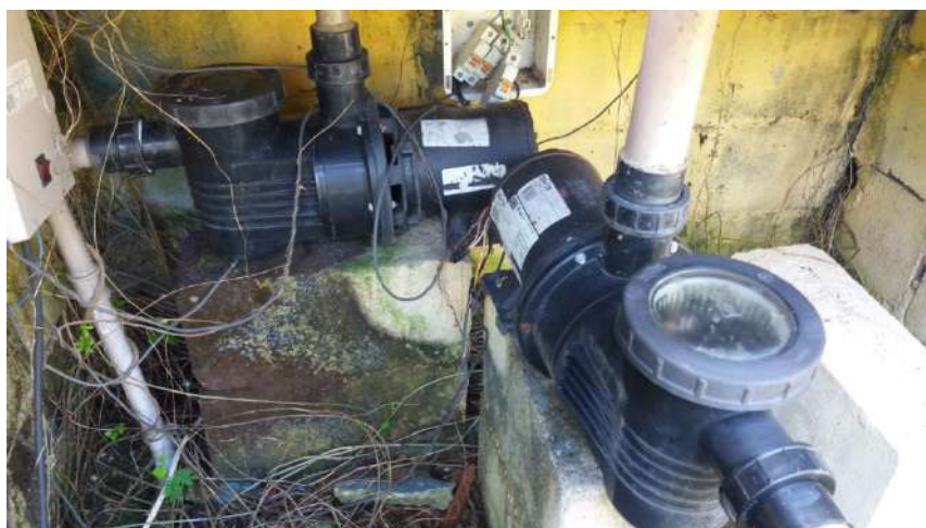
Figura 6 – Sistema de bombeamento para recirculação da água das baias de manutenção de reprodutores e rãs do ranário experimental da EAAPM
