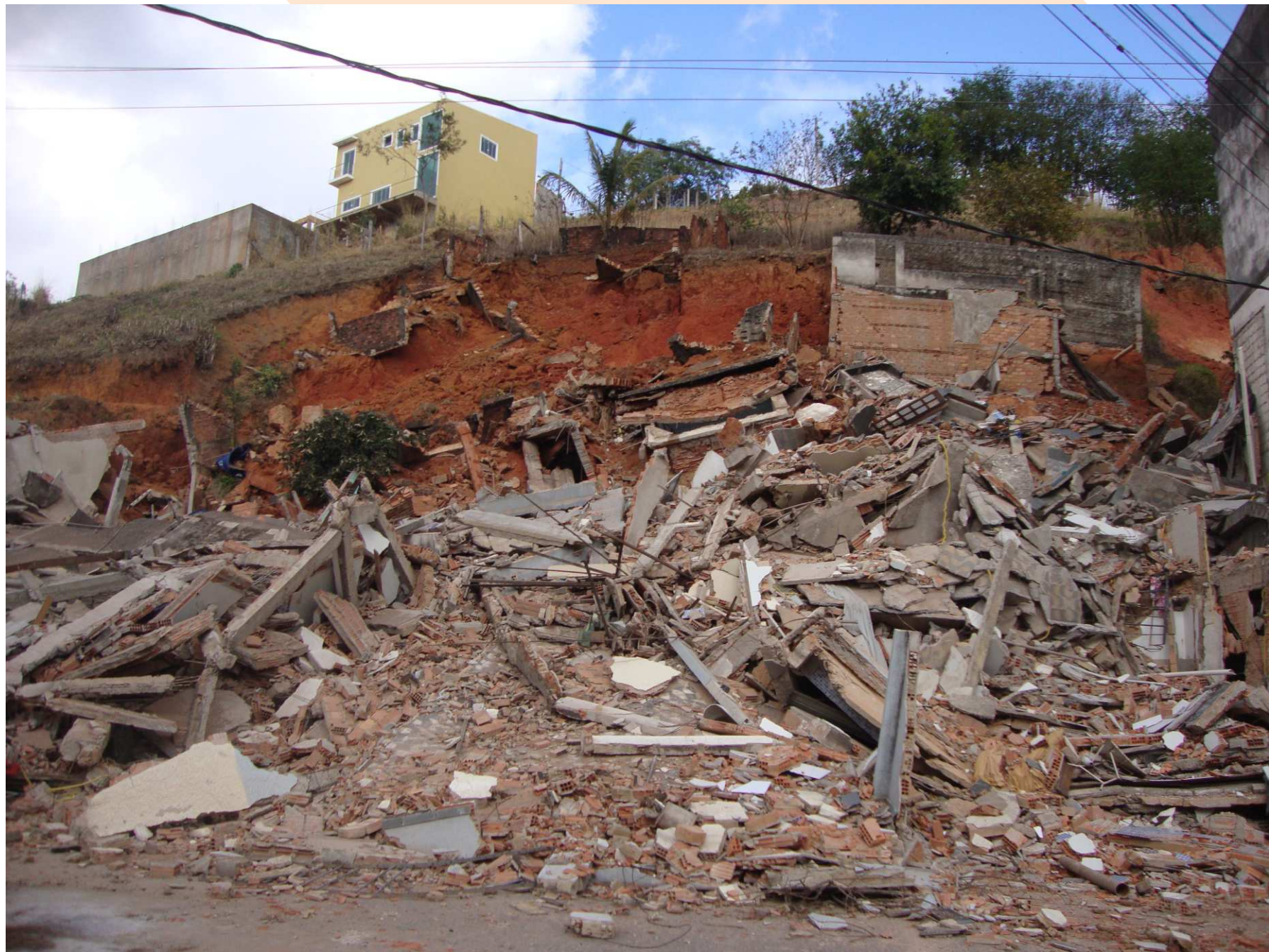
Figura 2. Vista frontal do escorregamento.
