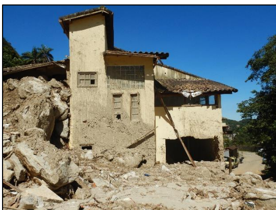
Figura 4. Construção afetada pelos movimentos gravitacionais de massa.
