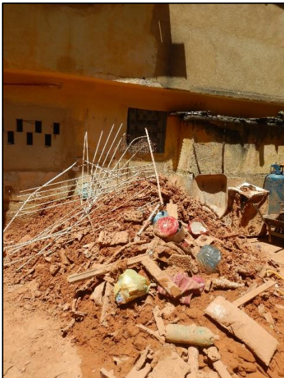
Figura 8. Moradia afetada pela corrida de massa.
