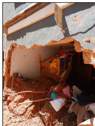
Figura 7. Parede de casa destruída por corrida.
