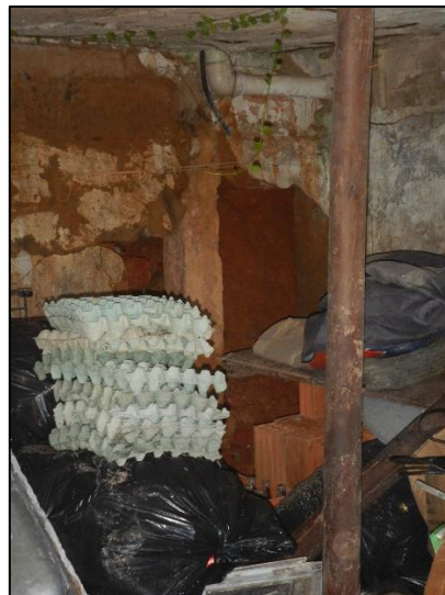
Figura 9. Base de construção parcialmente erodida.
