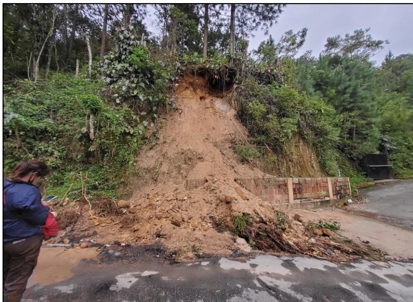
Figura 8. Deslizamento 2: Primeiro: com 14 m de altura, 10 m de largura e com inclinação de 41 graus. interdição parcial da via. Situação: desobstruída parcialmente.
