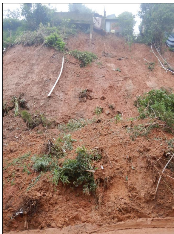
Figura 5. Cicatriz de deslizamento planar.
