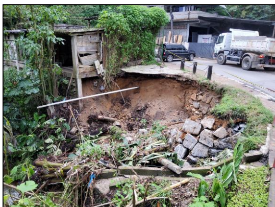
Figura 4. Solapamento de margem de rio na Rua Stephan Zweig.
