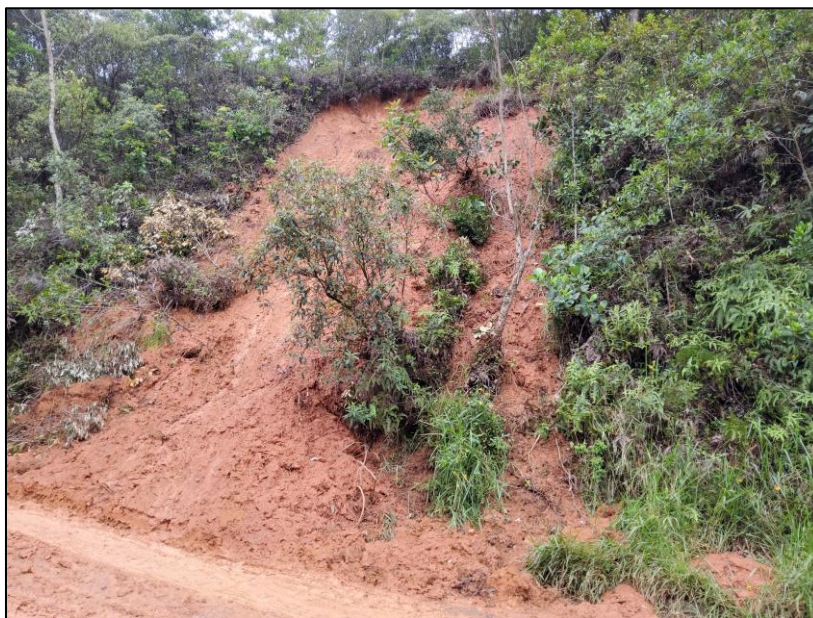
Figura 6. Deslizamento 1: Deslizamento de terra obstruindo parcialmente a via. Inclinação da encosta com 60 graus, altura = 7,7 m. Rua Engenheiro José lima Filho. Presença de deslizamento pretérito próximo. Situação: desobstruída parcialmente.
