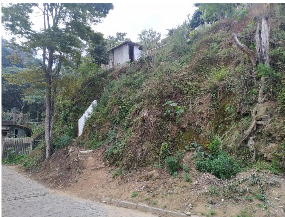
Figura 2: Um dos acessos ao terreno, com talude apresentando alguns processos erosivos.
