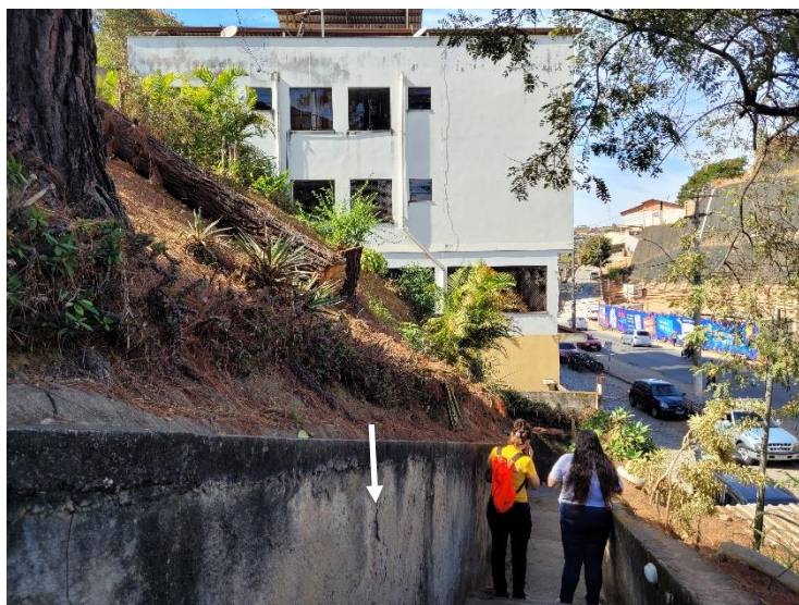
Figura 1- Imagem do muro de acesso às escadas apresentando trincas e sem drenagem
