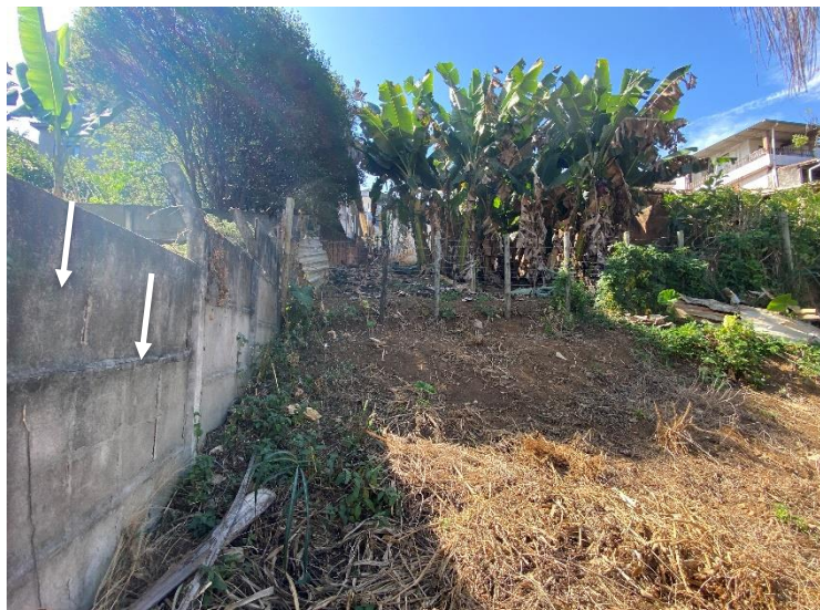
Figura 3 – Parte dos fundos da casa onde o muro apresenta ferragens expostas, além de trincas em sua estrutura.
