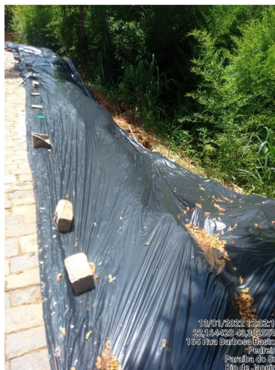
Figura 8 – Deslizamento a jusante da Rua Barbosa Bastos.
