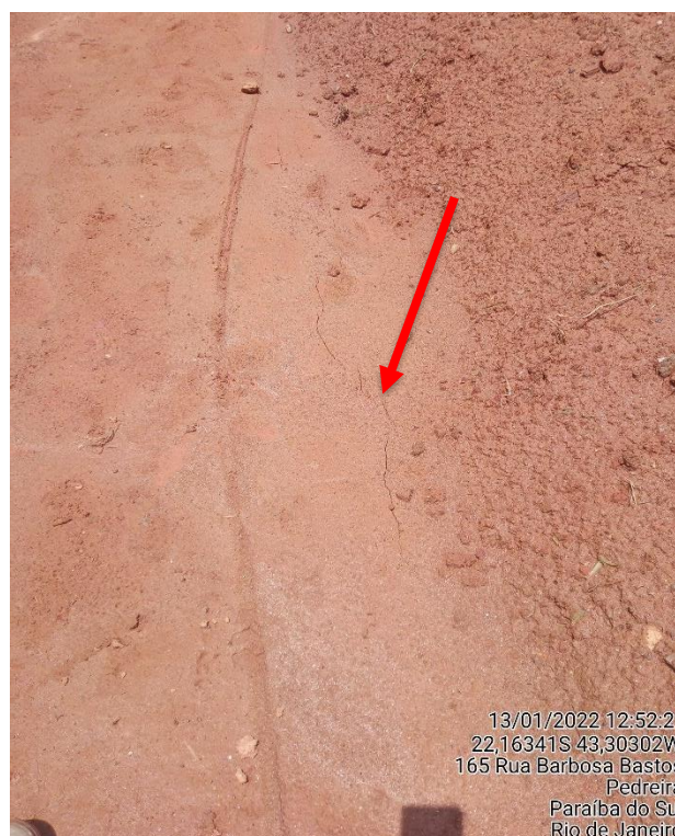
Figura 4 – Trincas no terreno.
