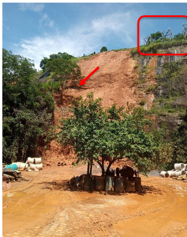
Figura 2 – Cicatriz de deslizamento planar com indícios de instabilidade no maciço rochoso (lascas rochosas) e presença de 3 estruturas metálicas.
