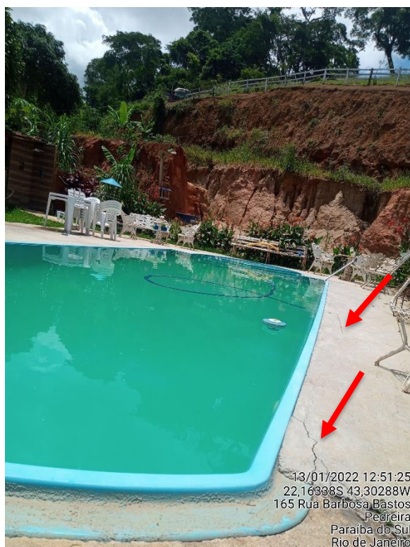
Figura 3 – Sobreposição da piscina e trincas.
