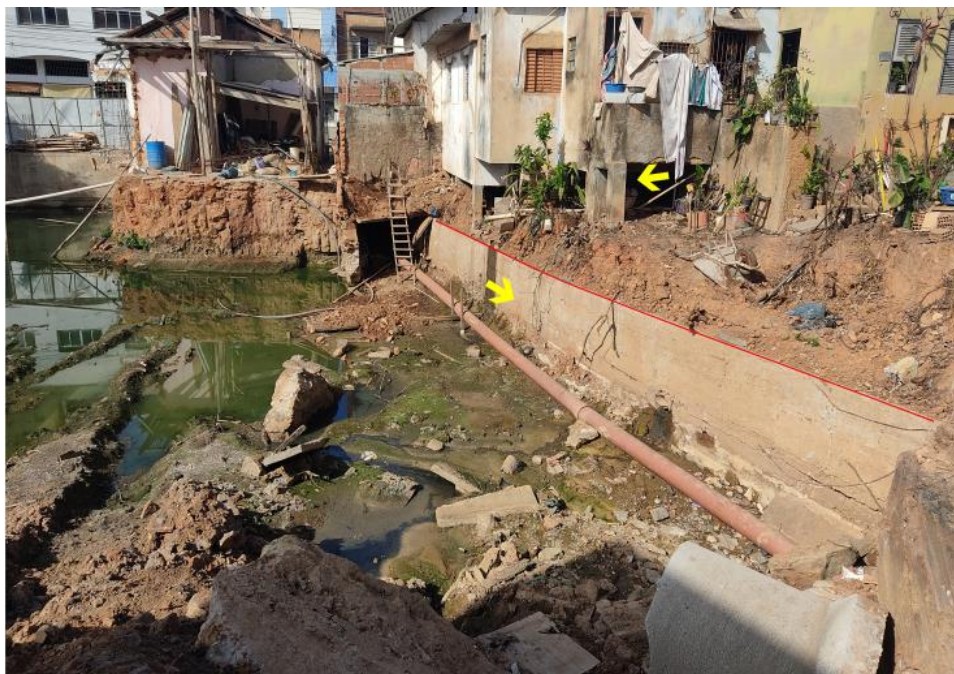
Figura 3: Setas amarelas indicando as trincas no muro e na fundação e a linha vermelha demonstrando o embarrigamento.
