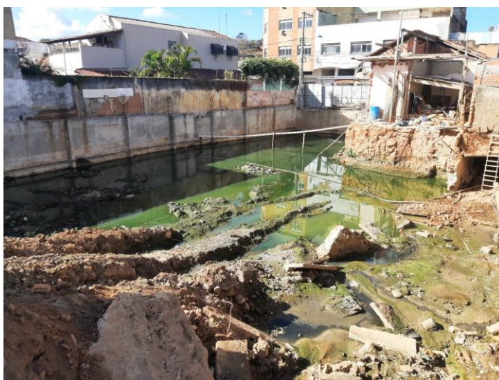
Figura 2: Terreno alagado por esgoto após danos na rede pluvial.
