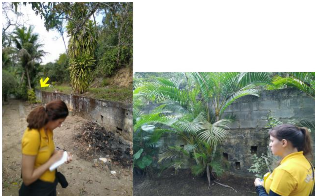
Figura 2: Parte do muro reconstruído próximo à entrada do terreno com sistema de drenagem parcialmente obstruído.
