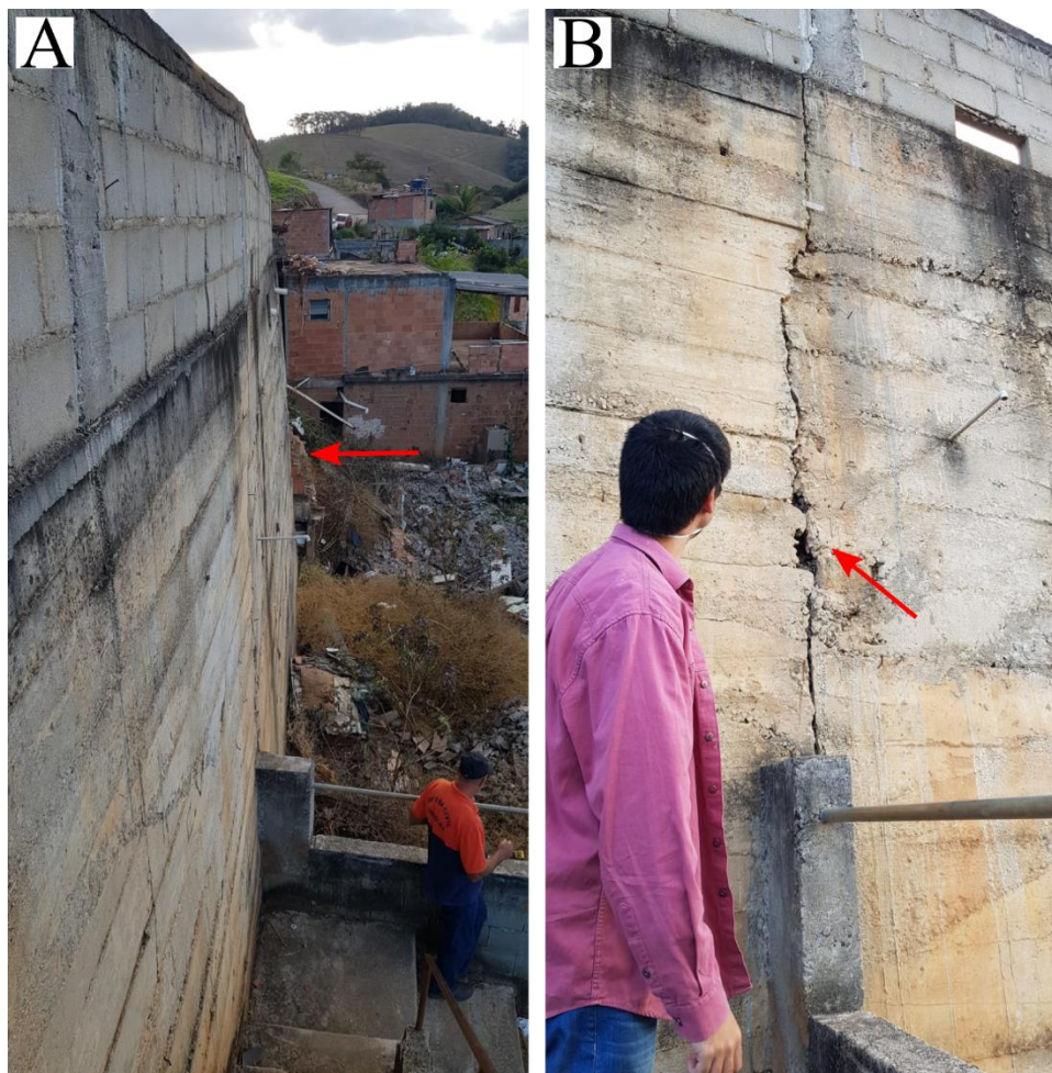
Figura 5: Muro de bloco cimentício . A) Embarrigamento do muro (seta vermelha); B) Rachadura no muro indicada pela seta vermelha.
