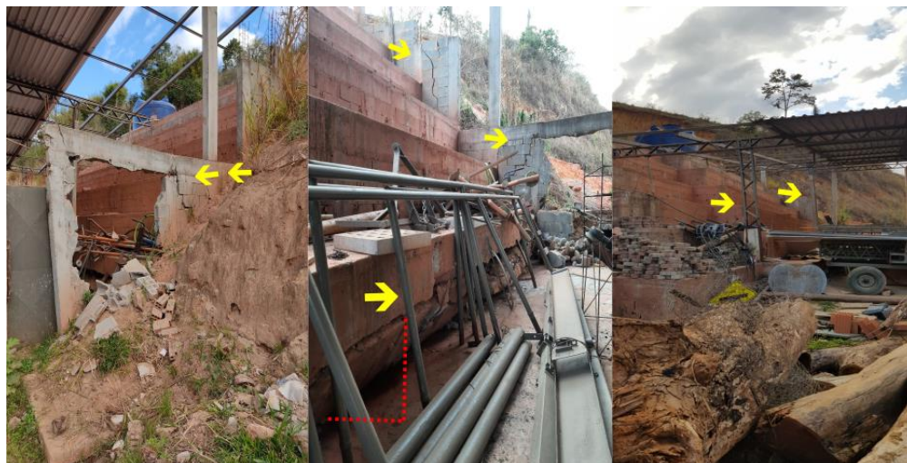
Figura 2: Da esquerda para a direita: parte do muro do antigo acesso danificado, base do muro de contenção deslocado e pilares do telhado envergados.
